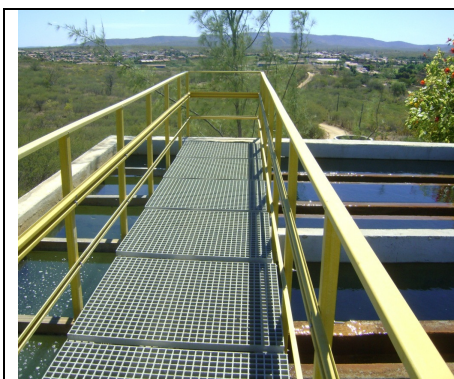
Foto 14 – Floccodecantador: em boas condições de manutenção.
