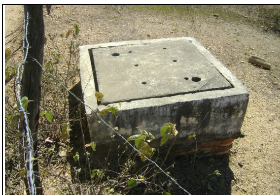
Foto 58 – Adutora de água bruta: caixa de inspeção de ventosa.
