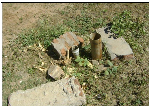
Foto 64 – Registro de descarga localizada na Rua Guedes Martins, próximo a bueira – Araça, com caixa de proteção danificada.
