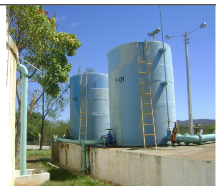
Foto 10 – ETA: vista geral dos filtros.
