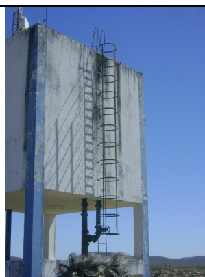
Foto 46 – REL-02: pintura do reservatório e da gaiola protetora da escada de acesso externo, deteriorada.
