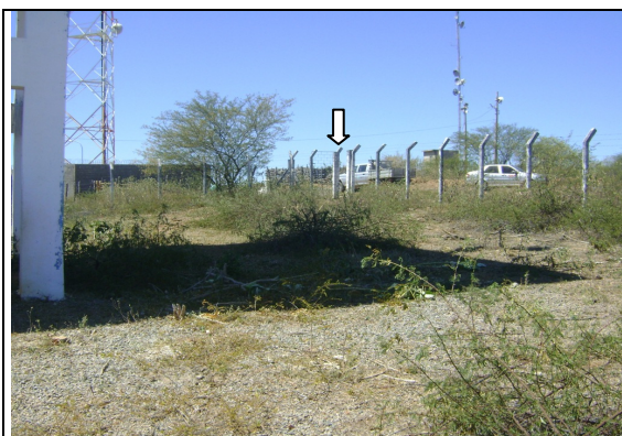
Foto 45 – REL-02: portão de acesso à área sem fixação.
