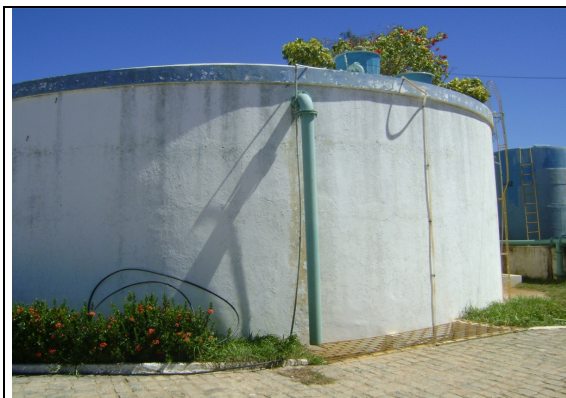
Foto 36 – RAP-02: ausência de identificação.
