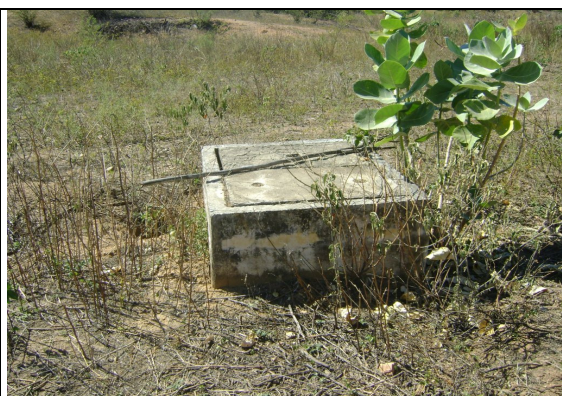
Foto 59 – Adutora de água bruta: caixa de inspeção de ventosa.
