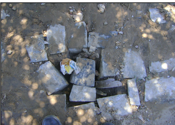
Foto 70 – Registro de descarga localizado na Rua Guedes Martins, 2 esquina da Rua Bela Vista – Araça, sem caixa de proteção.
