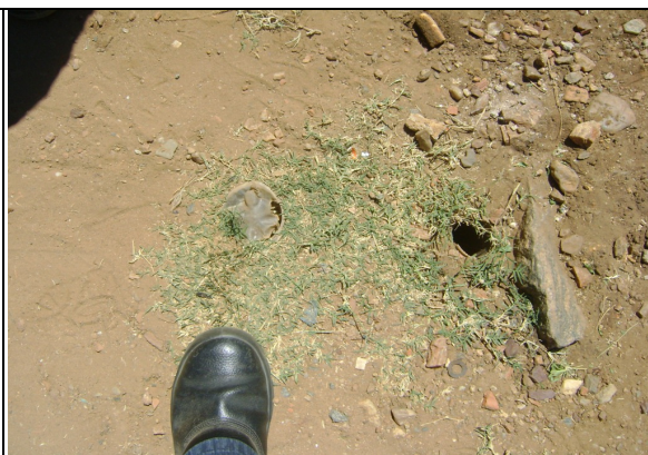
Foto 69 – Registro de descarga localizada na Rua Vinor Leite, 63 – Araça, sem caixa de proteção.
