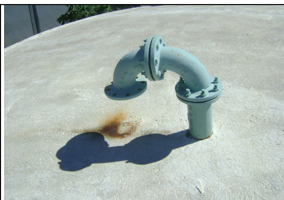
Foto 41 – RAP-02: tubulação de ventilação sem tela de proteção.
