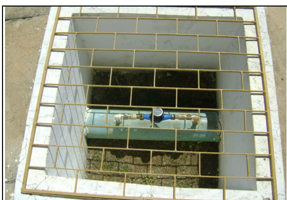
Foto 54 – Macromedidor na saída do RAP-02, para lavagem dos filtros.
