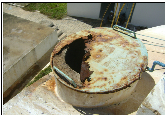
Foto 40 – RAP-02: tampa de inspeção, deteriorada.
