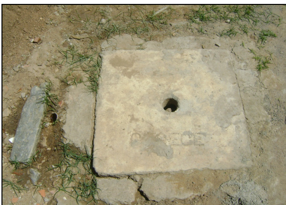
Foto 66 – Registro de descarga localizada na Rua E, 100 – Conjunto Habitacional – Vila Paulo Gonçalves.
