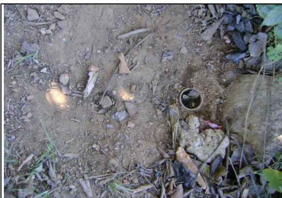
Foto 68 – Registro de descarga localizado na Rua Vila Freire, 495 – Vila Paulo Gonçalves, sem caixa de proteção.
