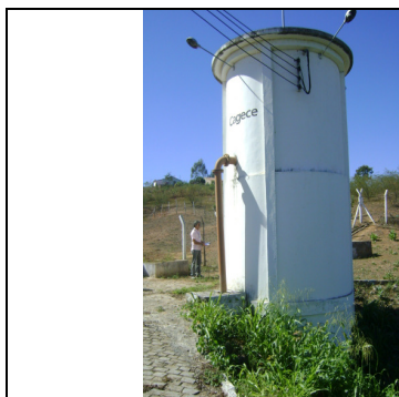
Foto 29 – EE-01: ausência de identificação.
