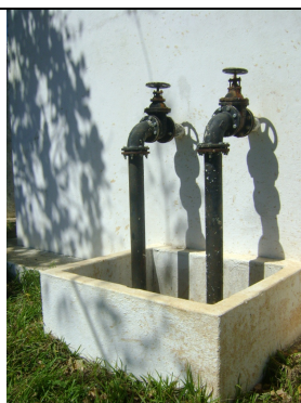
Foto 17 – Flocculador: caixa de proteção de descarga de fundo, sem tampa.
