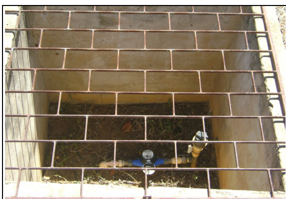
Foto 56 – Macromedidor na chegada do REL-02.
