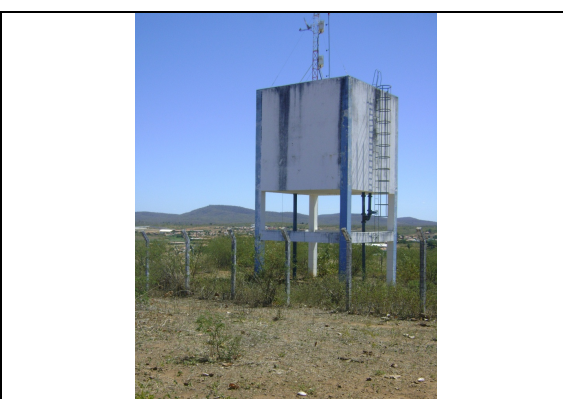
Foto 55 – Ausência de medidor e controle de nível, no REL-02.
