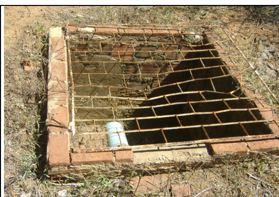
Foto 57 – Estação pitométrica com grade de proteção deteriorada, na área do REL-02.
