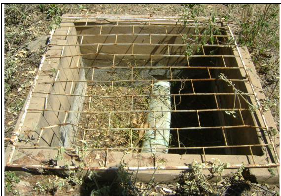
Foto 51 – REL-02: grade de proteção da caixa da tubulação, deteriorada.
