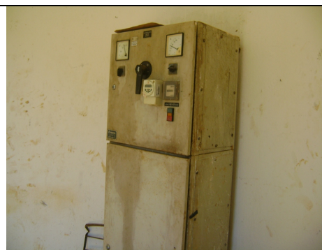
Foto 30 – EE-01: quadro de comando com pintura deteriorada.
