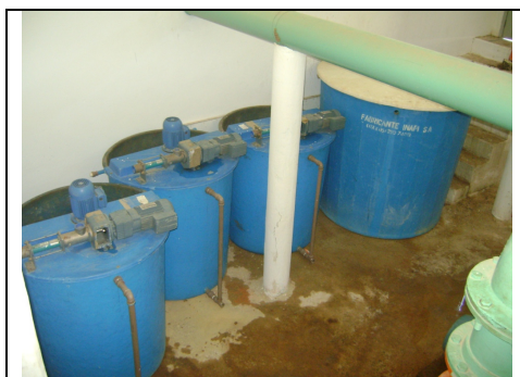
Foto 28 – Tanques dosadores, agitadores e bombas para reposição.
