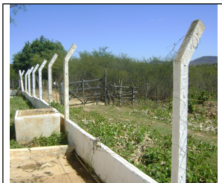
Foto 13 – ETA: parte da cerca de proteção sem arame farpado.
