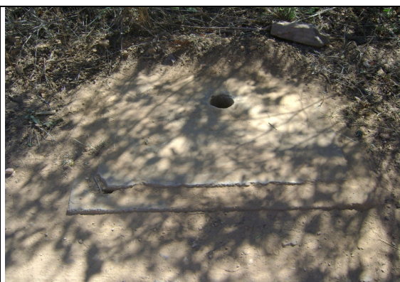
Foto 61 – Adutora de água bruta: caixa de inspeção de registro de descarga.
