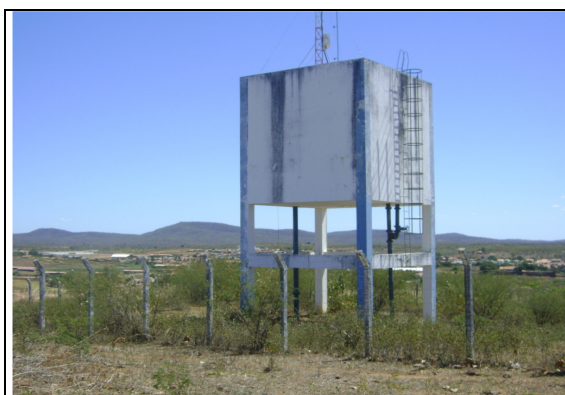
Foto 43 – REL-02: ausência de placa indicativa, identificando a área como pertencente à CAGECE.
