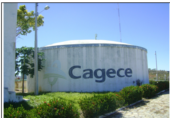
Foto 42 – RAP-02: pintura deteriorada.
