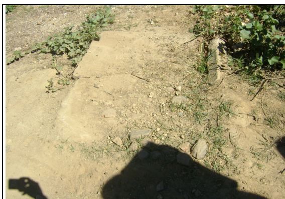
Foto 60 – Adutora de água bruta: caixa de inspeção de registro de descarga.
