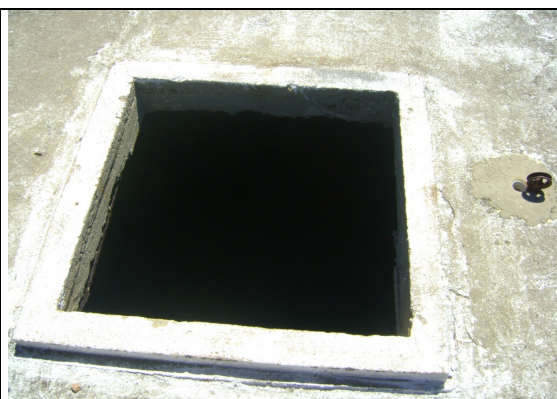
Foto 48 – REL-02: ausência de tampa de inspeção.
