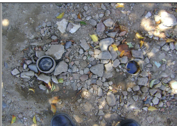
Foto 71 – Registro de descarga localizada na Rua Sete de Setembro, 1 – Centro, sem caixa de proteção.
