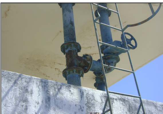
Foto 49 – REL-02: barrilete com pintura deteriorada.
