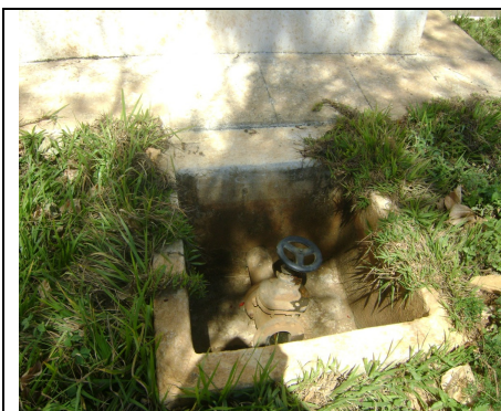
Foto 16 – Flocculador: caixa de proteção de descarga de fundo, sem tampa.
