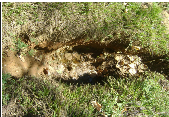
Foto 53 – Estação pitométrica, sem caixa de proteção, na ETA.
