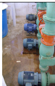
Foto 32 – EE-02: ausência de identificação.
