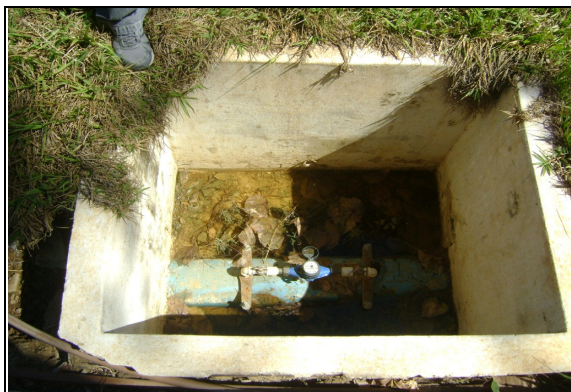
Foto 52 – Macromedidor na chegada da ETA, com caixa de proteção sem tampa.
