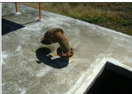
Foto 50 – REL-02: tubulação de ventilação sem tela de proteção e pintura deteriorada.
