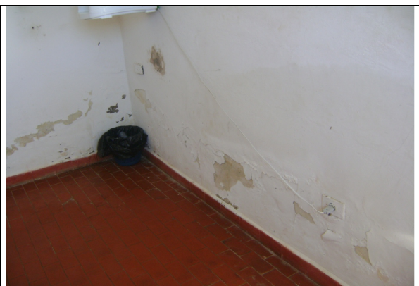
Foto 81 – Pintura interna deteriorada.
