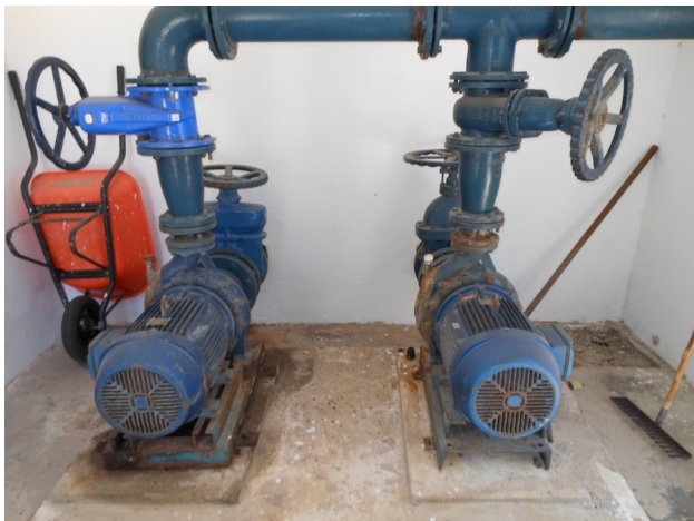
Foto 26 - Elevatória: conjunto motor-bomba e reserva da EEAT-01.
