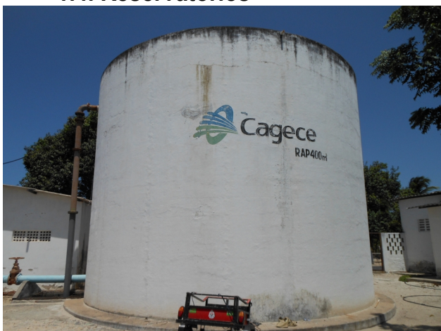
Foto 29 - Reservatório: identificação do RAP-01 e pintura deteriorada.
