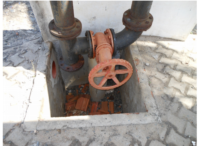
Foto 36 - Reservatório: caixa do registro de descarga do REL-01 sem grade de proteção.
