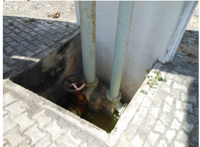
Foto 38 - Reservatório: caixa do registro do REL-01 sem grade de proteção.
