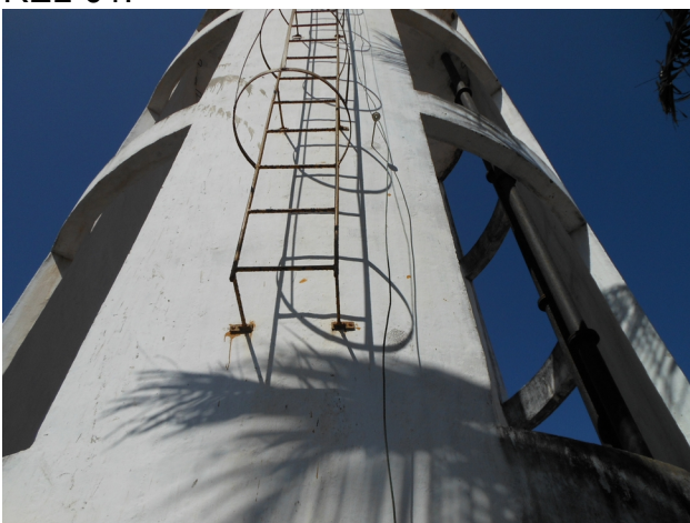
Foto 39 - Reservatório: escada de acesso ao REL-01 apresenta corrosão.
