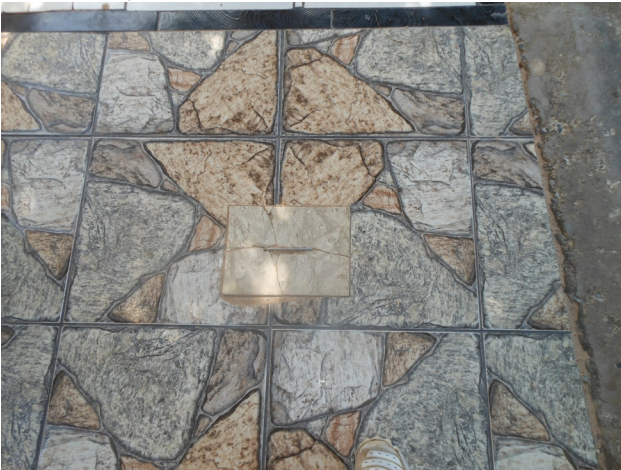
Foto 42 - Registro de descarga localizado na Avenida João Batista Rios, 264.
