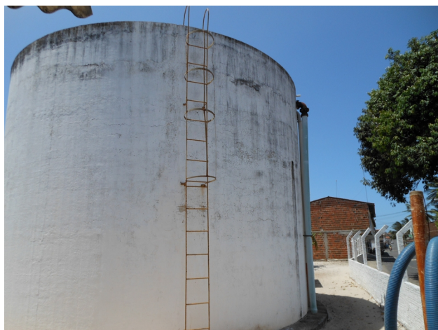
Foto 30 - Reservatório: escada de acesso ao RAP-01 apresenta corrosão.
