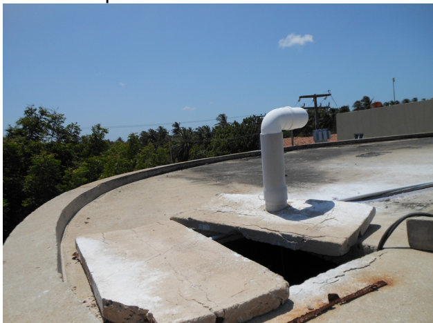
Foto 31 - Reservatório: ausência de guarda-corpo na laje de cobertura e tampa danificada do RAP-01.
