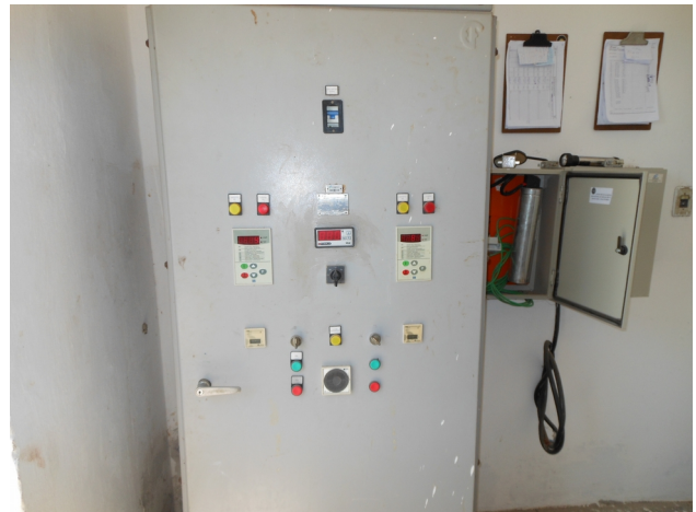
Foto 25 - Elevatória: quadro de comando da EEAT-01.
