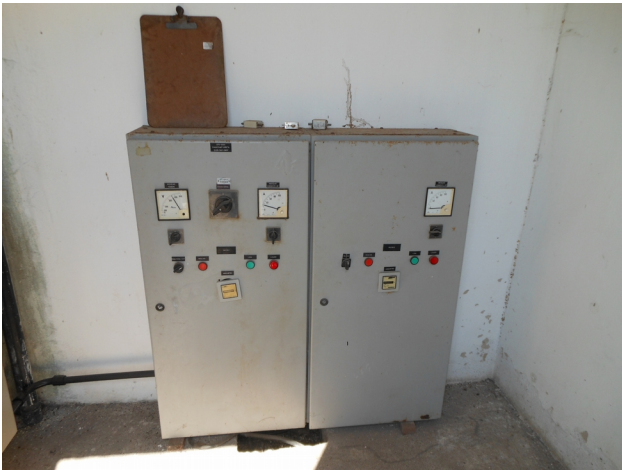
Foto 13 - Captação: quadro de comando da EEPT-06.
