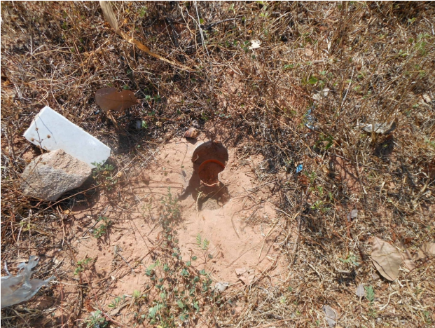
Foto 40 - Registro de descarga sem caixa de proteção localizado na Estrada para Almofala, 3938.
