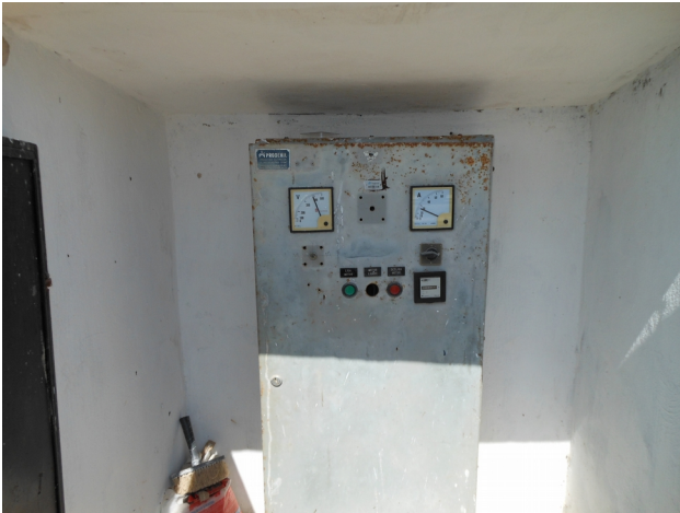
Foto 7 - Captação: quadro de comando da EEPT-03.
