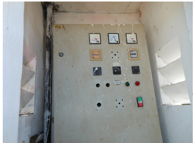
Foto 10 - Captação: quadro de comando da EEPT-04.
