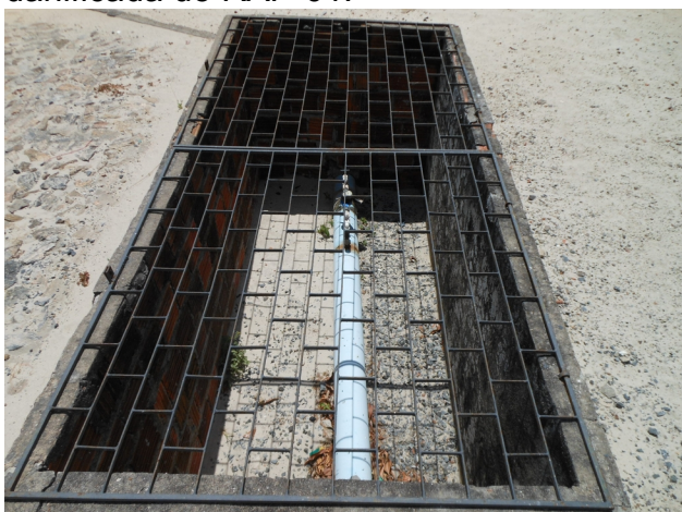
Foto 33 - Reservatório: medidor proporcional localizado na área do RAP-01 com grade de proteção.
