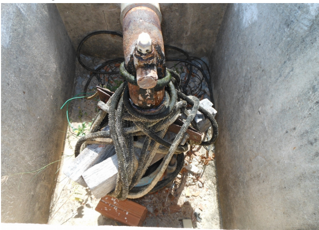
Foto 5 - Captação: ausência de tampa de proteção do PT-03.
