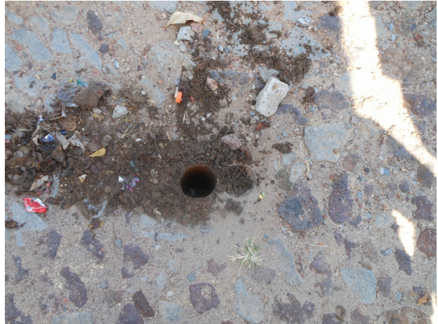
Foto 41 - Registro de descarga sem caixa de proteção localizado na Rua João Elias Brandão, 110.
