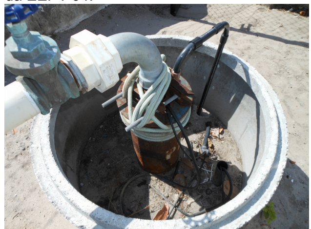
Foto 12 - Captação: tampa de proteção do PT-06.
