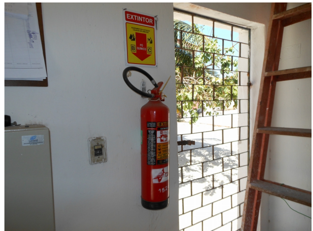
Foto 27 - Elevatória: extintor de incêndio dentro do prazo de validade.
