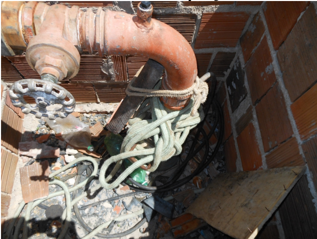
Foto 1 - Captação: ausência de tampa de proteção do PT-02.
