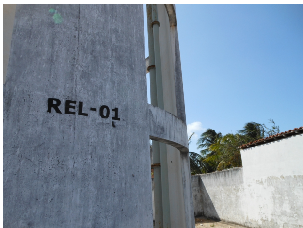
Foto 34 - Reservatório: identificação do REL-01 e pintura deteriorada.
