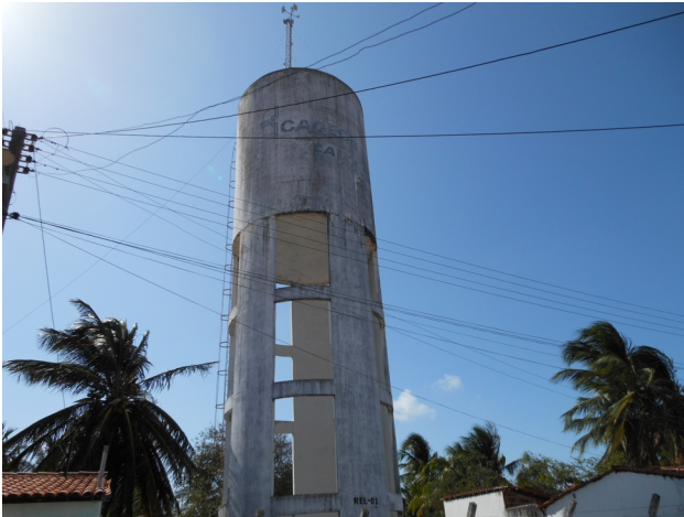
Foto 35 - Reservatório: ausência de guarda-corpo na laje de cobertura e sinalização noturna no REL-01.
