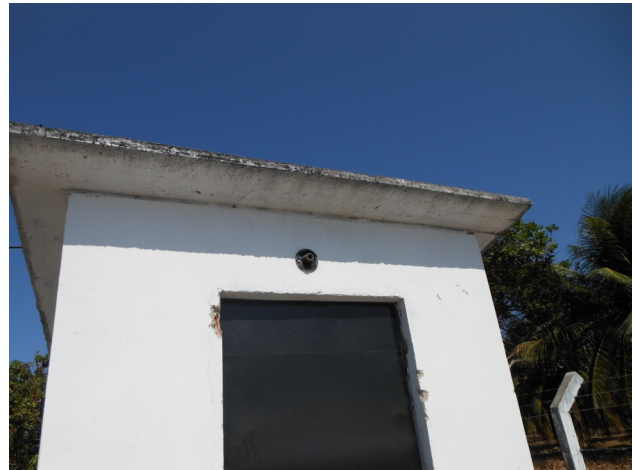
Foto 14 - Captação: ausência de iluminação na casa de abrigo da EEPT-06.
