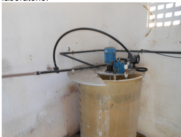
Foto 22 - Casa de Química: tanque dosador de cloro.
