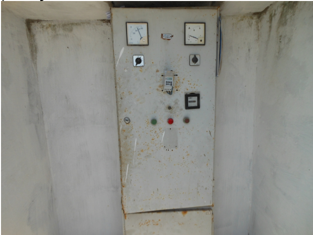
Foto 3 - Captação: quadro de comando da EEPT-02.
