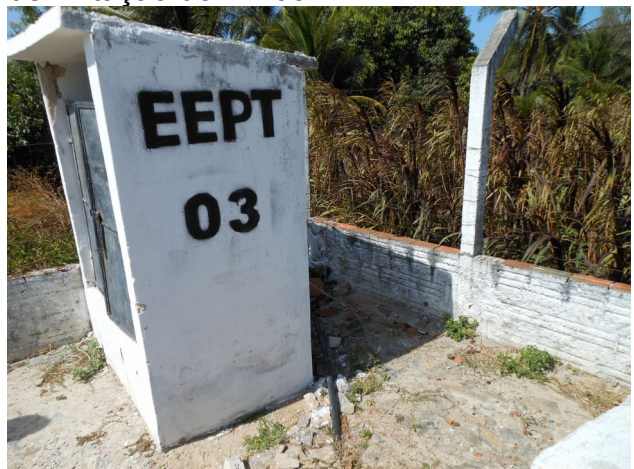
Foto 6 - Captação: identificação da EEPT-03.
