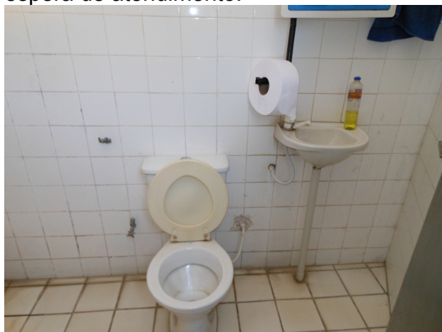
Foto 49 - Instalações sanitárias disponíveis para funcionários e usuários.
