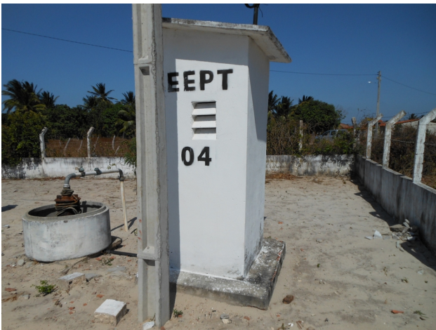
Foto 9 - Captação: identificação da EEPT-04.
