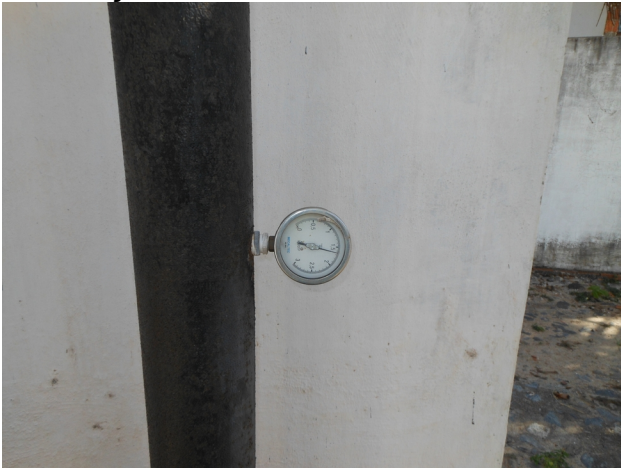
Foto 37 - Reservatório: medidor de nível do REL-01.
