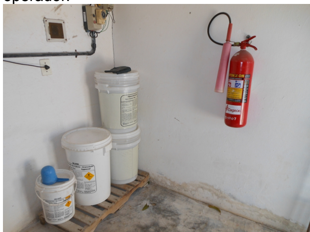
Foto 23 - Casa de Química: armazenamento de produto químico e extintor de incêndio dentro do prazo de validade.
