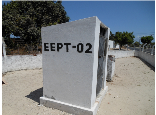
Foto 2 - Captação: identificação da EEPT-02.
