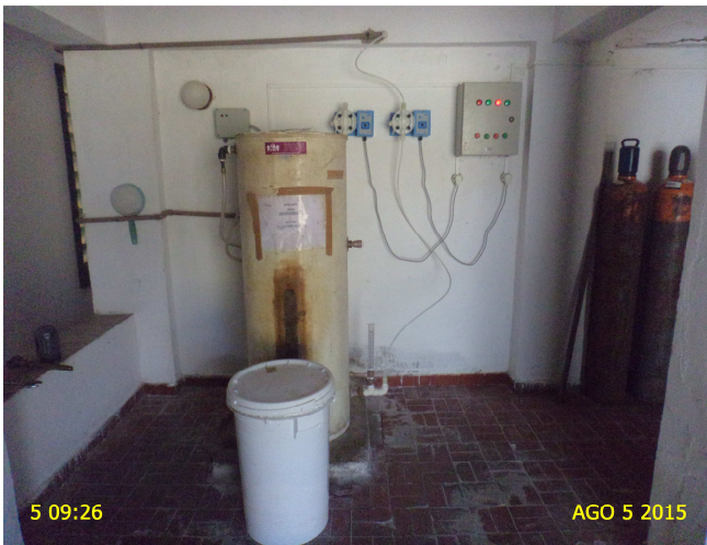
Foto 5 – casa de química: sistema de fluoretação com defeito.
