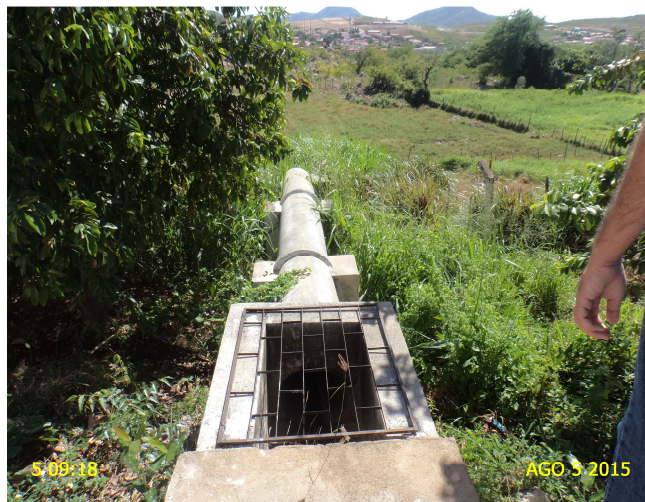
Foto 12 – ETA/Filtração: Local de descarga das águas de lavagem dos filtros.
