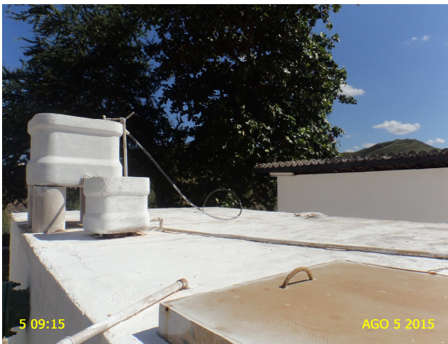
Foto 4 – RAP-01: ausência de tubulação de ventilação.
