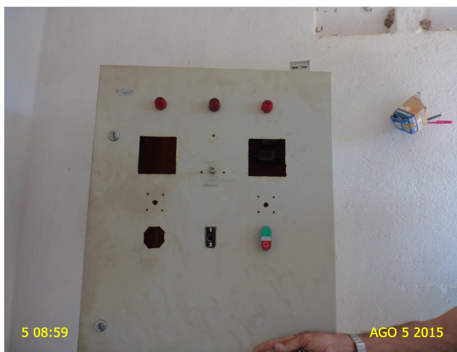
Foto 2 – EECS-01: quadro de comando sem amperímetro, horímetro e voltímetro.
