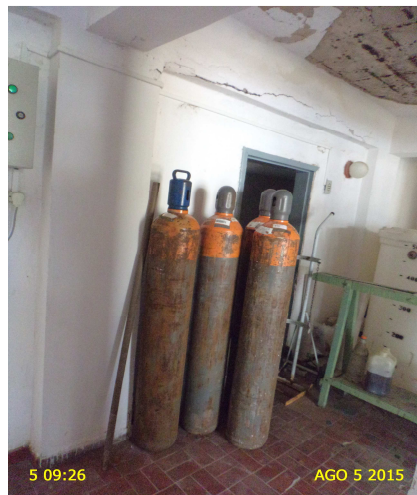
Foto 10 – Casa de química: cilindros de cloro gasoso em local inadequado.
