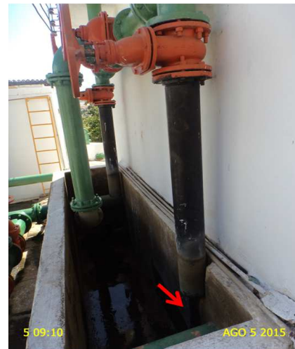
Foto 6 – F-02: registro com vazamento.
