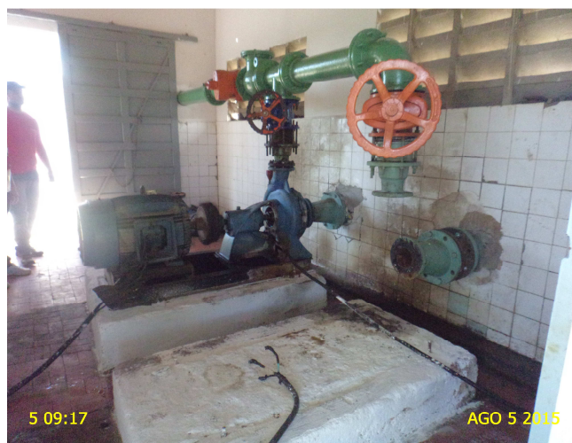
Foto 3 – EEAT-01: ausência bomba reserva.
