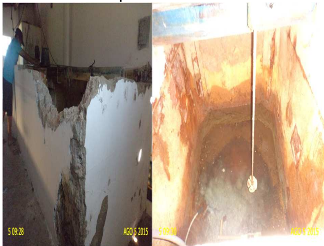
Foto 11 – ETA: tanques dosadores em inadequadas condições.
