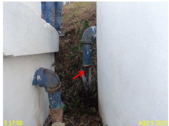
Foto 8 – RAP-03: vazamento na tubulação de descarga.
