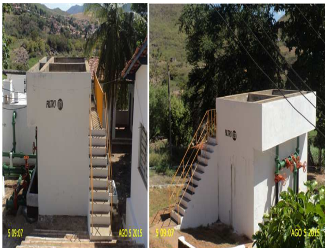
Foto 9 – Filtros F-01, F-02, F-03 e F-04: ausência de tampas.
