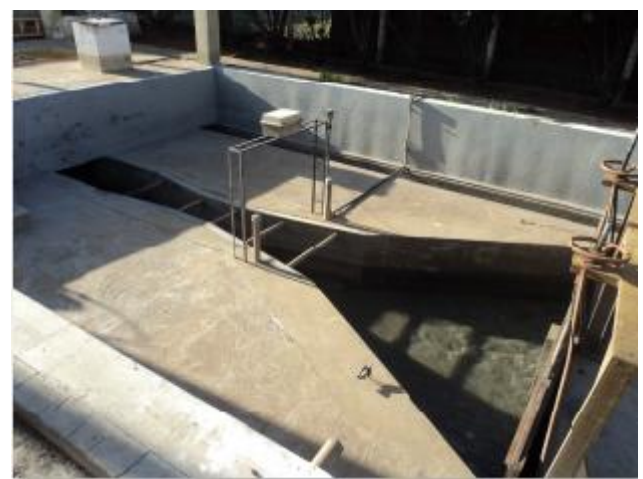
Foto 10 – EEE-Malvas: calha Parshall.
