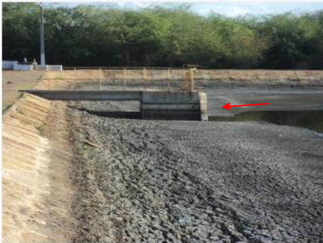
Foto 13 – ETE-Malvas: estrutura de chegada do esgoto danificada na lagoa anaeróbia desativada.
