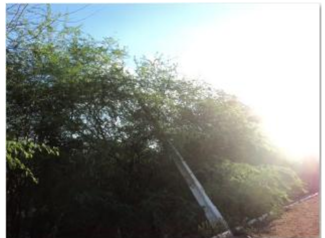
Foto 18 – ETE-Malvas: poste de iluminação inclinado com risco de queda.
