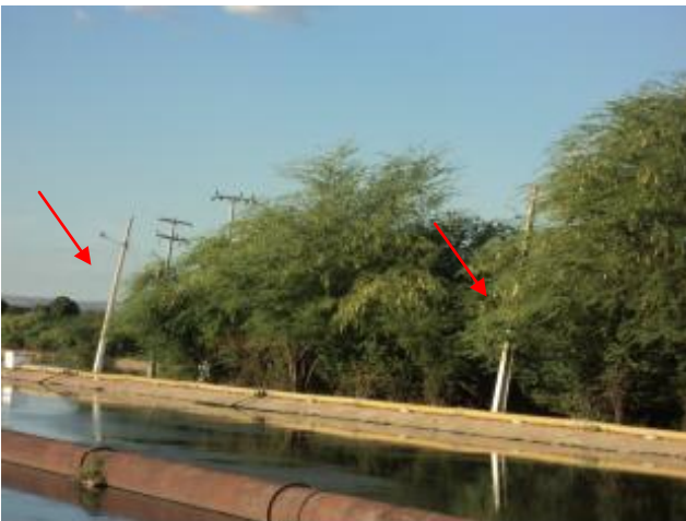
Foto 17 – ETE-Malvas: postes de iluminação inclinados com risco de queda.
