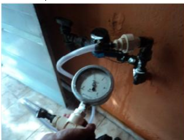
Foto 4 – Medição instantânea de pressão na Rua do Horto, 449 – Horto.
