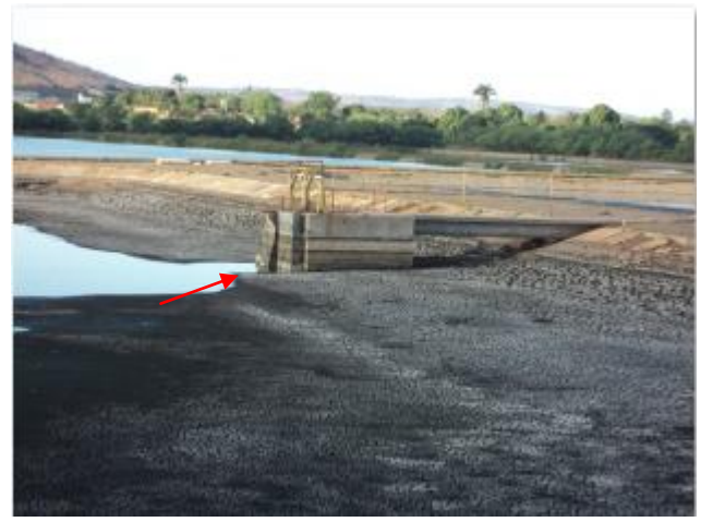
Foto 12 – ETE-Malvas: estrutura de chegada do esgoto danificada na lagoa anaeróbia desativada.
