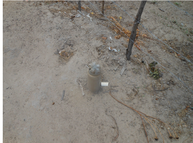
Foto 13 - Registro de descarga na rede de distribuição, sem caixa, localizado na Rua Maria do Carmo Lima – Estação.
