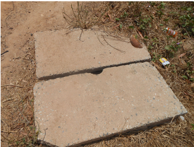
Foto 10 - Registro de manobra, localizado na CE – Itapipoca, debaixo da Ponte – Estação.
