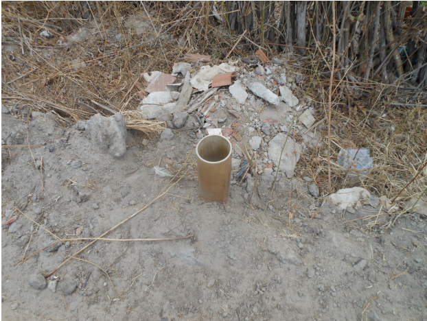
Foto 12 - Registro de descarga, sem caixa, localizado na Rua Francisco Juarez Rodrigues – Estação.
