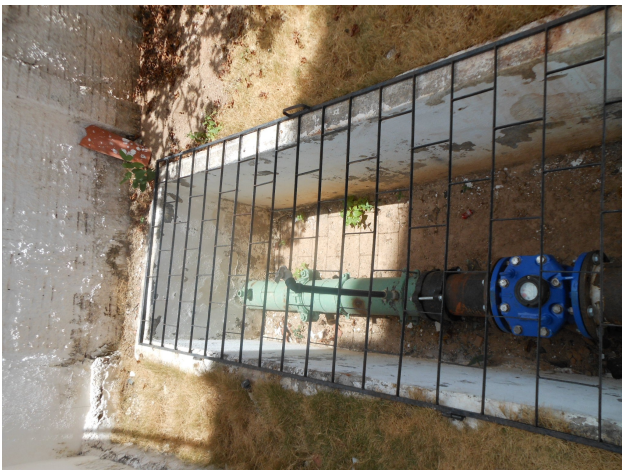
Foto 6 - REL-01: adutora com macromedidor.
