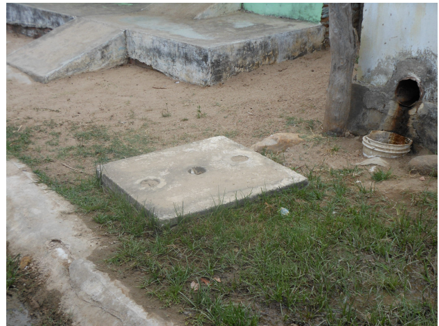
Foto 11 - Registro de descarga na rede de distribuição, localizado na Rua Mestre Zezé, em frente ao nº 2090 – Estação.
