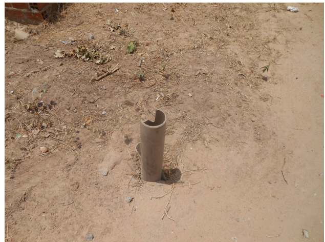
Foto 15 - Registro de descarga na rede de distribuição, sem caixa, localizado na Rua Adv. José Porfírio Sampaio – Alto da Paz.
