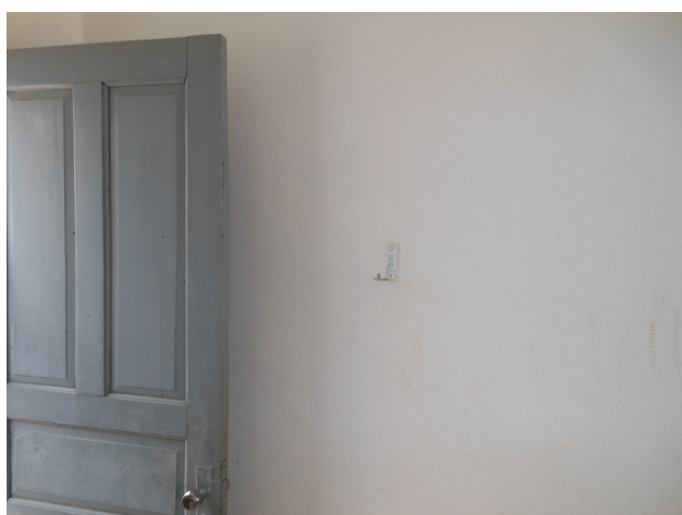
Foto 22 - Comercial/Escritório/Almoxarifado: Suporte para extintor de incêndio vazio.
