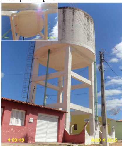
Foto 6 – REL-01: pintura deteriorada e sinais de infiltração.
