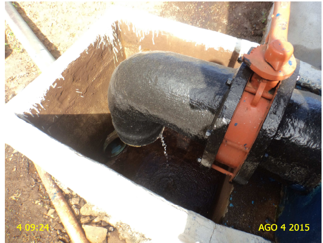
Foto 3 – F-01: vazamento no registro.
