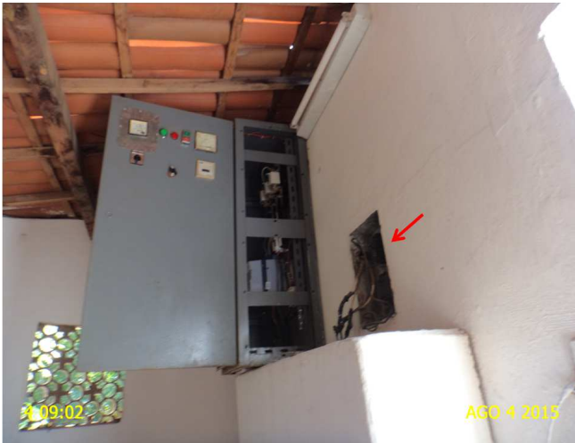
Foto 2 – PA-01: quadro de força com fiação exposta.
