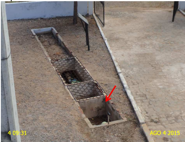
Foto 4 – ETA: caixa de inspeção sem tampa ou grade de proteção.
