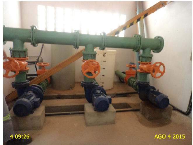
Foto 5 – EELF-01: bomba reserva com defeito.
