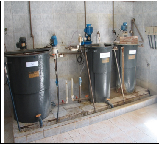
Foto 13 – Tanques de dosagem
