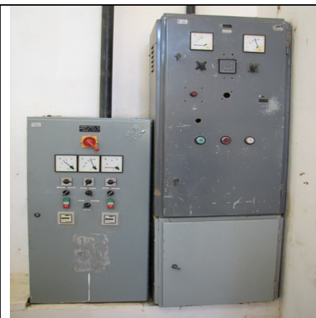
Foto 22 – Quadro elétrico da EEAT-01 e EELF-01
