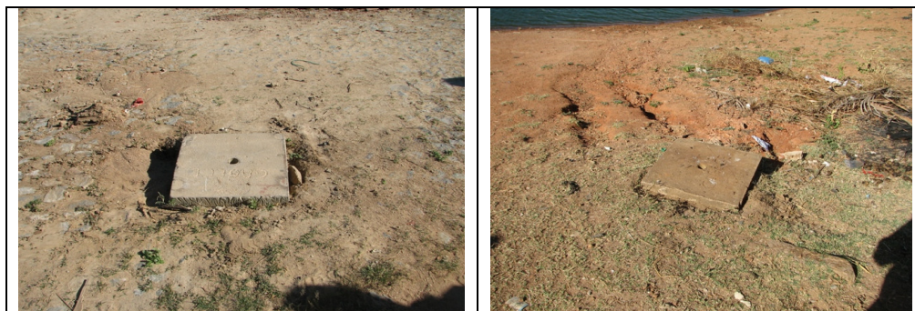
Fotos 29 e 30 – Registros de descarga na Rua Onorina Moreira Lima e Rua Alexandre de Melo
