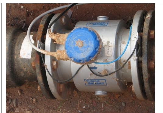
Foto 27 – Macromedidor na saída do RAP-01
