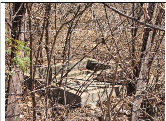
Foto 28 – Ventosa da adutora de água bruta, próximo à captação
