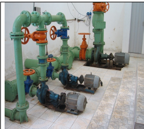
Foto 21 – Vista da EEAT-01 e EELF-01
