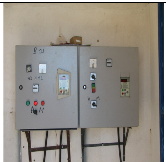
Foto 20 – Quadro elétrico da EECS-01
