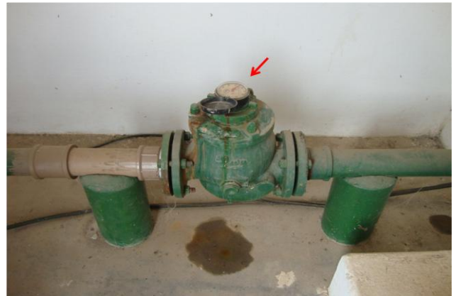
Foto 25 – Macromedidor do PT-01.
