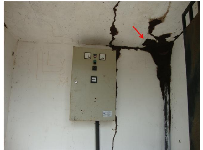
Foto 10 – PT-02: quadro de comando e presença de cupim na parede.
