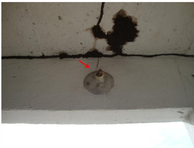
Foto 11 – PT-02: ausência de iluminação interna na casa de abrigo do quadro de comando.
