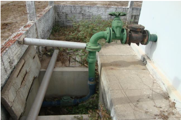
Foto 24 – Registro instalado na adutora de água bruta do PT-01 sem tampa ou grade de proteção.
