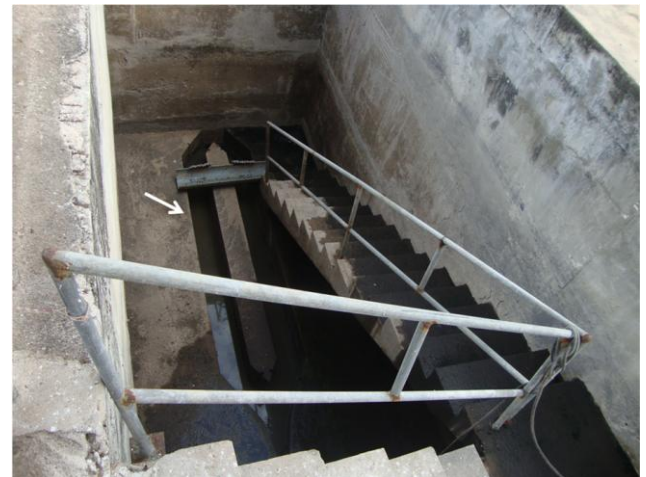
Foto 57 – EEE-02: caixa de areia.
