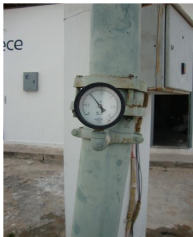
Foto 33 – REL-01: medidor de nível.
