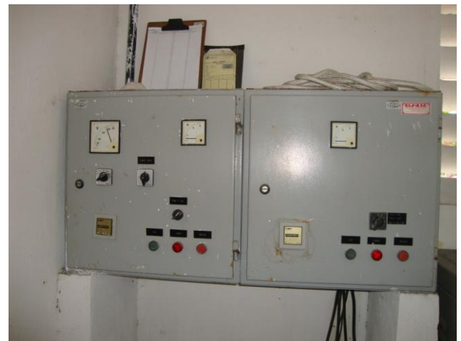
Foto 51 – EEE-01: quadro de comando do conjunto moto-bomba.
