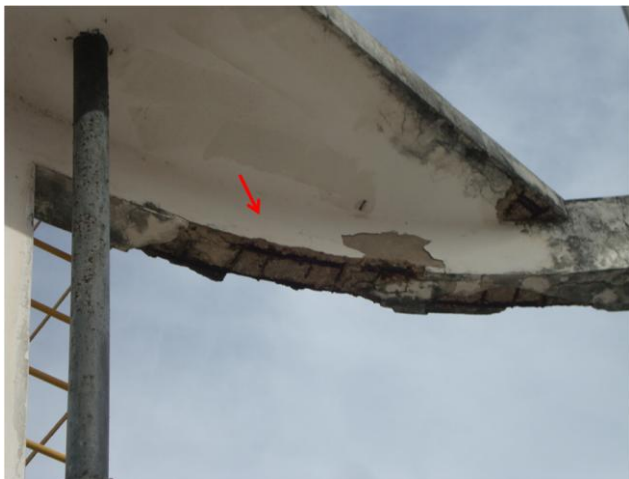
Foto 30 – REL-01: estrutura deteriorada.
