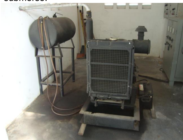
Foto 52 – EEE-01: grupo gerador de energia.
