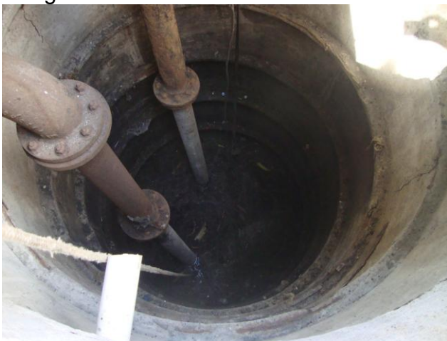
Foto 50 – EEE-01: conjunto moto-bomba submerso.
