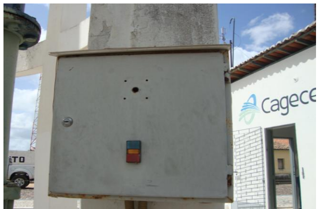
Foto 27 – Quadro de comando do Booster-01 .
