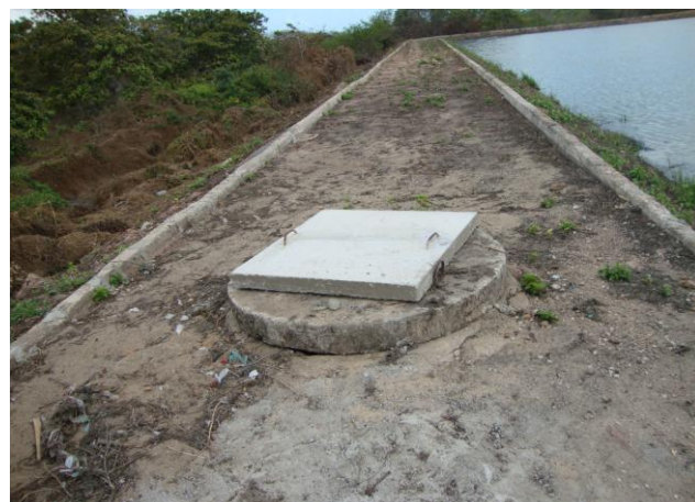
Foto 68 – ETE: poço de chegada na lagoa facultativa.
