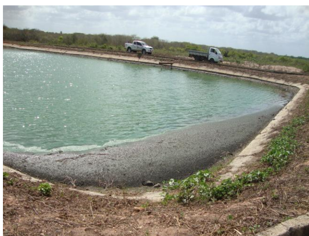
Foto 75 – ETE: lagoa de maturação II com sobrenadante.
