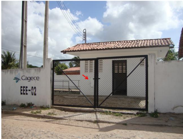
Foto 54 – EEE-02: vista externa com portão danificado.
