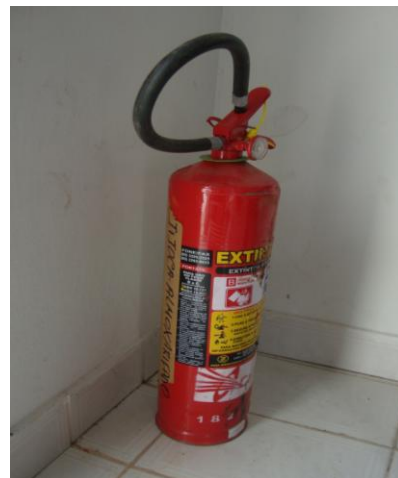
Foto 82 – Extintor de incêndio da loja de atendimento com validade até ago/2014.
