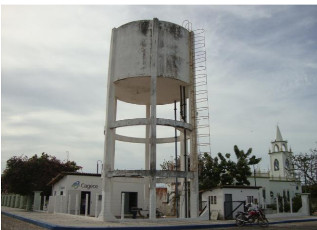
Foto 28 – REL-01: ausência de guarda-corpo na laje de cobertura.
