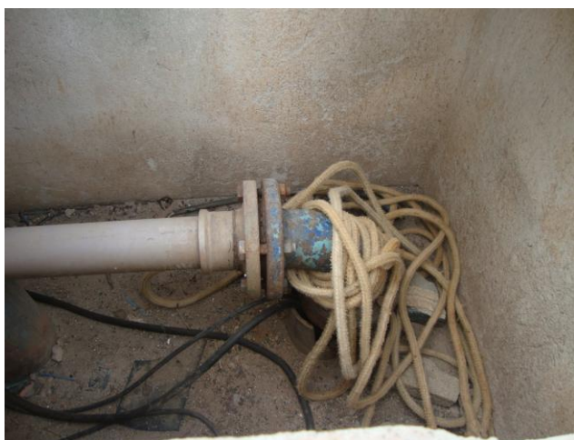
Foto 3 – PT-01: tubulação de recalque.
