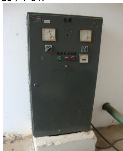
Foto 4 – PT-01: quadro de comando.
