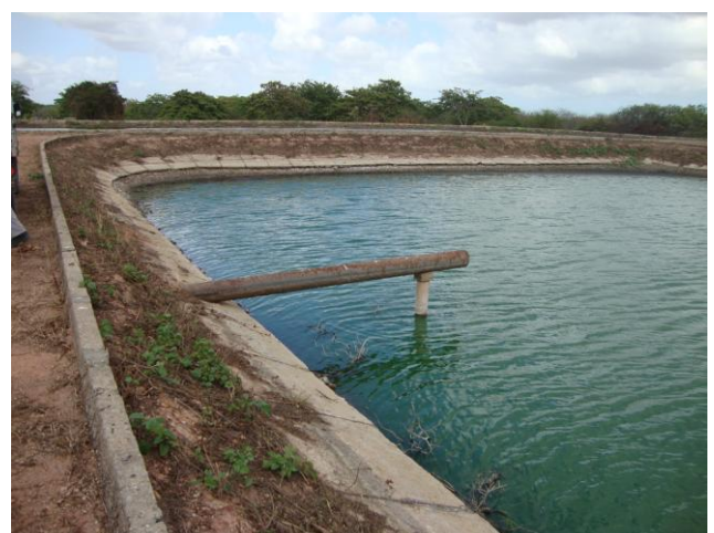
Foto 76 – ETE: tubulação de saída a lagoa de maturação II.
