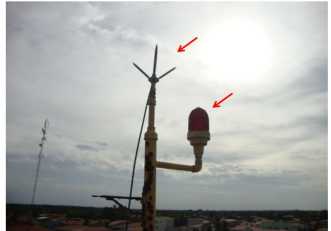
Foto 37 – REL-01: com para-raios e sinalização noturna.
