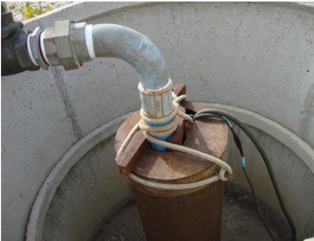
Foto 9 – PT-02: tubulação de recalque.
