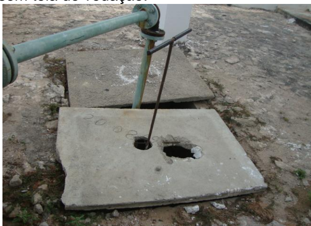
Foto 34 – REL-01: caixa de registro de descarga com tampa danificada.
