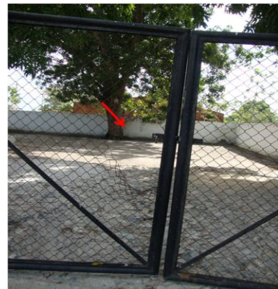
Foto 47 – EEE-01: portão de entrada danificado.
