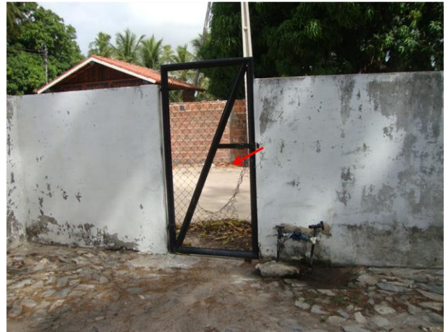
Foto 49 – EEE-01: portão interno danificado.
