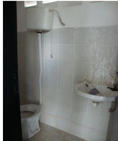
Foto 63 – EEE-02: instalação sanitária para o operador.
