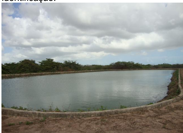
Foto 69 – ETE: lagoa de facultativa.
