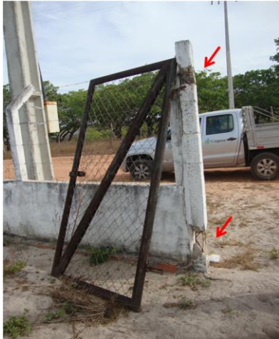
Foto 7 – PT-02: portão de acesso danificado.
