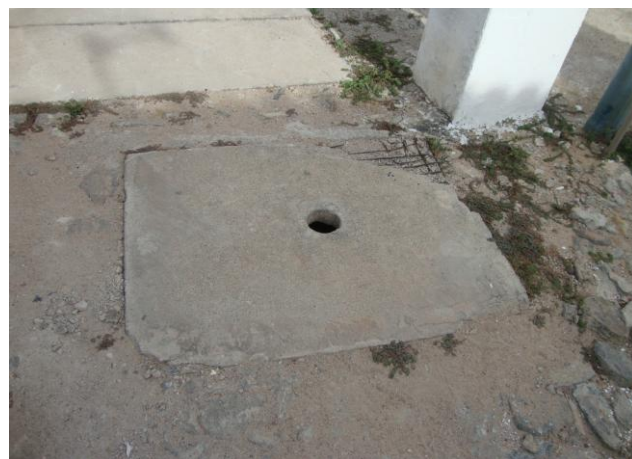
Foto 35 – REL-01: caixa de registro de descarga.
