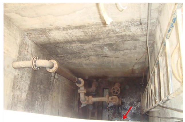
Foto 59 – EEE-02: Conjunto moto-bomba sem reserva.
