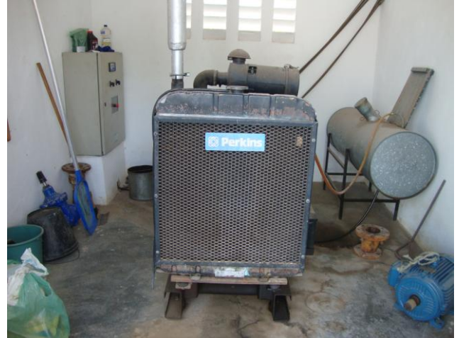
Foto 61 – EEE-02: grupo gerador de energia elétrica.
