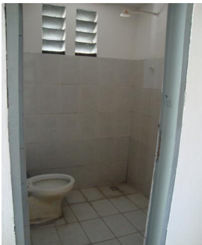
Foto 81 – Instalações sanitárias disponíveis para funcionários e usuários.
