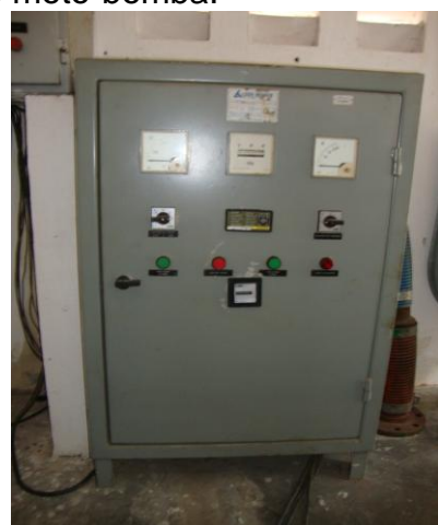
Foto 53 – EEE-01: quadro de comando do gerador.
