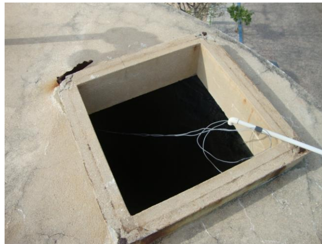
Foto 31 – REL-01: sem tampa de inspeção.
