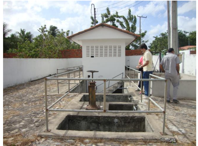
Foto 55 – EEE-02: vista do poço do tratamento preliminar.
