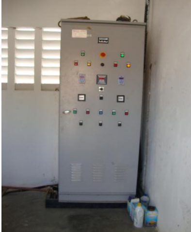
Foto 60 – EEE-02: quadro de comando do conjunto moto-bomba.
