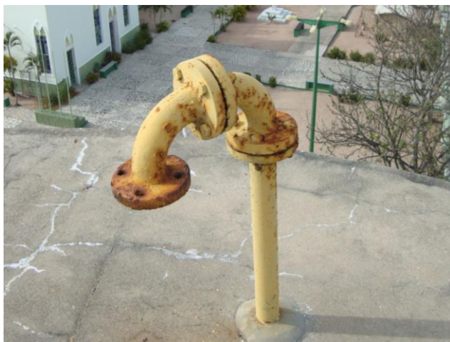
Foto 32 – REL-01: tubulação de ventilação sem tela de vedação.
