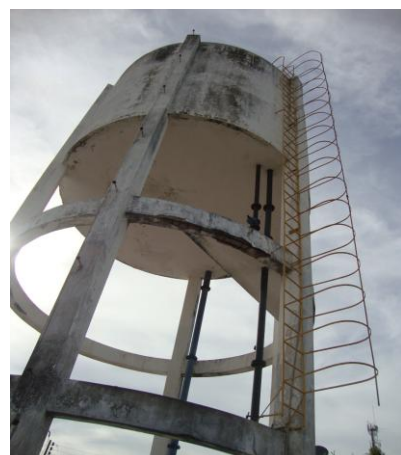
Foto 29 – REL-01: com escada de acesso e estrutura deteriorada.
