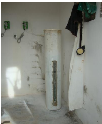
Foto 16 – Dosador de flúor.
