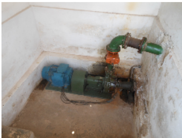
Foto 6 - Elevatória de água Bruta- EEAB-01.
