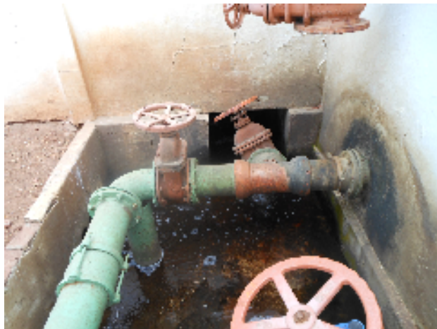
Foto 8 - Filtração: Destinação inadequada das águas de lavagem.
