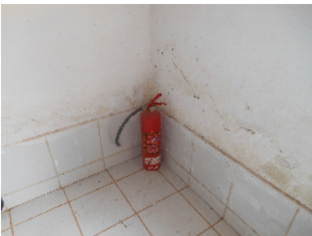
Foto 35 - Extintor de incêndio da EEAT-03.
