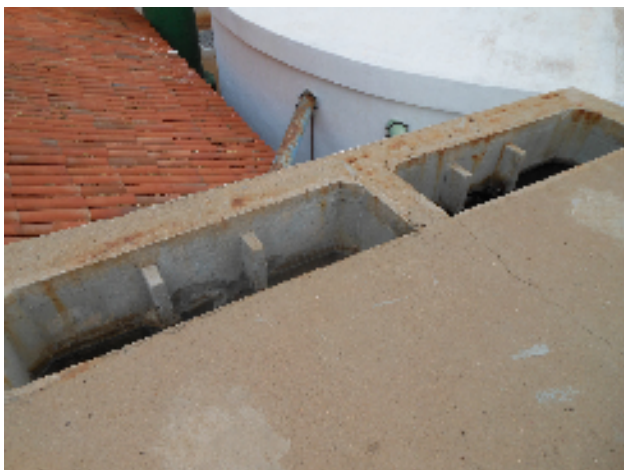
Foto 9 - Filtração: Calha dos filtros F-01 e F-02
