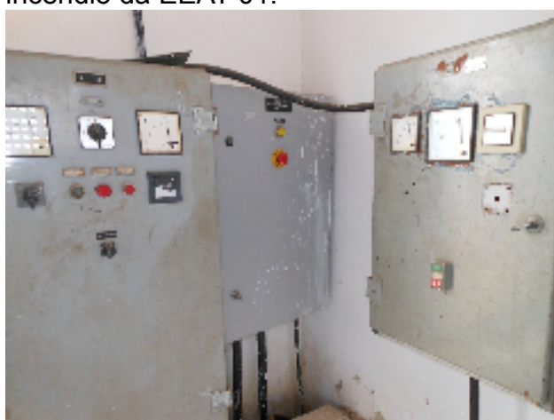
Foto 30 - Elevatória: Quadro de comando da EEAT-02.
