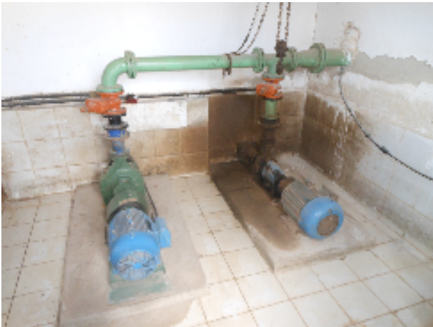
Foto 31 - Elevatória: Conjunto moto-bomba da EEAT-02.
