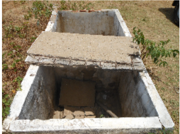
Foto 44 - Ausência de tampa ou grade na caixa de registro.
