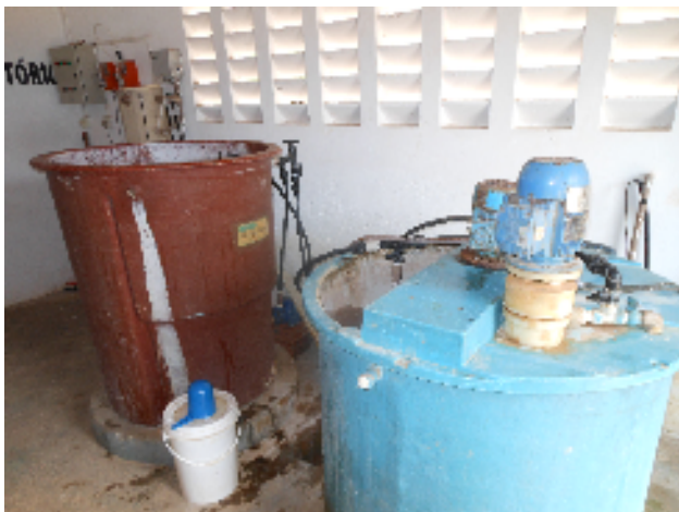
Foto 17 - Casa de Química: Tanque dosador de produtos químicos.
