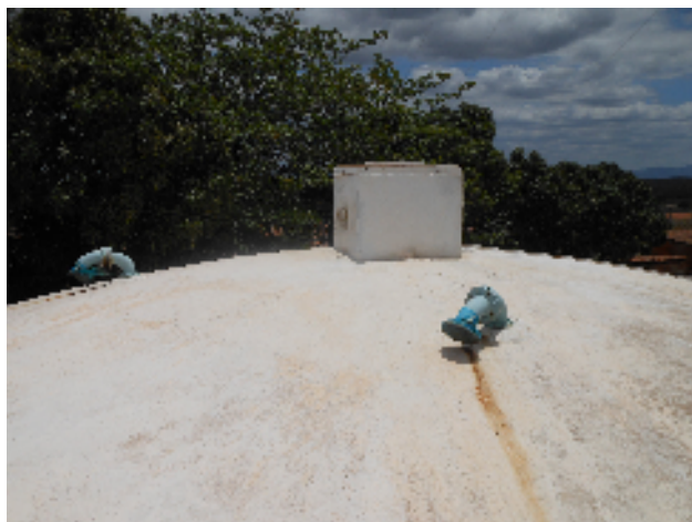
Foto 46 - Ventilação do RAP-01.
