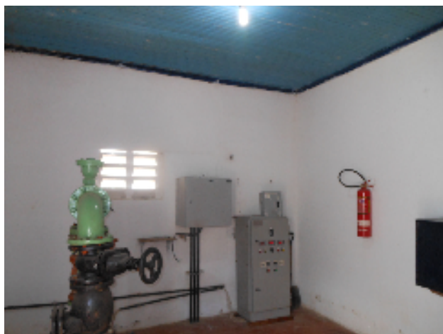
Foto 28 - Quadro de comando e extintor de incêndio da EEAT-01.
