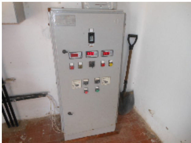
Foto 26 - Elevatória : Quadro de comando da EEAT-01.
