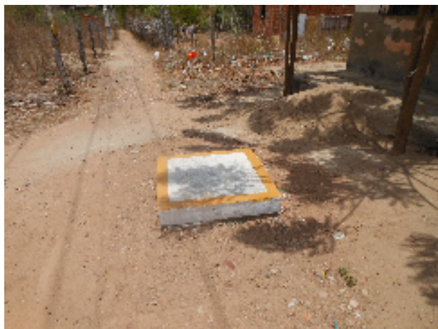
Foto 58 - Rede de distribuição: Registro de descarga localizado na Rua Alto Alegre, Alto Alegre.
