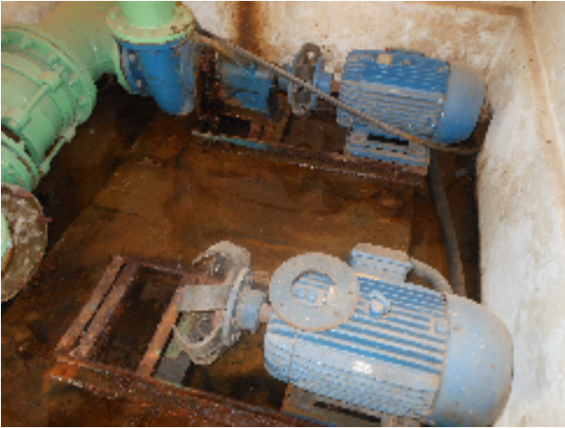
Foto 37 - Conjunto motor-bomba da EELF-01.
