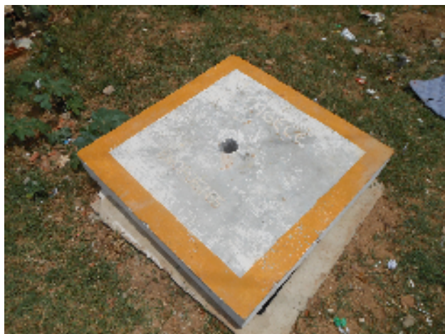
Foto 56 - Rede de distribuição: Registro de descarga localizado na Rua Francisco Chaves Nunes, Conj. São Francisco.
