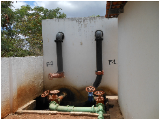
Foto 7 - Filtração: Filtros F-01 e F-02 em alvenaria.
