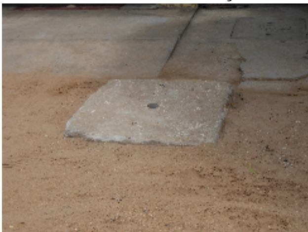
Foto 55 - Rede de distribuição: Registro de descarga localizado na Rua Francisco Chaves Nunes, Suate.
