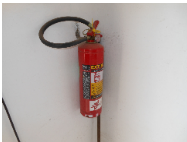
Foto 69 - Extintor de incêndio da loja.
