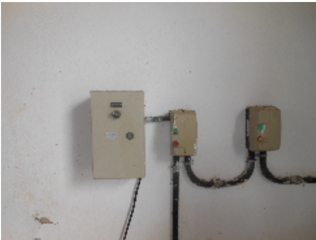
Foto 33 - Quadro de comando da EEAT-03.
