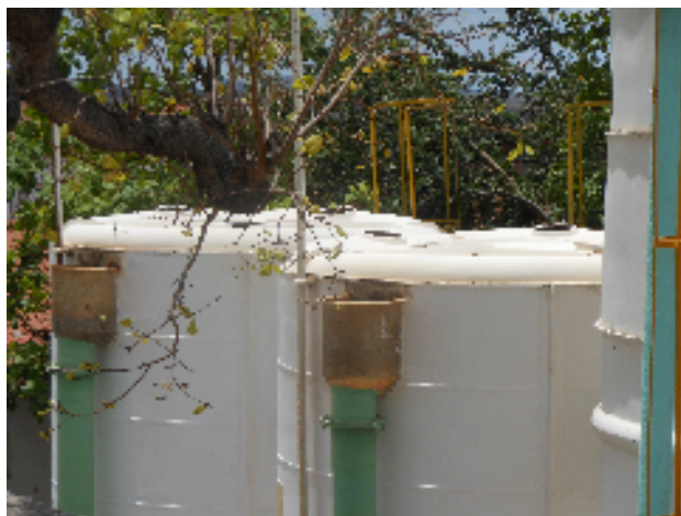
Foto 10 - Filtração: Ausência de tampa na
