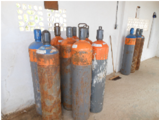
Foto 13 - Local de acondicionamento do cloro gasoso.
