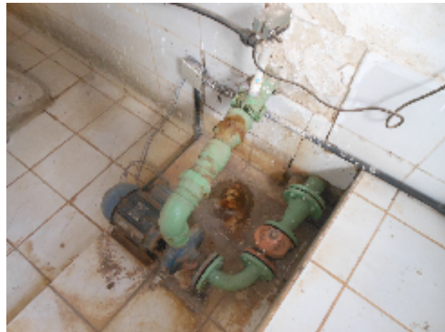
Foto 34 - Conjunto motor-bomba da EEAT-03.
