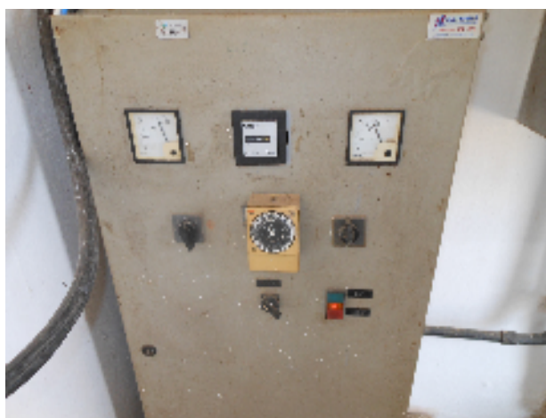
Foto 5 - Quadro de comando da bomba da EEAB-01.
