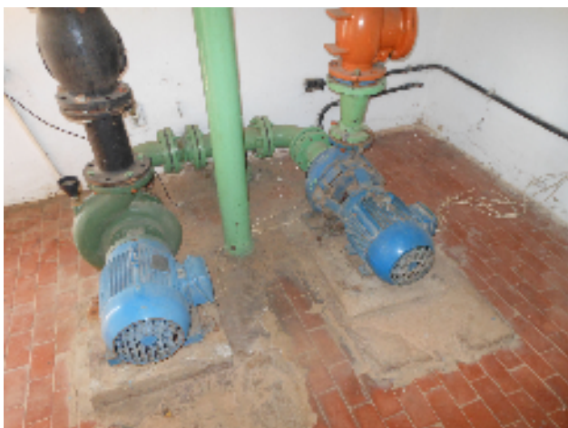
Foto 27 - Elevatória: Conjunto motor-bomba da EEAT-01.
