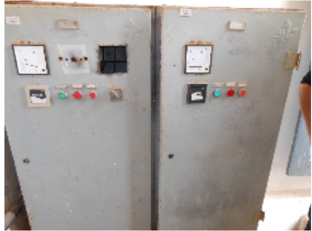
Foto 38 - Quadro de comando do EELF-01.
