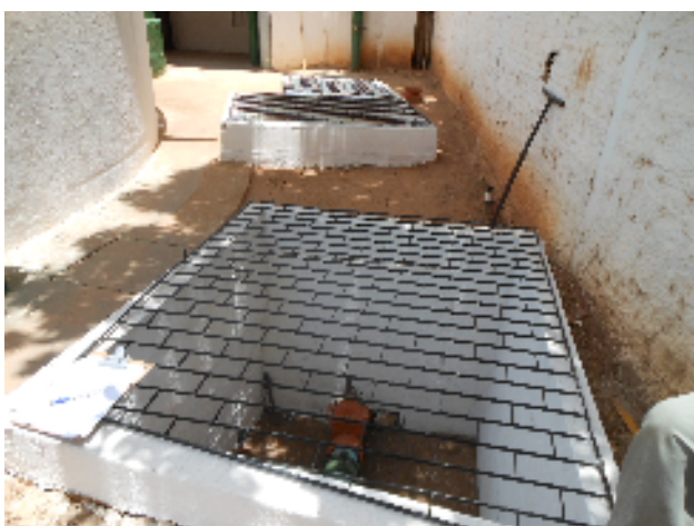
Foto 49 - Caixa de registro do RAP-01.
