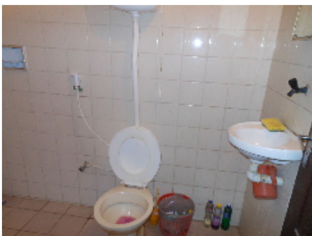
Foto 62 - Instalações sanitárias disponíveis para funcionários e usuários.
