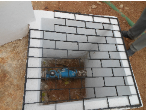
Foto 41 - Macromedidor de água tratada.
