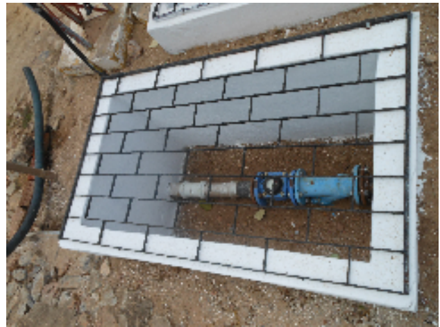
Foto 40 - Macromedidor de água tratada.
