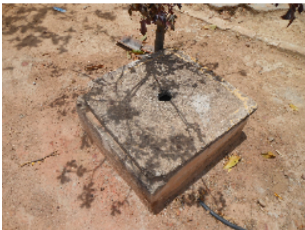
Foto 57 - Rede de distribuição: Registro de descarga localizado na Rua da Coelce, Coelce.
