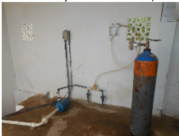
Foto 12 - Cilindros e dosador de cloro gasoso.
