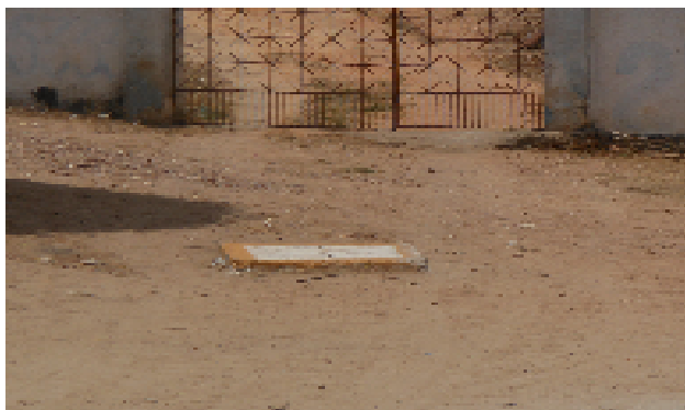
Foto 59 - Rede de distribuição: Registro de descarga localizada na Rua 7 de Setembro, Salgado.
