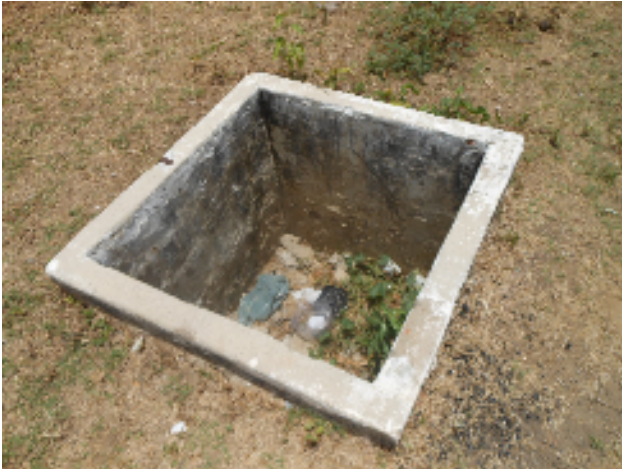
Foto 43 - Ausência de tampa na caixa de registro.
