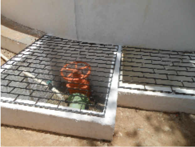
Foto 51 - Caixa de registro do RAP-01.
