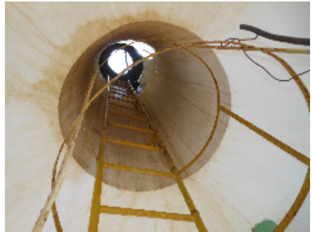
Foto 54 - Reservatório: Ausência de tampa.
