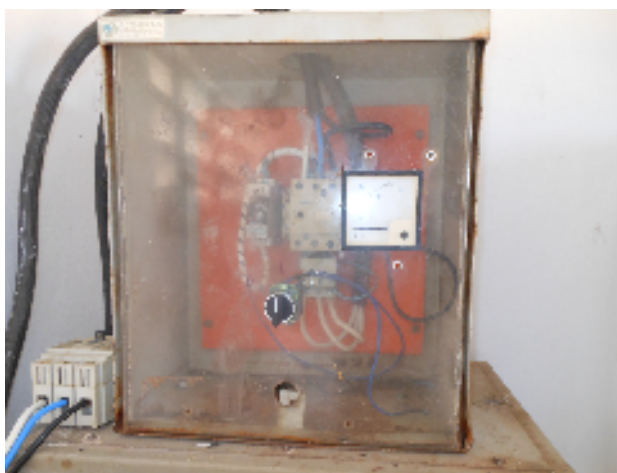
Foto 4 - Quadro de energia da captação sem horímetro.
