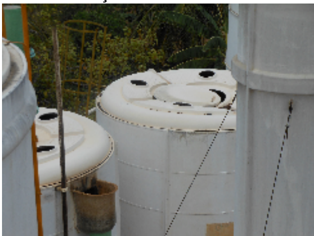
Foto 11 - Filtração: Filtro 04 com tampa danificada.
