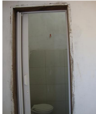
Foto 87 – Instalações sanitárias disponíveis para funcionários e usuários.
