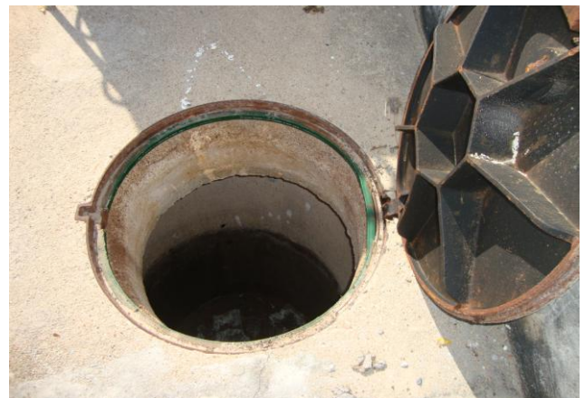
Foto 39 – PV na Rua das Dunas.
