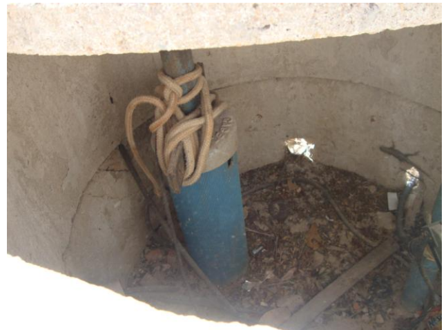
Foto 2 – PT-03: tubulação de recalque.
