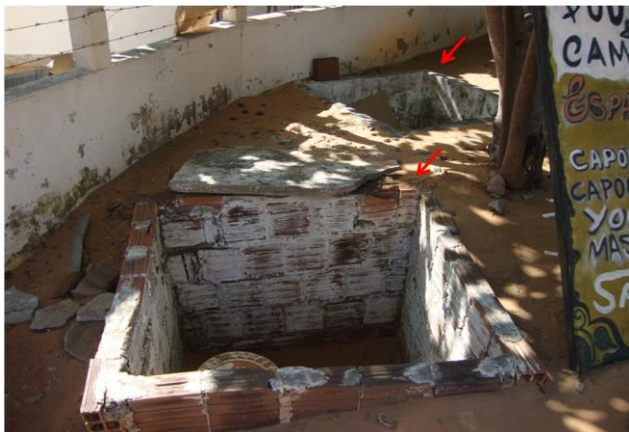
Foto 18 – Caixas de registros sem tampa ou grade de proteção na saída do tratamento.
