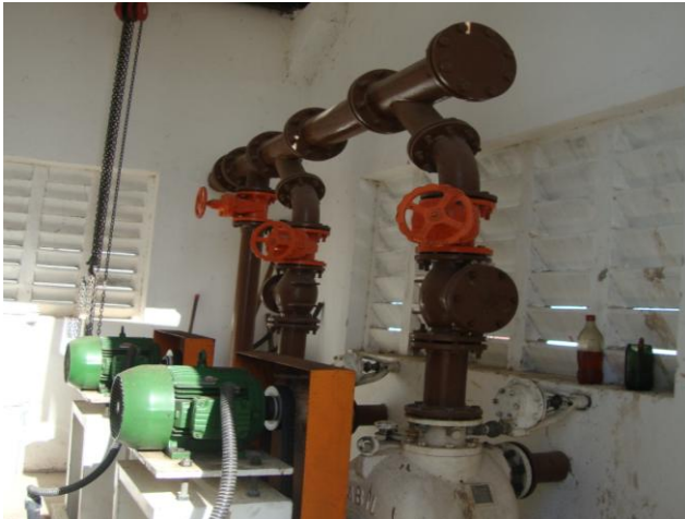
Foto 51 – EEE-02: conjunto moto-bomba.
