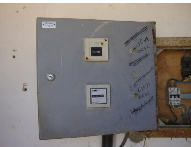
Foto 5 – PT-03 e PT-04: quadro de comando sem amperímetro e voltímetro.
