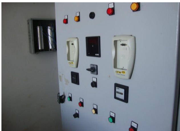
Foto 79 – ETE: quadro de comando dos sopradores.
