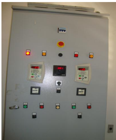
Foto 47 – EEE-01: quadro de comando do conjunto moto-bomba.
