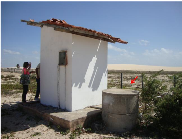
Foto 1 – PT-03: ausência de identificação.
