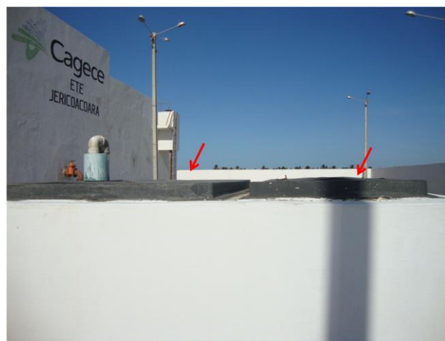
Foto 66 – ETE: poço de entrada com tampas.
