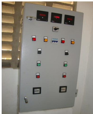
Foto 50 – EEE-01: quadro de comando do gerador de energia.
