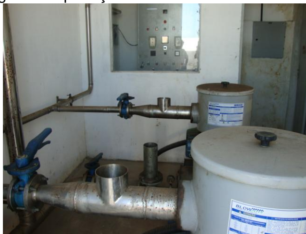
Foto 78 – ETE: sopradores do FSA.
