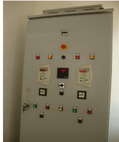
Foto 52 – EEE-02: quadro de comando do conjunto moto-bomba.
