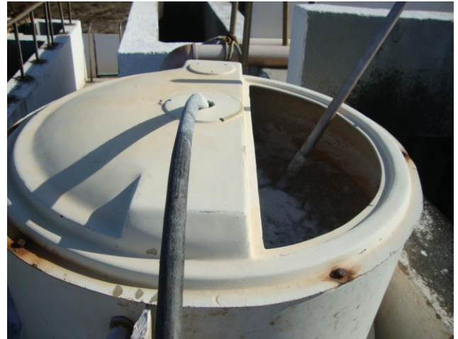
Foto 70 – ETE: solução de cal destinada ao borbulhamento do biogás no DAFA.
