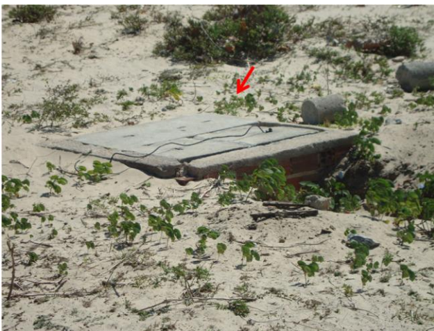
Foto 3 – PT-04: caixa de proteção.
