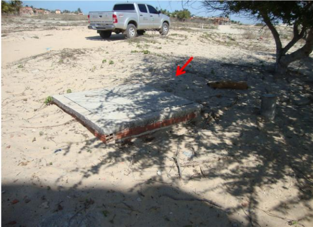
Foto 7 – PT-06: caixa de proteção.
