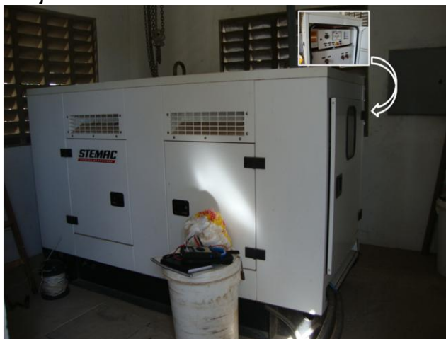
Foto 49 – EEE-01: gerador de energia.
