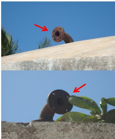
Foto 25 – RAP-01: tubulações de ventilação sem telas de proteção.
