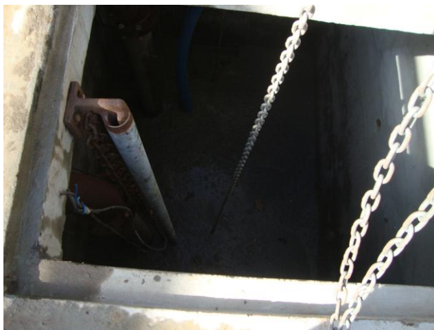
Foto 45 – EEE-01: poço de sucção.
