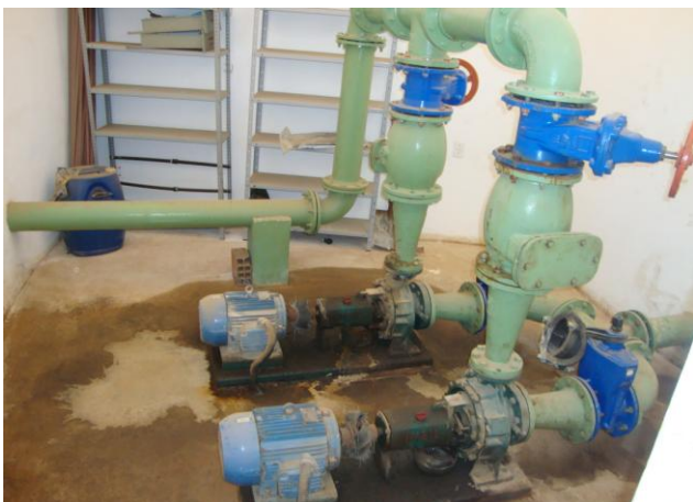
Foto 19 – Conjunto motor-bomba da EEAT-01.
