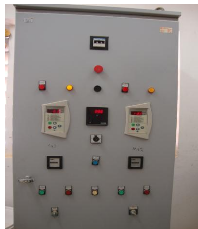
Foto 20 – Quadro de comando da EEAT-01.
