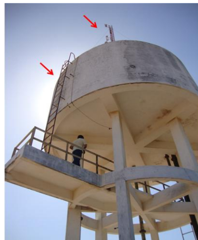
Foto 28 – REL-01: com escada de acesso, para-raios e sinalização noturna.
