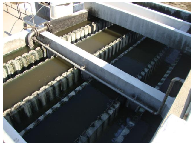
Foto 74 – ETE: vista superior do decantador.
