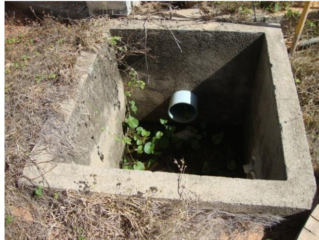
Foto 30 – REL-01: caixa de descarga sem tampa ou grade de proteção.
