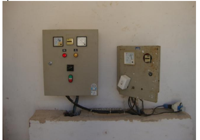
Foto 10 – PT-05 e PT-06: quadro de comando.
