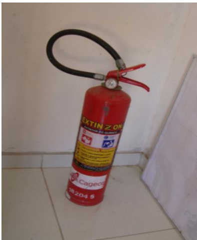
Foto 88 – Extintor de incêndio da loja de atendimento com validade até jul/2014.
