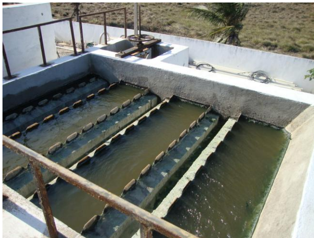
Foto 75 – ETE: vista do decantador.
