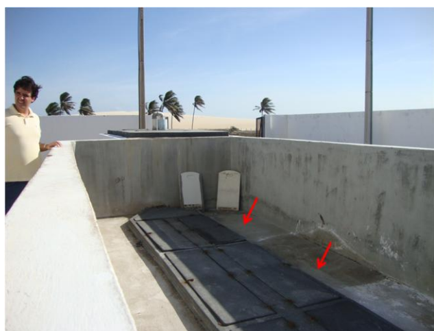
Foto 67 – ETE: caixa de areia com tampas.
