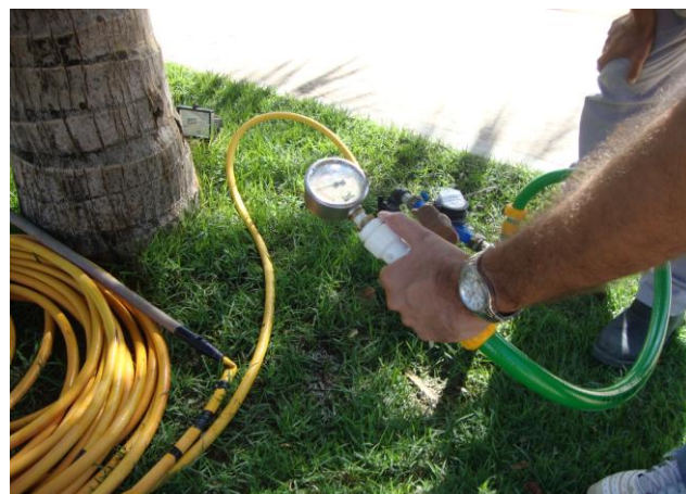
Foto 34 – Medição de pressão na Rua SDO, s/n.
