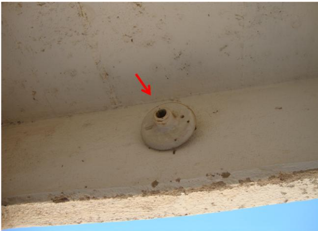
Foto 9 – PT-05 e PT-06: : ausência de iluminação interna na casa de abrigo do quadro de comando.
