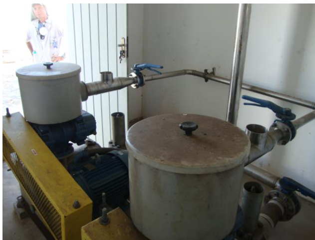
Foto 77 – ETE: sopradores do FSA.
