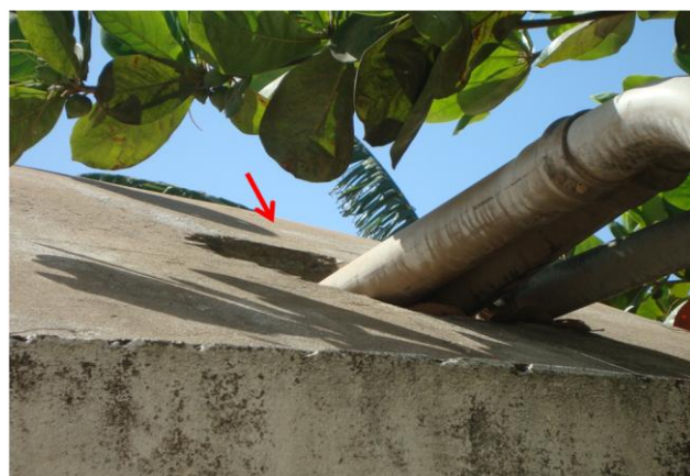
Foto 22 – RAP-01: entrada das tubulações inadequada.
