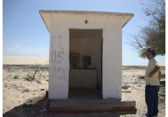
Foto 8 – PT-05 e PT-06: casa de abrigo do quadro de comando.
