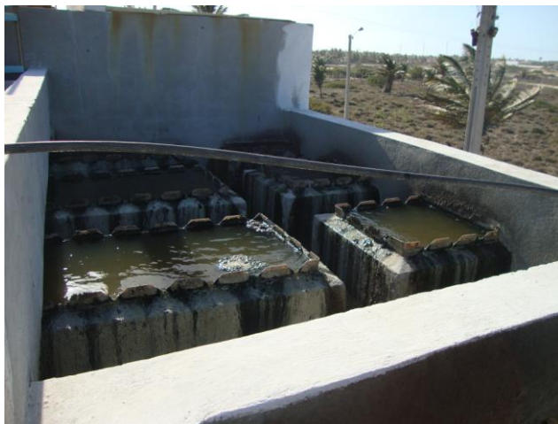
Foto 73 – ETE: vista do FSA.
