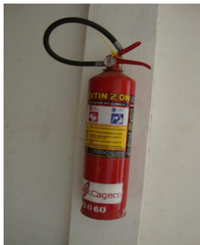
Foto 48 – EEE-01: extintor de incêndio com validade até out/2014.
