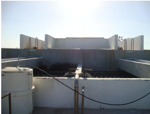
Foto 71 – ETE: vista geral do tratamento.
