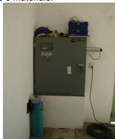
Foto 56 – EEE-02: quadro de comando do gerador de energia.
