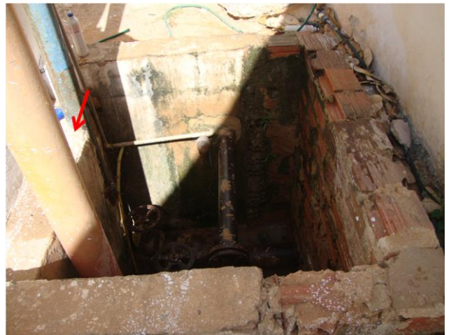
Foto 26 – RAP-01: tubo extravasor.
