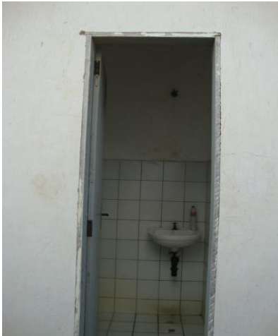
Foto 57 – EEE-02: instalação sanitária para o operador.
