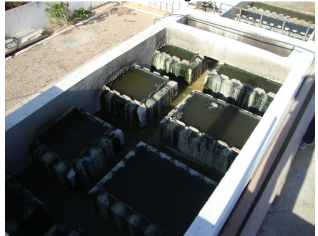
Foto 72 – ETE: vista superior do FSA.
