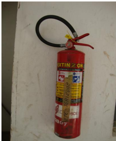
Foto 53 – EEE-02: extintor de incêndio com validade até out/2015.
