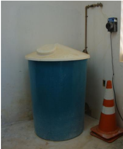
Foto 13 – Tanque de cloração (hipoclorito de cálcio).
