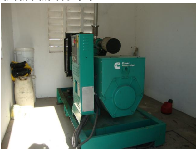
Foto 55 – EEE-02: gerador de energia.
