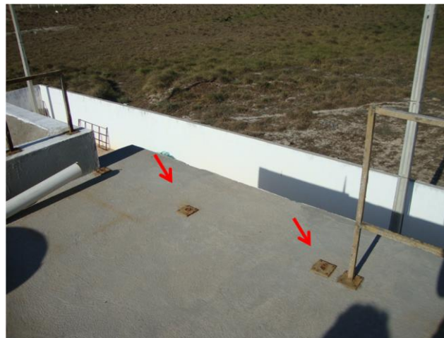
Foto 76 – ETE: decantador sem parte da grade de proteção.
