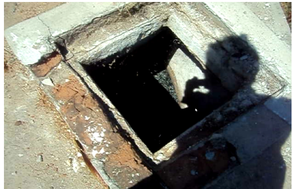
(b) Caixa de inspeção.
