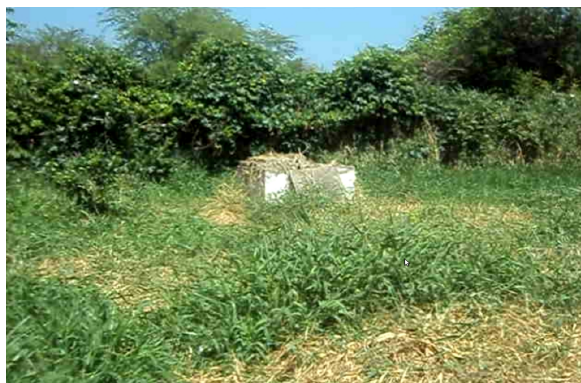
(d) Caixa de cloração.
