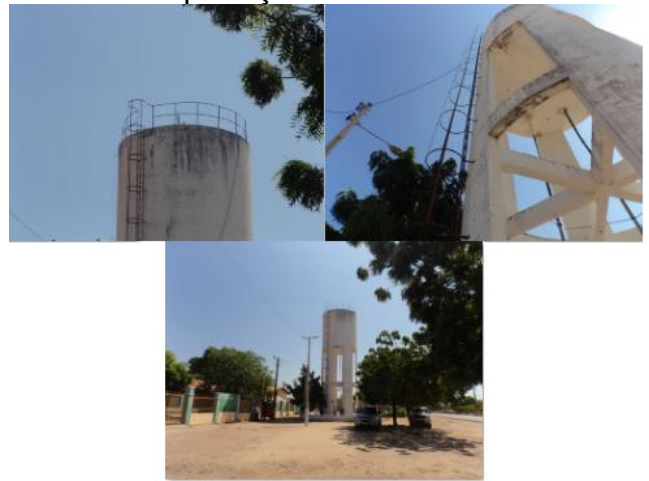
Foto 15 – REL-01: ausência de identificação, pintura deteriorada, escadas e guarda-corpos em processo de corrosão.
