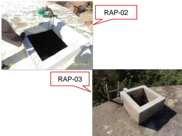
Foto 3 – RAP-02 e RAP-03: ausência de tampas de inspeção.
