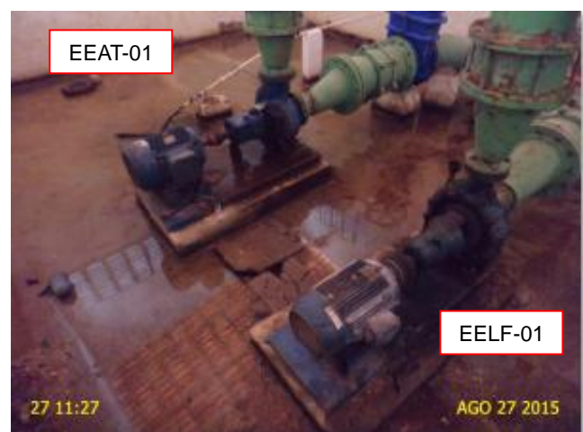
Foto 2 – EEAT-01 e EELF-01: ausência de bomba reserva.
