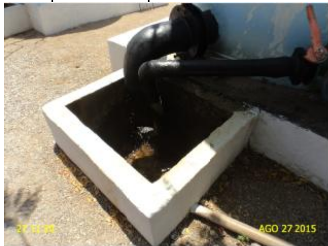
Foto 9 – F-02: registro sem vedação.
