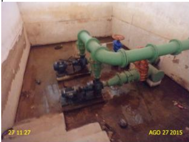
Foto 10 – EEAT-01 e EELF-01: ausência de identificação e acúmulo de água.
