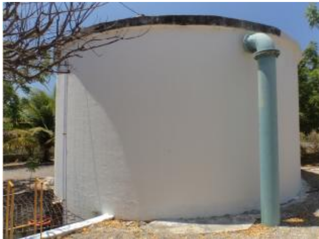
Foto 14 – RAP-01: ausência de identificação.
