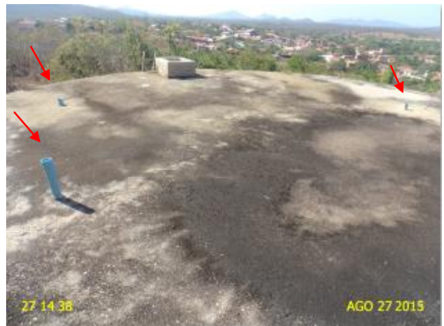
Foto 13 – RAP-03: tubulação de ventilação sem tela de proteção.
