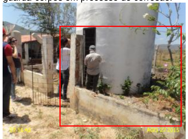
Foto 17 – REL-02: cerca danificada.
