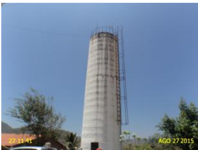
Foto 16 – REL-02: ausência de identificação, pintura deteriorada, escadas e guarda-corpos em processo de corrosão.
