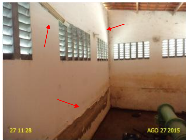
Foto 11 – EEAT-01 e EELF-01: ausência de iluminação e reboco deteriorado.
