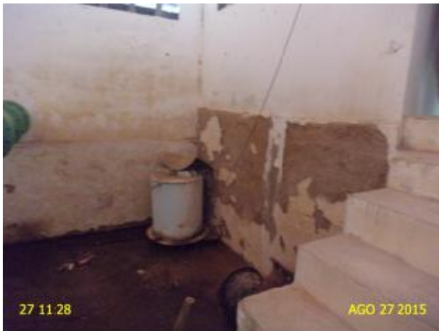
Foto 12 – EEAT-01 e EELF-01: reboco deteriorado.
