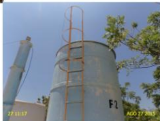
Foto 8 – F-01 e F-02: guarda-corpos em processo de corrosão.
