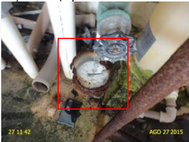
Foto 5 – REL-02: medidor de nível danificado e em processo de corrosão.
