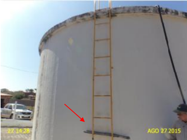
Foto 18 – RAP-02: escada danificada.
