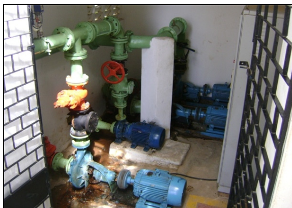
Foto 24 – Elevatórias EEAT-01 e EEAT-02.
