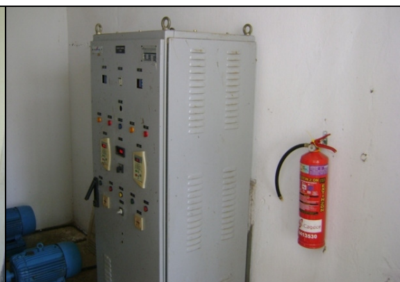
Foto 28 – Quadro de comando e extintor de incêndio da EEAT-01 e EEAT-02.
