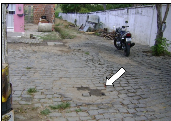
Foto 57 – Ligação clandestina próxima ao registro de descarga na Rua Abílio Gurgel.
