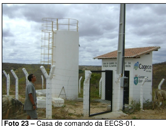
Foto 23 – Casa de comando da EECS-01.
