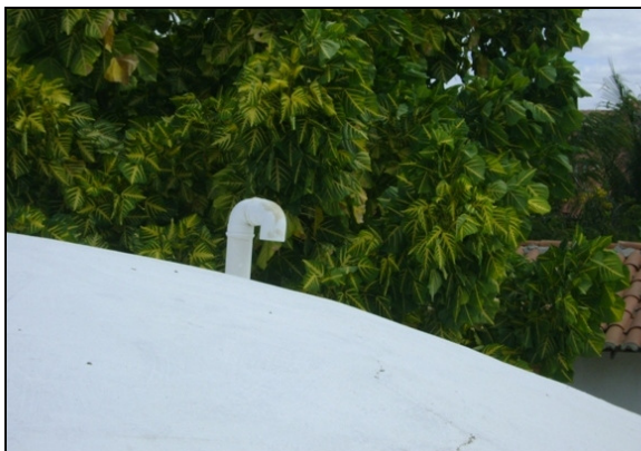
Foto 35 – Ventilação do RAP-01.
