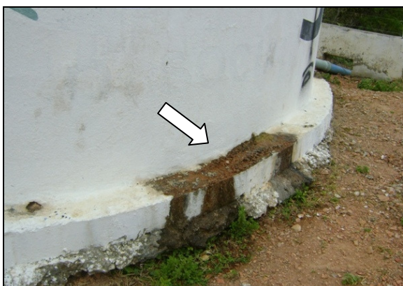
Foto 39 e 40 – Infiltrações na base do RAP-02.
