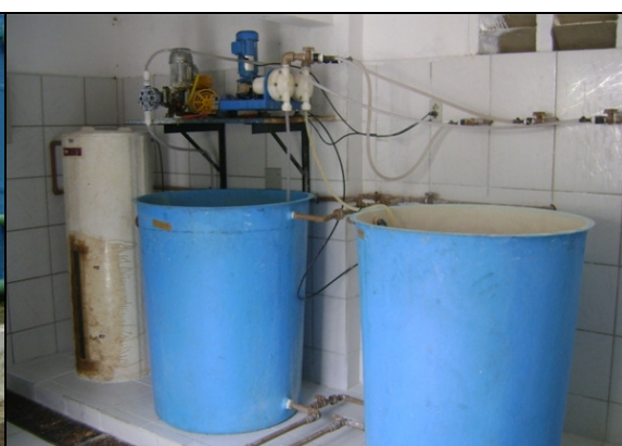
Foto 11 – Dosadores de produtos químicos.
