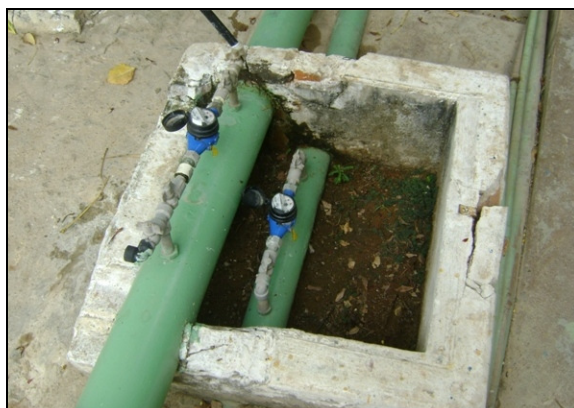
Foto 55 – Medidores proporcionais na saída da ETA.
