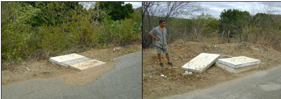
Foto 53 – Ventosa na adutora de água bruta.
