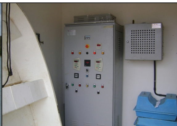
Foto 22 – Quadro da EECS-01.
