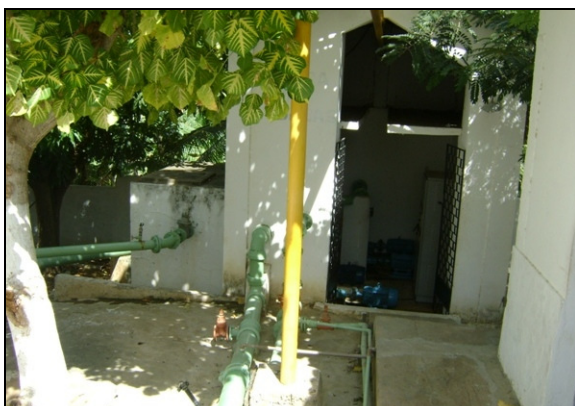
Foto 27 – Casa de comando da EEAT-01 e EEAT-02.
