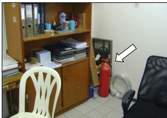
Fotos 66 – Extintor de incêndio do escritório.
