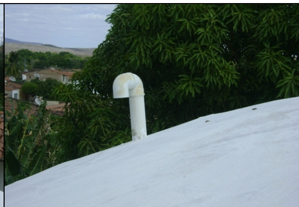
Foto 36 – Ventilação do RAP-01.
