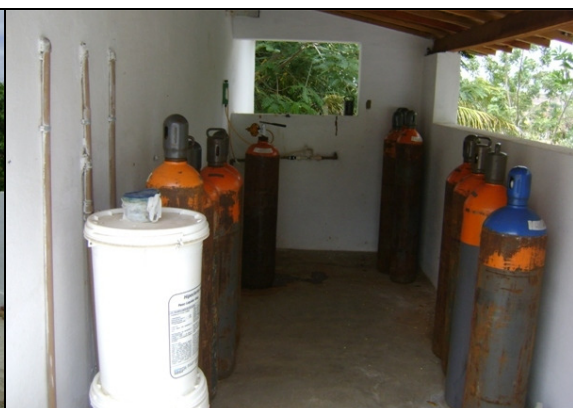
Foto 9 – Local dos cilindros de cloro gasoso.
