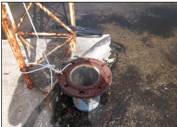
Foto 43 – Tubulação de ventilação do REL-06.
