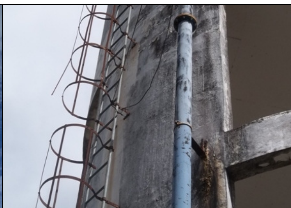
Foto 42 – Gaiola protetora da escada do REL-06, danificada.
