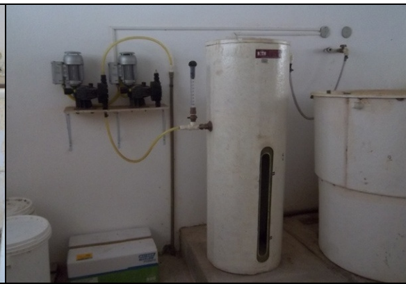
Foto 10 – Dosador de flúor.
