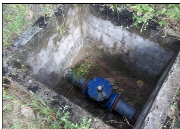
Foto 47 – Caixa do macromedidor de água tratada, localizado na entrada dos REL-04 e REL-06.
