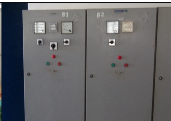
Foto 25 – Quadro de comando da EEAT-01.
