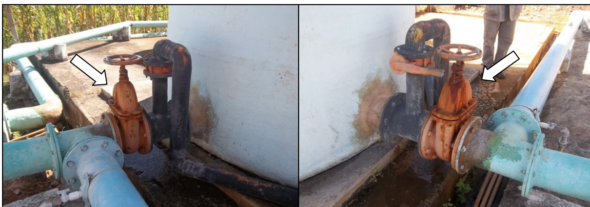
Foto 5 – Registro de descarga do filtro 01, com problema de vedação.
