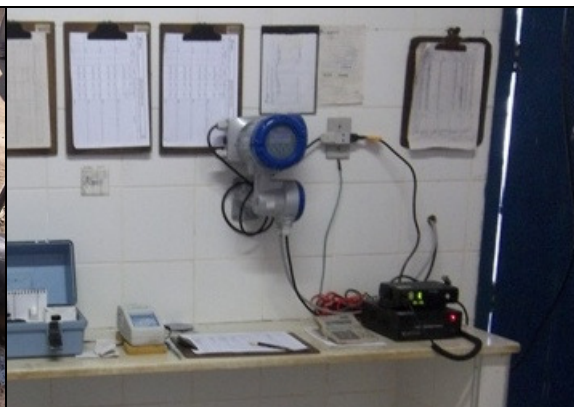
Foto 46 – Contador do macromedidor de água bruta, no laboratório da ETA.
