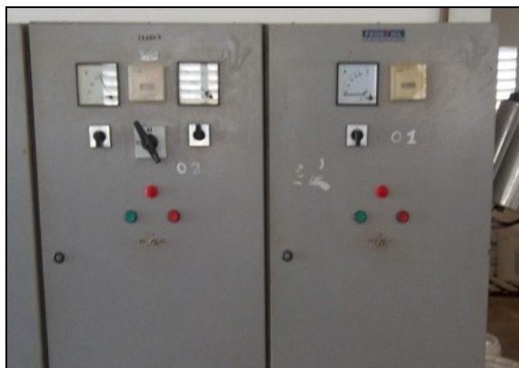
Foto 23 – Quadro de comando da EECS-01.
