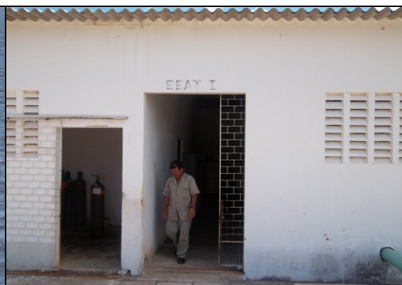
Foto 22 – Prédio de abrigo dos quadros de comando da EECS-01, EEAT-01, EEAT-02 e EEAT-04.
