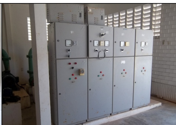
Foto 27 – Quadros de comando da EEAT-02 e EEAT-04.
