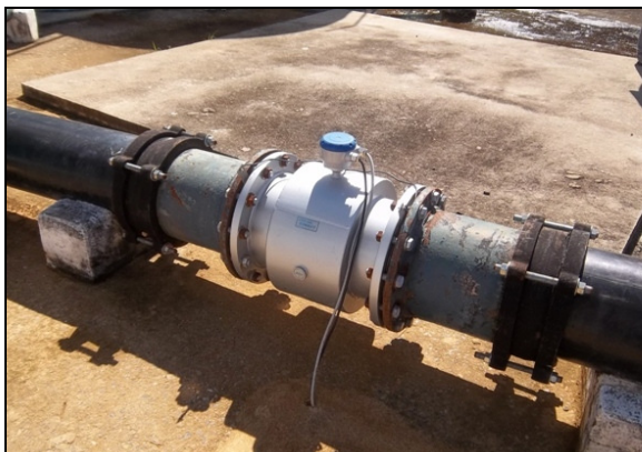
Foto 45 – Macromedidor de água bruta, localizado na entrada da ETA.
