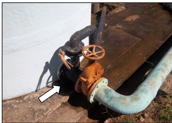
Foto 7 – Tubulação do filtro 02, danificada.
