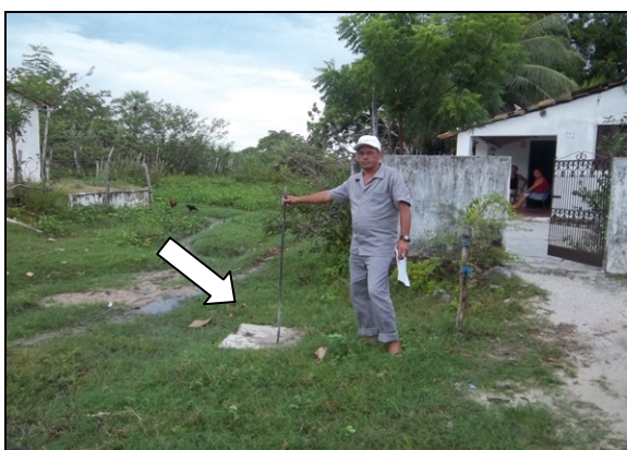
Foto 49 – Registro de descarga, localizado na Rua Vicente Veras, Centro.
