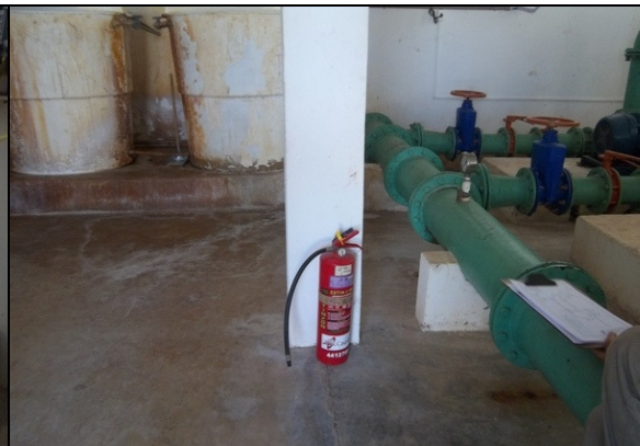
Foto 12 – Extintor de incêndio da casa de química.
