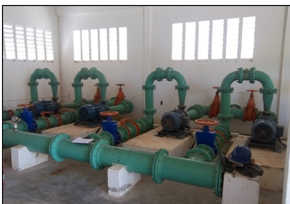
Foto 26 – Elevatórias EEAT-02 e EEAT-04.
