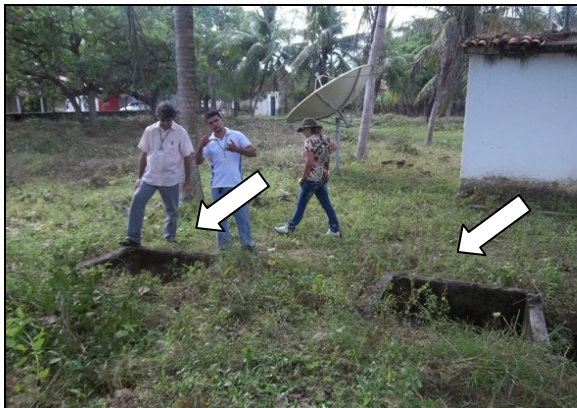
Fotos 36 e 37 – Caixas de inspeção sem tampa de proteção.
