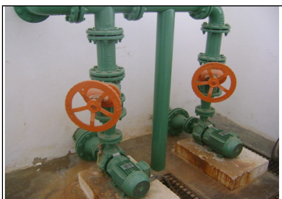
Foto 34 – EEAT-03: Conjunto moto-bomba.
