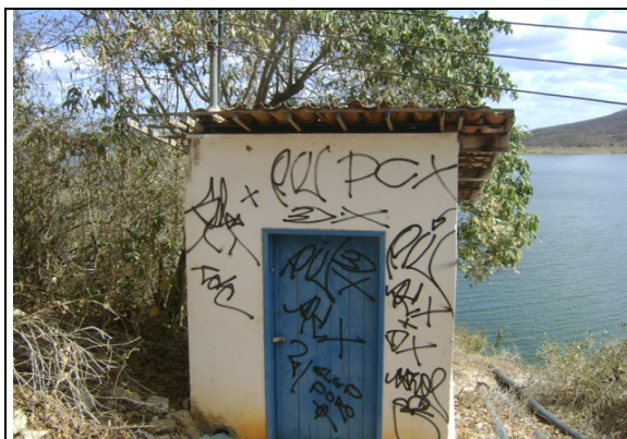
Foto 26 – EECS-01: Sem identificação.
