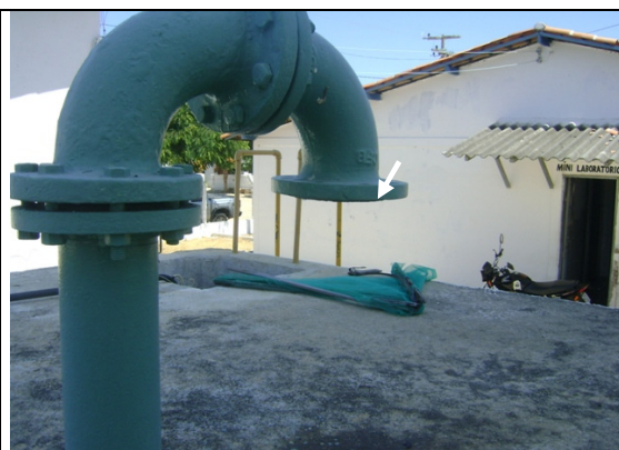
Foto 38 – RAP-01: Ausência de tela de proteção na tubulação de ventilação.
