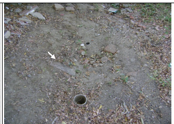
Foto 55 – Registro de descarga sem tampa de proteção, localizado na Trav. Santa Ana.
