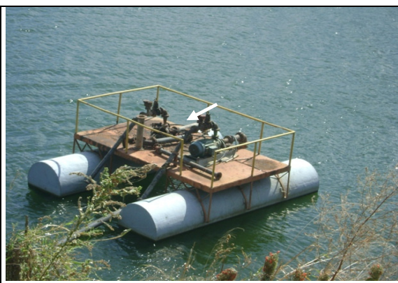
Foto 29 – EECS-01: Ausência de bomba reserva.
