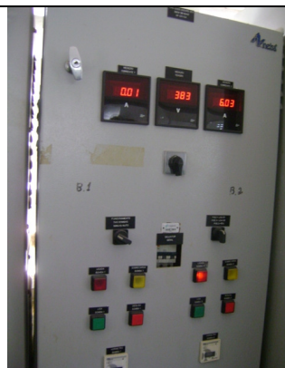
Foto 33 – EEAT-02: Quadro de comando.
