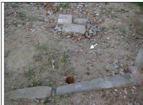
Foto 56 – Registro de descarga sem tampa de proteção, localizado na Trav. Santos Gomes.
