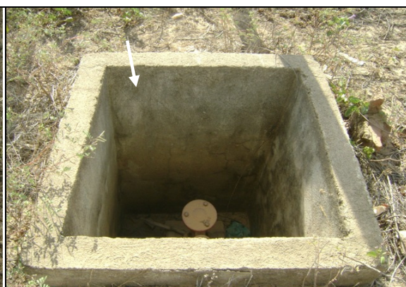
Foto 23 – Adutora de água bruta: Caixa de proteção de ventosa sem tampa.
