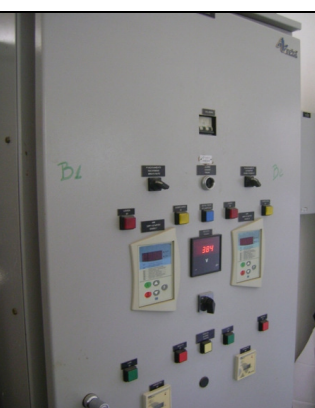
Foto 35 – EEAT-03: Quadro de comando.
