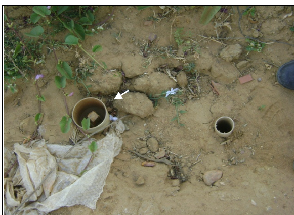
Foto 58 – Registro de descarga sem tampa de proteção, localizado na Rua Prefeito Wilson Sampaio.
