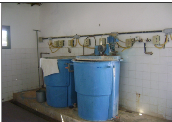
Foto 17 – Tanques de mistura de produtos químicos.
