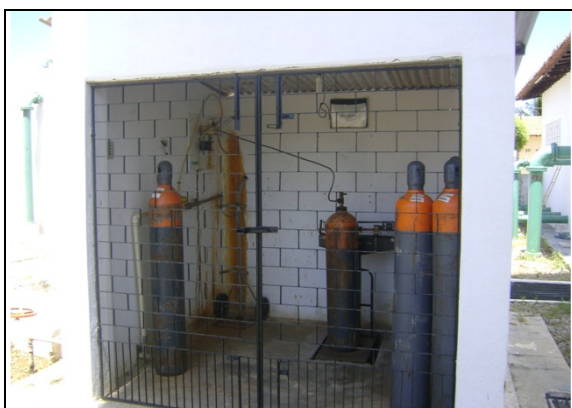
Foto 18 – Cilindros de cloro gasoso.
