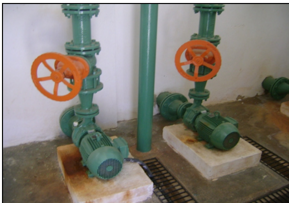
Foto 32 – EEAT-02: Conjunto moto-bomba.
