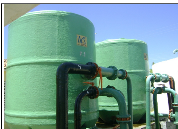
Foto 6 – Filtradores de fluxo ascendente: Existência de identificação.
