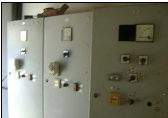
Foto 28 – EECS-01: Quadro de comando.
