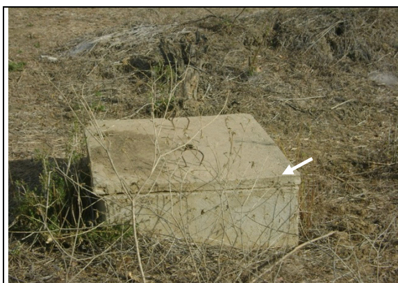
Foto 22 – Adutora de água bruta: Registro de descarga protegido.
