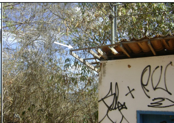
Foto 27 – EECS-01: Casa do quadro de comando, apresentando telhado danificado.
