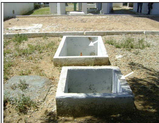
Foto 21 – Adutora de água bruta: caixa de proteção do medidor proporcional e registro, localizado na entrada da ETA, sem tampa.
