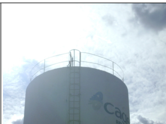
Foto 46 – REL-02: Existência de guarda-corpo na laje superior, pára-raio e sinalizador noturno.
