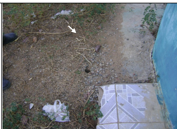
Foto 59 – Registro de descarga localizado na Rua Orleans Farias.
