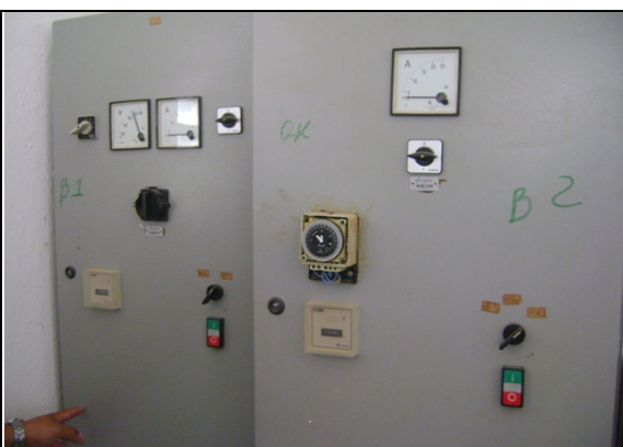
Foto 31 – EEAT-01: Quadro de comando.
