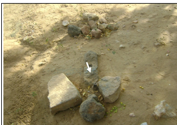
Foto 60 – Registro de descarga sem tampa de proteção, localizado na Rua SDO 17.
