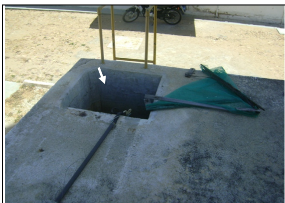
Foto 39 – RAP-01: Ausência de tampa de inspeção.
