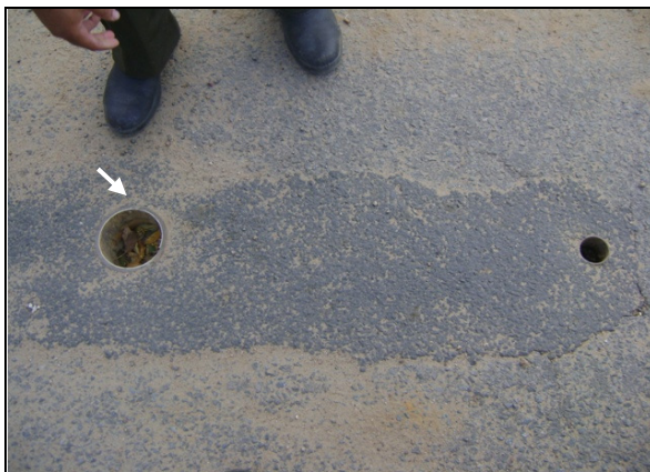
Foto 54 – Registro de descarga sem tampa de proteção, localizado na Rua Gonçalves Soares.
