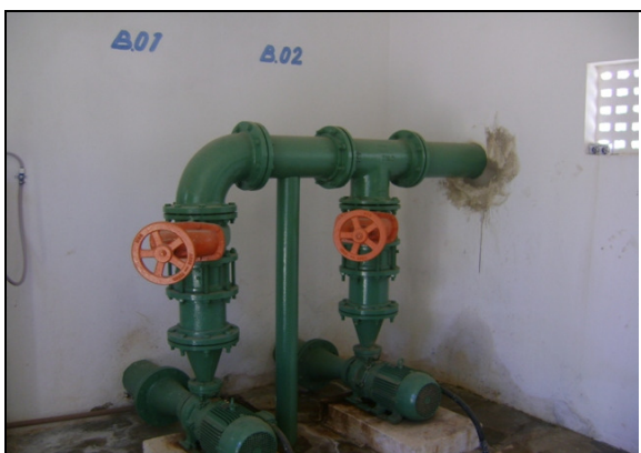
Foto 30 – EEAT-01: Conjunto moto-bomba.
