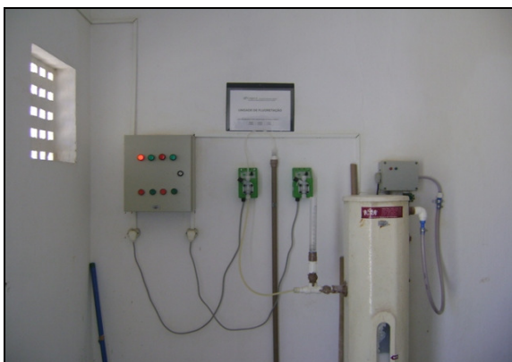
Foto 16 – Dosador de flúor..
