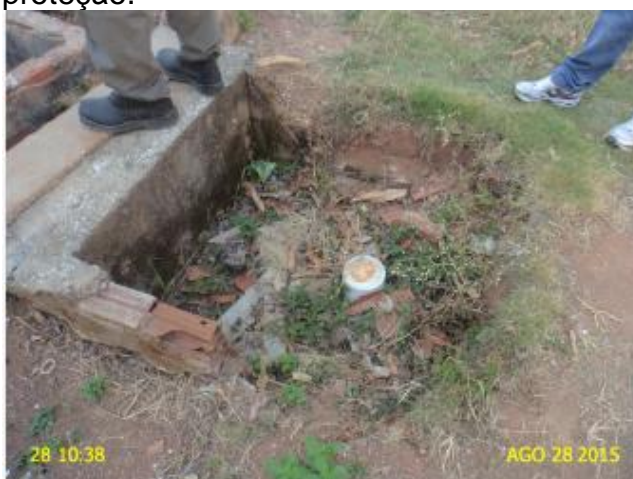
Foto 25 – REL-01: caixa sem tampa ou grade de proteção.
