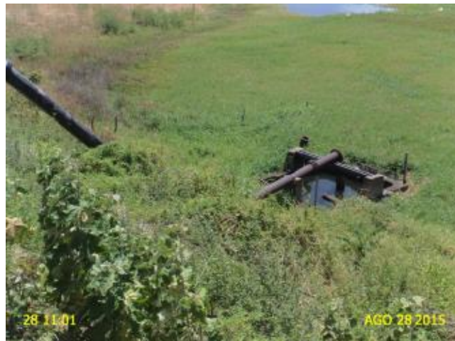
Foto 42 – Captação: ausência de sinalização identificando a área.
