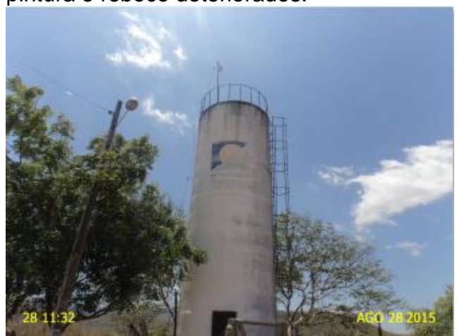
Foto 32 – REL-04: ausência de identificação e pintura deteriorada.
