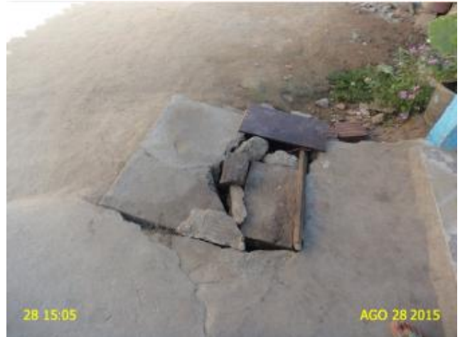
Foto 22 – RDA: registro de descarga com tampa deteriorada na Rua Zeca Lopes
