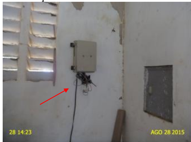
Foto 18 – EERD-02: instalações inadequadas.
