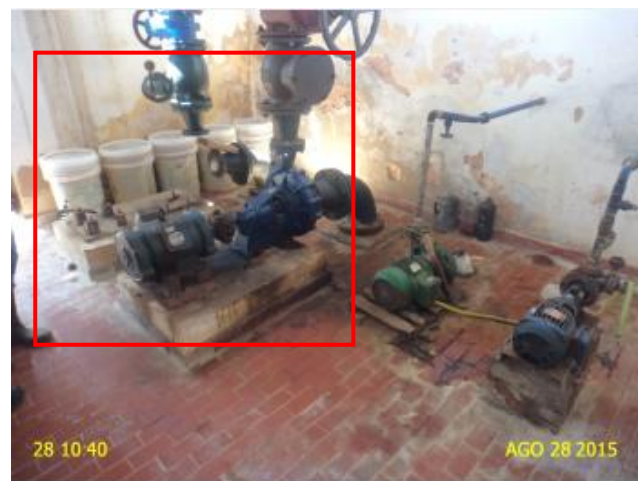
Foto 2 – EEAT-01: ausência de bomba reserva e identificação.
