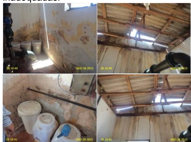
Foto 20 – EEAT-01: pintura, reboco, teto e porta deteriorados.
