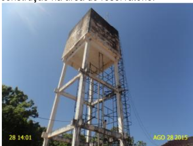
Foto 31 – REL-02: ausência de identificação e pintura deteriorada.
