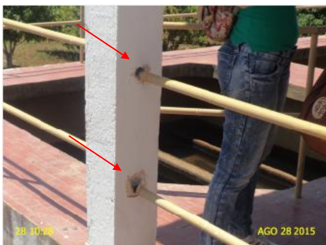
Foto 13 – Filtração: guarda-corpo sem fixação na estrutura.
