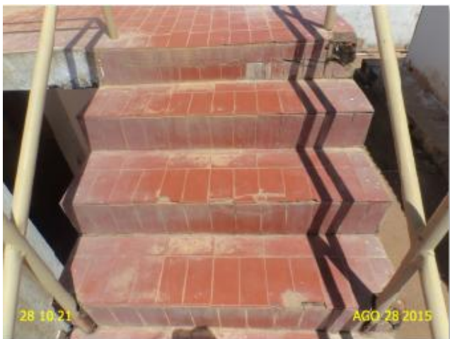
Foto 11 – Filtração: escada de acesso deteriorada.
