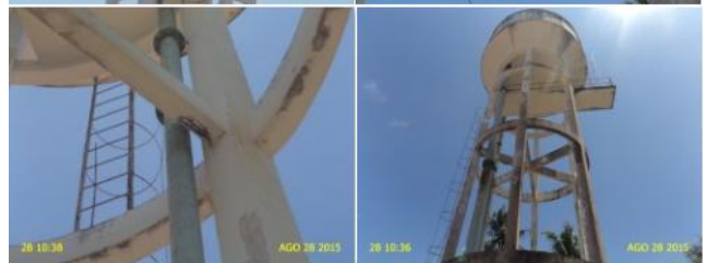
Foto 30 – REL-01: ausência de identificação, pintura e reboco deteriorados.
