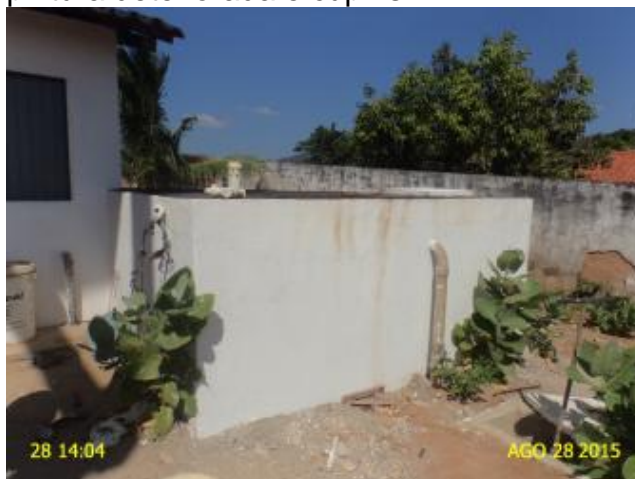
Foto 36 – RSE-01: ausência de identificação.
