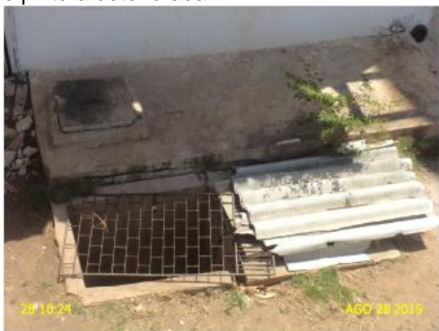
Foto 35 – REN-01: ausência de identificação e pintura.
