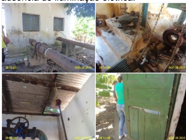
Foto 19 – EEAB-01: pintura, reboco, teto e porta deteriorados.
