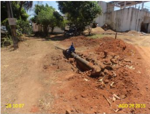
Foto 5 – AAB: registro sem caixa de inspeção.
