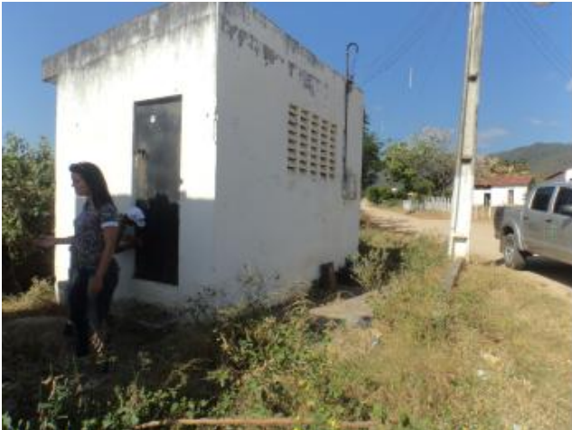
Foto 3 – REN-02 e EERD-02: ausência de identificação, de delimitação e excesso de vegetação.
