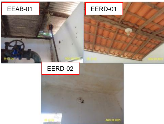
Foto 17 – EEAB-01, EERD-01 e EERD-02: ausência de iluminação elétrica.
