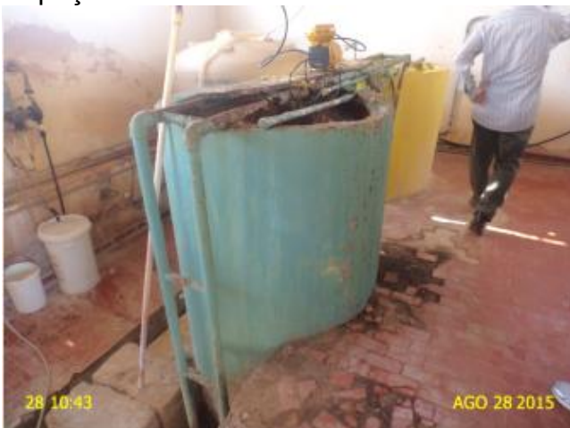
Foto 7 – Casa de química: tanque de dosagem em condições inadequadas e piso deteriorado.
