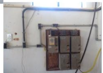
Foto 8 – Casa de química: QC em condições inadequadas e ausência de iluminação.
