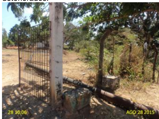
Foto 14 – ETA: cerca deteriorada.
