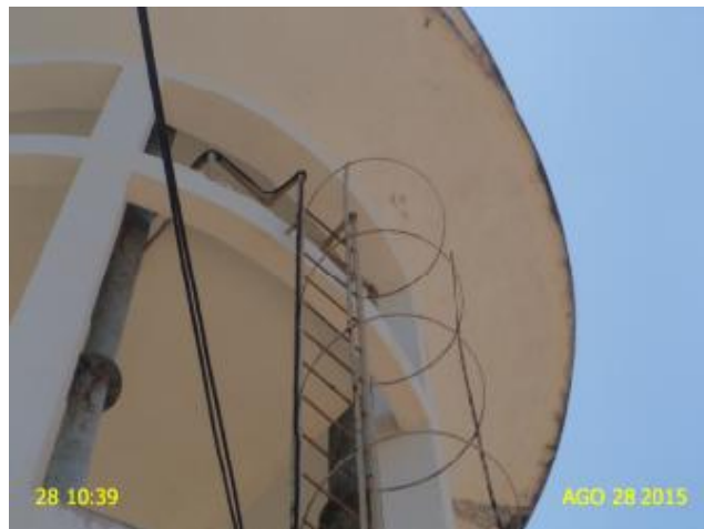
Foto 40 – REL-01: escada em processo de corrosão, guarda-corpo danificado.
