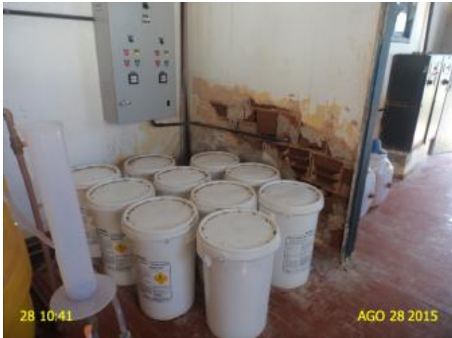
Foto 9 – Casa de química: pintura e reboco deteriorados.
