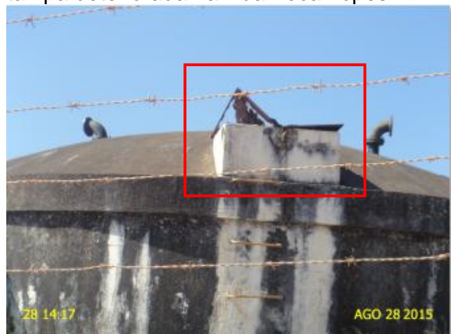
Foto 24 – RAP-01: tampa deteriorada.
