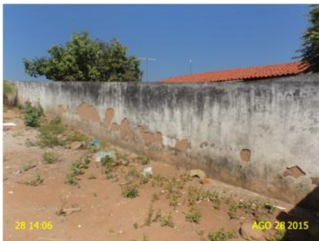
Foto 39 – REL-02, RSE-01, RSE-02 e EEAT-02: muro deteriorado.
