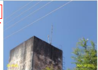
Foto 4 – REL-01 e REL-02: ausência de guarda corpo na laje de cobertura.
