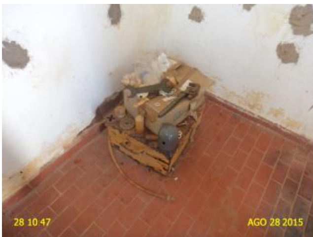
Foto 1 – ETA: KIT de emergência inadequado, armazenado na área do cloro gasoso.
