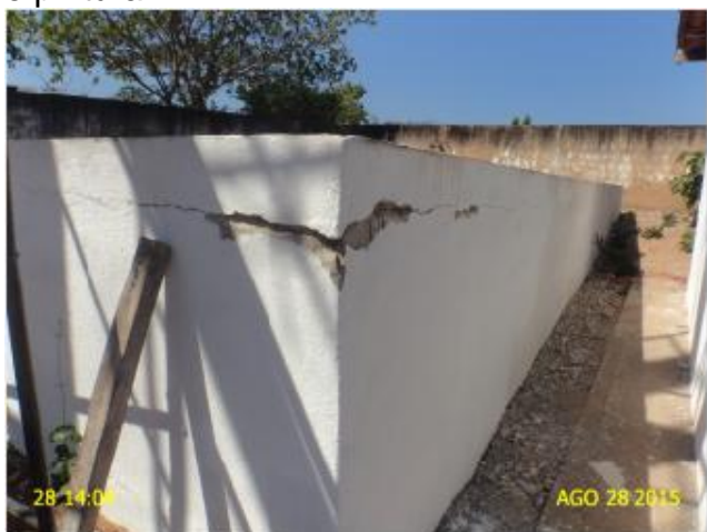
Foto 37 – RSE-02: ausência de identificação e rachadura na estrutura.
