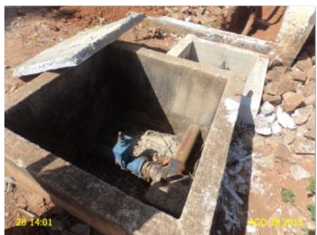
Foto 26 – REL-02: caixa sem tampa ou grade de inspeção.
