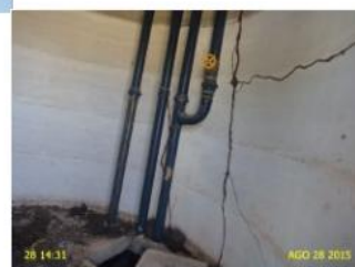
Foto 34 – REL-06: ausência de identificação, pintura deteriorada e cupins.
