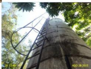
Foto 33 – REL-05: ausência de identificação e pintura deteriorada.
