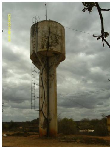
Foto 1 – REL-01: ausência de guarda corpos na escada de acesso.
