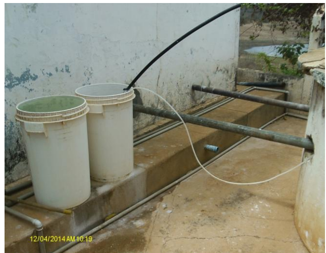
Foto 5 - Dosagem de cloro improvisada.
