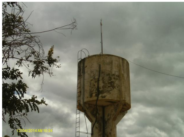
Foto 11 – REL-01: ausência de identificação, pintura deteriorada e sinalizador noturno de obstáculos com defeito.
