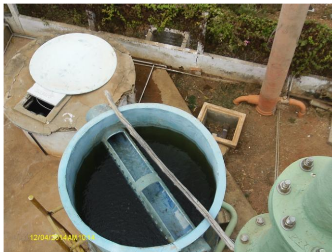
Foto 13 – Filtro F-01 descoberto.
