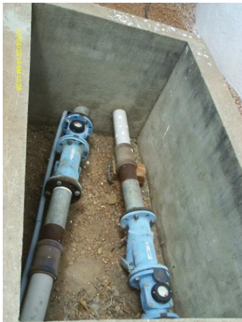
Foto 8 – Caixa do medidor proporcional sem tampa ou grade de proteção.
