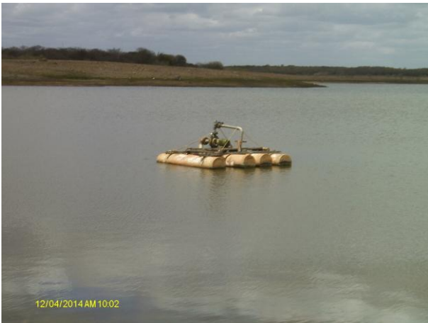
Foto 2 – EEECS-01 sem identificação.
