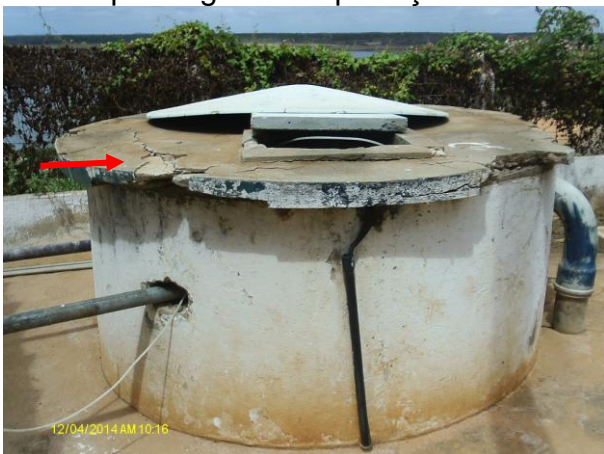
Foto 10 – RSE-01: ausência de identificação, pintura deteriorada, tampa sem vedação, laje danificada, ausência de medidor de nível.
