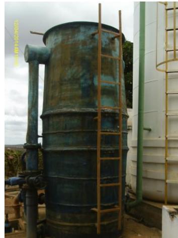
Foto 7 – Filtro F-01 sem identificação e com pintura deteriorada.
