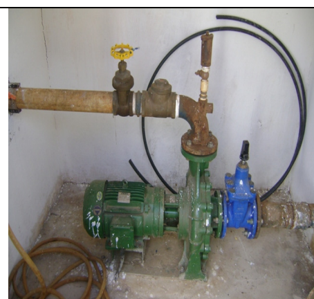
Foto 24 – Booster-01 - conjunto motor-bomba sem reserva.
