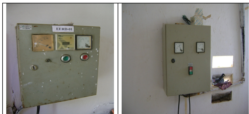
Fotos 29 e 30 – Quadros de comando do Booster-01 e Booster-02
