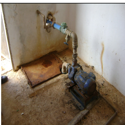
Foto 25 – Booster-02 - conjunto motor-bomba sem reserva.
