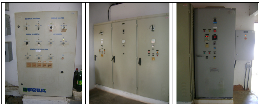
Fotos 26, 27 e 28 – Quadros de comando da EEAT-01, EELF-01 e EECS-01.
