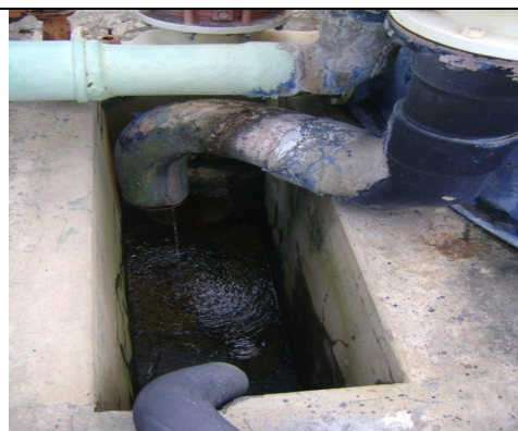
Foto 11 – Vazamento em registro dos filtros.
