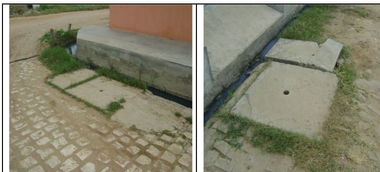
Fotos 46 e 47 – Registros de descarga nas Ruas Carneiro de Mendonça e SDO-27.
