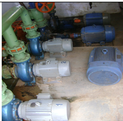
Foto 22 - EELF-01 – conjuntos motores-bomba com vazamentos.
