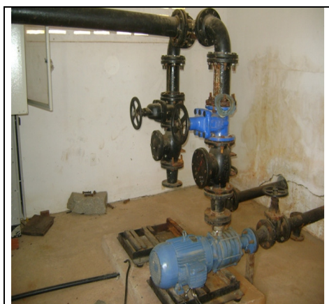
Foto 23 – EE-01 - conjunto motor-bomba sem reserva.
