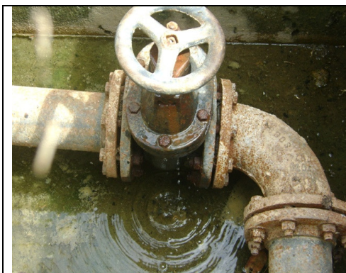
Foto 10 – Vazamento em registro do floco-decantador.
