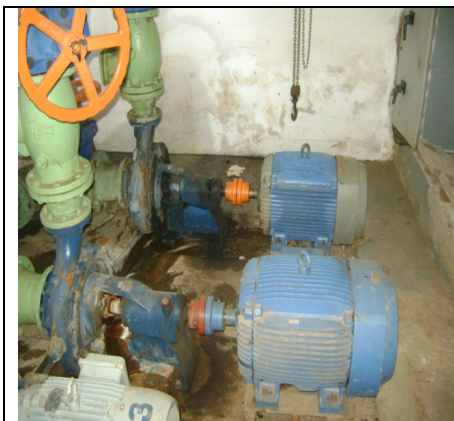
Foto 21 - EEAT-02 – conjuntos motores-bomba com vazamentos.
