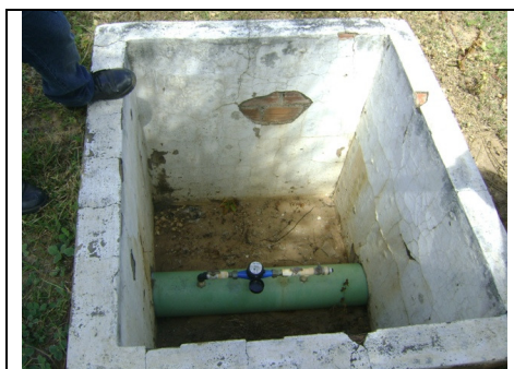
Foto 43 – Macromedidor proporcional na entrada do RAP-01.
