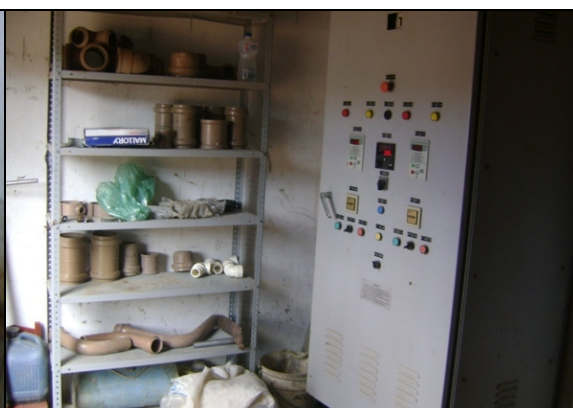
Foto 60 – Quadro de comando da EERD-02.
