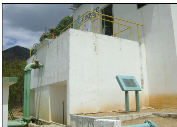
Foto 5 – Vista dos filtros da ETA-01.
