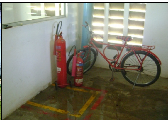
Foto 58 – Extintor de incêndio da EEAT-03.
