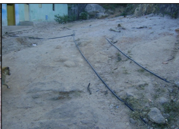
Foto 87 – Ramais prediais expostos, Bairro Ladeira.
