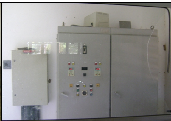
Foto 56 – Quadro de comando da EEAT-03.
