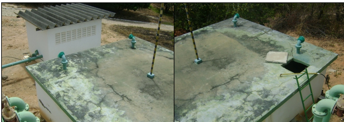
Fotos 69 e 70 – Ventilações do RAP-01.
