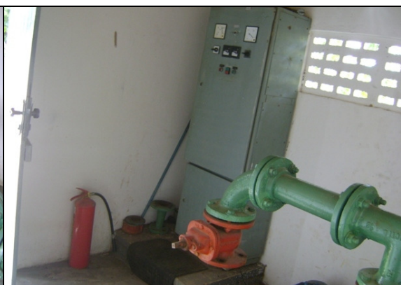
Foto 53 – Quadro de comando e extintor de incêndio da EEAT-02.
