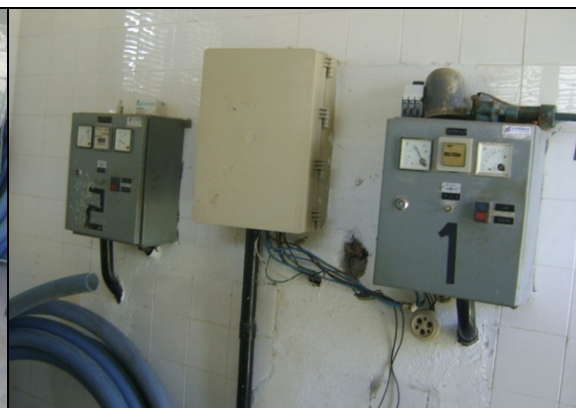
Foto 46 – Quadro de comando da EEAB-01.
