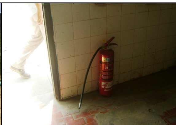
Foto 51 – Extintor de incêndio da EEAT-01.
