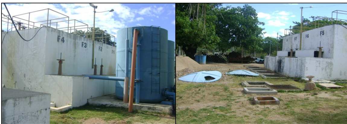
Fotos 23 e 24 – Vistas dos Filtros.
