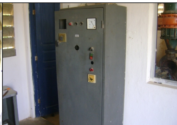
Foto 43 – Quadro de comando da bomba reserva da EEPR-01.
