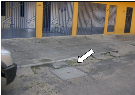
Foto 82 – Registro de descarga na Rua João Araújo Teixeira, Fazendinha.
