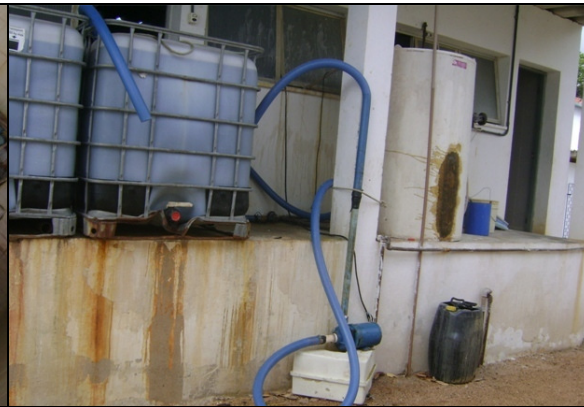
Foto 27 – Dosadores de flúor.
