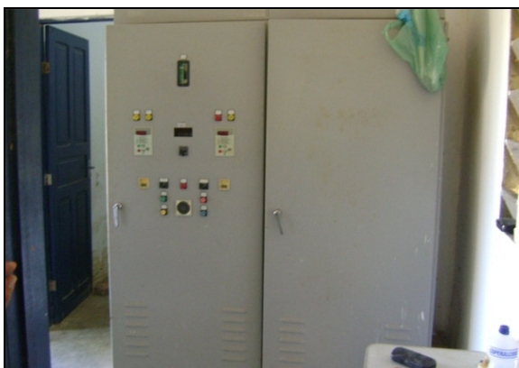
Foto 42 – Quadro de comando da EEPR-01.
