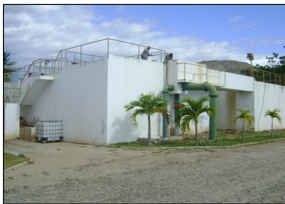
Foto 20 – Vista do Floco-decantador.
