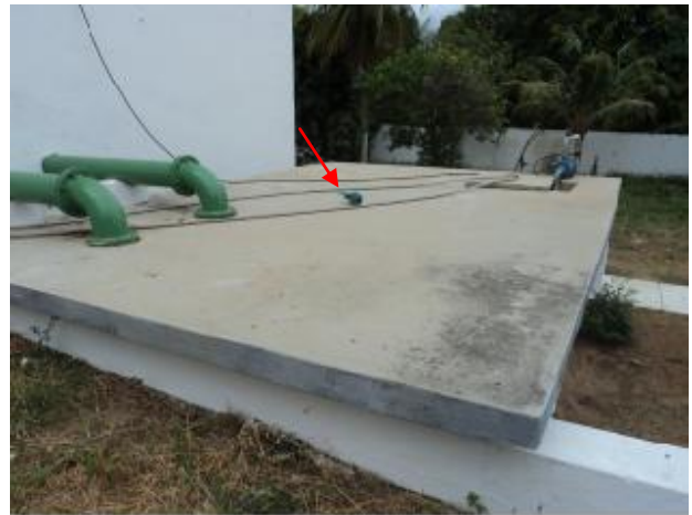
Foto 40 – RSE-01: cobertura do reservatório e tubulação de ventilação.
