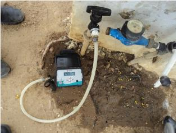
Foto 51 – Rede de distribuição: medição instantânea de pressão na Av. Lindolfo Paula Braga, 636 – Centro.
