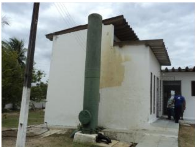
Foto 11 – ETA: torre de nível.
