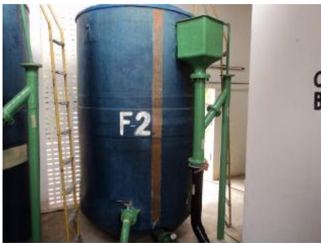
Foto 13 – Filtração: identificação e escada de do filtro F-2.
