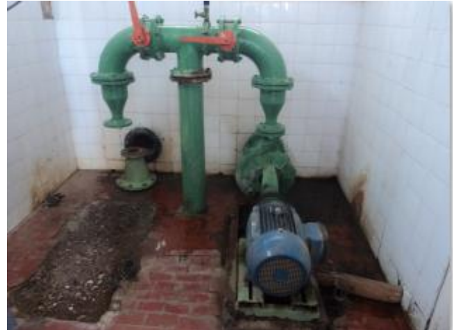
Foto 36 – EEAT-01: conjunto moto-bomba sem reserva.
