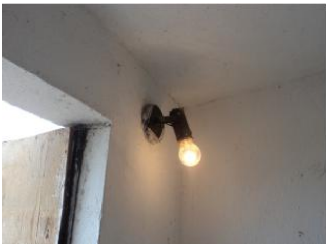
Foto 7 – EECS: iluminação interna na casa de abrigo do quadro de comando.
