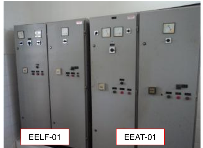
Foto 38 – EELF-01 e EEAT-01: quadro de comando
