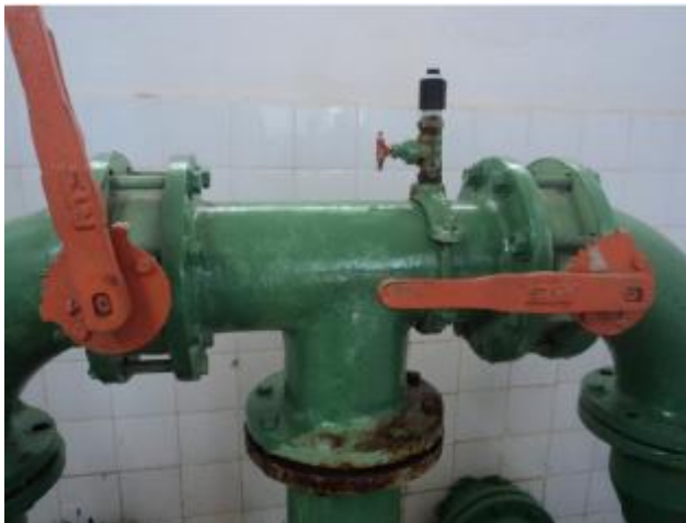
Foto 37 – EEAT-01: vazamento na tubulação.
