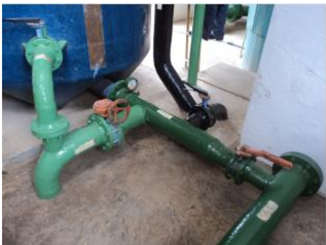
Foto 15 – Filtro F-2: tubulações e registro.
