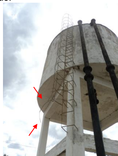
Foto 44 – REL-01: escada com guarda corpo deteriorado.
