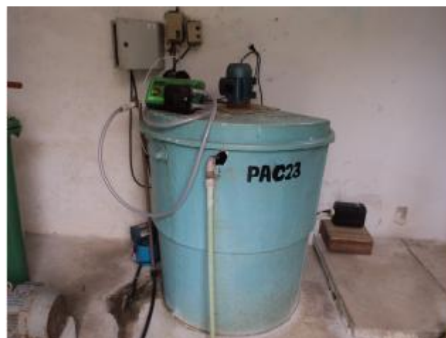
Foto 20 – Casa de química: tanque de PAC.
