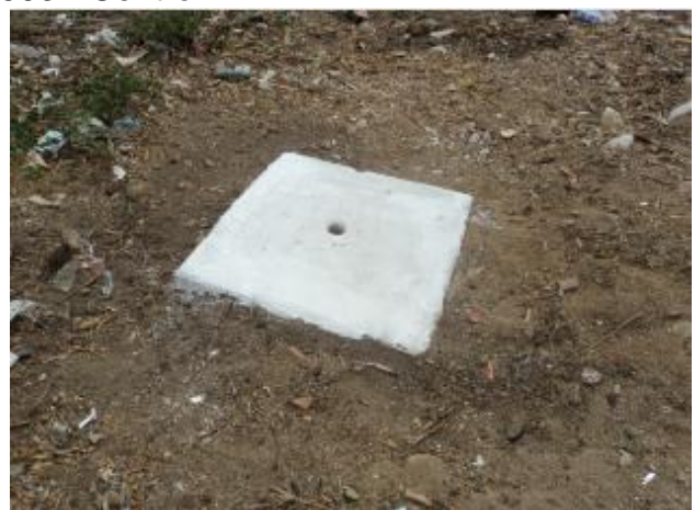
Foto 56 – Rede de distribuição: registro de descarga na Rua José Linhares –Centro.
