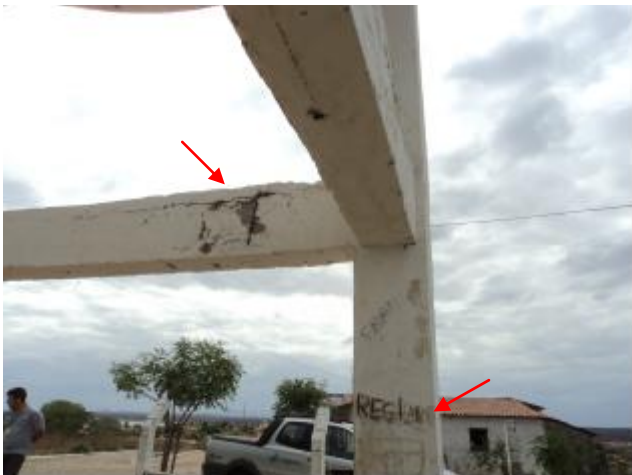
Foto 47 – REL-01: armadura exposta e pintura deteriorada.
