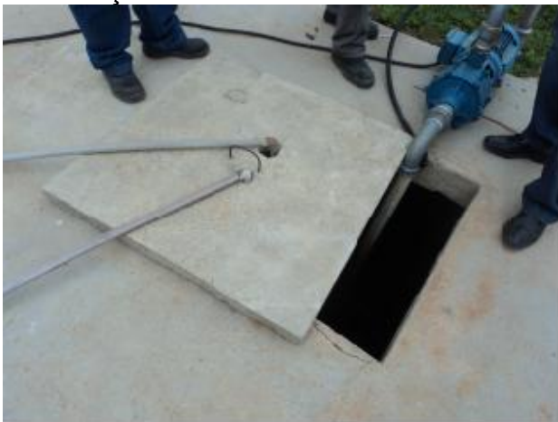
Foto 41 – RSE-01: tampa de inspeção utilizada de forma inadequada e Booster (EERD-01).
