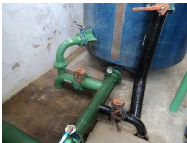
Foto 14 – Filtro F-1: tubulações e registros.
