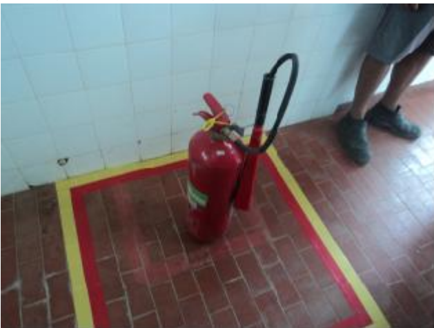
Foto 25 – Casa de química: extintor de incêndio dentro do prazo de validade.
