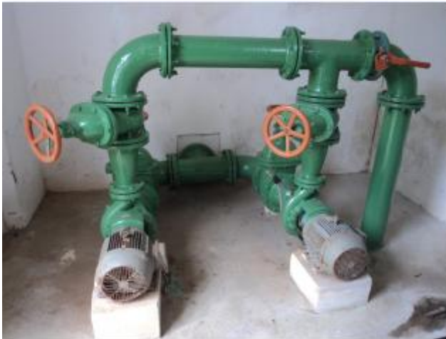
Foto 35 – EELF-01: conjunto moto-bomba.
