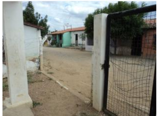
Foto 46 – REL-01: ausência de delimitação e portão danificado.
