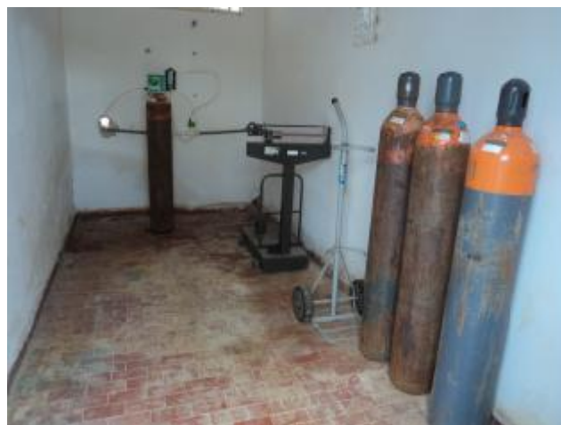
Foto 22 – Casa de química: local de armazenamento do cloro gasoso.
