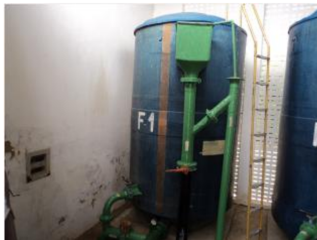
Foto 12 – Filtração: identificação e escada de do filtro F-1.
