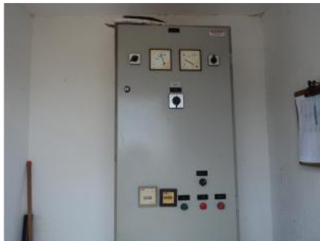
Foto 6 – EECS: quadro de comando.
