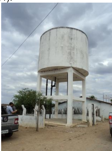
Foto 43 – REL-01: ausência de identificação e delimitação da área.
