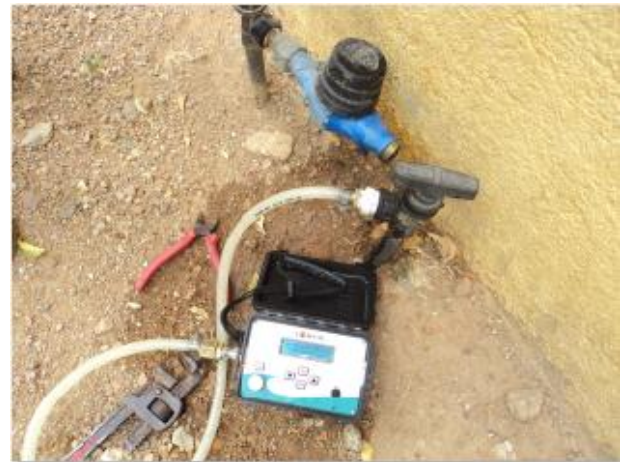
Foto 54 – Rede de distribuição: medição instantânea de pressão na Rua José Alves, 593 - Centro.
