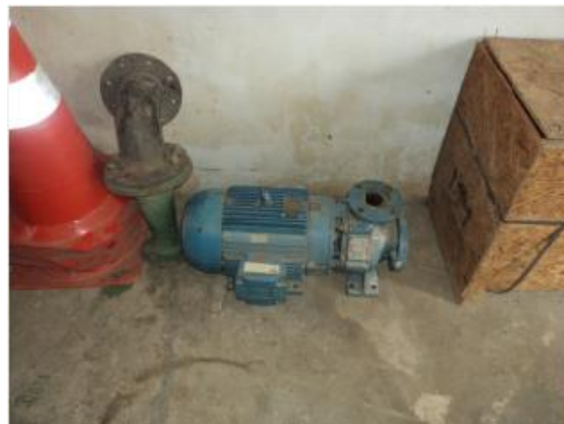
Foto 8 – EECS: bomba reserva.
