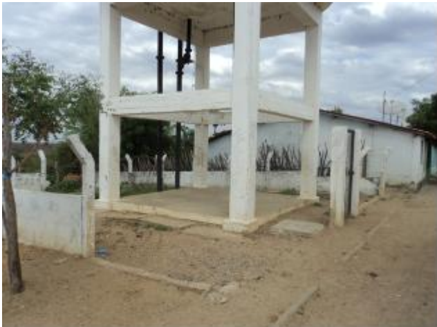
Foto 45 – REL-01: ausência de delimitação.
