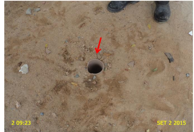
Foto 12 – RDA: ausência de caixa de inspeção no registro de descarga da Rua Luíz Antunes com Rua Rita Martins.
