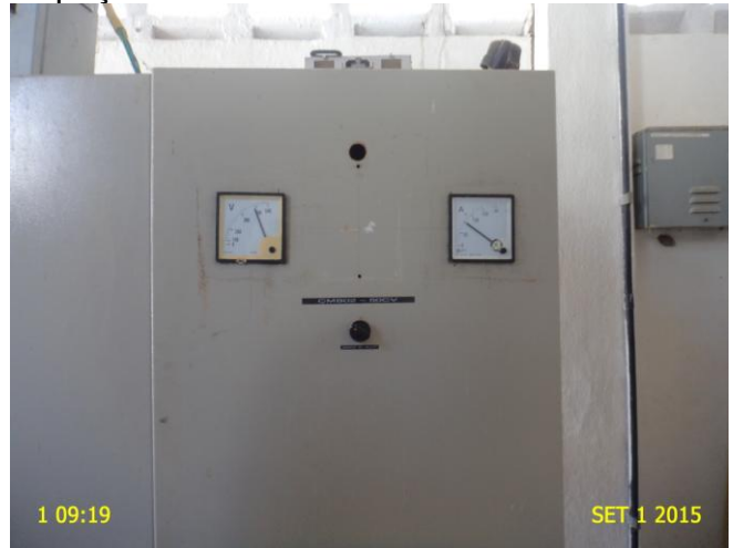
Foto 5 – EECS-01: quadro de comando sem horímetro.
