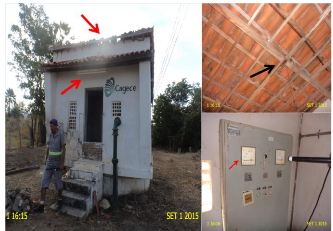
Foto 8 – PA-01: ausência de identificação, casa de abrigo com estrutura e pintura deterioradas, telhado danificado, instalação elétrica inadequada, ausência de iluminação elétrica e voltímetro sem funcionamento.
