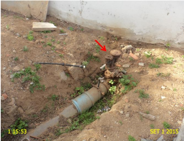
Foto 15 – REL-01: ausência de caixa de inspeção na ventosa.
