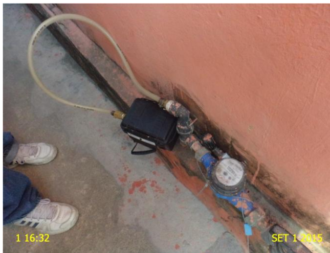
Foto 1 – Aparelho datalogger instalado no endereço localizado na Travessa Santa Luzia, 6 (FNS) – Centro.
