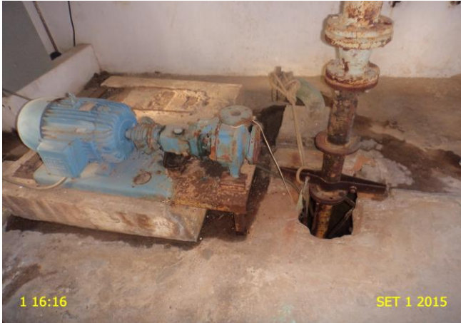
Foto 2 – PA-01: bomba reserva com defeito.
