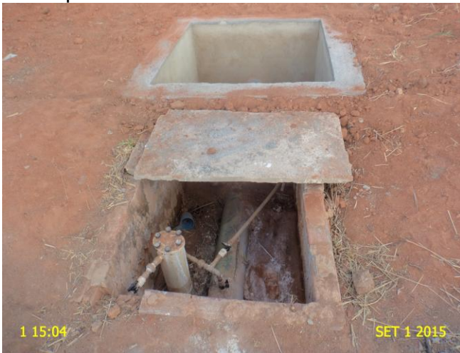
Foto 13 – RAP-02: caixas de inspeção sem tampa ou grade de proteção.
