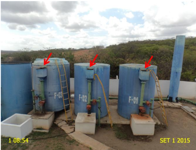
Foto 4 – F-01, F-02 e F-03: ausência de tampa de proteção na calha de saída da água tratada.
