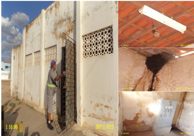
Foto 11 – Booster : sem identificação, pintura e estrutura deterioradas e instalação elétrica inadequada.
