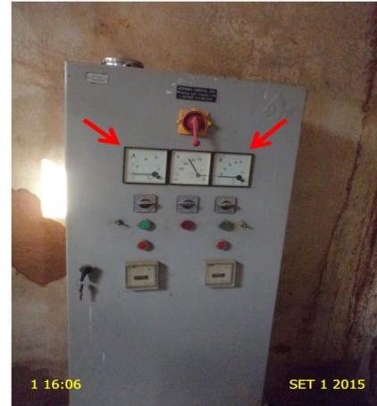
Foto 10 – Booster : amperímetros com defeito.
