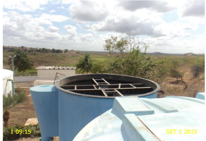
Foto 3 – F-04: ausência de tampa de inspeção.
