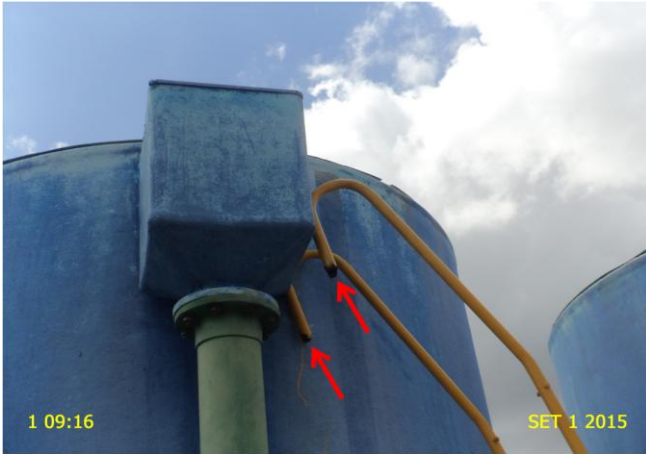
Foto 9 – F-02: escada sem fixação na estrutura.
