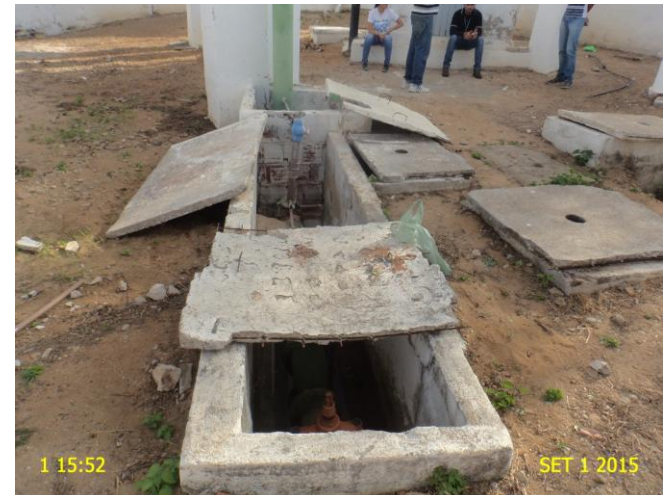
Foto 14 – REL-01: caixas de inspeção sem tampa ou grade de proteção.
