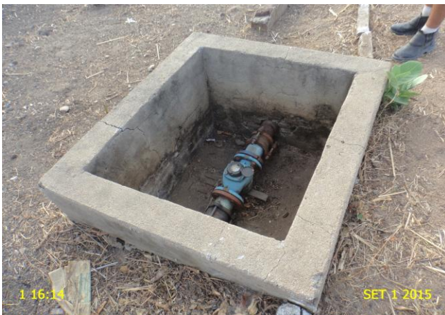
Foto 7 – PA-01: macromedidor de água tratada sem tampa ou grade de inspeção.
