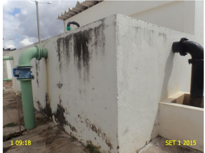
Foto 16 – RAP-01: ausência de identificação e pintura deteriorada.
