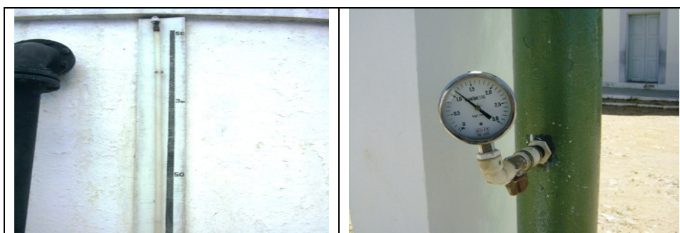
Fotos 30 e 31 – Medidores de nível nos reservatórios RAP-02 e REL-01.
