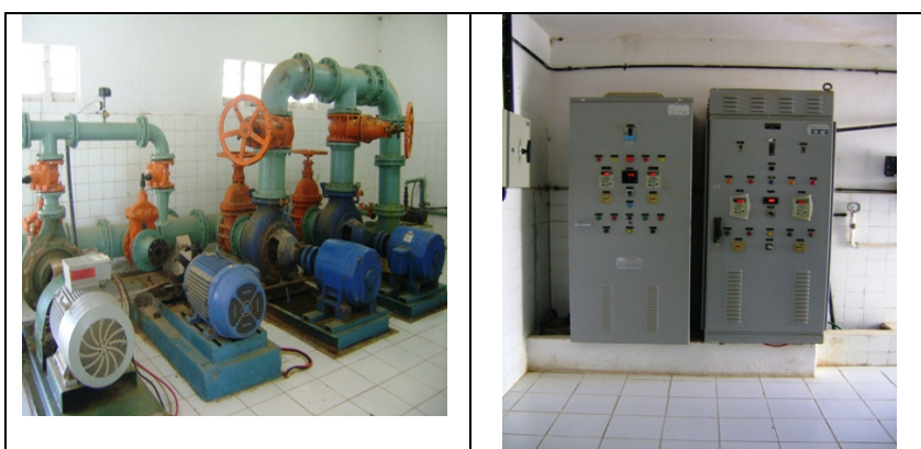
Fotos 19 e 20 – Conjuntos moto-bombas e quadros de comando das elevatórias EEAT-01 e EELF-01
