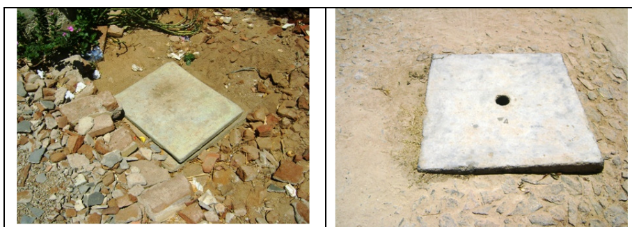
Fotos 42 e 43 – Registros de descarga na Av. Franklin Cavalcante e Campo São Cristovão
