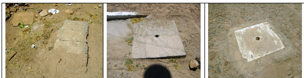
Fotos 39, 40 e 41 – Registros de descarga na COHAB, Campo São Cristovão e Rua Marechal Deodoro
