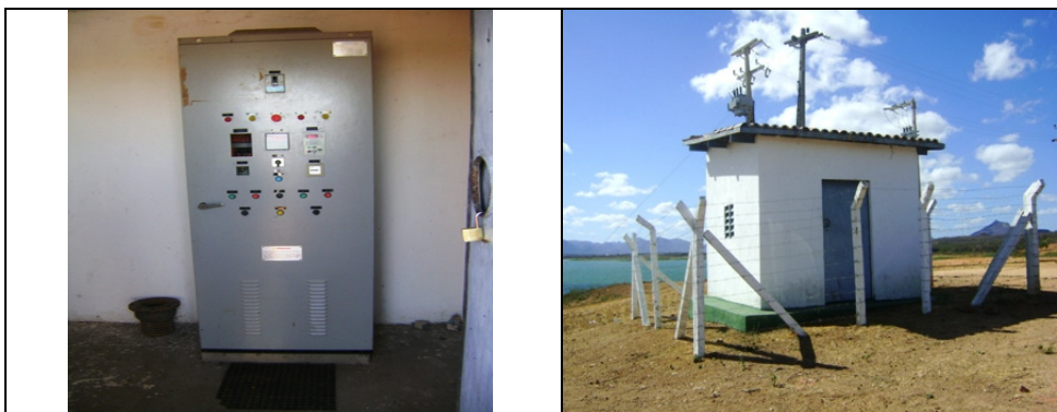
Fotos 17 e 18 – EEAB-01 - quadro de comando e a casa de abrigo
