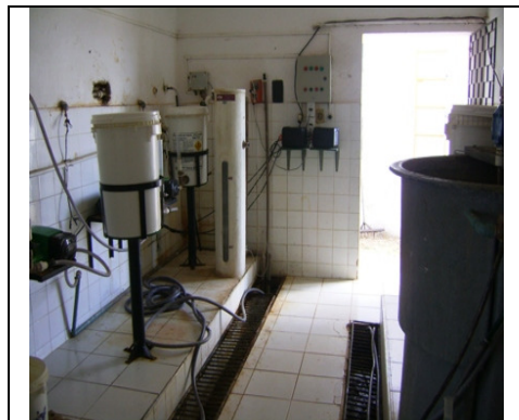
Foto 13 – Tanques dosadores e sistema de fluoretação
