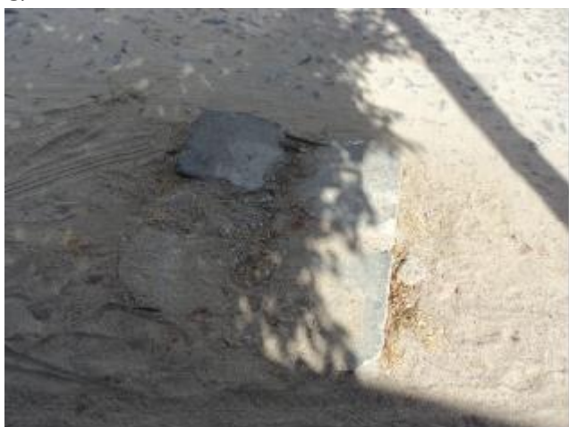
Foto 67 – Rede de distribuição: registro de descarga na Rua 7 de Setembro com tampa danificada.
