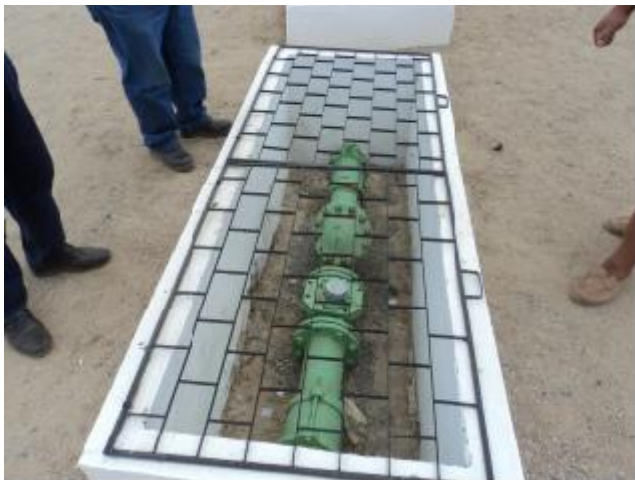
Foto 45 – AAB: macromedidor parado.
