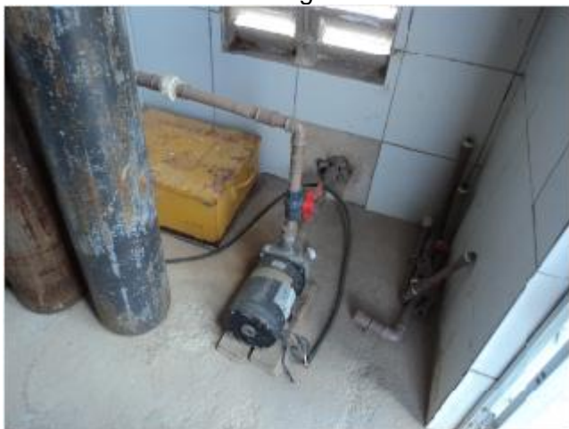
Foto 32 – Casa de química: bomba e kit de emergência dentro da casa de de cloro.
