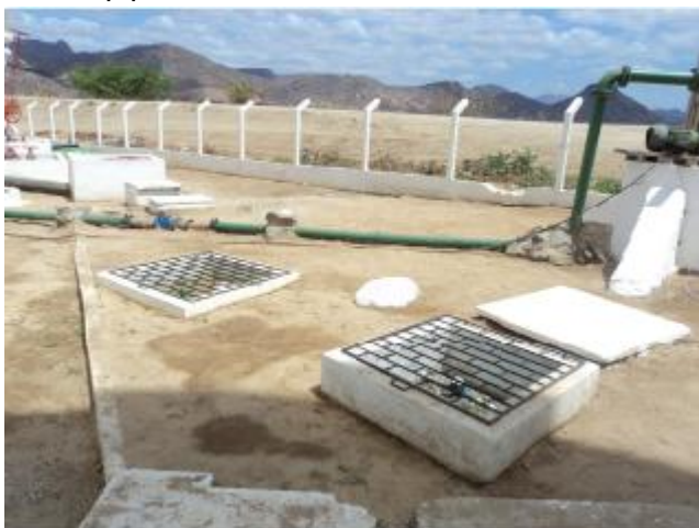
Foto 44 – ETA: caixas de proteção na área da ETA com tampas e grades.
