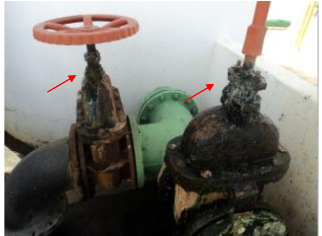
Foto 19 – Filtro 3: registros com vazamento.
