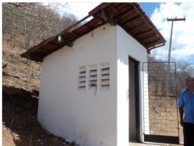
Foto 6 – EECS: casa de abrigo do quadro de comando sem identificação e iluminação.
