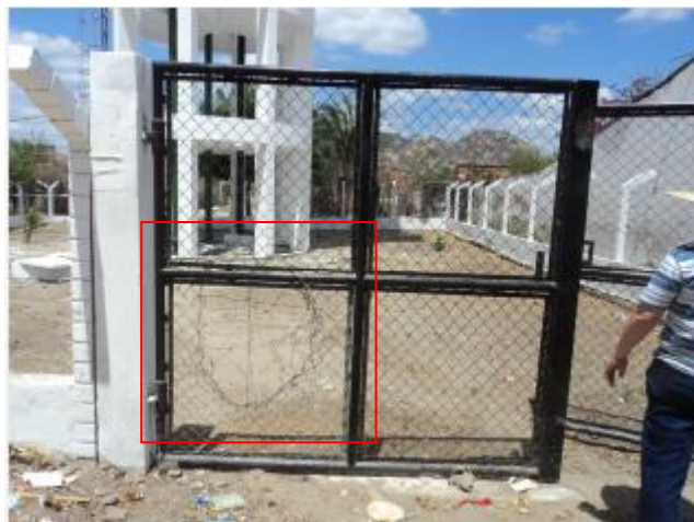
Foto 56 – REL-02: portão danificado.
