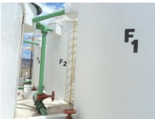
Foto 14 – Filtros 1, 2 (desativado) e 3: identificação.
