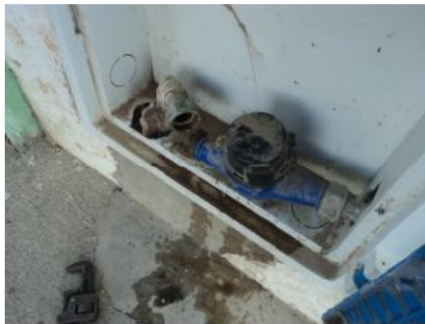
Foto 66 – Rede de distribuição: medição instantânea de pressão na Ra Lucas Batista Mota, 118 – Bairro Esperança.
