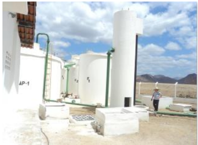
Foto 13 – ETA: vista geral do tratamento.
