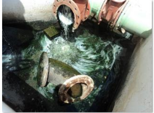
Foto 17 – Filtro 1: caixa de inspeção necessitando de limpeza.
