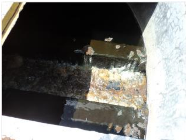
Foto 24 – Filtro 1: presença de materiais na superfície da água.
