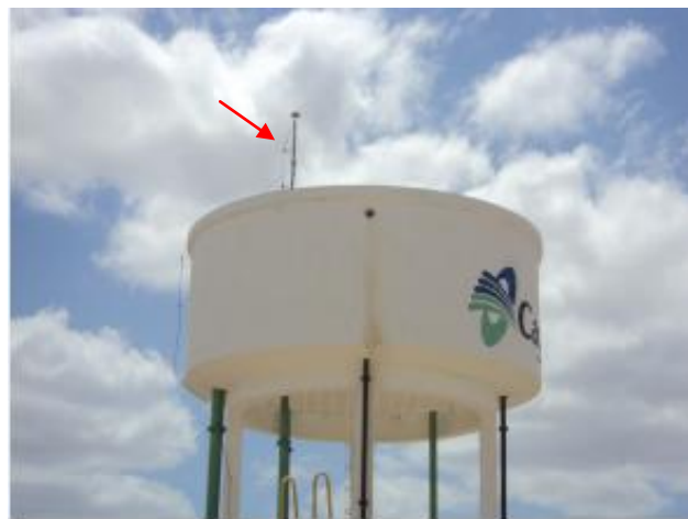
Foto 54 – REL-01: pára-raios e ausência de lâmpada de obstáculo.
