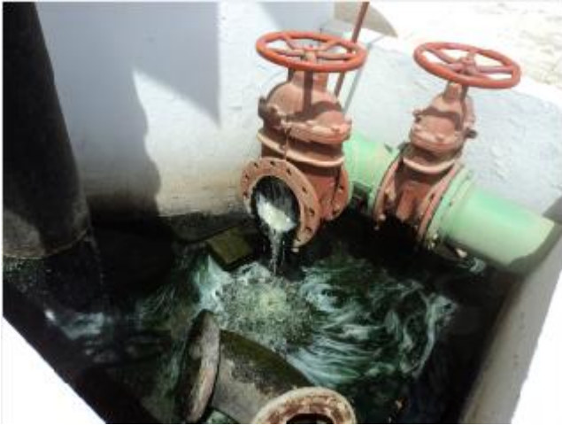
Foto 16 – Filtro 1: registro com vazamento.
