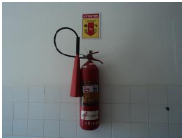
Foto 35 – Casa de química: extintor de incêndio.
