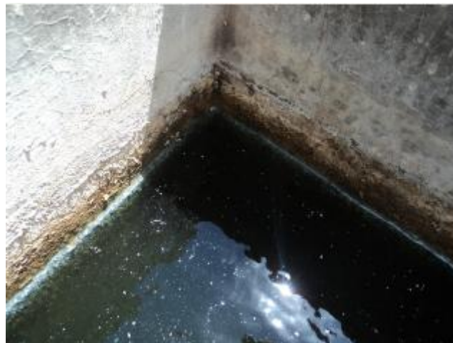
Foto 25 – Filtro 3: presença de materiais na superfície da água.
