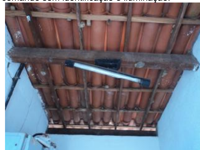
Foto 8 – EECS: lâmpada queimada na casa de abrigo do quadro de comando.
