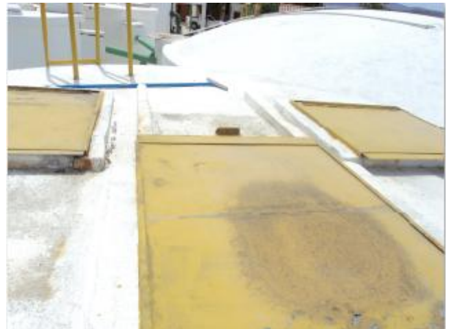
Foto 21 – Filtro 4: vista superior – tampas de inspeção.
