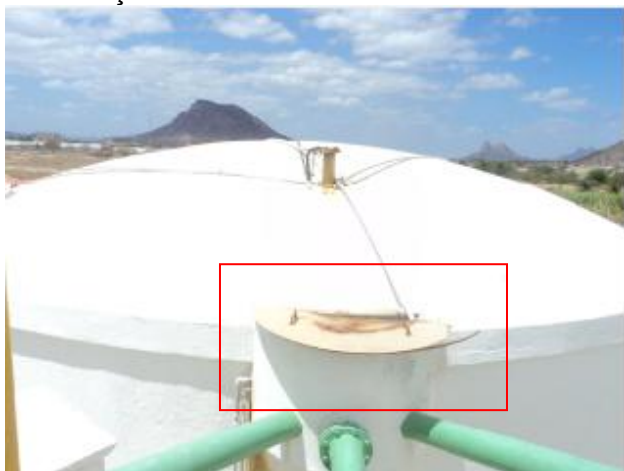
Foto 51 – RAP-01: caixa de chegada da água dos filtros com tampa de inspeção em processo de corrosão.
