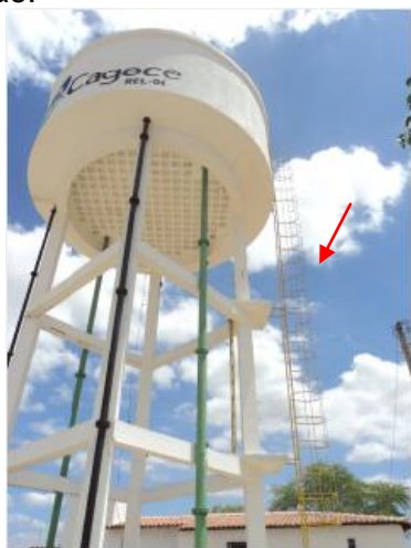
Foto 53 – REL-01: tubulações e escada com guarda-corpo.
