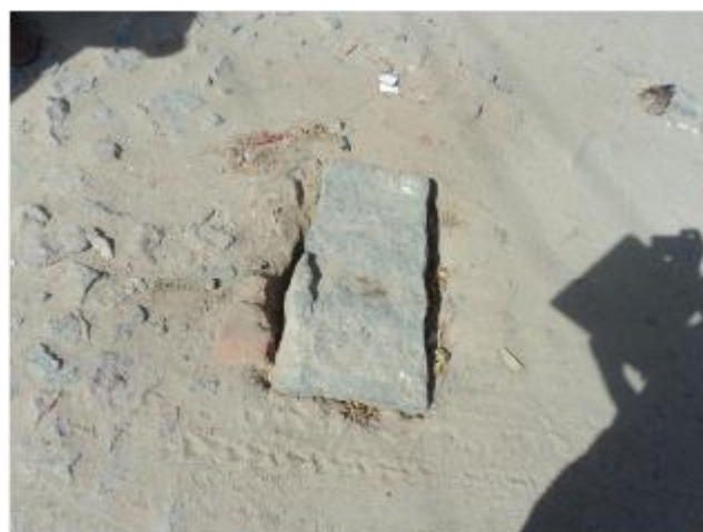
Foto 70 – Rede de distribuição: registro de descarga na Rua Lucas Batista com tampa improvisada.
