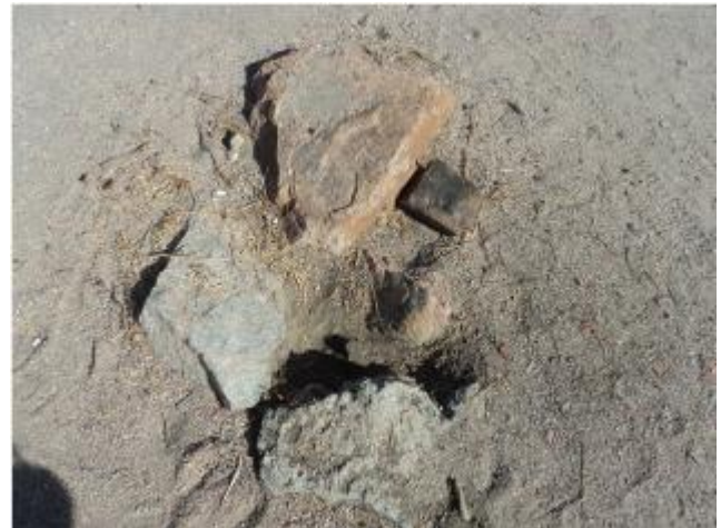
Foto 72 – Rede de distribuição: registro de descarga na Rua Waldir Andrade Braga sem caixa.
