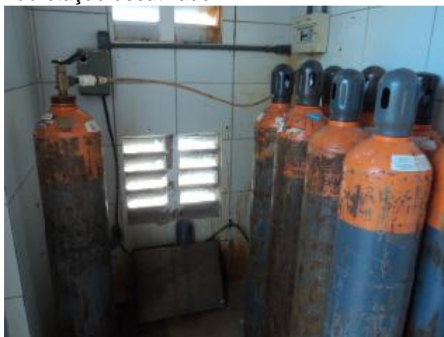
Foto 31 – Casa de química: armazenamento de cilindros de cloro gasoso.
