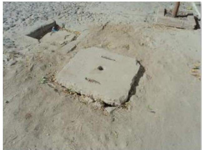
Foto 74 – Rede de distribuição: registro de descarga na Rua Profª Dilma Bastos.
