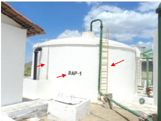
Foto 49 – RAP-01: medidor de nível, identificação e escada.
