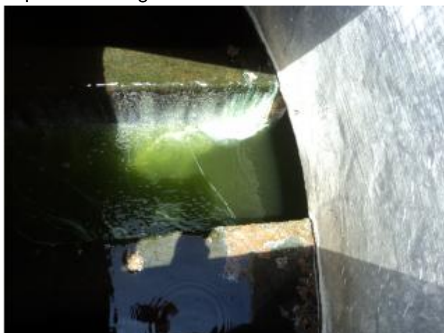
Foto 26 – Filtro 4: presença de materiais na superfície da água.
