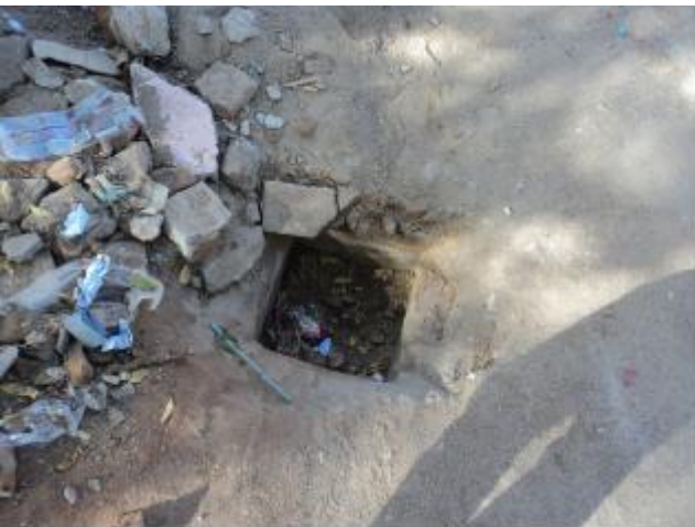
Foto 73 – Rede de distribuição: registro de descarga na Rua Luis da Mota Melo (2) sem tampa.
