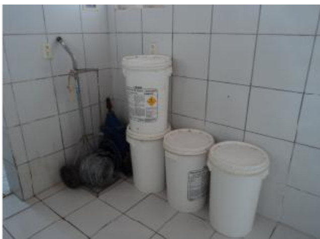
Foto 28 – Casa de química: armazenamento de produtos químicos.
