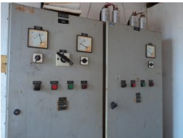
Foto 7 – EECS: quadro de comando.
