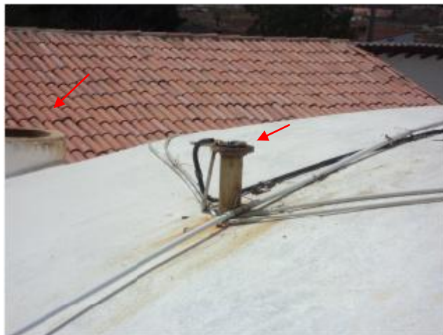
Foto 50 – RAP-01: ausência de tampa de inspeção e tubulação de ventilação inadequada.
