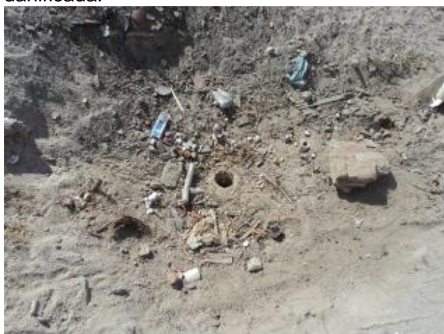
Foto 69 – Rede de distribuição: registro de descarga na Rua Luis Mota Melo (1) sem caixa.
