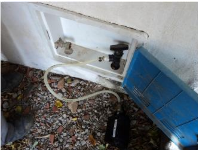
Foto 63 – Rede de distribuição: medição contínua de pressão na Rua 21 de junho, 378 - Centro.
