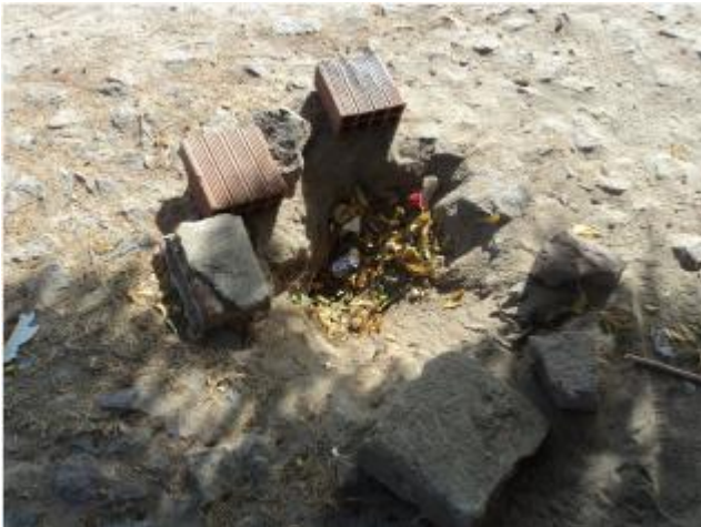
Foto 71 – Rede de distribuição: registro de descarga na Rua Walmar Braga sem caixa.
