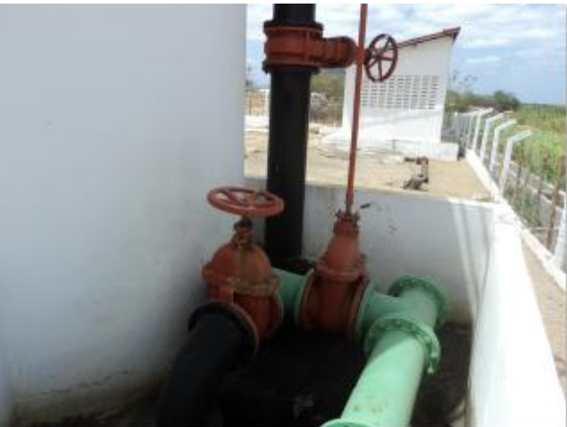
Foto 20 – Filtro 4: tubulações e registros.
