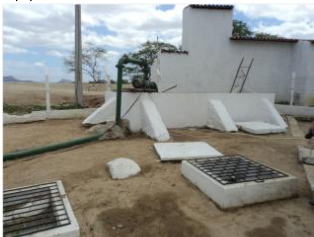
Foto 42 – ETA: reservatório para recebimento de carros-pipa.
