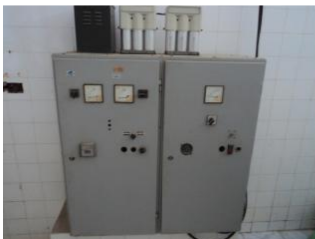
Foto 48 – EEAT-01: quadro de comando.
