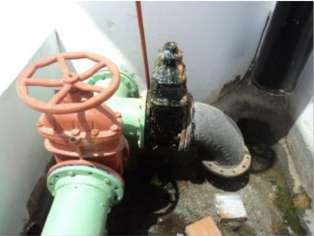
Foto 18 – Filtro 2 (desativado): registros.
