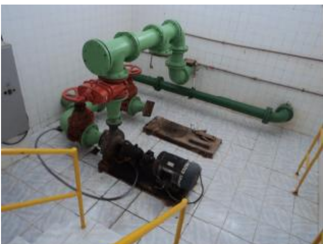
Foto 47 – EEAT-01: sem conjunto moto-bomba reserva.
