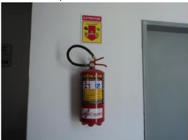
Foto 80 – Loja de atendimento: extintor de incêndio.
