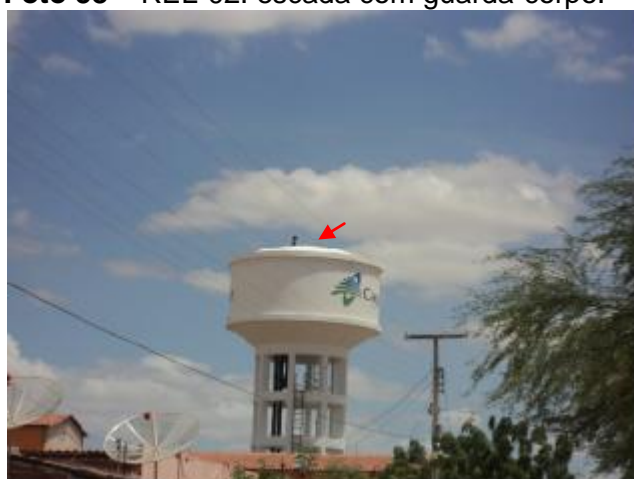
Foto 60 – REL-02: pára-raio caído na laje de cobertura.
