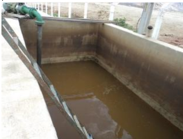
Foto 43 – ETA: reservatório para recebimento de carros-pipa.
