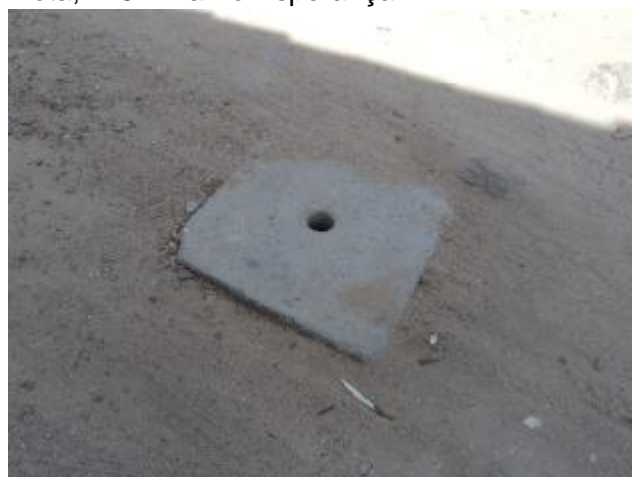
Foto 68 – Rede de distribuição: registro de descarga na Rua Euriva Negreiros.
