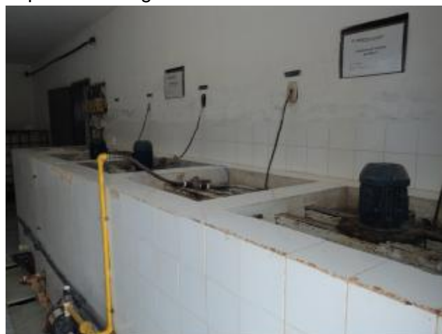
Foto 27 – Casa de química: tanques de mistura.
