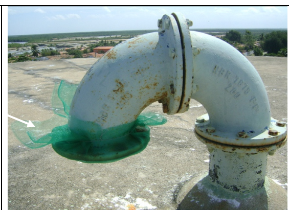
Foto 8 – RAP-02: tubulação de ventilação com tela de proteção.
