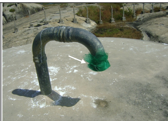
Foto 5 – RAP-01: tubulação de ventilação com tela de proteção.
