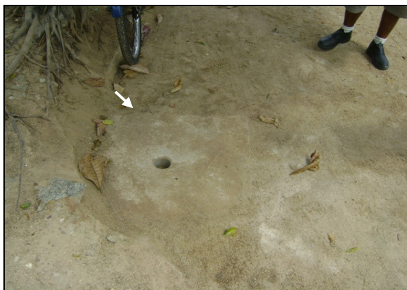
Foto 21 – Registro de descarga localizado na Rua Prof. João Rodrigues Braga.
