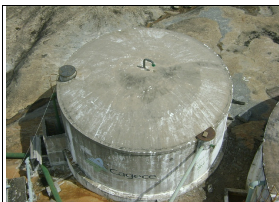
Foto 7 – RAP-02: pintura deteriorada.
