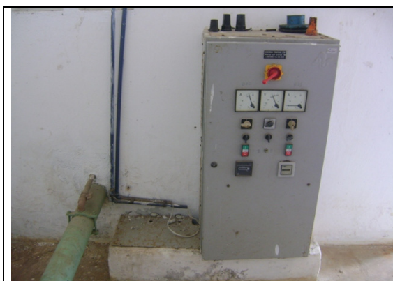
Foto 1 – EEAT-03: fiação elétrica do quadro de comando exposta.
