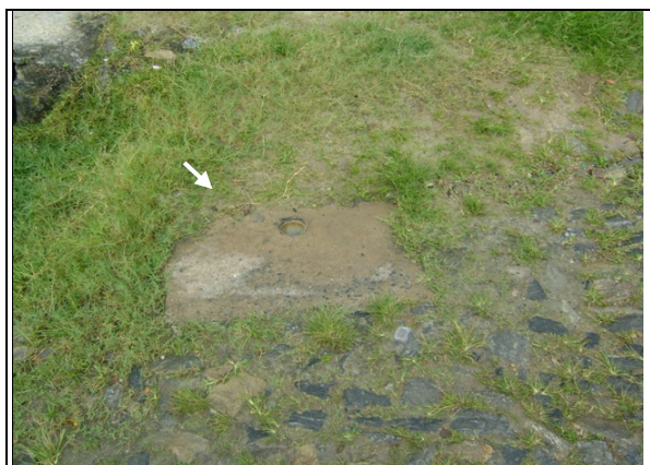
Foto 23 – Registro de descarga localizado na Rua Arabaina.
