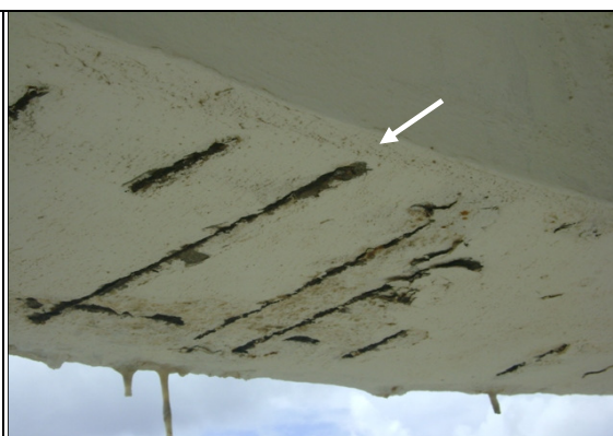
Foto 15 – REL-03: Ferrugem da estrutura de concreto aparente.
