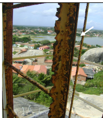
Foto 13 – REL-03: escada de acesso oxidada.
