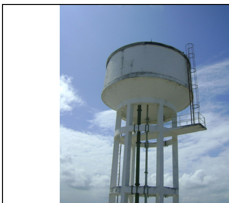
Foto 10 – REL-03: ausência de identificação e guarda-corpo na laje superior.
