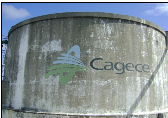
Foto 4 – RAP-01: pintura deteriorada.
