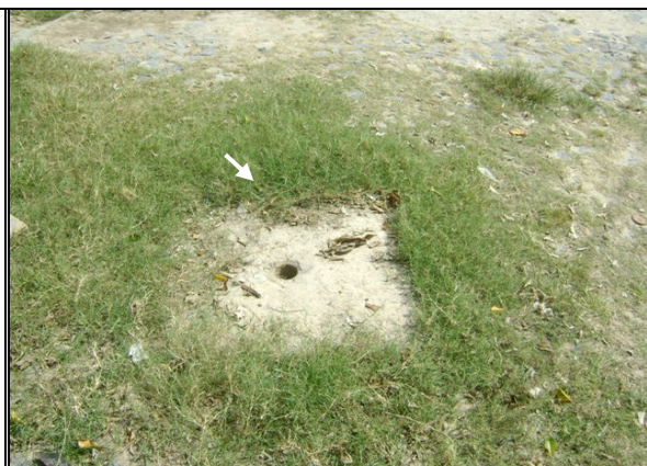
Foto 20 – Registro de descarga localizado na Rua Pe. Antônio Carneiro.
