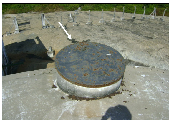
Foto 6 – RAP-01: tampa de inspeção oxidada.
