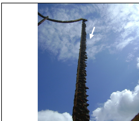
Foto 14 – REL-03: escada de acesso oxidada.
