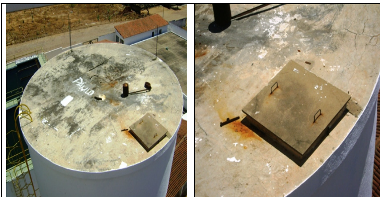
Fotos 36 e 37 – Vistas superiores do REL-02
