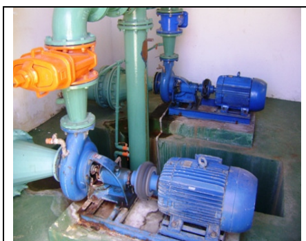
Foto 21 – Conjuntos motores-bomba da EEAT-01
