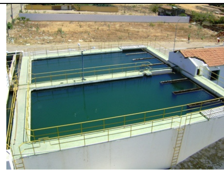
Foto 9 – Detalhe dos decantadores
