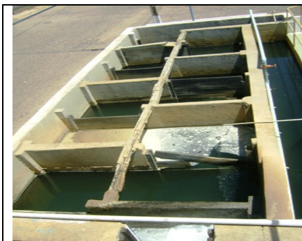
Foto 8 – Detalhe dos floculadores
