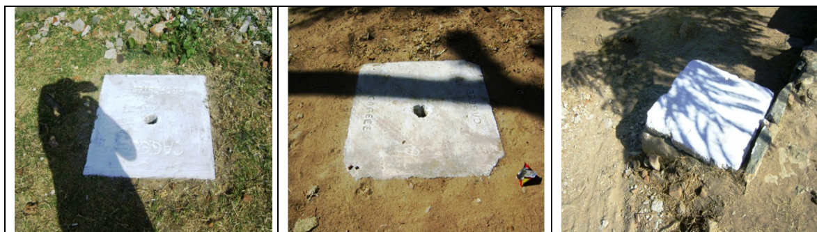
Fotos 44, 45 e 46 – Registros de descarga nas Ruas Jacob Melo, Washington Vale e Francisco Alves Ferreira
