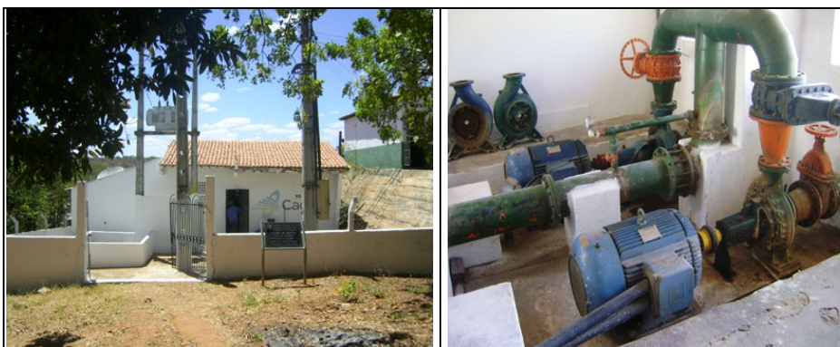
Fotos 3 e 4 – Casa de abrigo e conjuntos motores-bomba da EEAB-01
