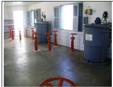
Foto 17 – Sistema de fluoretação e tanques dosadores
