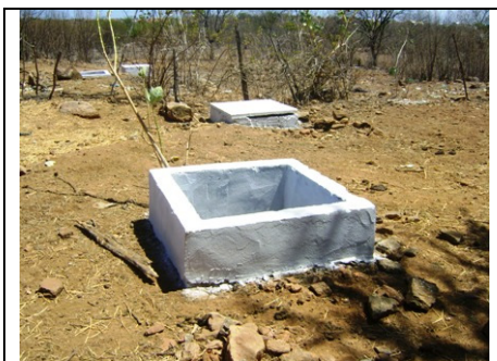
Foto 38 – Caixa de proteção aberta na adutora de água bruta
