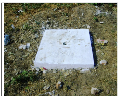
Foto 47 – Registros de descarga na Rua Almirante Tamandaré
