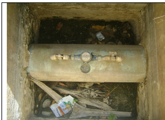
Foto 48 – Macromedidor para lavagem dos filtros.
