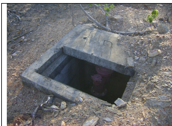
Foto 54 – Adutora de água bruta: caixa de inspeção de ventosa.
