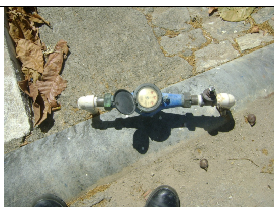
Foto 47 – Macromedidor na saída do REL-01, sem caixa de proteção.
