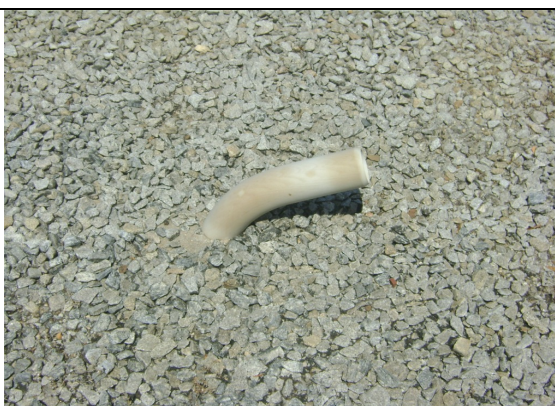
Foto 42 – RAP-02: tubulação de ventilação inadequada e sem tela de proteção.
