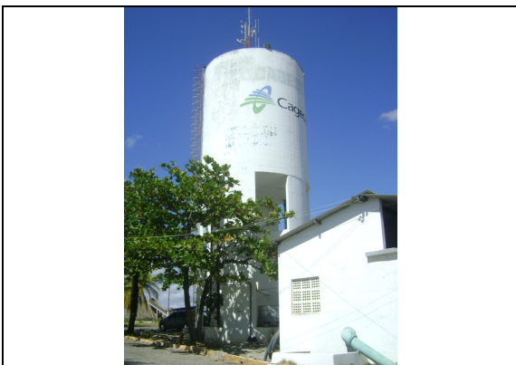
Foto 45 – REL-01: ausência de guarda corpo na laje de cobertura.
