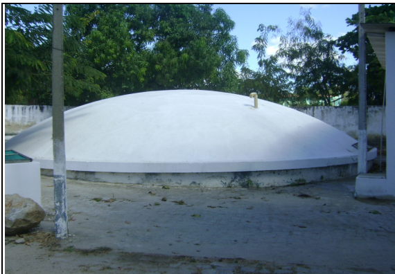
Foto 44 – RSE-01 (Pão): ausência de identificação.
