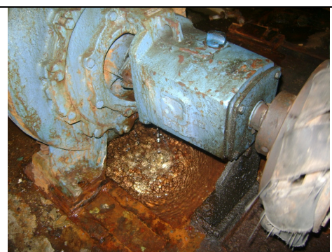
Foto 31 – EEAT-02: vazamento na gaxeta da bomba.
