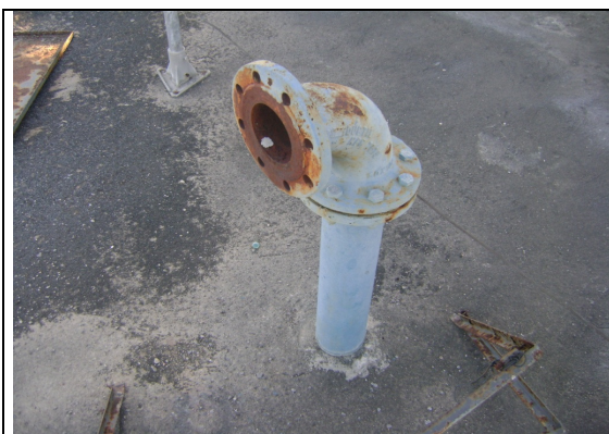
Foto 34 – RSE-01 (Tapuiará): tubulação de ventilação inadequada e sem tela de proteção.
