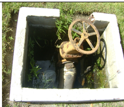
Foto 10 – ETA: caixa de proteção de registro com água e sem grade de proteção.
