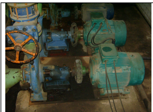
Foto 29 – EEAT-01: pintura deteriorada dos conjuntos motores-bomba.
