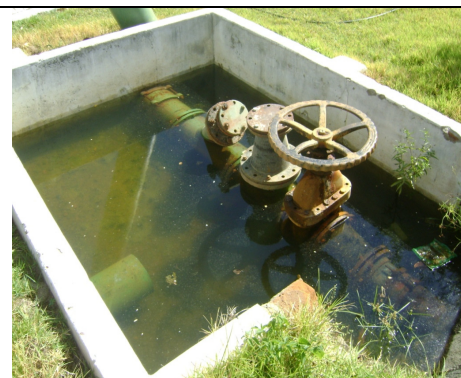
Foto 9 – ETA: caixa de proteção de registro com água e sem grade de proteção.
