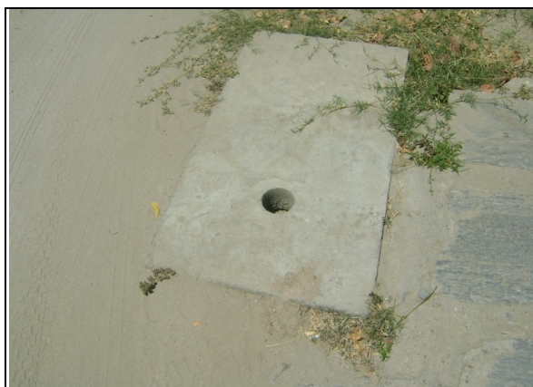
Foto 63 – Registro de descarga localizada na Rua Tabelião Eneas, 13 – Rodoviária.
