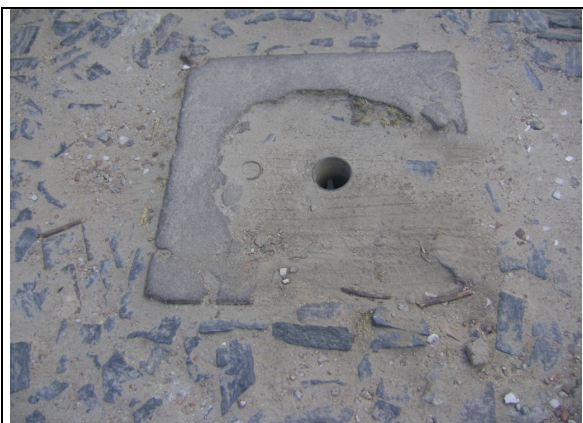
Foto 65 – Registro de descarga localizado na Rua Sebastião Holanda Pinto, 144 – Alto São Francisco.
