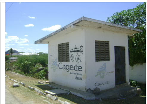
Foto 32 – EERD-01 ( booster Putiú ): casa de proteção do booster com pintura deteriorada.
