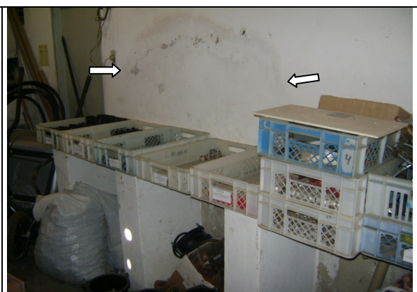
Foto 88 – Pintura do almoxarifado do SAA de Quixadá, deteriorada.
