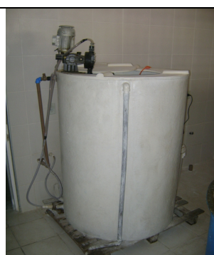
Foto 18 – Sistema de fluoretação em funcionamento.
