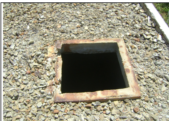
Foto 41 – RAP-02: ausência da tampa de inspeção.
