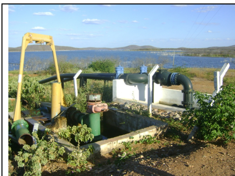
Foto 20 – EECS-01 e EECS-02: ausência de identificação.
