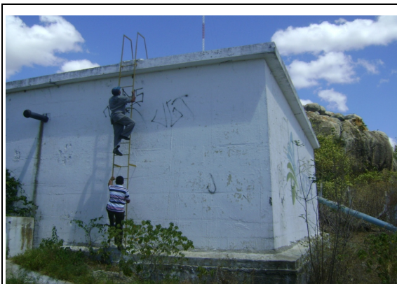
Foto 39 – RAP-02: ausência de identificação.
