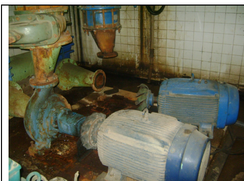
Foto 30 – EEAT-02: pintura deteriorada dos conjuntos motores-bomba.
