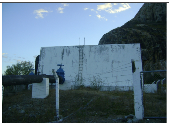
Foto 37 – RAP-01 (caixa de passagem): cerca de proteção da área danificada, pintura deteriorada e ausência de identificação.
