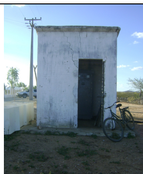
Foto 21 – EECS-01 e EECS-02: casa de proteção do quadro de comando com pintura deteriorada.
