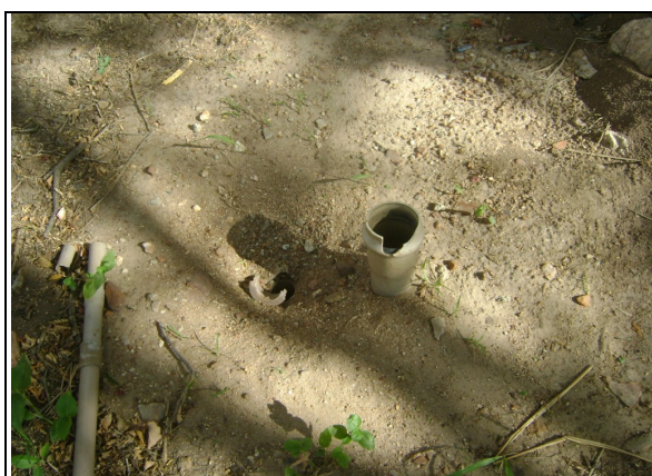
Foto 69 – Registro de descarga localizado na Rodovia Costa e Silva – Belas Artes, sem caixa de proteção.
