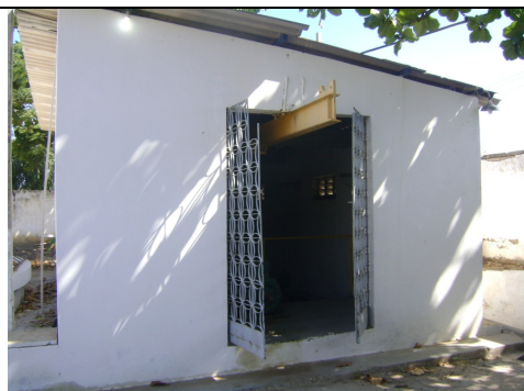
Foto 27 – EEAT-01 e EEAT-02: ausência de identificação.
