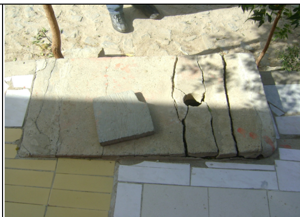
Foto 68 – Registro de descarga localizado na Rua Ovídio Pereira Lima, 269 – Jardim dos Manólitos (Nova Aldeota), com tampa da caixa de proteção, danificada.
