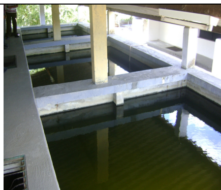
Foto 6 – ETA: vista geral dos filtros.
