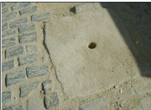
Foto 67 – Registro de descarga localizado na Rua Santa Edwirges, 656 - Mutirão.
