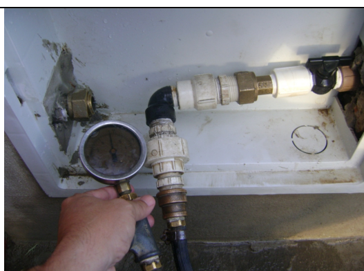
Foto 73 – RDA: medição de pressão no endereço Rua Juvêncio Alves de Oliveira, 1.033.
