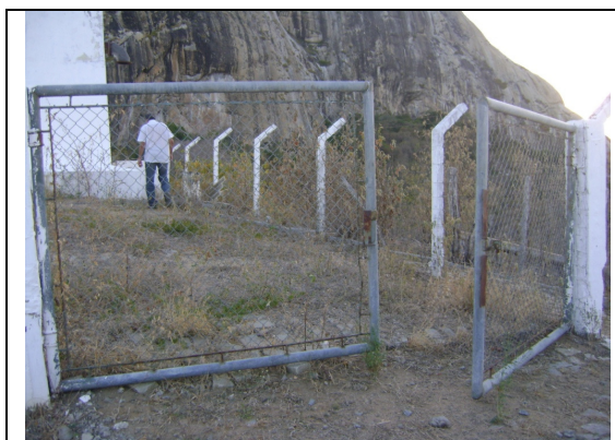
Foto 36 – RAP-01 (caixa de passagem): portão de acesso, danificado.
