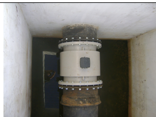
Foto 53 – Macromedidor eletromagnético na saída do RAP-01-SOHIDRA.
