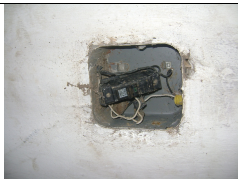
Foto 28 – EEAT-01: instalação elétrica inadequada.
