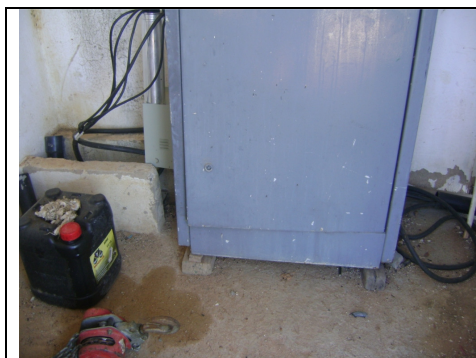
Foto 22 – EECS-01 e EECS-02: quadro de comando sem base de sustentação.
