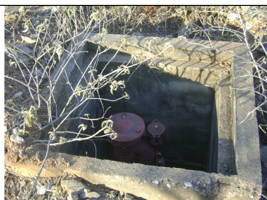
Foto 55 – Adutora de água bruta: caixa de inspeção de ventosa.
