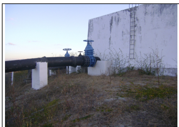
Foto 38 – RAP-01 (caixa de passagem): limpeza da área inadequada.
