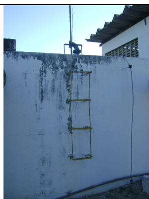
Foto 35 – RSE-01 (Tapuiará): ausência de identificação.
