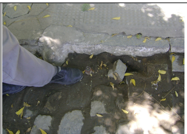
Foto 64 – Registro de descarga localizada na Rua José Jucá, 527 - Centro, sem caixa de proteção.
