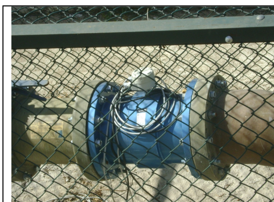
Foto 46 – Macromedidor eletromagnético na chegada da ETA (decantador), com grade de proteção.
