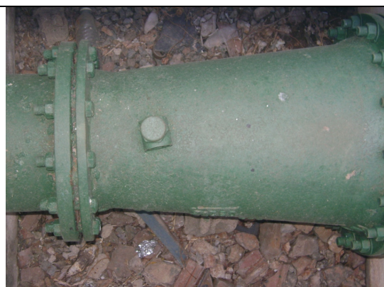
Foto 52 – Estação pitométrica na saída do RSE-01 (Tapuiará).
