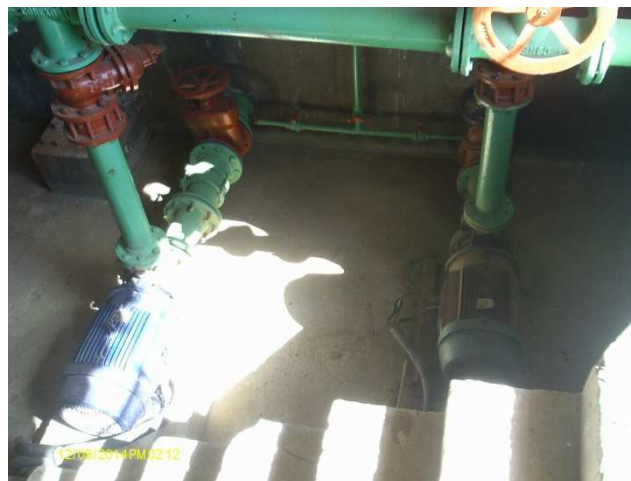
Foto 14 – EEAT-01 – sem identificação.
