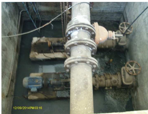
Foto 6 – EEE-01: ausência de bomba reserva.
