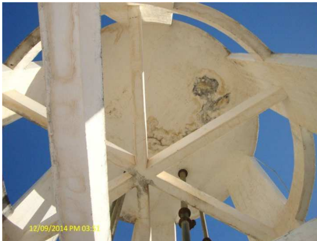
Foto 21 – REL-02: estrutura deteriorada.
