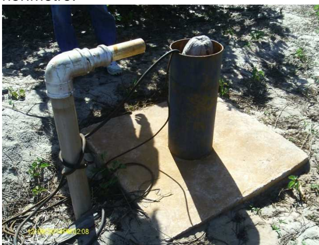
Foto 3 – PT-03: ausência de bomba.
