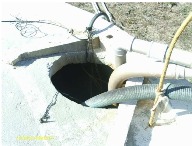
Foto 17 – RAP-01: sem tampa de inspeção.
