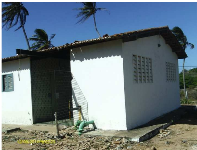
Foto 13 – Casa de bombas sem identificação.
