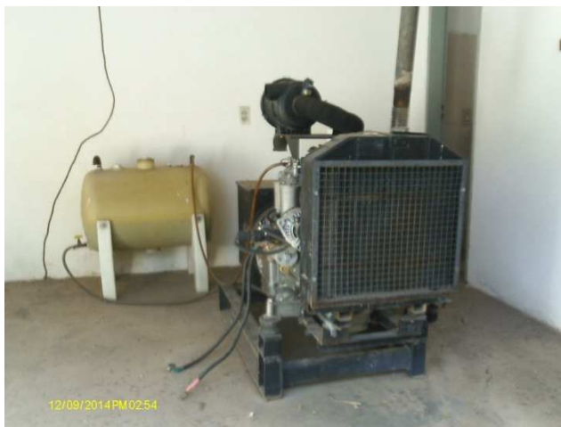
Foto 31 – EEE-01: grupo gerador sem funcionar.
