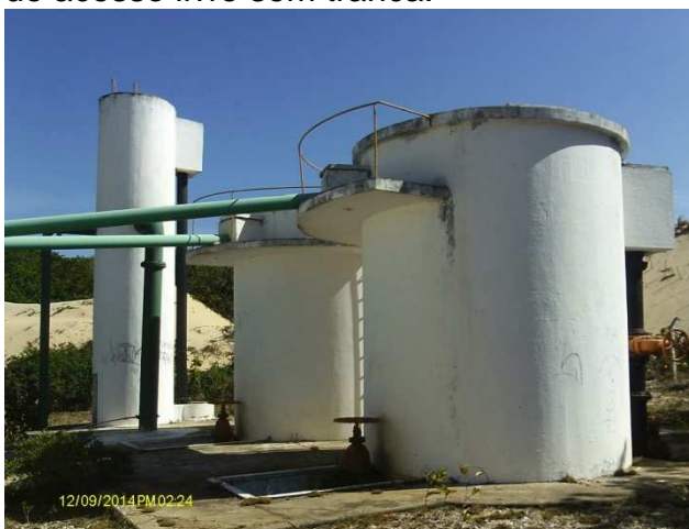
Foto 11 – Filtros F-01 e F-02 sem identificação.
