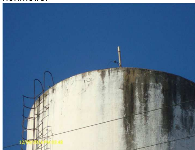
Foto 4 – REL-02: ausência de para-raios e sinalização noturna.
