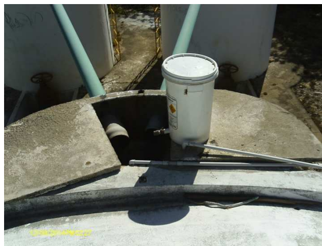
Foto 18 – RAP-01: vista superior da calha de recepção de água sem adequada vedação.
