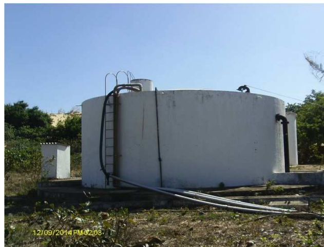
Foto 16 – RAP-01: sem identificação.
