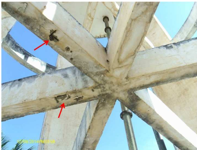
Foto 25 – REL-03: estrutura deteriorada.
