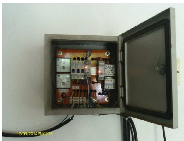
Foto 2 – PT-02: quadro de comando sem horímetro.
