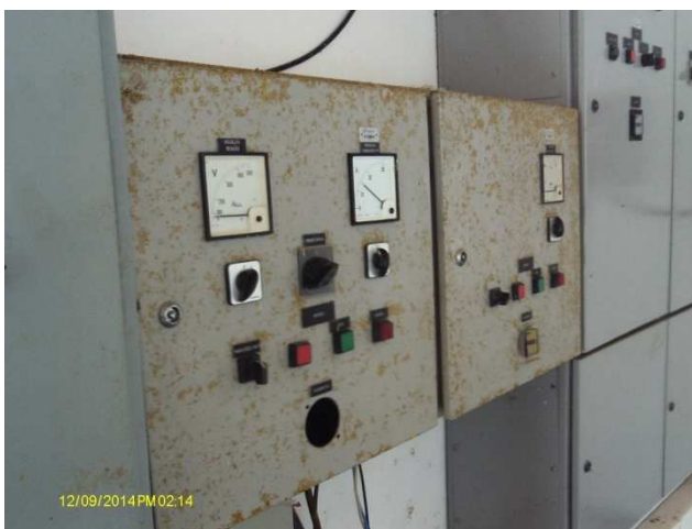
Foto 1 – PT-01: quadro de comando sem horímetro.
