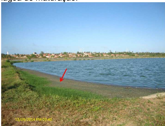
Foto 29 – ETE: lagoa facultativa com sobrenadante e talude danificado.
