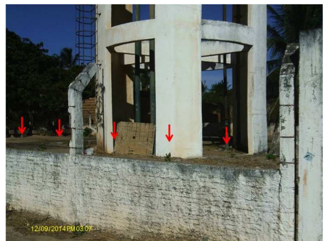
Foto 24 – REL-03: cerca danificada.
