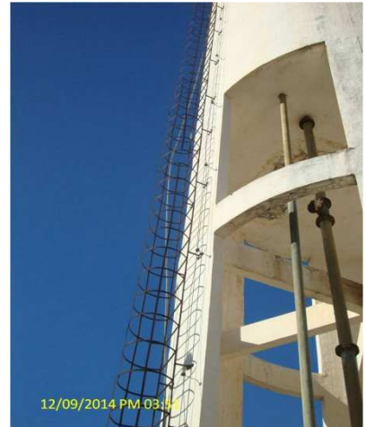
Foto 20 – REL-02: escada solta da estrutura do reservatório e com corrosão.
