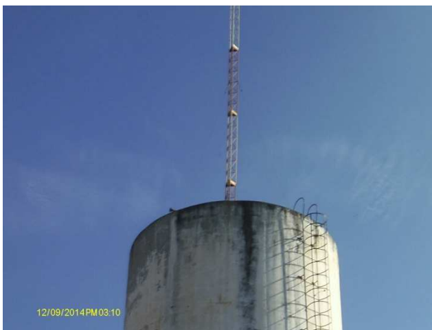
Foto 5 – REL-03: ausência de para-raios e sinalização noturna.
