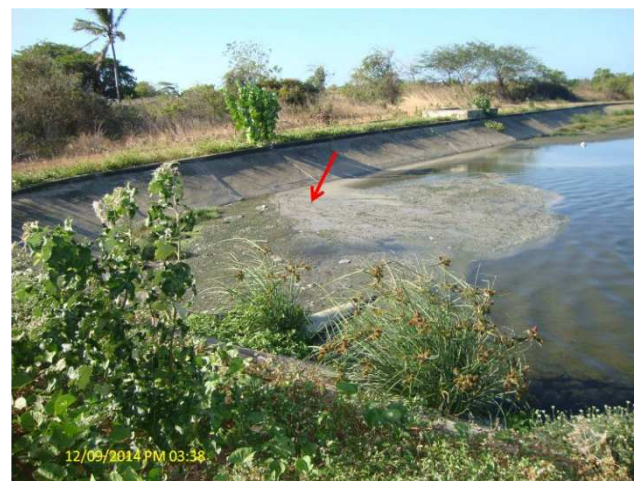
Foto 28 – ETE: lagoa de maturação com sobrenadante.
