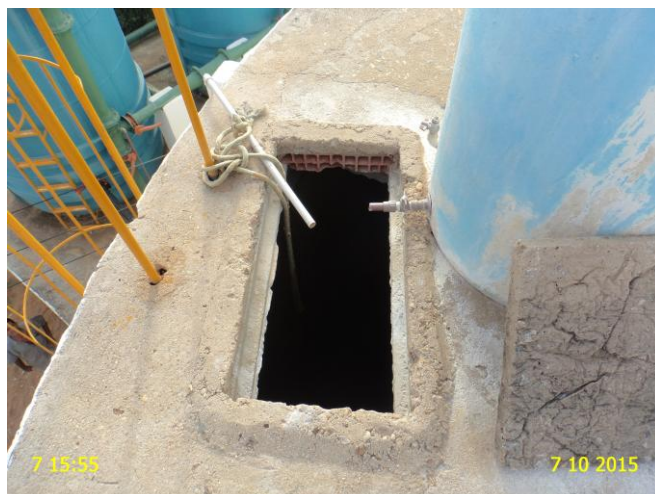
Foto 7 - RAP-01: tampa de inspeção sem vedação.
