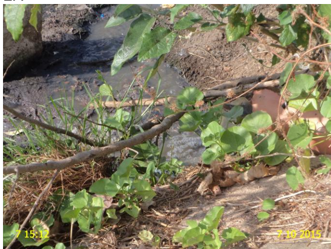
Foto 6 - ETE: tubulação de chegada do esgoto bruto danificada.
