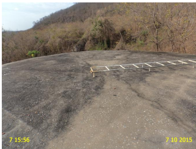
Foto 1 - RAP-01: ausência de tubulação de ventilação.
