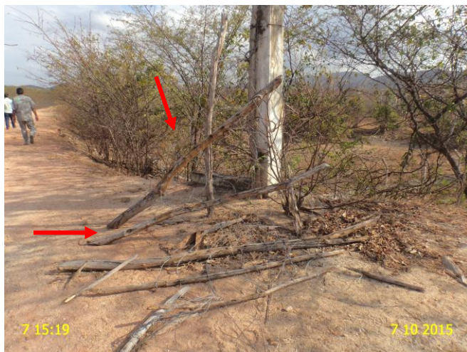
Foto 2 - ETE: portão danificado.
