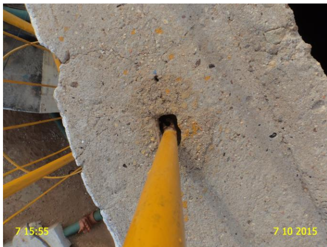
Foto 8 - RAP-01: escada de acesso sem fixação na estrutura do reservatório.
