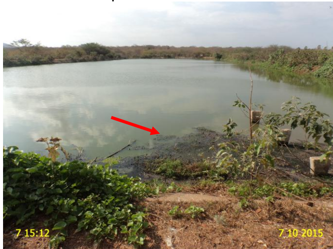
Foto 4 - ETE: acúmulo de sobrenadantes na LF.
