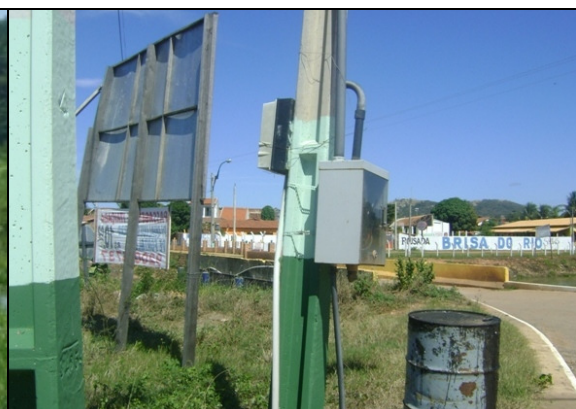
Foto 25 – Quadro de comando da EE-01.
