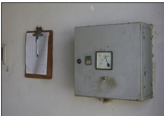
Foto 31 – Quadro de comando da EE-03.
