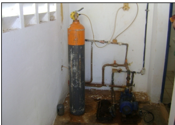
Fotos 12 – Cilindros e dosador de cloro gasoso.
