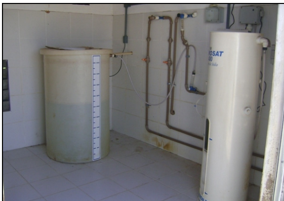
Fotos 14 e 15 – Vistas da fábrica de cloro.
