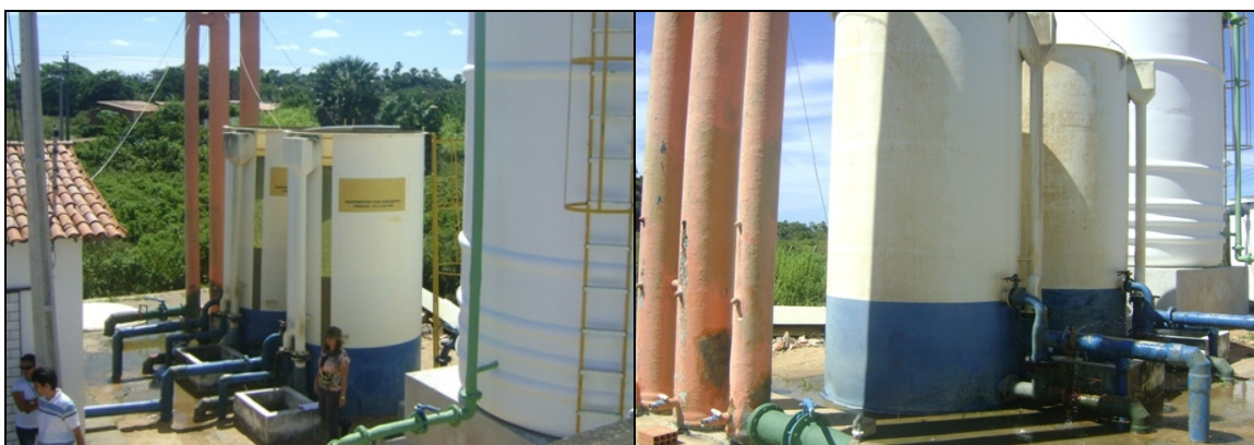
Fotos 5 e 6 – Vistas dos filtros 01 e 02.
