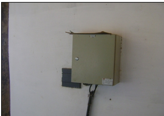
Foto 34 – Quadro de comando da EE-04.
