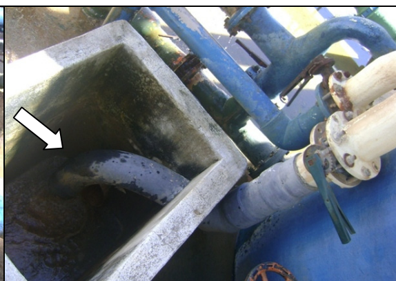
Foto 8 – Problema de vedação no registro do filtro 02.
