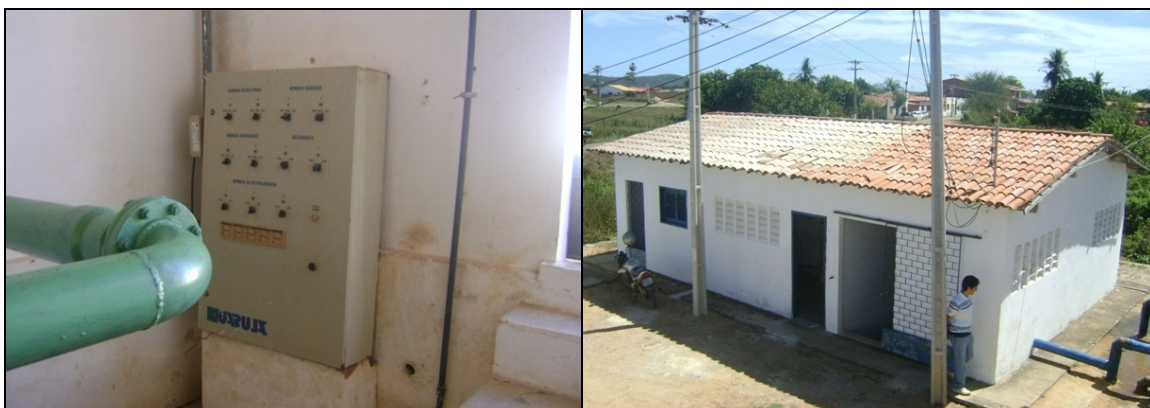
Foto 28 – Quadro de comando das EE-02 e EE-05.
