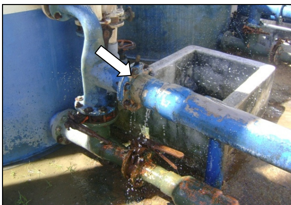
Foto 7 – Vazamento no tubo de lavagem do filtro 01.
