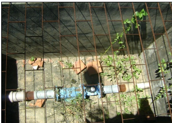
Foto 43 – Macromedidor de água tratada na saída da ETA.
