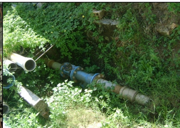
Foto 44 – Caixa de proteção do macromedidor de água tratada, na saída do REL-01, quebrada.
