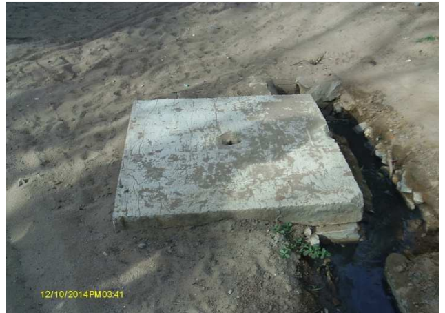
Foto 17 – Registro de descarga próximo a águas servidas, localizado na Rua José Carneiro de Meireles – Boa Esperança.
