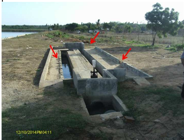
Foto 22 – ETE: tratamento preliminar com estrutura deteriorada.
