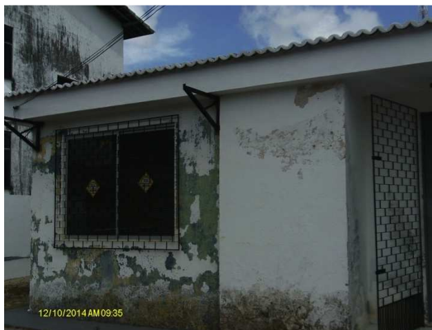
Foto 31 – Vista externa do escritório de atendimento ao usuário com pintura deteriorada.
