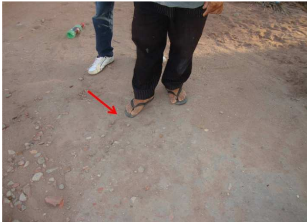
Foto 14 – Registro de descarga soterrado e sem caixa de proteção, localizado na Rua Antônio Tabosa.
