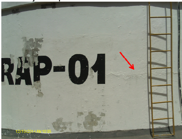
Foto 10 – RAP-01: infiltração na parede.
