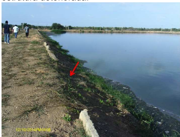
Foto 24 – ETE: lagoa facultativa com guia danificada.
