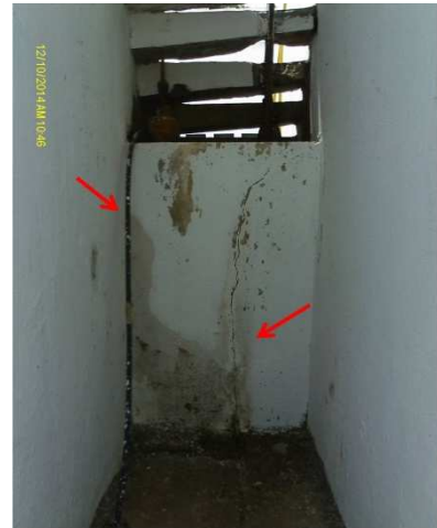
Foto 9 – ETA: Filtro com infiltrações abaixo da escada de acesso.
