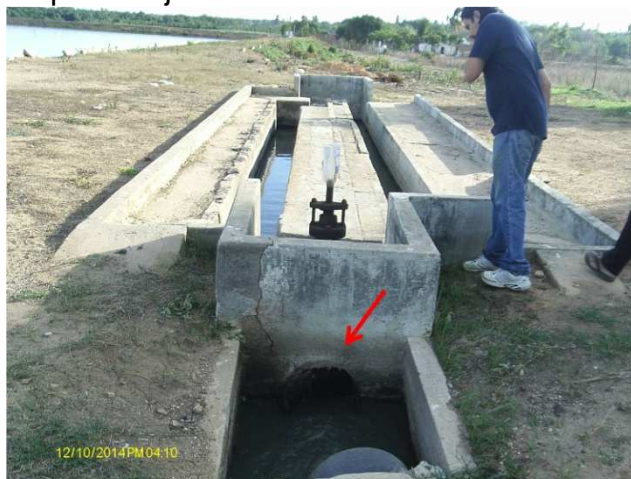
Foto 3 – ETE: ausência de gradeamento na entrada do tratamento preliminar.
