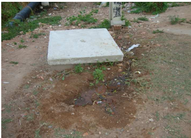
Foto 18 – Registro de descarga com vazamento, localizado na Rua José de Sousa Pinto.
