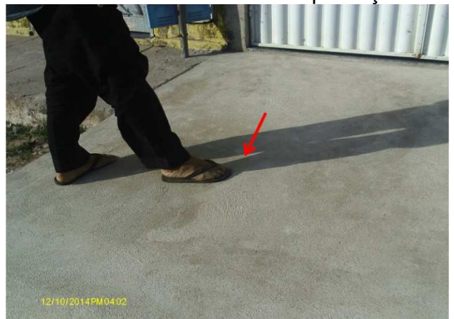
Foto 19 – Registro de descarga soterrado e coberto por uma calçada, localizado na Rua José Ferreira de Carvalho – Lagoa de Beber.
