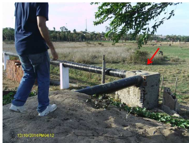
Foto 21 – Curva inadequada para chegada de esgoto na ETE.
