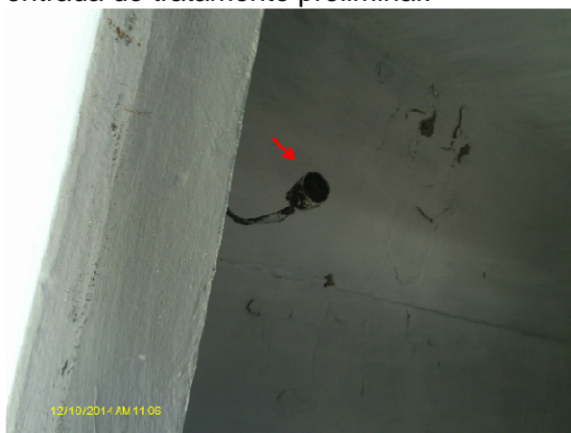
Foto 5 – Casa de abrigo do quadro de comando sem iluminação.
