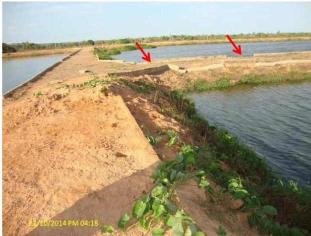
Foto 26 – ETE: lagoa facultativa e lagoas de maturação com guias danificadas.
