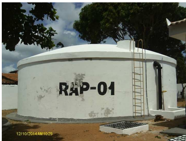
Foto 1 – RAP-01: ausência de guarda-corpo na laje de cobertura.
