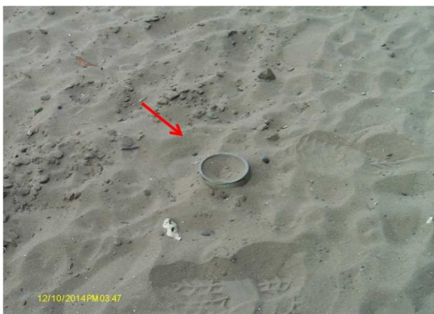
Foto 12 – Registro de descarga soterrado e sem caixa de proteção, localizado na Rua SDO 15 – Cana Brava.
