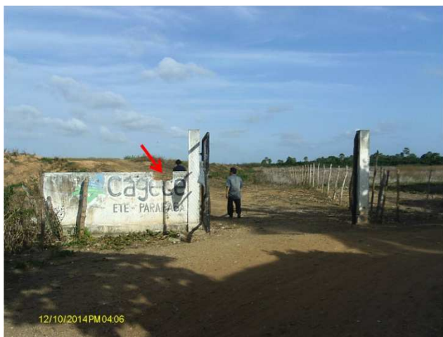
Foto 20 – ETE: entrada de acesso com pintura e estrutura deterioradas.
