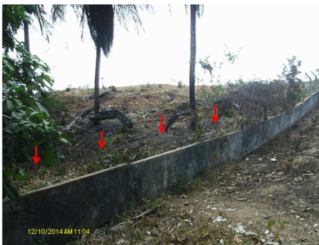
Foto 6 – Cerca de proteção da captação danificada.
