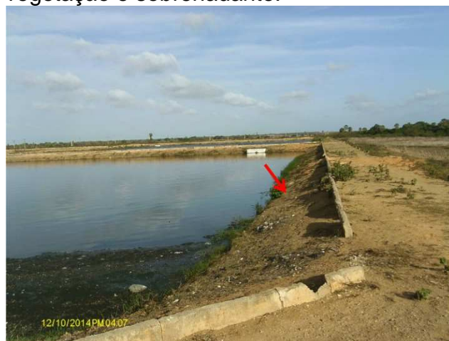
Foto 25 – ETE: lagoa facultativa sem placas de proteção a erosão.
