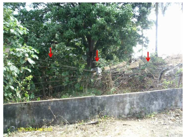
Foto 7 – Cerca de proteção da captação danificada.
