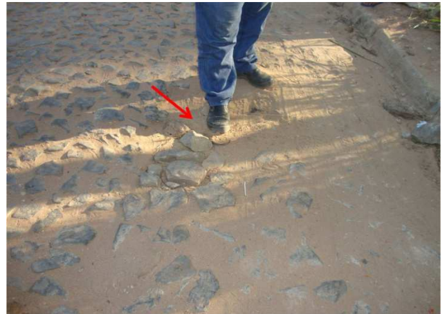
Foto 15 – Registro de descarga soterrado e sem caixa de proteção, localizado na Rua Francisco Batista de Azevedo - Centro.
