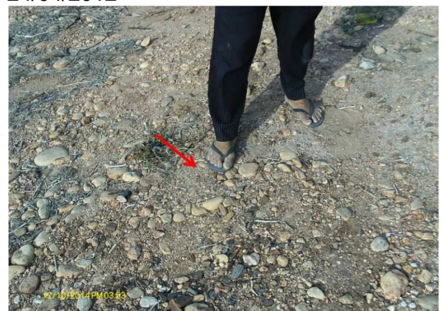
Foto 13 – Registro de descarga soterrado e sem caixa de proteção, localizado na Travessa Naum – Barroso Ramos.
