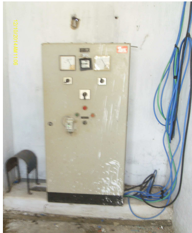
Foto 8 – Quadro de comando da EECS-01, com fiação exposta.
