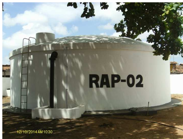
Foto 2 – RAP-02: ausência de guarda-corpo na laje de cobertura.
