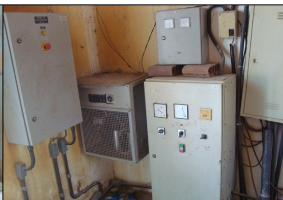
Foto 27 – Quadro da EE-02.
