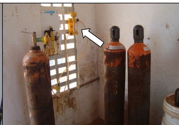
Foto 15 – Dosador e cilindros de cloro gasoso.
