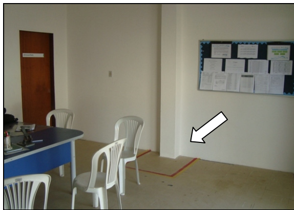
Foto 48 – Local do extintor de incêndio do escritório.
