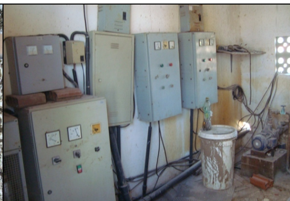
Foto 29 – Quadro da EE-03.
