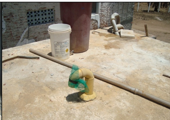
Foto 33 – Ventilação do RSE-01.
