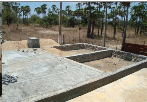
Foto 13 – Local destinado aos filtros.
