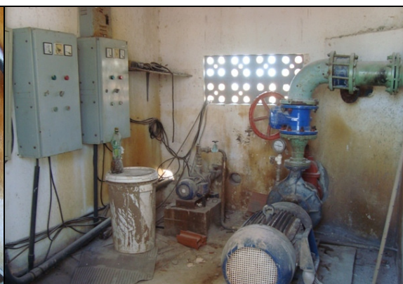
Foto 24 – Quadro da EE-01.
