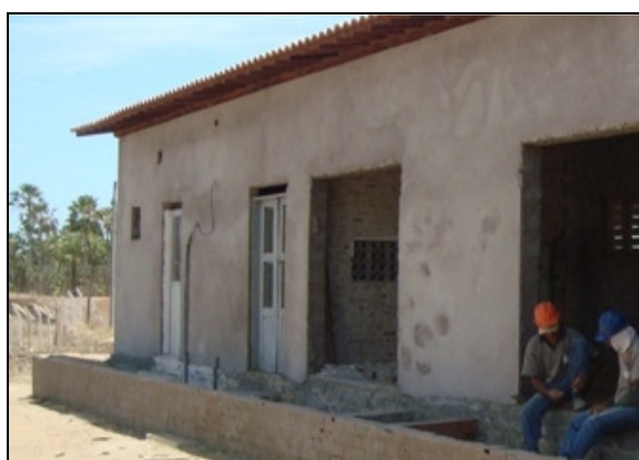
Foto 25 – Casa de comando da EE-01.
