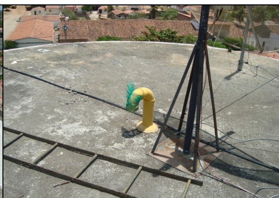
Foto 37 – Ventilação do REL-01.
