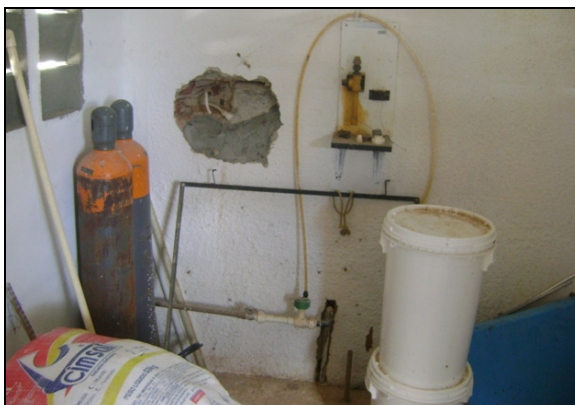
Foto 15 – Cilindros e dosador de cloro gasoso.
