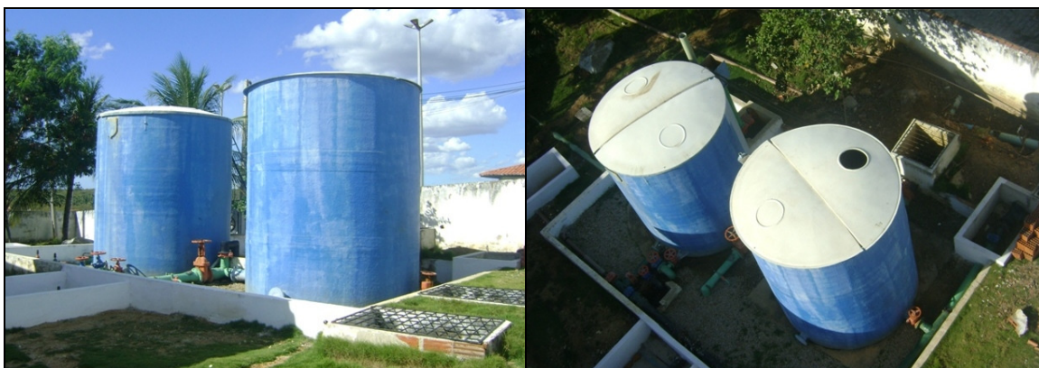
Fotos 6 e 7 – Vistas dos filtros 01 e 02.
