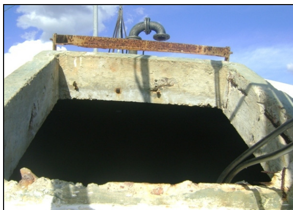
Foto 50 – Inspeção e Ventilação do REL-01.
