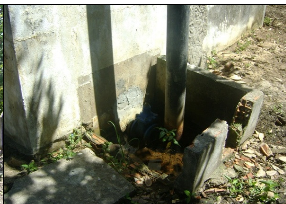
Foto 38 – Caixa do extravasor do RAP-01, quebrada.
