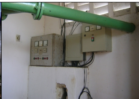
Foto 36 – Quadro de comando da EE-04.
