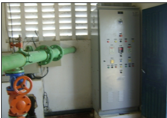
Foto 33 – Quadro de comando da EE-03.
