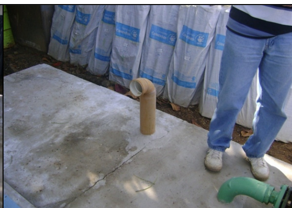
Foto 47 – Tubulação de ventilação do Poço de Reunião.
