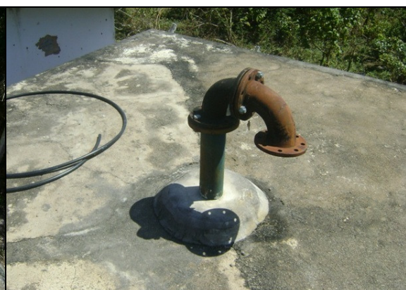
Foto 40 – Tubulação de ventilação do RAP-01.
