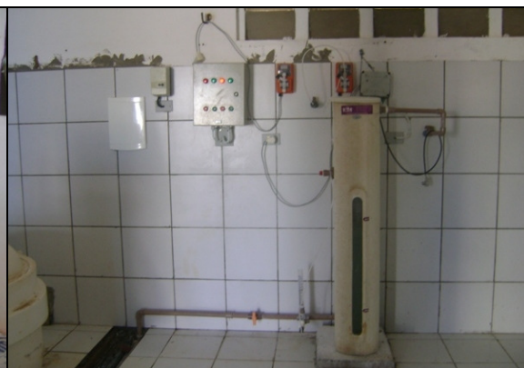
Foto 12 – Dosador de flúor.
