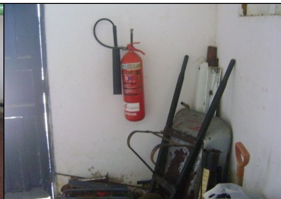
Foto 32 – Extintor de incêndio da EE-03.
