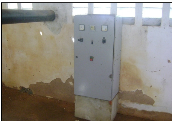
Foto 29 – Quadro de comando da EE-02.
