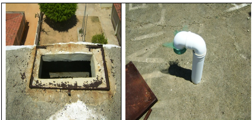
Fotos 30 e 31 – Vistas superiores do REL-01
