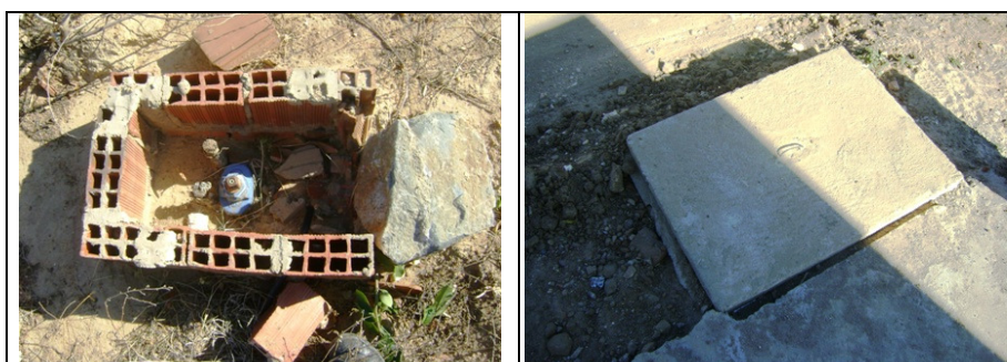
Fotos 45 e 46 – Registros de descarga na Av. José Chagas Filho e Rua Zacarias Pinheiro Silva
