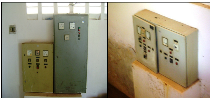
Fotos 20 e 21 – Quadros de comando das elevatórias EEAB-01 e EEAT-01
