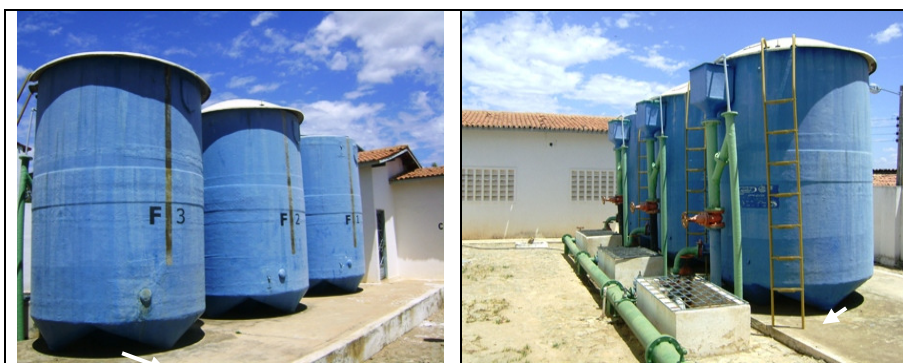
Fotos 5 e 6 – Vistas dos filtros
