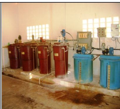
Foto 11 – Tanques dosadores e o sistema de fluoretação
