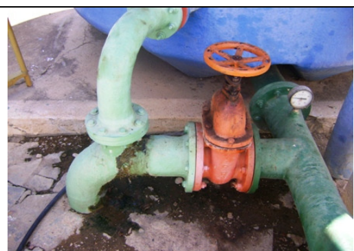
Foto 8 – Registro com vazamento
