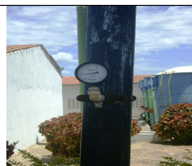
Foto 33 – Medição de nível no reservatório REL-01
