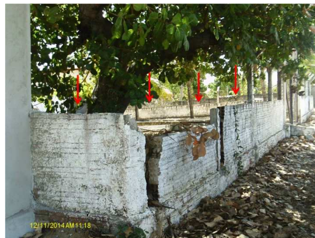
Foto 15 – EEE-01: cerca de proteção e estrutura danificada.
