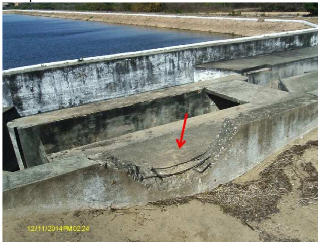
Foto 20 – ETE: tratamento preliminar com estrutura deteriorada.
