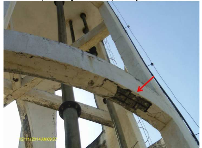
Foto 9 – REL-01: com estrutura deteriorada.
