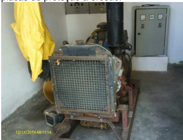
Foto 28 – EEE-01: grupo gerador sem funcionar.
