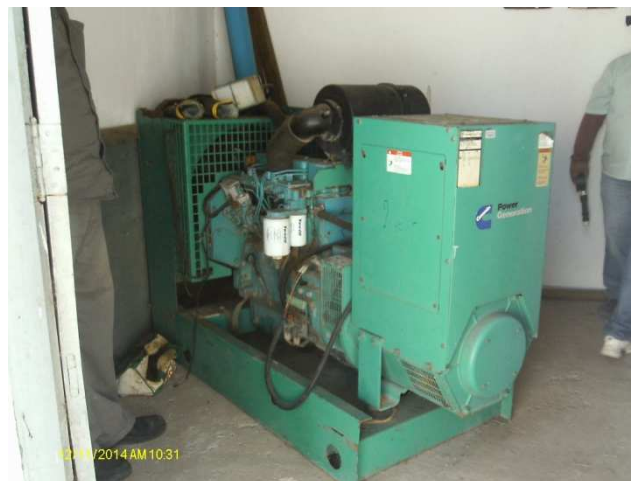
Foto 29 – EEE-02: grupo gerador sem funcionar.
