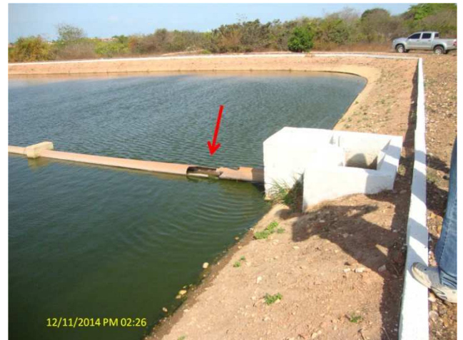
Foto 21 – ETE: tubulação de chegada na lagoa facultativa danificada.
