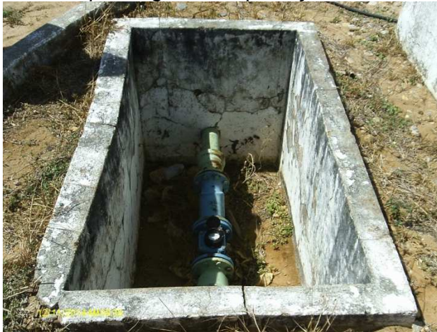
Foto 8 – Macromedidor de água tratada na chegada do REL-01 sem tampa ou grade de proteção.
