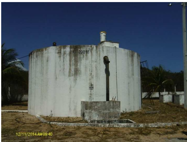
Foto 1 – RAP-01: ausência de guarda-corpo na laje de cobertura.
