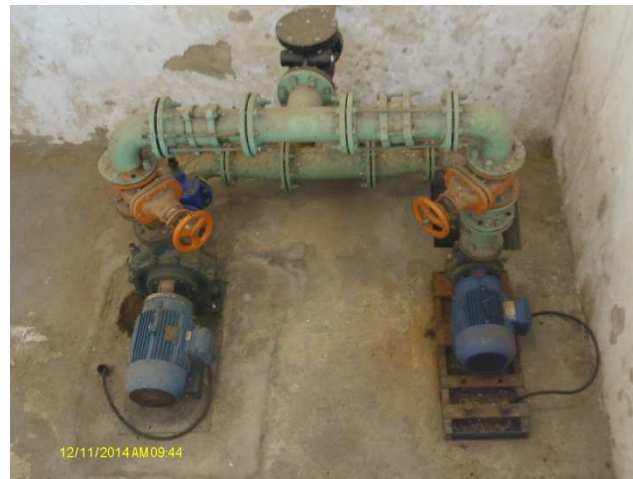
Foto 13 – EEAT-01 – sem identificação.
