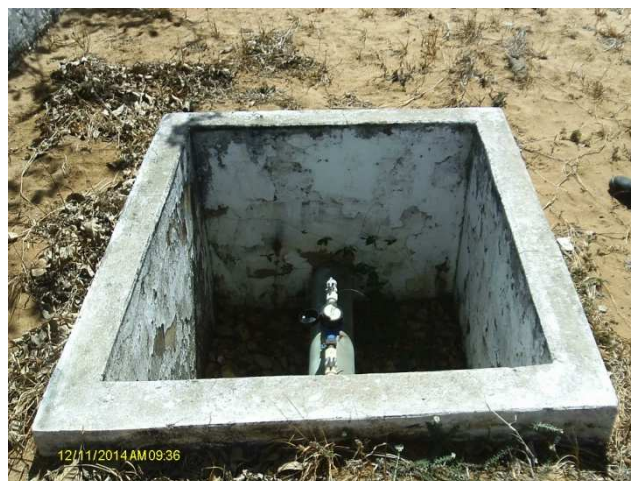
Foto 5 – Medidor proporcional de água bruta na chegada do RAP-01 sem tampa ou grade de proteção.
