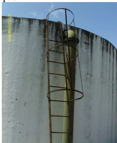
Foto 10 – RAP-01: escada apresentando corrosão e com estrutura sem fixação.
