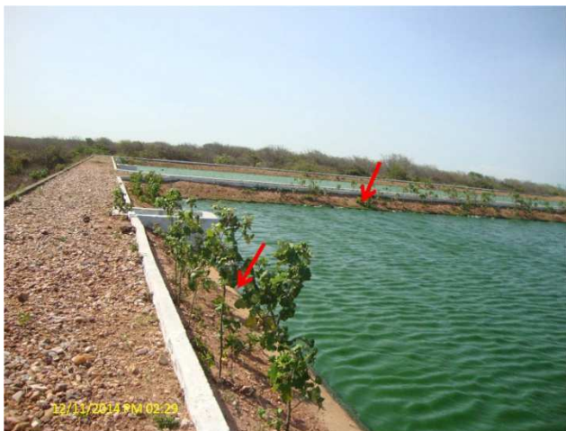
Foto 26 – ETE: lagoa facultativa sem placas de proteção a erosão.
