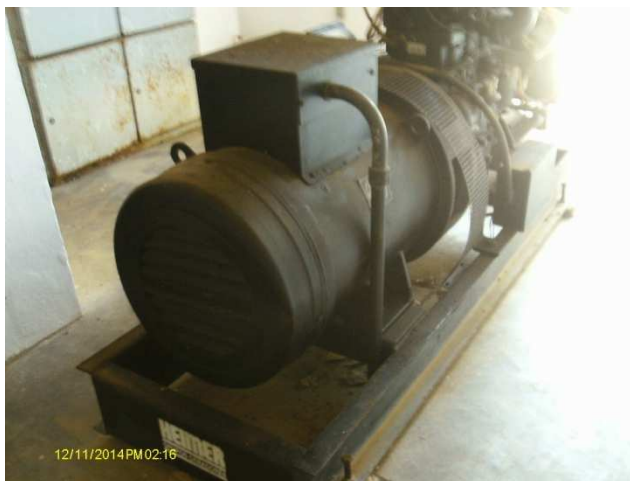
Foto 30 – EEE-03: grupo gerador sem funcionar.
