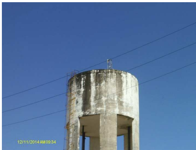
Foto 2 – REL-01: ausência de guarda-corpo na laje de cobertura.
