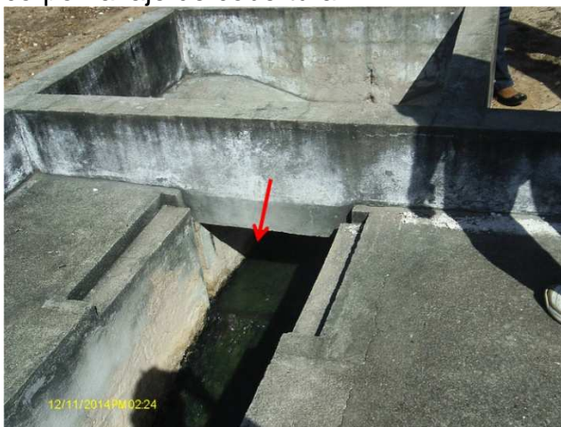
Foto 3 – ETE: ausência de gradeamento na entrada do tratamento preliminar.
