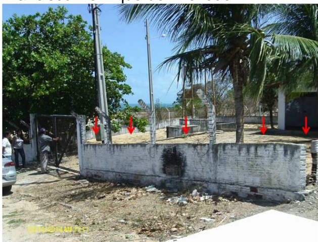
Foto 14 – EEE-01: cerca de proteção e estrutura danificada.
