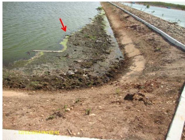
Foto 25 – ETE: lagoa de maturação com sobrenadante.
