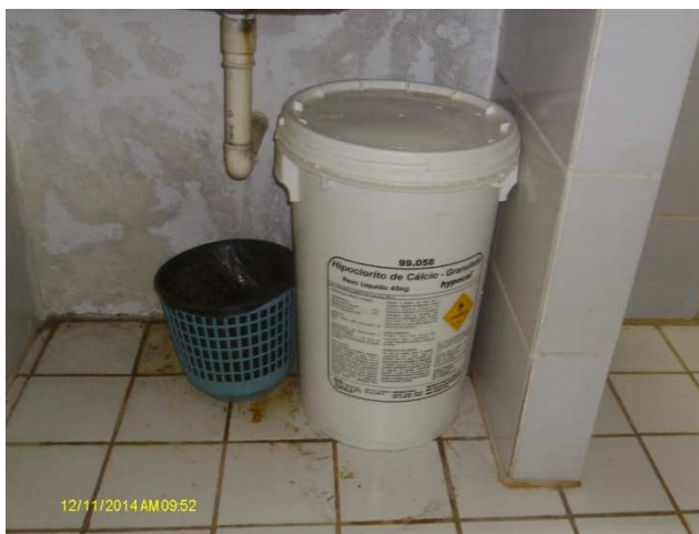
Foto 4 – ETA: armazenamento inadequado de produto químico.
