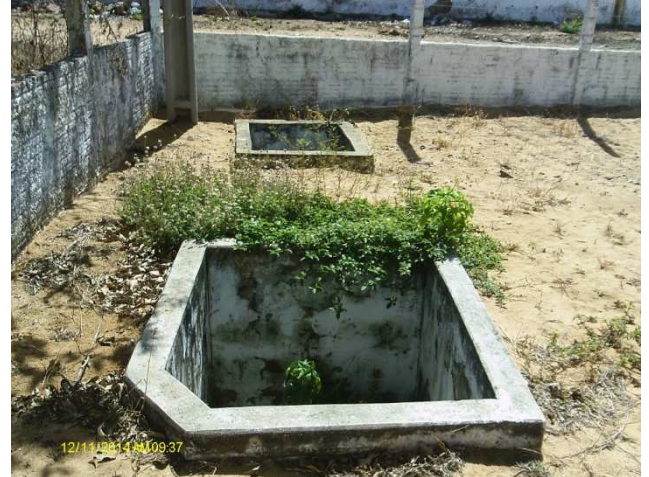
Foto 7 – Caixa de inspeção na área da ETA sem tampa ou grade de proteção.
