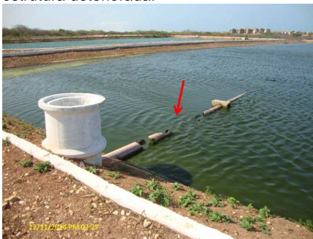
Foto 22 – ETE: tubulação de chegada na lagoa facultativa danificada.
