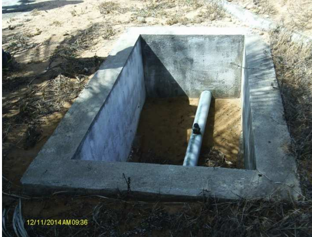
Foto 6 – Caixa de inspeção na área da ETA sem tampa ou grade de proteção.
