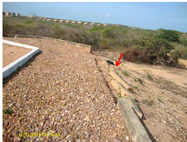
Foto 27 – ETE: guias danificados.
