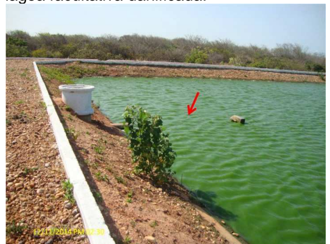
Foto 23 – ETE: tubulação de chegada na lagoa de maturação danificada.
