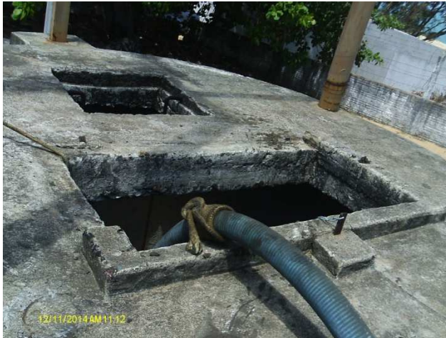
Foto 18 – EEE-01: poço de sucção sem tampa
