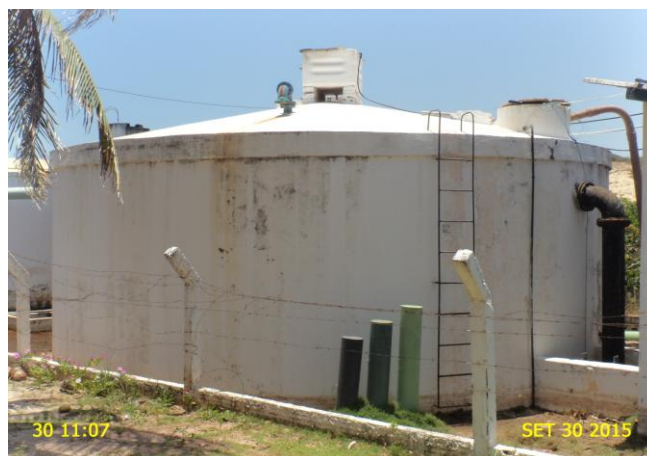
Foto 31 – RAP-01: pintura deteriorada, ausência de medidor de nível e de identificação.
