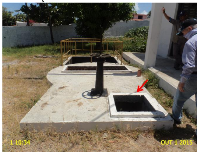
Foto 15 – EEE-01: ausência de tampa no poço de inspeção.
