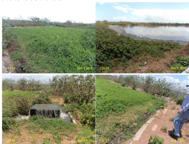
Foto 22 – ETE: placas de proteção dos taludes danificadas e acúmulo de vegetação no interior da lagoa de facultativa LF1.
