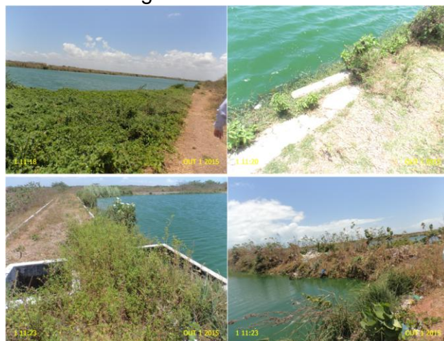
Foto 23 – ETE: placas de proteção dos taludes danificadas e acúmulo de vegetação no interior da lagoa facultativa LF2.
