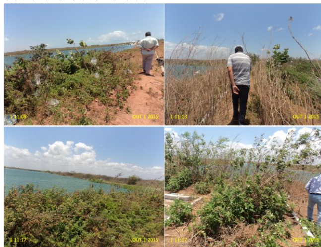
Foto 21 – ETE: excesso de vegetação nos taludes e nas guias.
