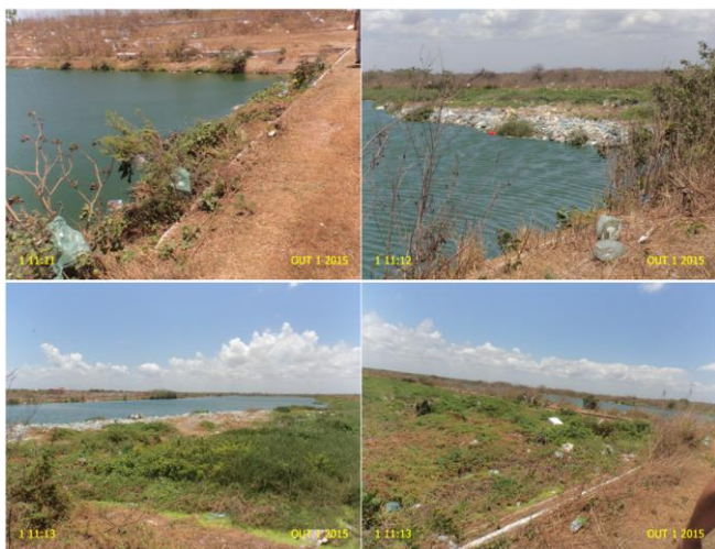
Foto 24 – ETE: placas de proteção dos taludes danificados e acúmulo de vegetação e resíduos no interior da lagoa de maturação.
