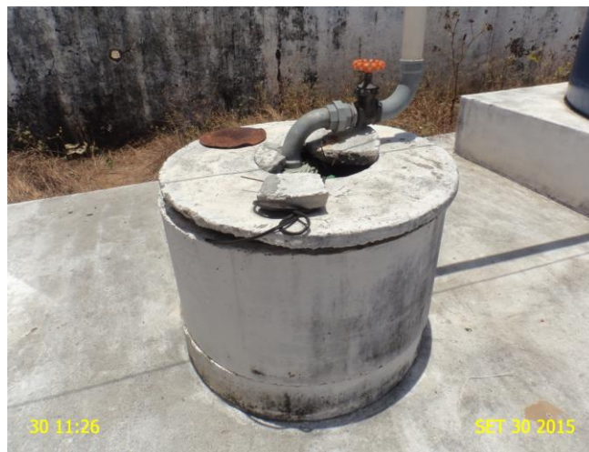
Foto 2 – Poço na área do REL-02: tampa de proteção danificada.
