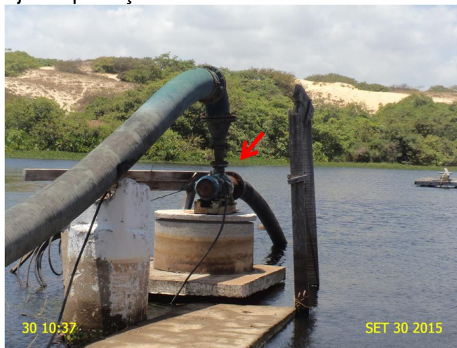
Foto 5 – EECS-01: ausência de bomba reserva.
