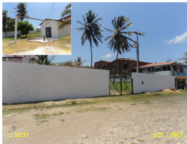
Foto 13 – EEE-01: ausência de identificação.
