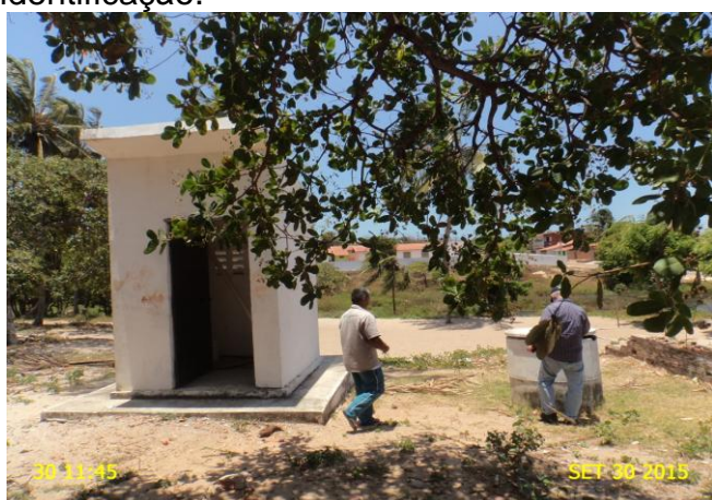
Foto 8 – Poço do Riacho Doce: ausência de identificação e iluminação.
