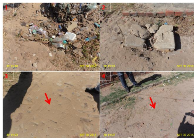
Foto 29 – RDA: 2 (dois) registros com caixas danificadas, nos endereços Rua João A. de Souza e Rua Domingos Paulino; e 2 (dois) soterrados, nos endereços Trav. Frei Damião e Rua Izaque da Rocha.
