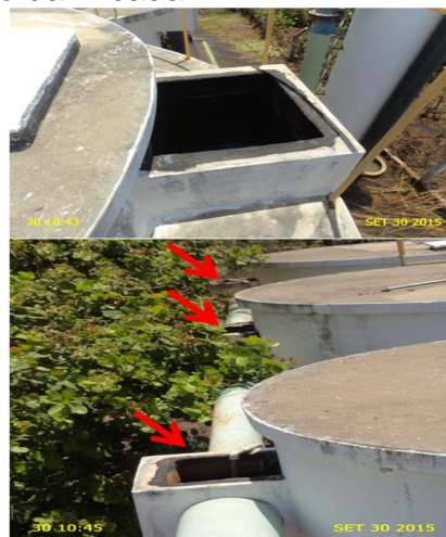
Foto 4 – F-01, F-02, F-03 e F-04: ausência de tampas nas calhas de saída.
