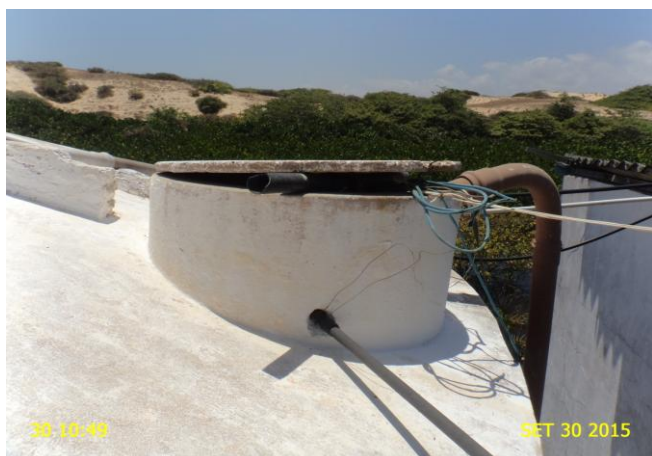
Foto 30 – RAP-01: tampa de abertura de inspeção sem fechamento adequado.
