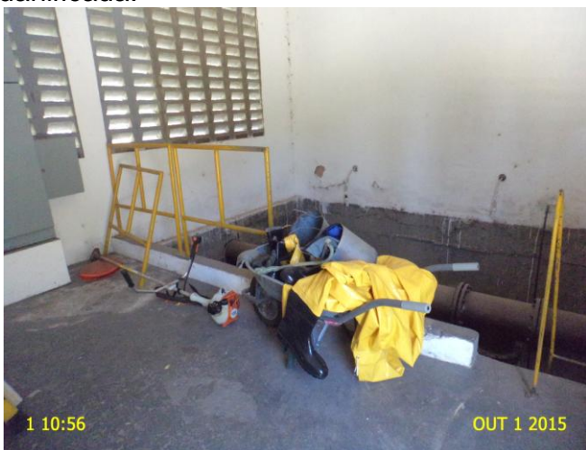
Foto 14 – EEE-02: guarda-corpos inadequado.
