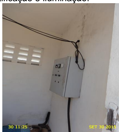
Foto 9 – Poço na área do REL-02: apresenta fiação exposta.
