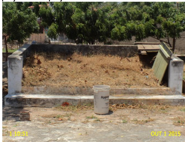
Foto 17 – EEE-02: leito de secagem necessitando de limpeza.
