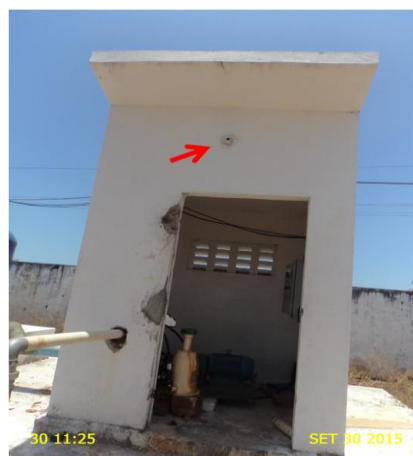
Foto 7 – Poço na área do REL-02: ausência de identificação e iluminação.
