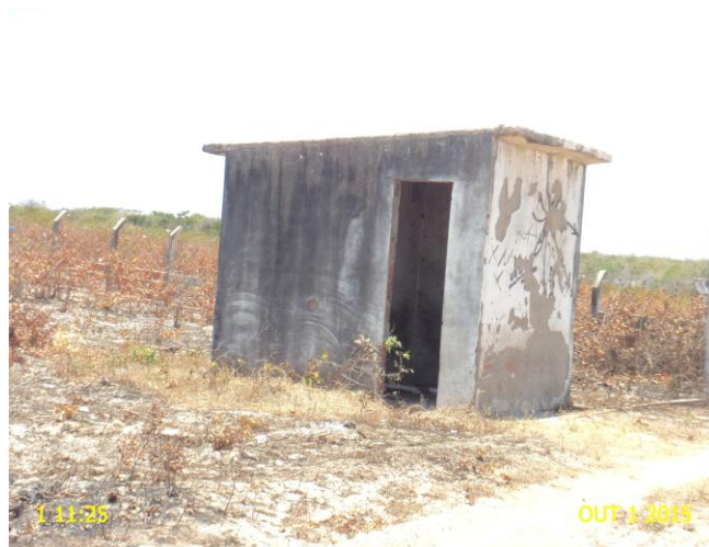
Foto 19 – ETE: edificação de apoio com estrutura deteriorada.
