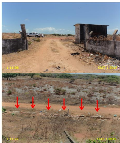
Foto 18 – ETE: ausência de identificação e muro delimitador danificado.
