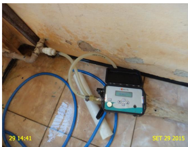
Foto 34 – Aparelho datalogger instalado no endereço localizado na Rua Luiz Mulato, nº 302.
