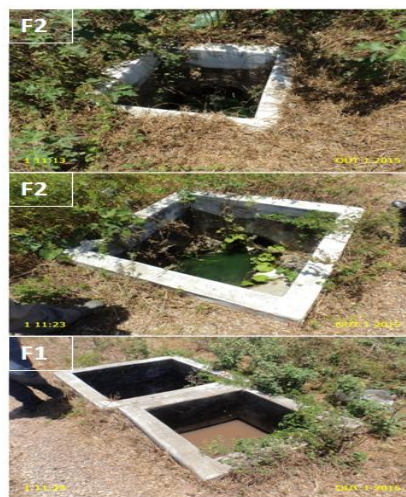
Foto 25 – ETE: poços de inspeção sem tampa nas lagoas facultativas F1 e F2.
