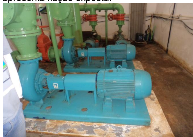
Foto 11 – EELF-01 e EEAT-01: ausência de identificação.
