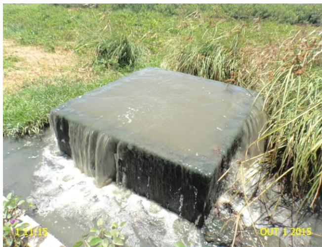
Foto 20 – ETE: caixa de recepção do esgoto bruto obstruída.
