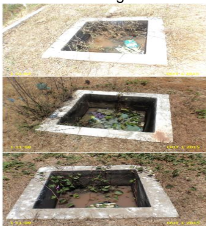
Foto 26 – ETE: poços de inspeção sem tampa na lagoa de maturação.
