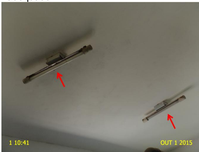
Foto 16 – EEE-01: ausência de iluminação.
