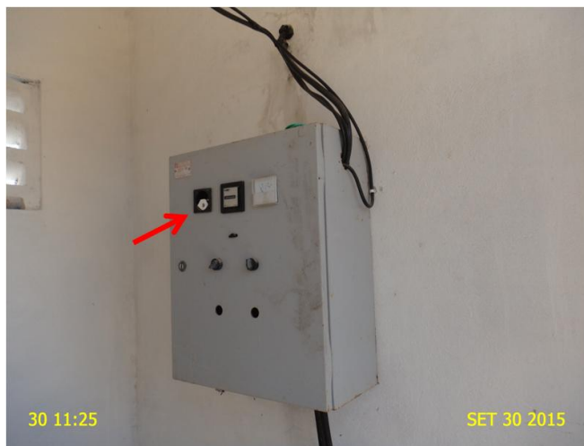
Foto 1 – QC do PT na área do REL-02: ausência de amperímetro.
