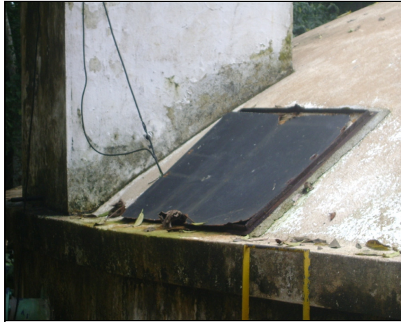
Foto 35 – RAP-06: tampa em estado avançado de corrosão e sem fixação.
