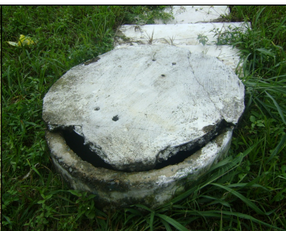
Foto 41 – Caixa de ventosa com tampa danificada no trecho da adutora entre Queimada e o RAP-05.
