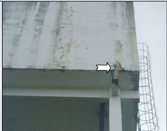
Foto 18 – REL-06: vazamento na laje de fundo.
