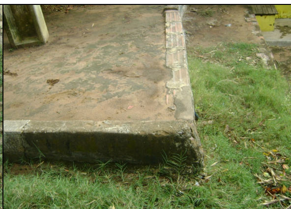
Foto 48 – Local do registro de descarga na Rua SDO 34: soterrado.
