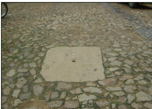
Foto 45 – Caixa de inspeção de registro de descarga na Rua SDO 37 com Rua 10 de Novembro.
