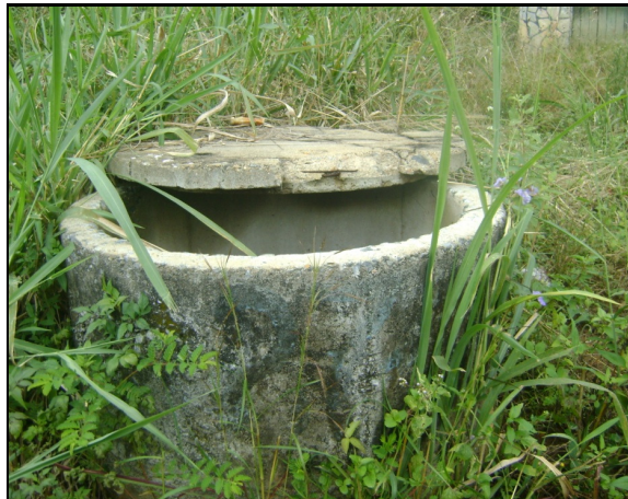
Foto 42 – Caixa de ventosa com tampa danificada no trecho da adutora entre o RAP-05 e o RAP-06
