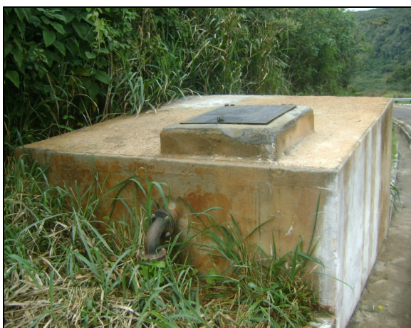
Foto 38 – Caixa de quebra de pressão na adutora que abastece o REL-Quatiguaba.
