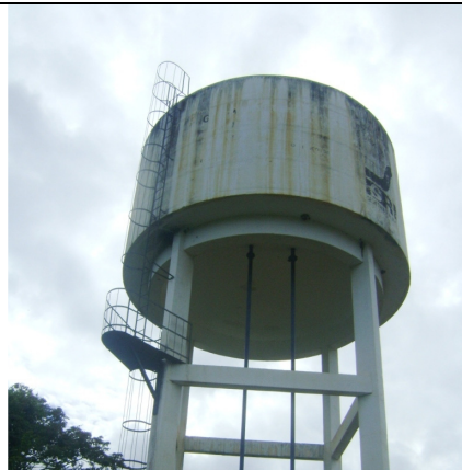
Foto 6 – REL-Quatiguaba: ausência de identificação e de guarda-corpo, e pintura deteriorada.
