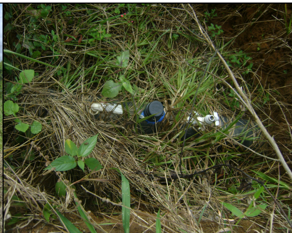
Foto 30 – RAP-05: macromedidor proporcional sem caixa de inspeção e tomado pela vegetação.
