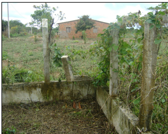
Foto 21 – REL-07: cerca de proteção danificada e inadequadas condições de limpeza e manutenção da área.
