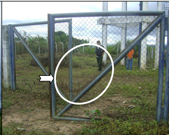
Foto 12 – REL-06: portão de acesso danificado.
