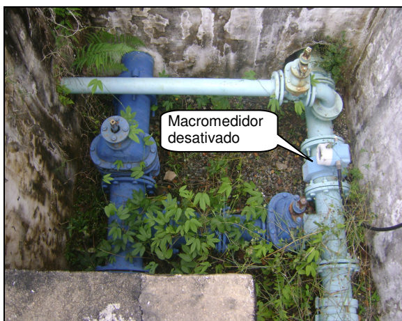
Foto 31 – RAP-05: dispositivos com caixa de inspeção sem tampa ou grade.
