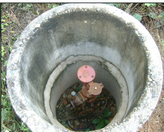
Foto 39 – Caixa de ventosa sem tampa na adutora que abastece o REL-Quatiguaba.
