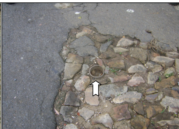
Foto 46 – Registro de descarga na Rua João Benício Fontenele, 66: sem caixa de inspeção e proteção.
