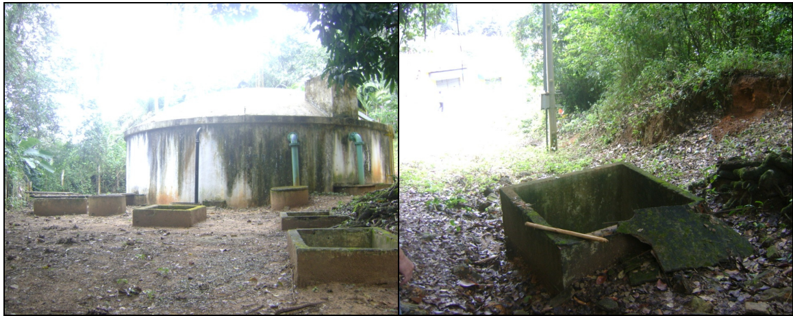
Fotos 36 e 37 – RAP-06: dispositivos com caixa de inspeção sem tampa ou grade.
