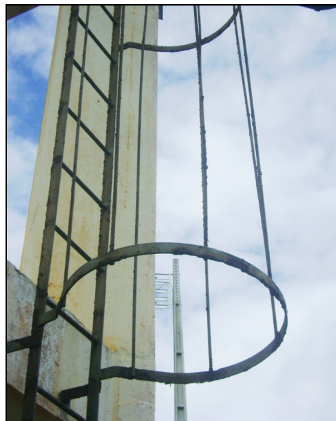
Foto 10 – REL-Quatiguaba: escada de acesso apresentando corrosão.
