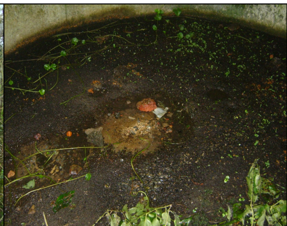
Foto 22 – REL-07: área sob a laje de fundo do reservatório apresentando-se inundada e suja.
