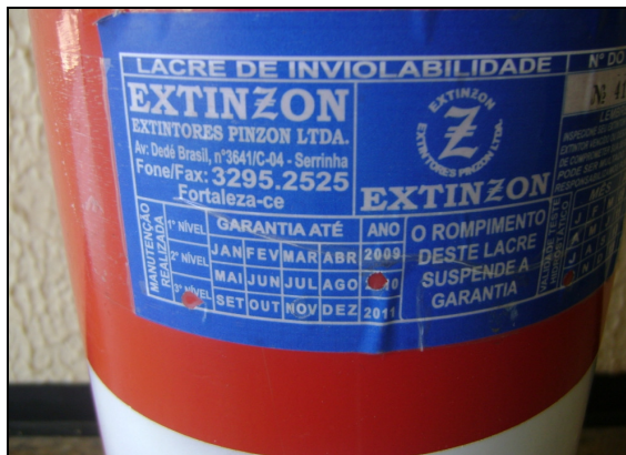
Foto 52 – Extintor de incêndio apresentando prazo de validade expirado no escritório.
