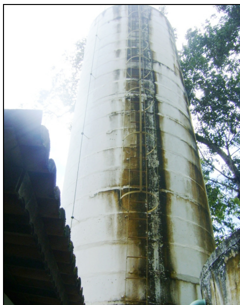
Foto 26 – REL-08: pintura deteriorada.
