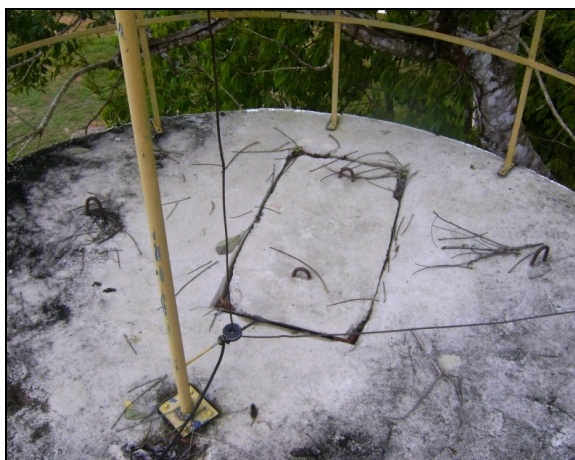
Foto 27 – REL-08: laje de cobertura. Ausência de tubulação de ventilação.
