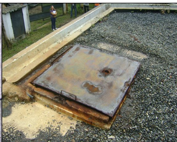
Foto 32 – RAP-05: tampa de inspeção em estado avançado de corrosão.
