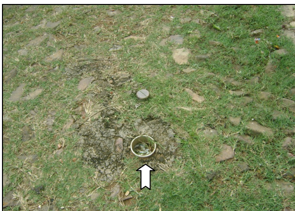
Foto 47 – Registro de descarga na Rua SDO 33, 108: sem caixa de inspeção e proteção.
