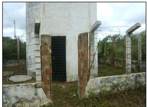
Foto 20 – REL-07: ausência de portão de acesso.
