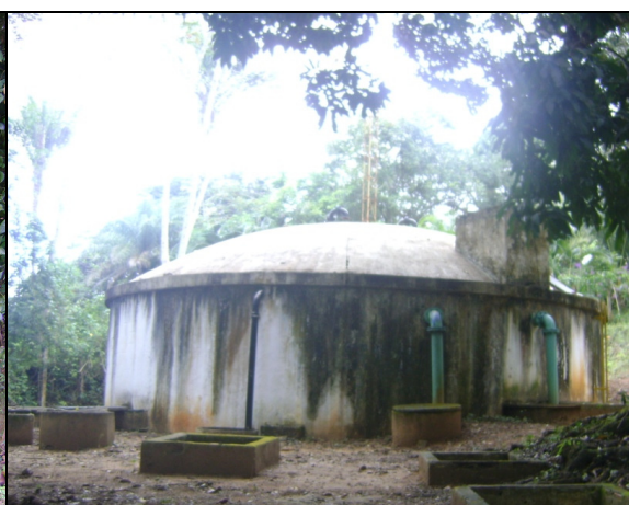
Foto 34 – RAP-06: ausência de identificação e pintura deteriorada.
