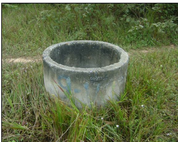
Foto 40 – Caixa de ventosa sem tampa no trecho da adutora entre Quatiguaba e Inharim.
