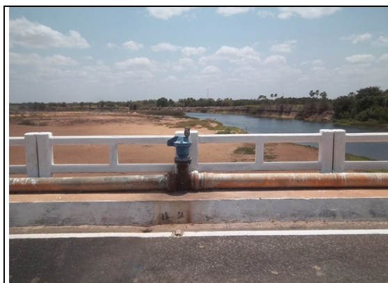
Foto 30 – Adutora de água tratada; Ventosa.
