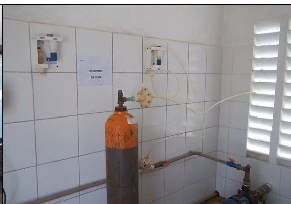
Foto 20 Cilindros de cloro gasoso.
