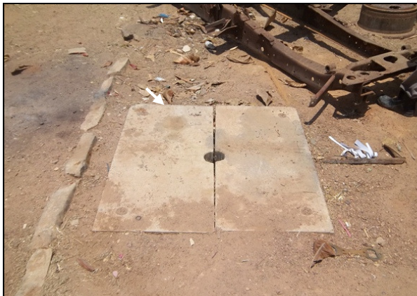
Foto 44 – Registro de descarga localizado na Rua Augustinho Ferreira Lima.
