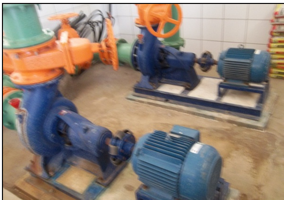
Foto 33 – EELF-01: Conjunto moto-bomba.
