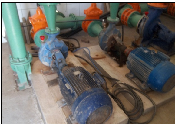
Foto 31 – EEAT-01: Conjunto moto-bomba.
