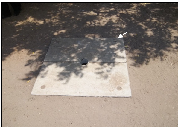
Foto 46 – Registro de descarga localizado na Vila Pontal.
