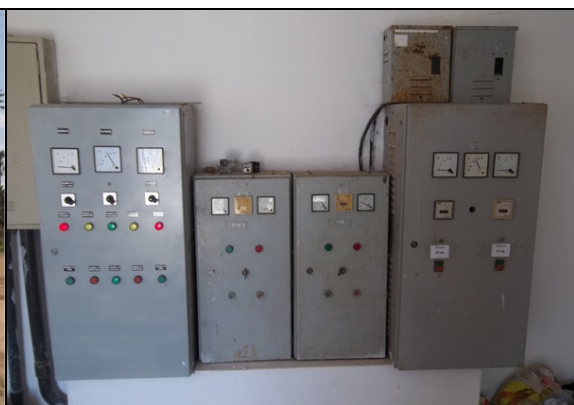
Foto 8 – Quadros de comando dos poços PT-01, PT-02, PT-03, PT-04, PA-01 e PA-02.
