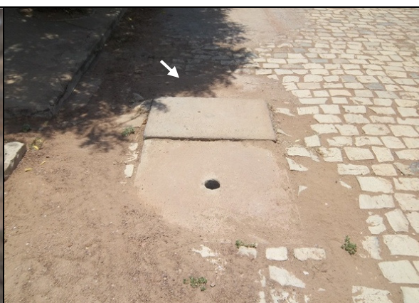
Foto 49 – Registro de descarga localizado na Rua Augustinho Ferreira Lima.
