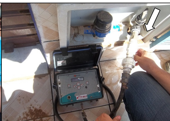
Foto 51 – Medição de pressão na Rua Marechal Manoel Cunha, nº 9.156, Centro.
