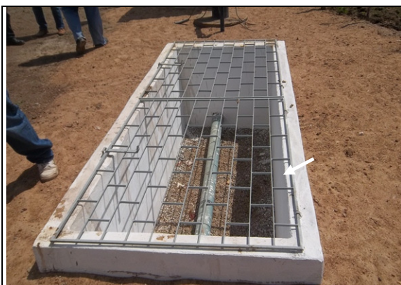
Foto 26 – Adutora de água bruta: caixa de proteção sem macromedição, localizado na saída do PT-03.
