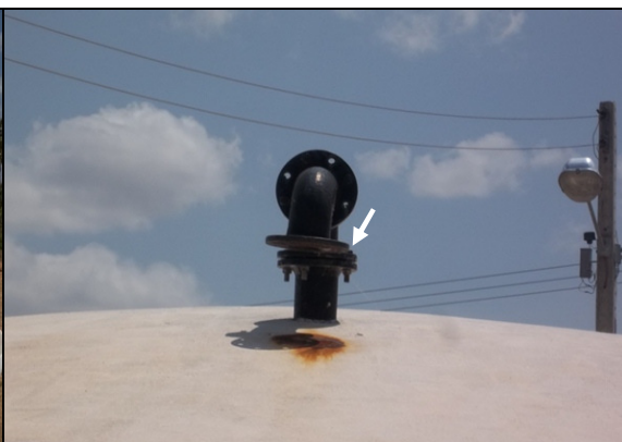
Foto 36 – RAP-01: Ausência de tela de proteção na tubulação de ventilação.
