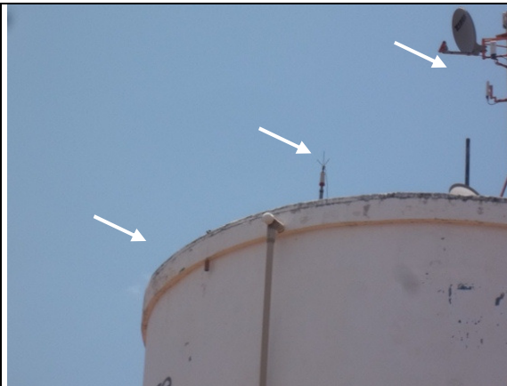
Foto 39 – REL-01: Existência de pára-raio e sinalizador noturno, e ausência de guarda-corpo na laje superior.
