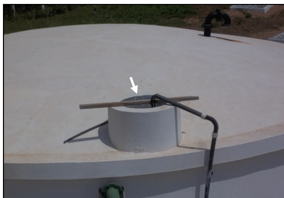
Foto 37 – RAP-01: Ausência de tampa de inspeção.
