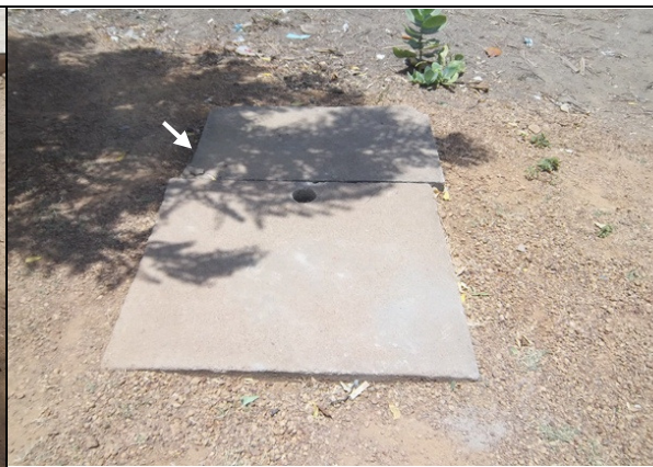
Foto 43 – Registro de descarga localizado na Rua Manoel Cunha.
