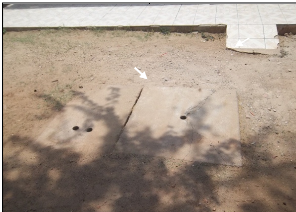
Foto 42 – Registro de descarga localizado na Rua Manoel Cunha.
