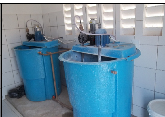
Foto 22 – Tanques de mistura de produtos químicos.
