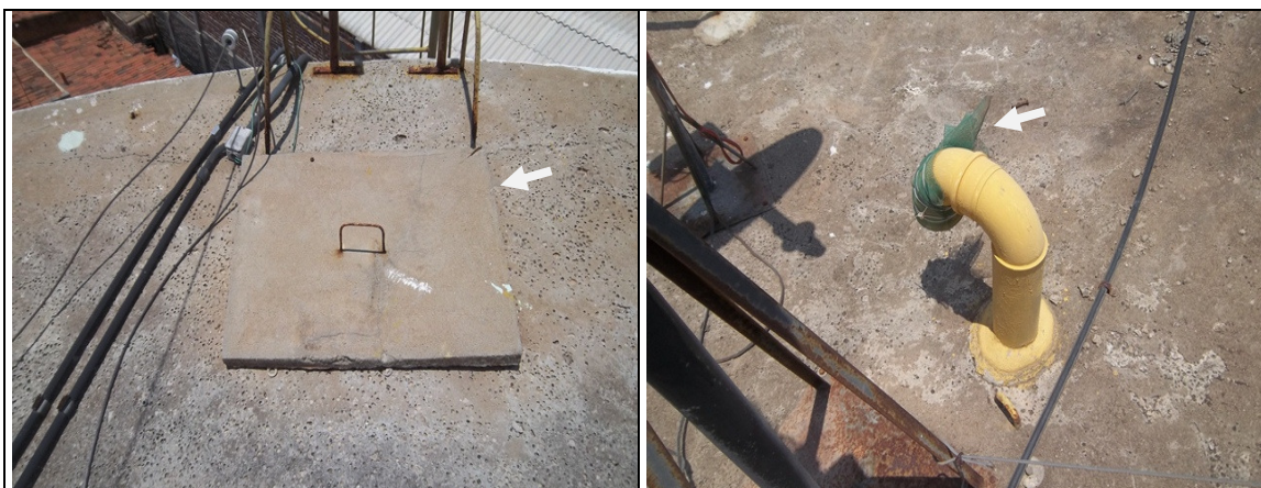
Foto 40 – REL-01: Tampa de inspeção comprometida pela corrosão.
