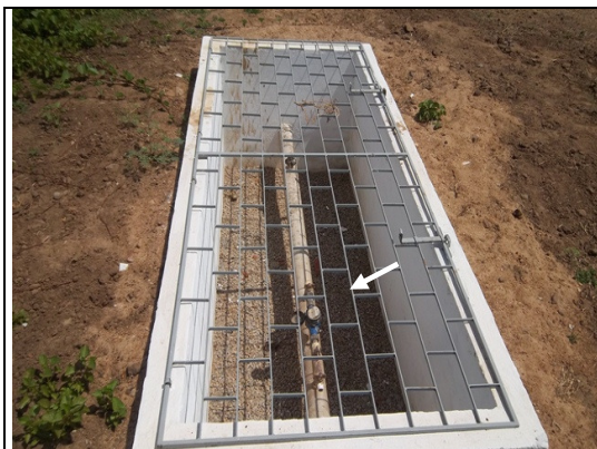
Foto 24 – Adutora de água bruta: caixa de proteção do medidor proporcional, localizado na saída do PT-01.
