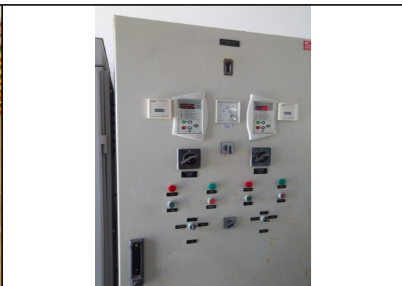
Foto 34 – EELF-01: Quadro de comando.
