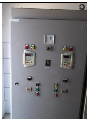
Foto 32 – EEAT-01: Quadro de comando.
