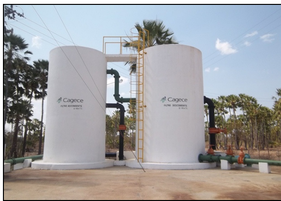
Foto 12 – ETA: Filtros 01 e 02.
