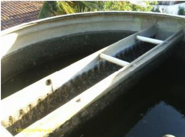
Foto 2 – Filtro F-01: ausência de tampa de inspeção.
