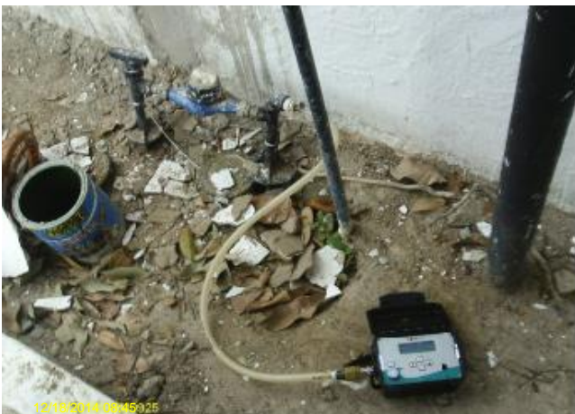
Foto 1 – RDA: medição contínua de pressão na ETA-Tapuiará (CAGECE).
