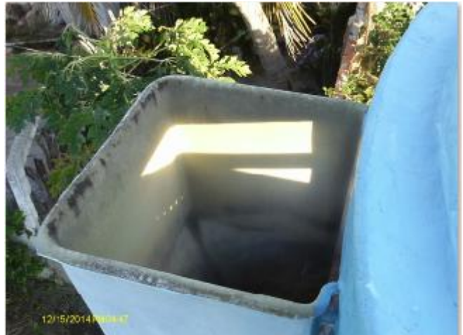
Foto 3 – Filtro F-01: ausência de tampa de inspeção na calha de água.
