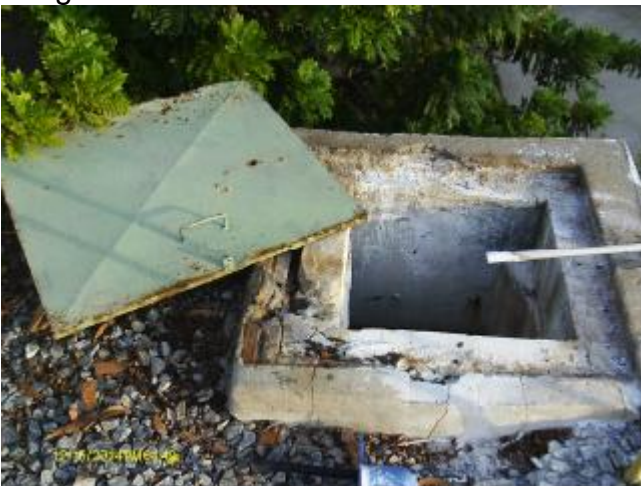
Foto 10 – RSE–02: tampa de inspeção em processo de corrosão e em inadequadas condições de vedação.
