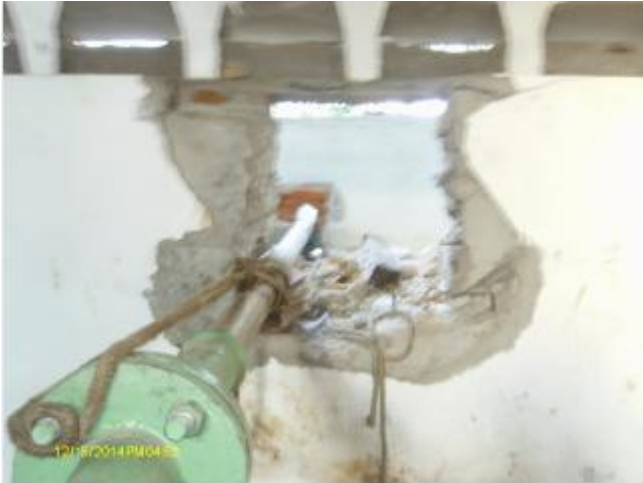
Foto 8 – EEAT–01: estrutura da casa de abrigo das bombas deteriorada.
