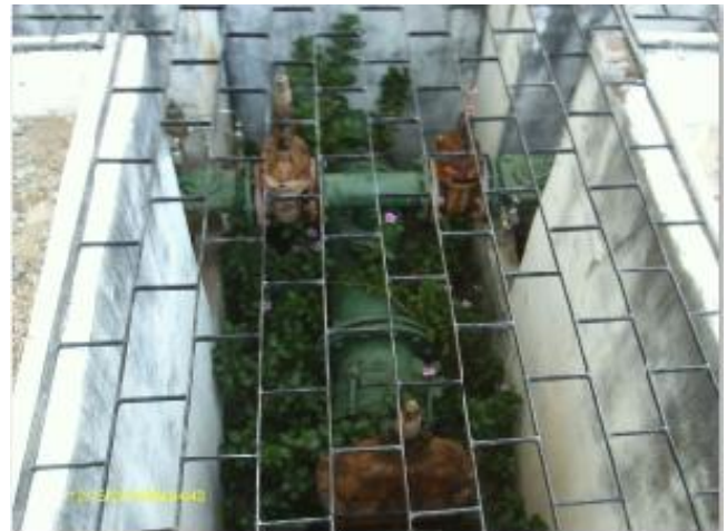
Foto 5 – ATT: excesso de vegetação na caixa de inspeção.
