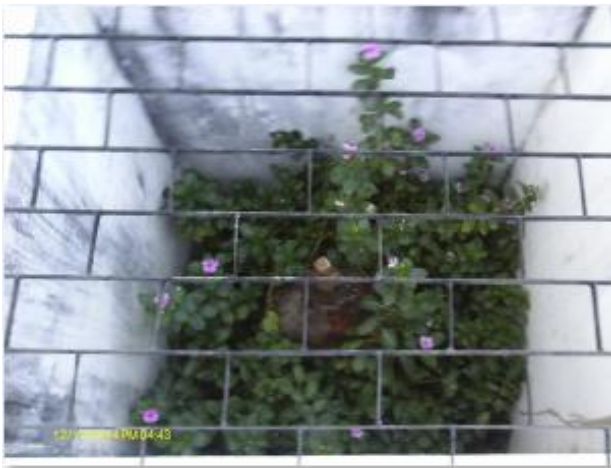
Foto 4 – ATT: excesso de vegetação na caixa de inspeção.
