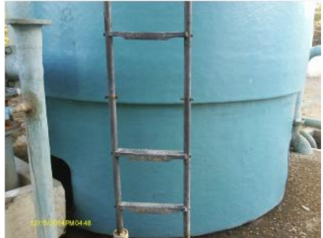
Foto 9 – Filtro F–01: escada de acesso danificada.
