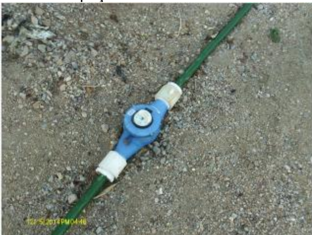
Foto 6 – AAT: Medidor sem caixa de proteção.
