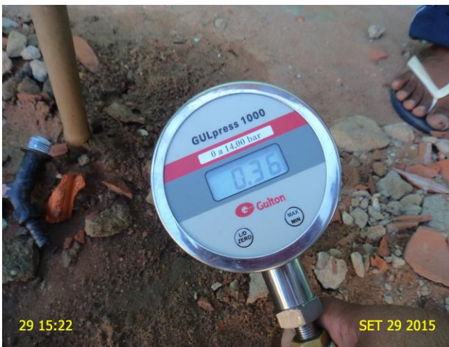
Foto 10 – Medição de pressão Rua SDO 26 (Igreja).
