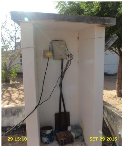
Foto 1 – PT-01: ausência de iluminação, de amperímetro e voltímetro no QC e fiação exposta.
