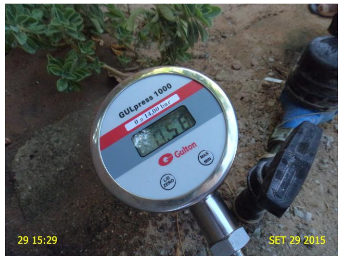
Foto 11 – Medição de pressão Rua Antônio Alves do Nascimento, s/n.
