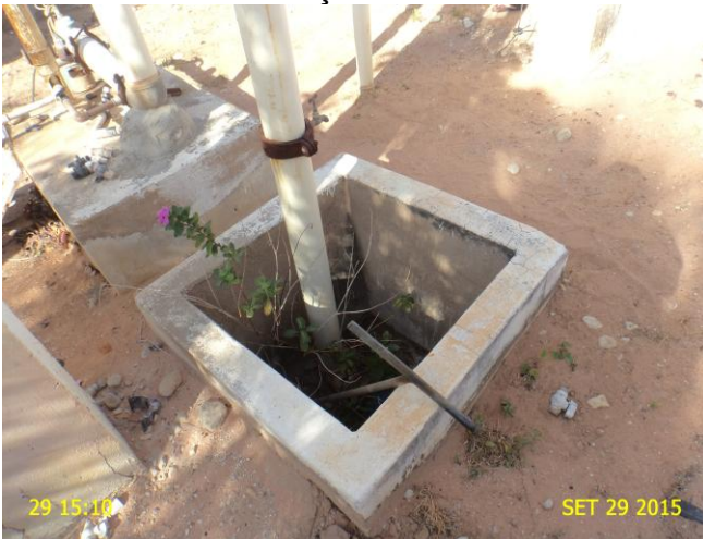
Foto 7 – REL-01: caixa de inspeção sem tampa ou grade de proteção.
