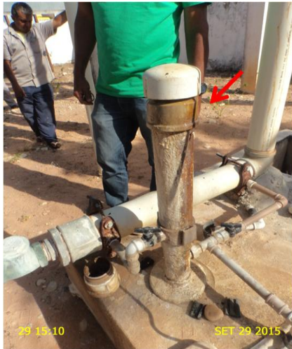
Foto 3 – PT-01: clorador de pastilha com vazamento.
