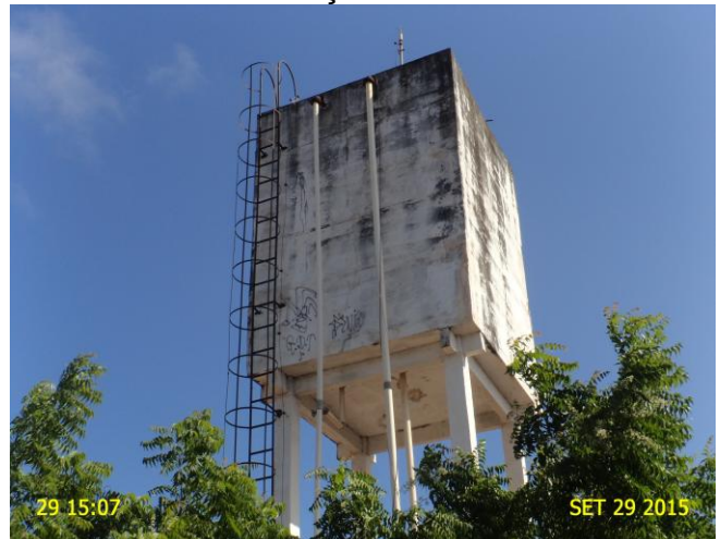
Foto 8 – RAP-01: pintura deteriorada.
