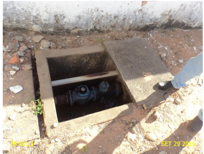
Foto 4 – ETA: macromedidor de saída sem tampa ou grade de proteção.
