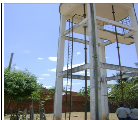
Foto 3 – Escada do REL-03, sem gaiola protetora
