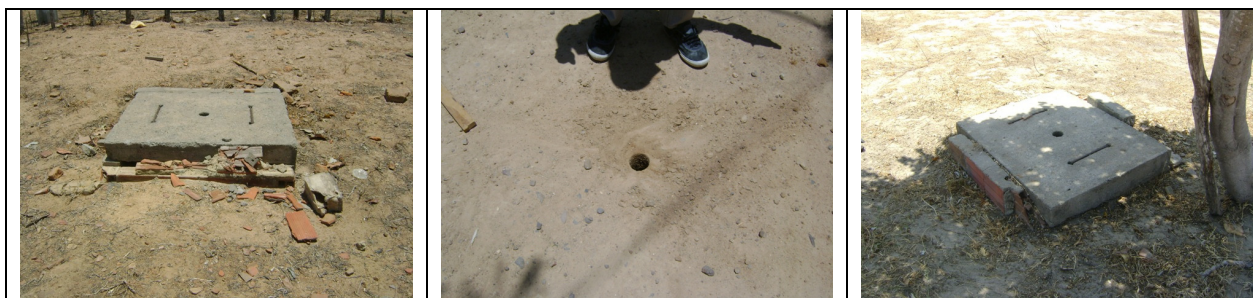
Fotos 15 a 17 – Registros de descarga nas Ruas Severiano Souza e Padre Heleno e Av. 23 de Agosto
