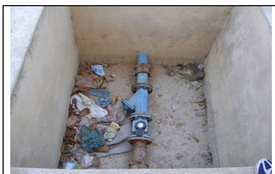
Foto 11 – Macromedidor na entrada do RAP-04
