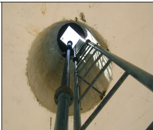
Foto 7 – REL-04: sem tampa na laje superior
