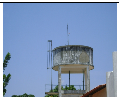
Foto 4 – REL-03: sem guarda-corpo na laje de cobertura
