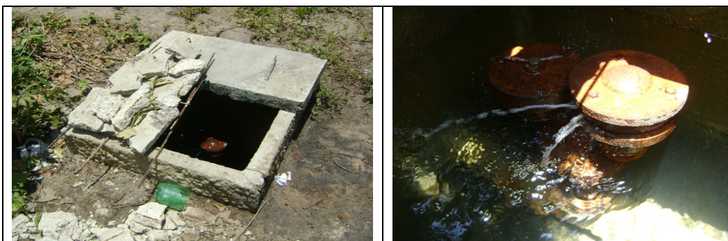
Fotos 12 e 13 – Caixa de proteção danificada e ventosa com vazamento na adutora de água tratada
