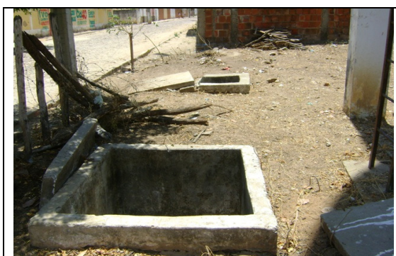
Foto 5 – Área do REL-03, com as caixas de registros sem tampas
