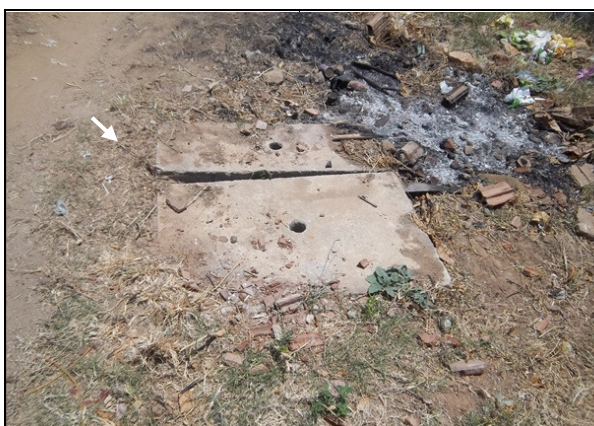
Foto 29 – Registro de descarga localizado na Rua Mel Queiroz.
