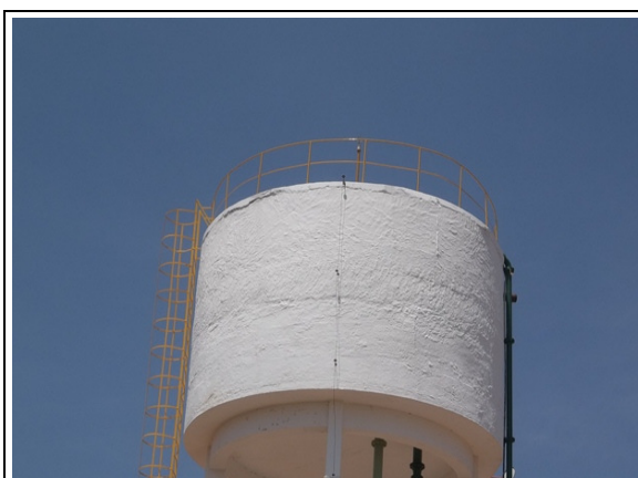
Foto 18 – REL-01: Ausência de identificação.
