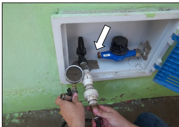
Foto 35 – Medição de pressão na Rua Senador Fernando Távora, n° 795, Bairro José Nogueira.
