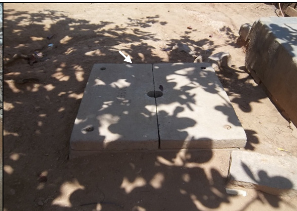
Foto 26 – Registro de descarga localizada na Rua Manoel Valentim Freitas.
