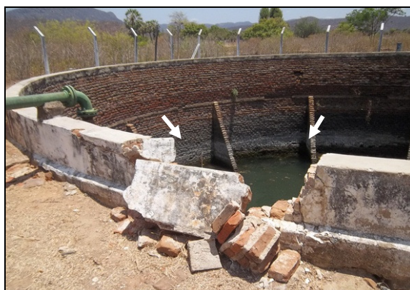
Foto 6 – Poço PA-01: Beiral de proteção danificado.
