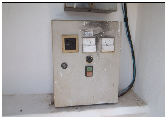
Foto 3 – Poço PT-01: Quadro de comando.
