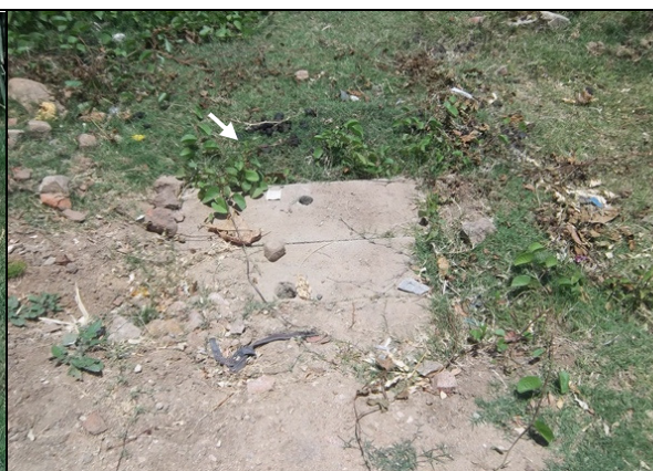
Foto 28 – Registro de descarga localizado na Rua Capitão Teotônio.
