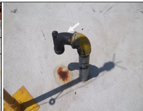
Foto 21 – REL-01: Tubulação de ventilação sem tela de proteção.
