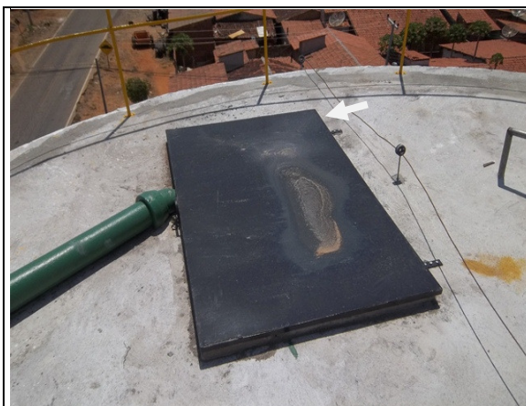
Foto 20 – REL-01: Tampa de inspeção adequada.
