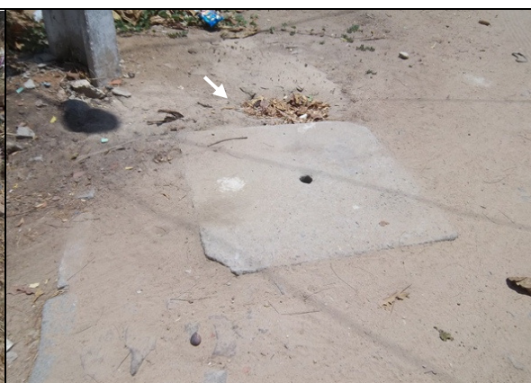
Foto 30 – Registro de descarga localizado na Rua Cícero Catingueira.
