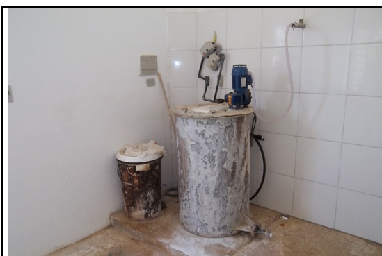
Foto 9 – Bomba dosadora de cloro.
