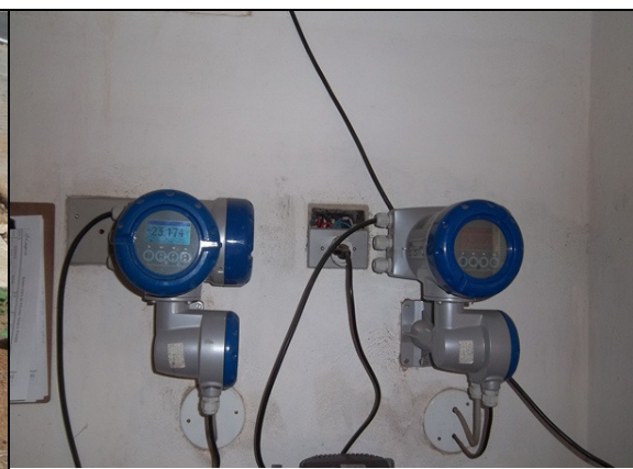
Foto 17 – Registros de leitura dos macromedidores - localizados no escritório de atendimento do SAA de Ererê.
