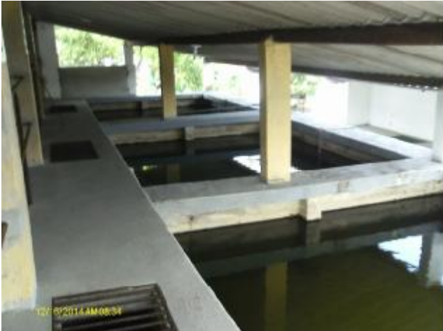
Foto 12 – ETA – Filtração: ausência de guarda-corpos nas instalações dos Filtros 04, 05 e 06.
