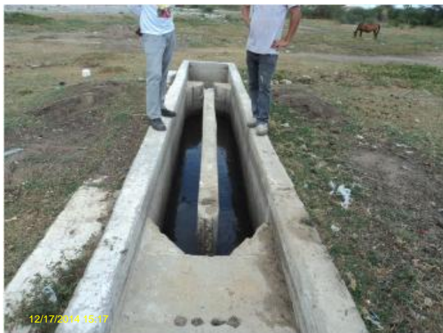
Foto 6 – ETE Campo Novo: ausência de gradeamento.
