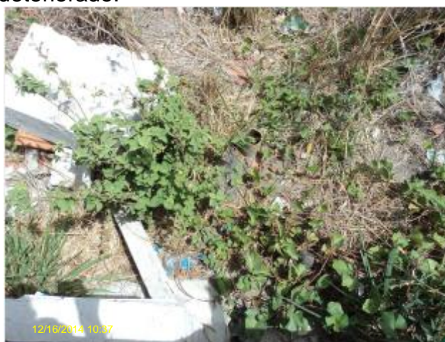
Foto 58 – RDA: registro de descarga sem caixa na Rodovia do Contorno.
