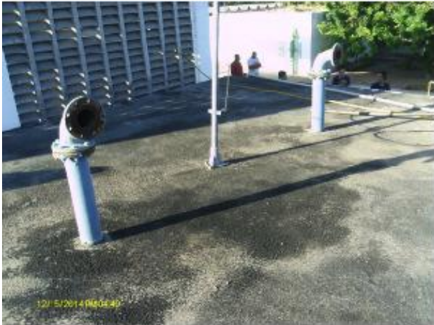
Foto 71 – RSE-01: tubulação de ventilação sem tela de proteção.
