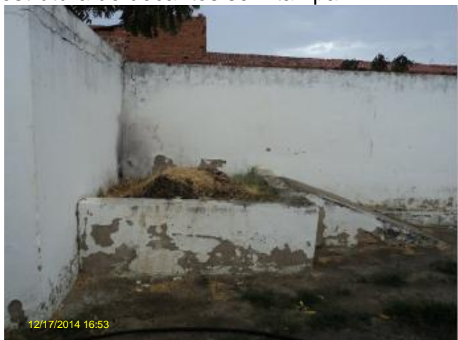
Foto 27 – EEE 06 (Carrascal): leito de secagem necessitando de limpeza.
