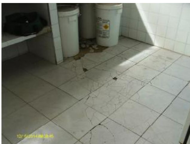
Foto 55 – ETA – Laboratório: piso deteriorado.
