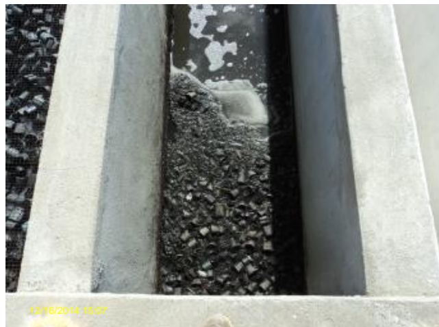
Foto 48 – ETE Herval: acúmulo de lodo e materiais no filtro submerso aerado.
