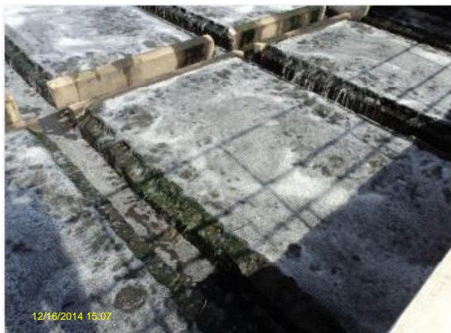
Foto 47 – ETE Herval: acúmulo de lodo no filtro submerso aerado.
