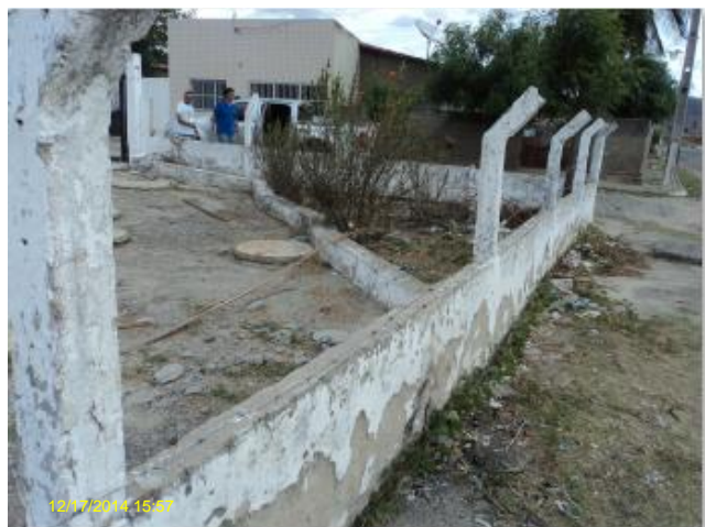
Foto 45 – ETE COHAB: cerca danificada.
