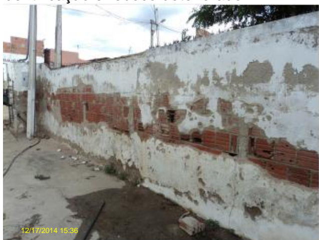
Foto 32 – EEE Sem Terra: parede com pintura e reboco deteriorados.
