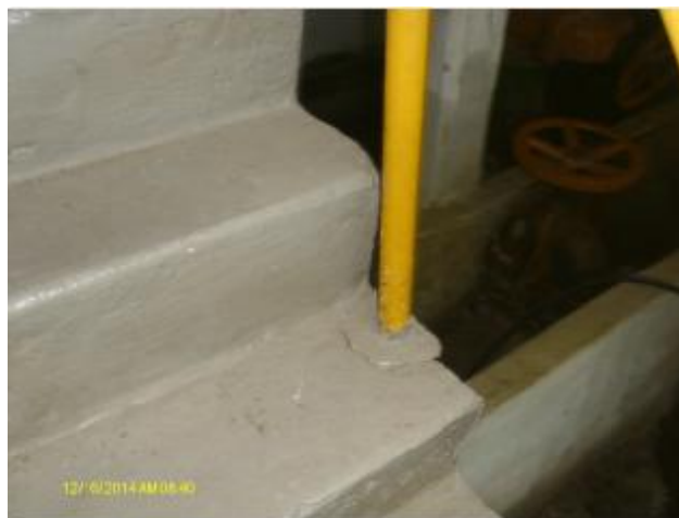
Foto 54 – ETA – Filtração: guarda-corpo sem fixação na base da escada nas instalações dos Filtros 01, 02 e 03.
