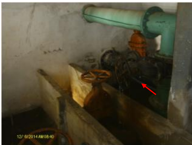
Foto 53 – ETA – Filtração: vazamento no registro do Filtro 01.
