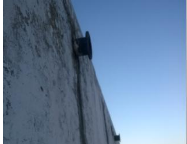
Foto 72 – RAP-01 (Fazenda Japão): tubulações de ventilação sem tela de proteção.
