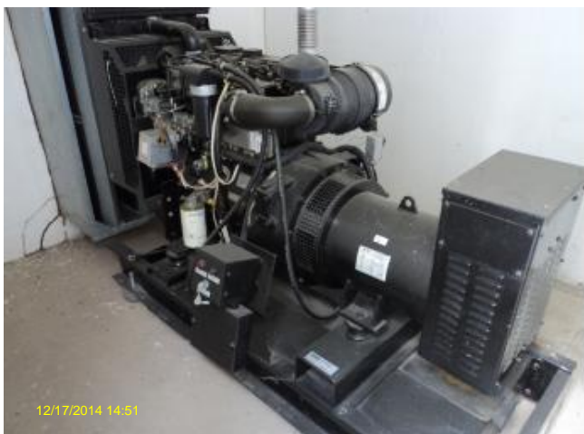
Foto 13 – EEE 04 (Mãe Domingos): grupo gerador de energia elétrica com bateria descarregada.
