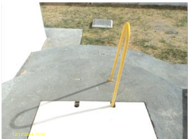
Foto 29 – EEE 08 (Baviera): escada de acesso ao poço de sucção danificada.
