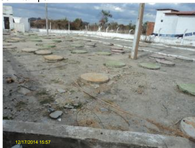
Foto 44 – ETE COHAB: condições de conservação.
