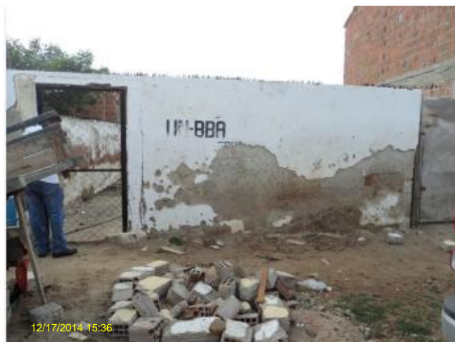
Foto 30 – EEE Sem Terra: ausência de identificação e reboco deteriorado.
