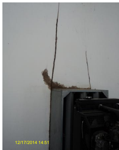
Foto 24 – EEE 04 (Mãe Domingos): presença de cupins na parede.
