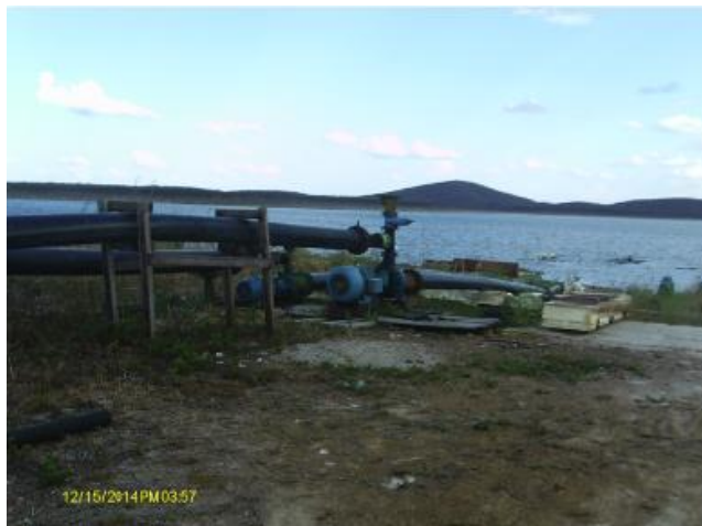
Foto 73 – Captação: ausência de sinalização identificando a área como destinada ao abastecimento público.
