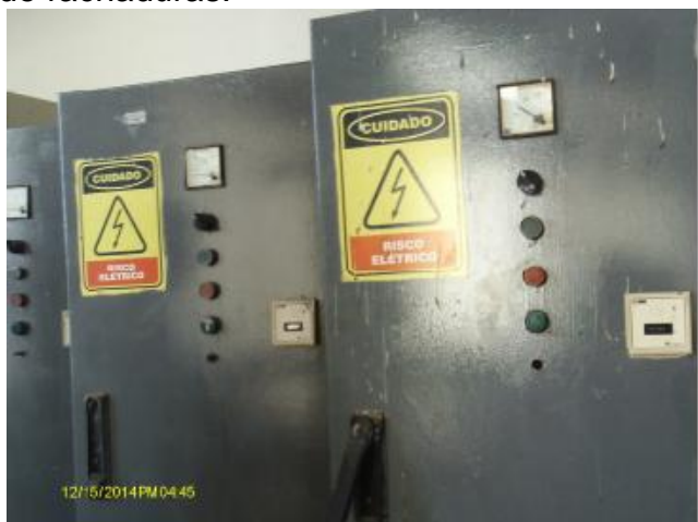
Foto 19 – EEAB-01: ausência de identificação.
