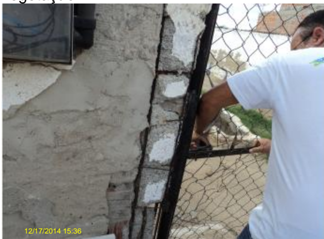
Foto 33 – EEE Sem Terra: portão de entrada danificado.
