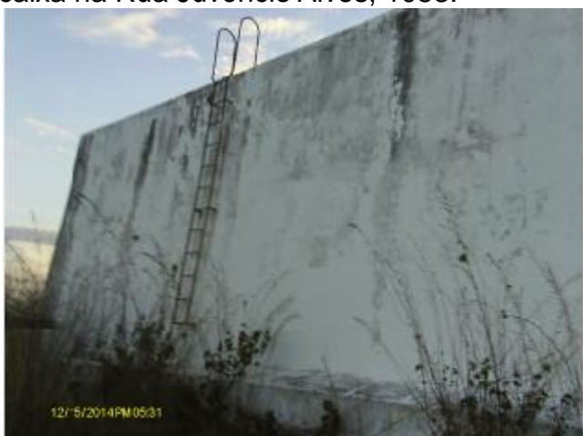
Foto 63 – RAP-01 (Fazenda Japão): pintura deteriorada e ausência de identificação.
