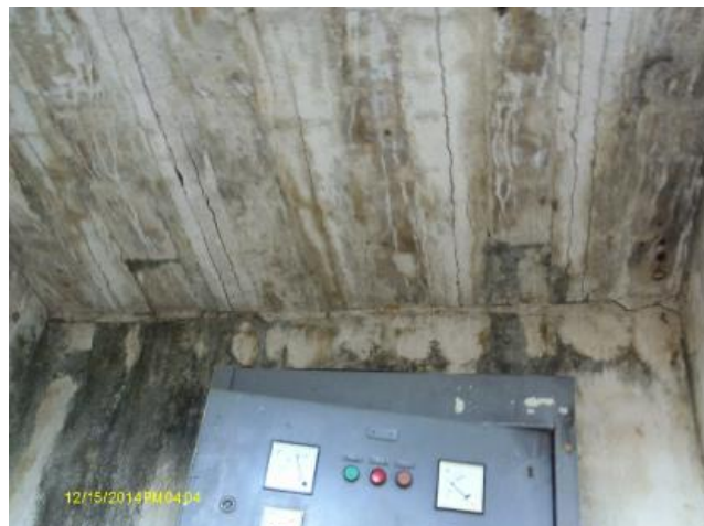
Foto 18 – EECS-02: casa de abrigo do quadro de comando com pintura deteriorada e presença de rachaduras.
