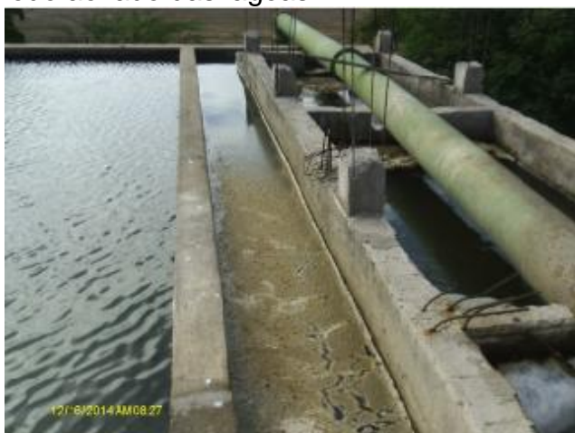
Foto 10 – ETA – Decantador: ausência de passarelas com guarda-corpos.
