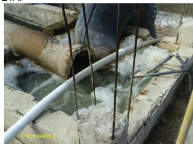
Foto 52 – ETA – Decantador: presença de espuma.
