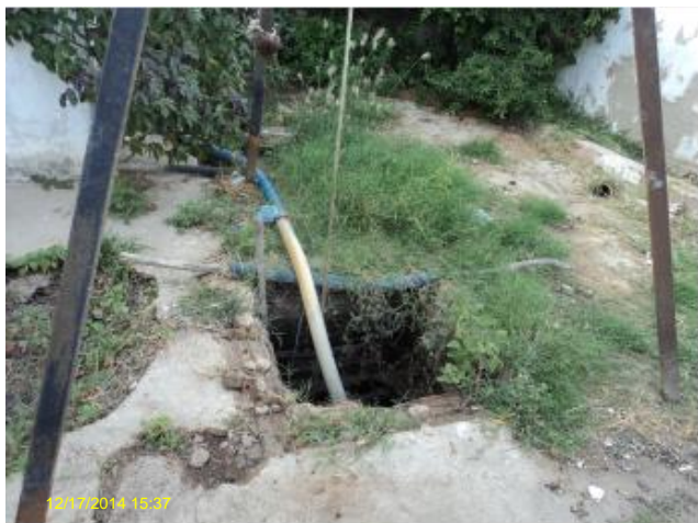
Foto 35 – EEE Sem Terra: poço de sucção sem tampa.
