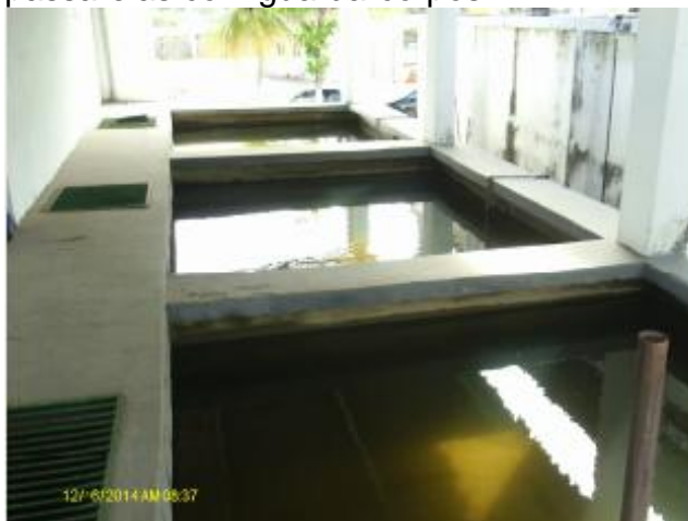
Foto 11 – ETA – Filtração: ausência de guarda-corpos nas instalações dos Filtros 01, 02 e 03.
