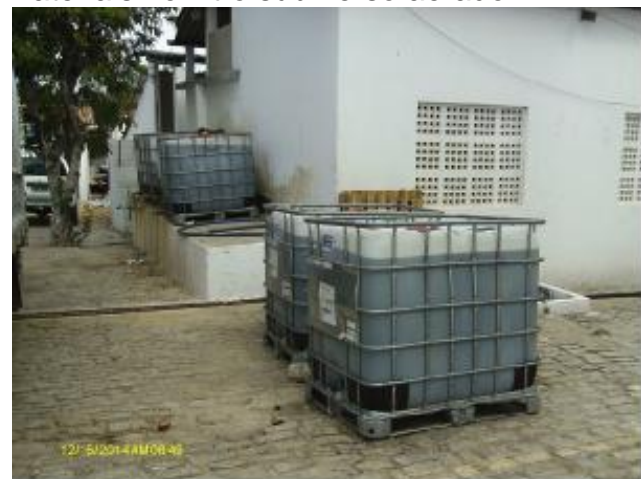
Foto 50 – ETA – Casa de Química: produtos químicos armazenados ao ar livre na área da ETA.
