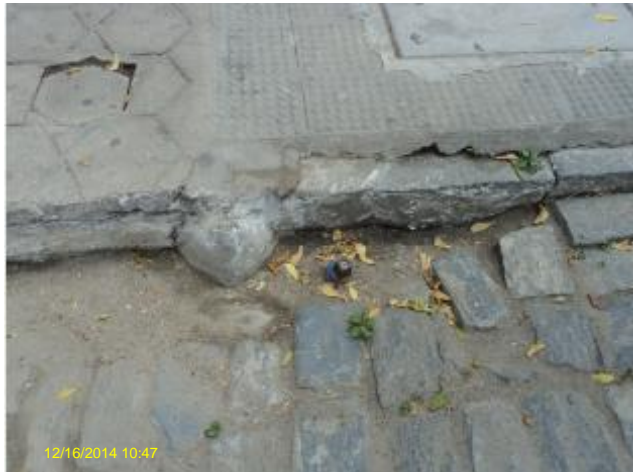
Foto 60 – RDA: registro de descarga sem caixa na Rua José Jucá, nº 527
