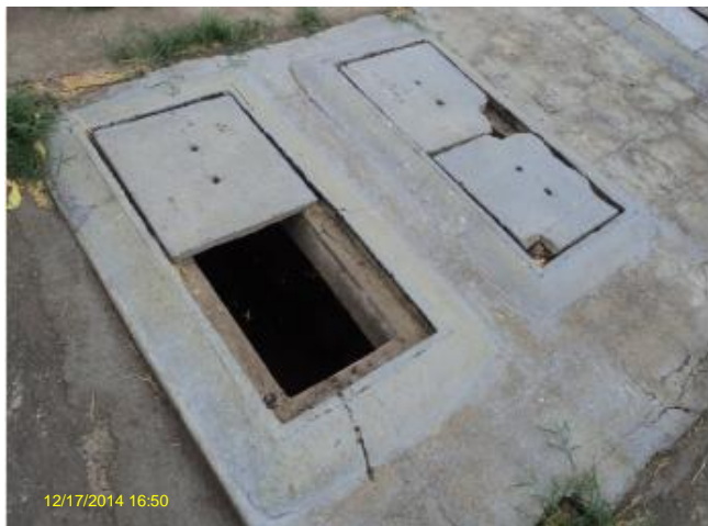
Foto 25 – EEE 06 (Carrascal): antiga estrutura de decantação sem tampa.
