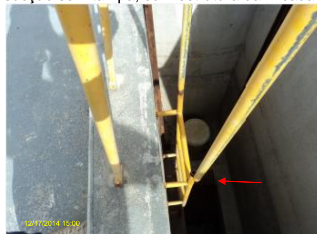
Foto 28 – EEE 08 (Baviera): escada de acesso ao tratamento primário danificada.
