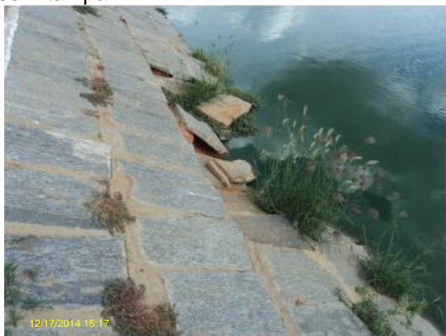
Foto 37 – ETE Campo Novo: talude deteriorado na lagoa de maturação 2.
