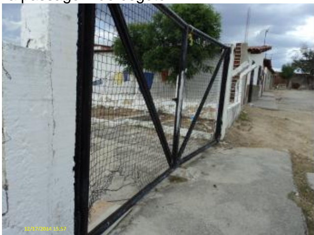
Foto 43 – ETE COHAB: portão danificado.
