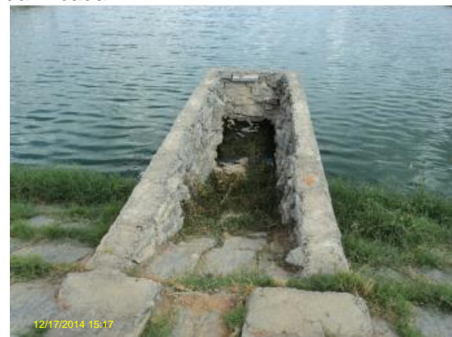
Foto 38 – ETE Campo Novo: estrutura de saída do esgoto na lagoa de maturação 2 deteriorada.
