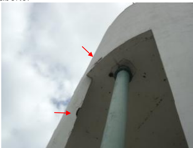
Foto 68 – REL-01: estrutura deteriorada com armadura exposta.
