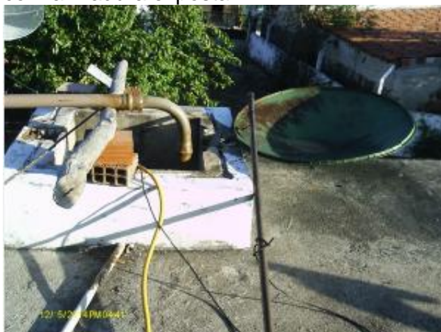
Foto 70 – RSE-01: tampa de inspeção inadequada.
