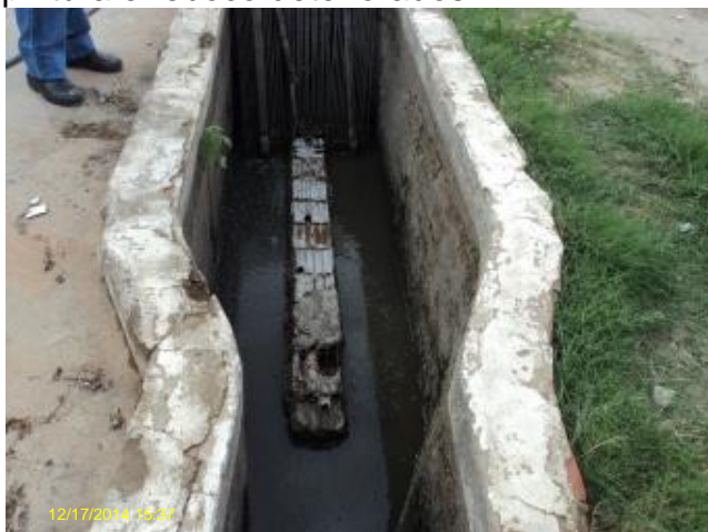
Foto 34 – EEE Sem Terra: caixa de areia em mau estado de conservação.
