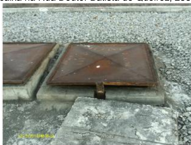
Foto 64 – RAP-01 (Fazenda Japão): tampa apresentando corrosão e sem vedação.
