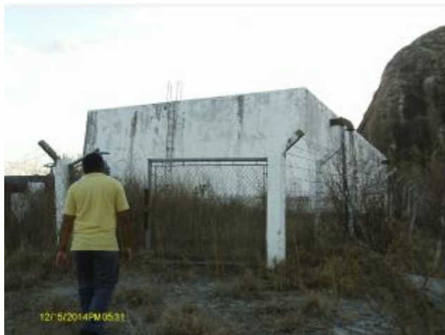
Foto 65 – RAP-01 (Fazenda Japão): excesso de vegetação.
