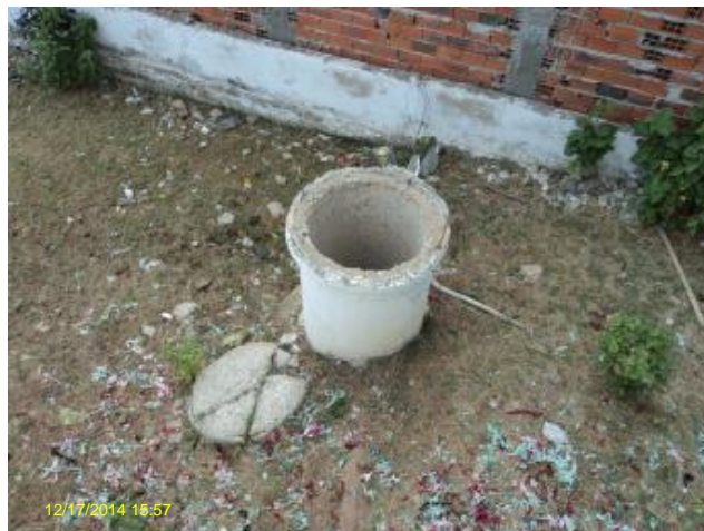
Foto 42 – ETE Chico Braz: poço de saída sem tampa.
