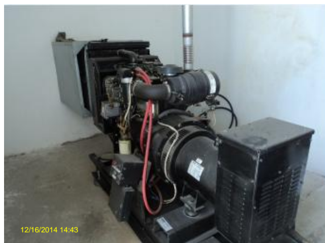
Foto 14 – EEE 05 (São João): grupo gerador de energia elétrica com bateria descarregada.
