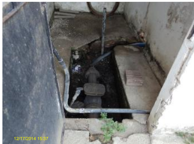
Foto 36 – EEE Sem Terra: casa de abrigo danificada.
