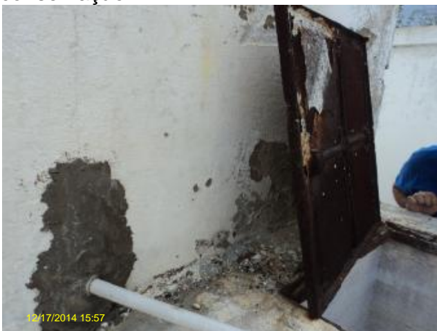
Foto 46 – ETE COHAB: tampa do tanque de armazenamento do produto para desinfecção apresentando corrosão.
