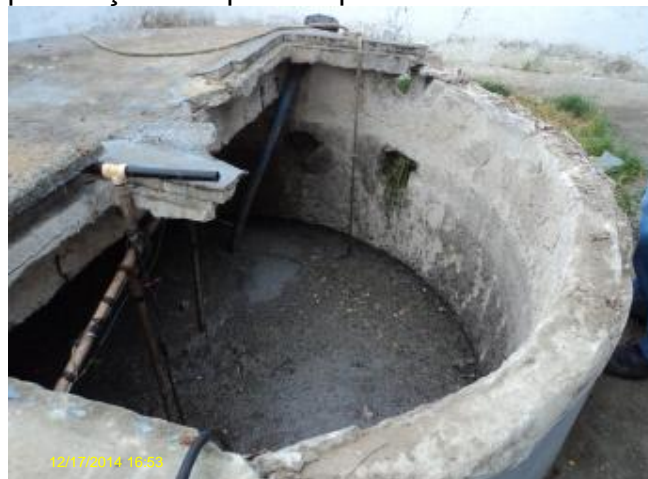
Foto 26 – EEE 06 (Carrascal): poço de sucção sem tampa, com estrutura danificada.
