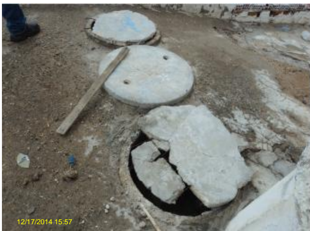
Foto 41 – ETE Chico Braz: tampa quebrada na passagem do esgoto.
