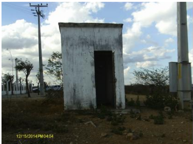
Foto 17 – EECS-02: Ausência de identificação, casa de abrigo do quadro de comando com pintura deteriorada e presença de rachaduras.
