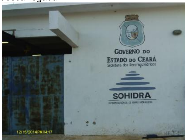
Foto 16 – EECS-01 e EEAB-02: ausência de identificação.
