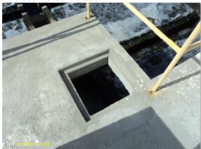
Foto 49 – ETE Herval: local de inspeção sem tampa no filtro submerso aerado.
