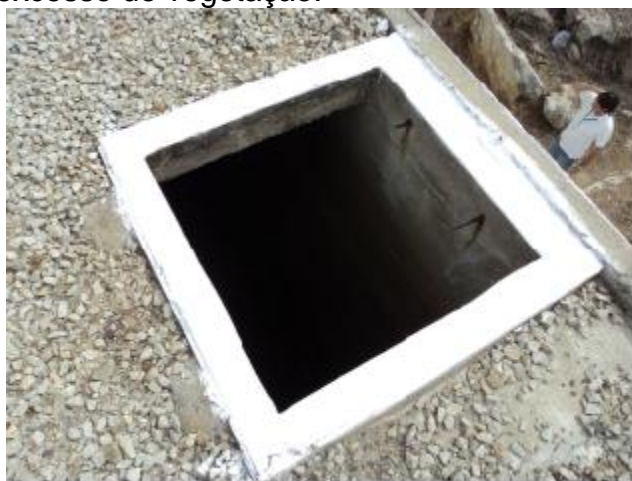
Foto 67 – RAP-02: ausência de tampa de inspeção.
