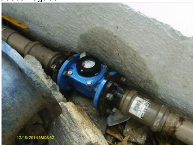
Foto 15 – ATT: macromedidor com vazamento.
