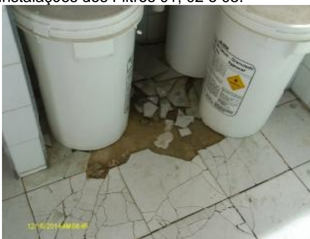
Foto 56 – ETA – Laboratório: piso deteriorado.
