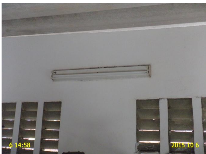
Foto 13 - Booster Picos I (EERD-03): lâmpada com defeito.
