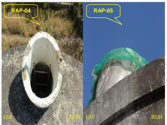
Foto 7 - RAP-04 e RAP-05: ausência de tampa de inspeção.
