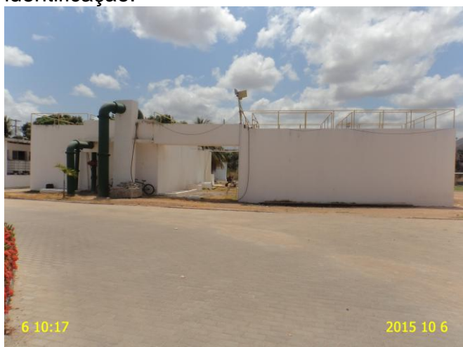
Foto 11 - Decantadores: ausência de identificação.
