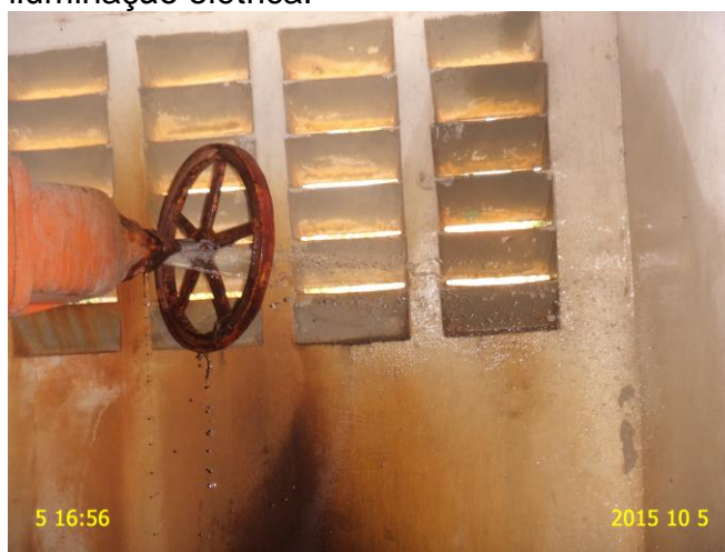
Foto 16 - EEPR-01: vazamento no registro.
