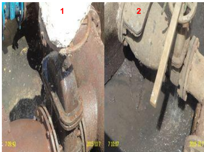
Foto 18 - EEE-01 (1) e EEE-03 (2): vazamento no registro.
