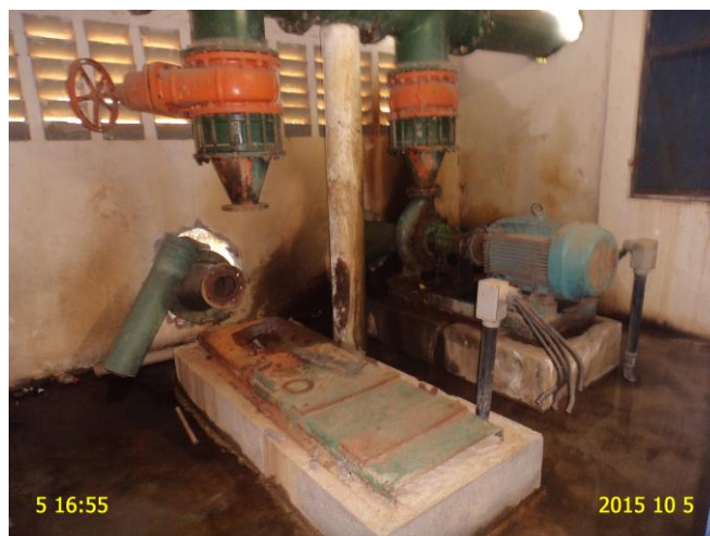
Foto 4 - EEPR-01 (Poço Verde): ausência de bomba reserva instalada.
