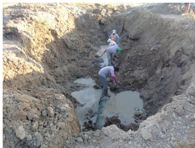
Foto 2 - AAB-02: Ocorrência operacional nº 000030/UNBCL - Retirada de vazamento na adutora do Açude Gameleira.
