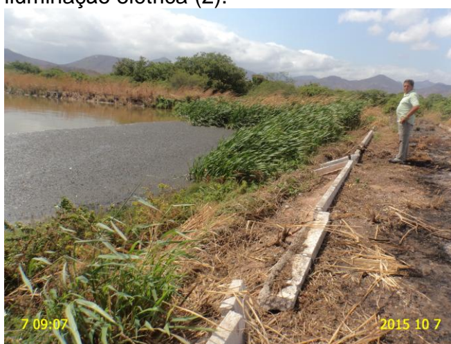
Foto 24 - ETE LF: acúmulo de sobrenadantes.
