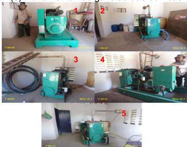
Foto 17 - EEE-01 (1), EEE-02 (2), EEE-03 (3), EEE-04 (4) e EEE-05 (5): grupos geradores de energia elétrica com defeito.
