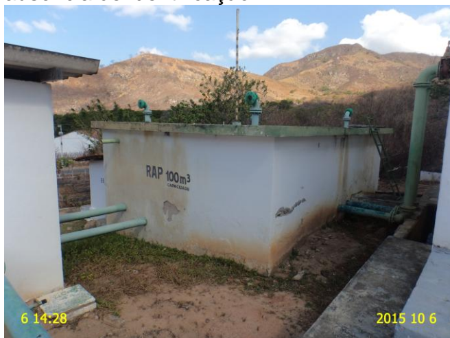
Foto 35 - RAP-01: pintura e reboco deteriorados.
