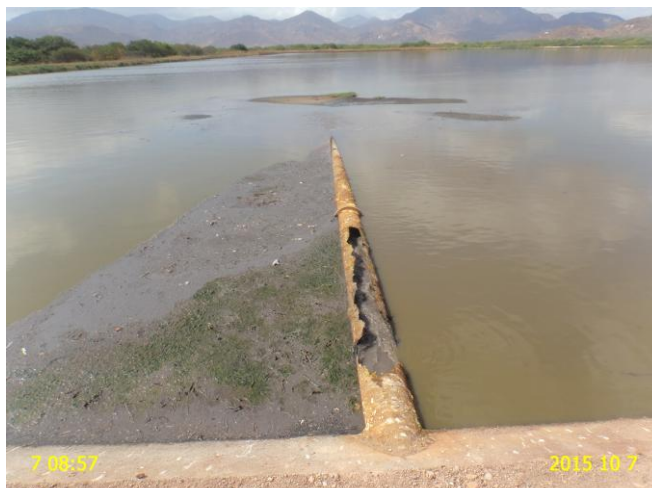
Foto 26 - ETE: tubulação de chegada de esgoto bruto danificada.
