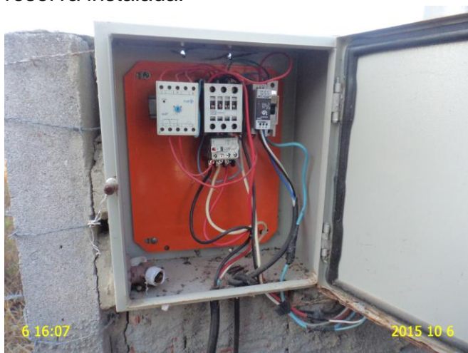
Foto 5 - Booster Julio I: ausência de horímetro instalado no QC.
