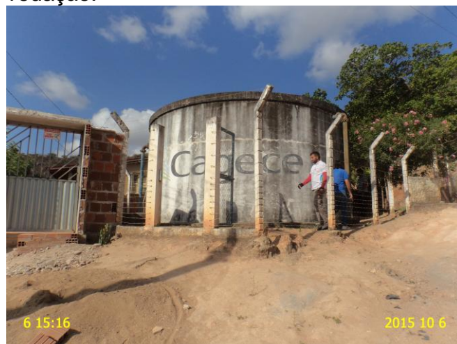
Foto 34 - RAP-05: pintura deteriorada e ausência de identificação.
