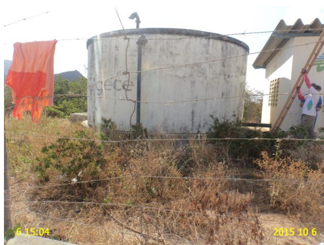
Foto 30 - RAP-04: ausência de identificação, pintura deteiorada e vegetação excessiva na área do reservatório.
