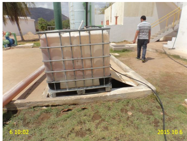
Foto 32 - REN-01: tampa de inspeção sem vedação.
