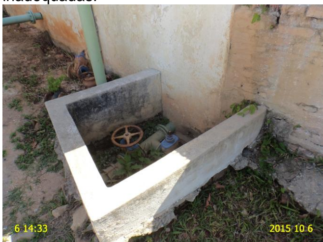
Foto 27 - RAP-01: caixa de inspeção sem tampa ou grade de proteção.
