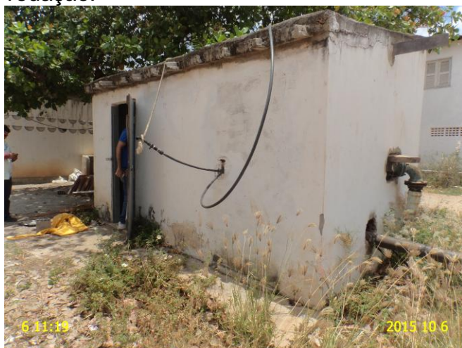
Foto 33 - EERD-02 (Booster REN-03): ausência de identificação.
