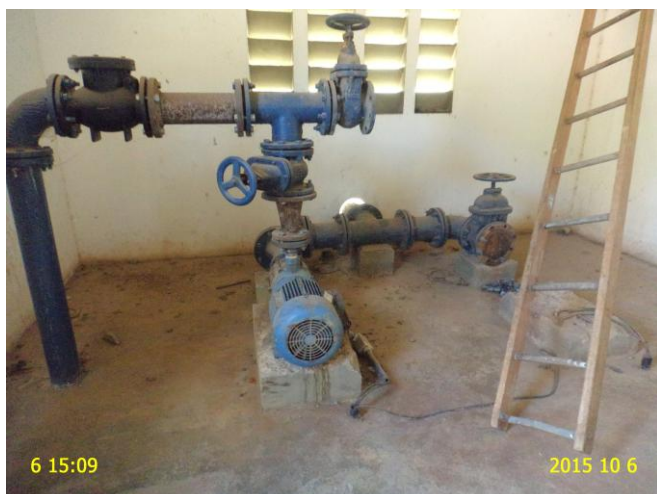
Foto 3 - EERD-04: ausência de bomba reserva instalada.
