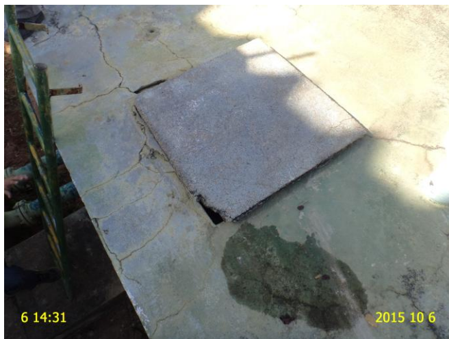
Foto 31 - RAP-01: tampa de inspeção sem vedação.
