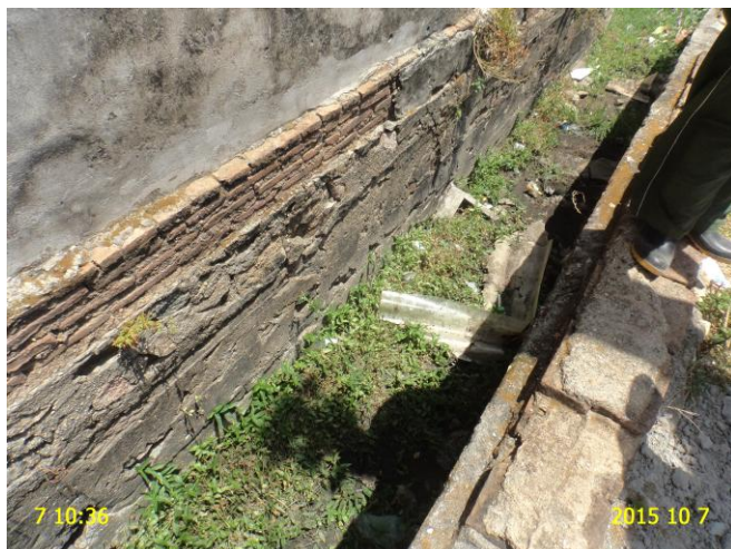
Foto 38 - RCE: lançamento de esgoto à céu aberto na Travessa Inocêncio Braga.
