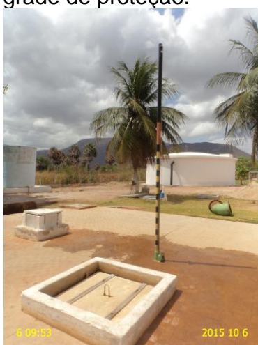
Foto 29 - REN-01: pintura deteriorada e sinais de extravasamento.
