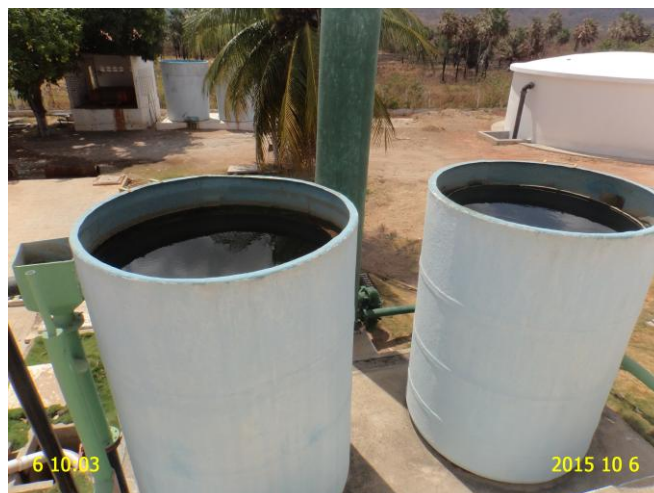
Foto 10 - F-09 e F-10: ausência de tampas.
