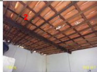
Foto 22 - ETE: casa de apoio ao operador com fechadura danificada (1) e sem iluminação elétrica (2).
