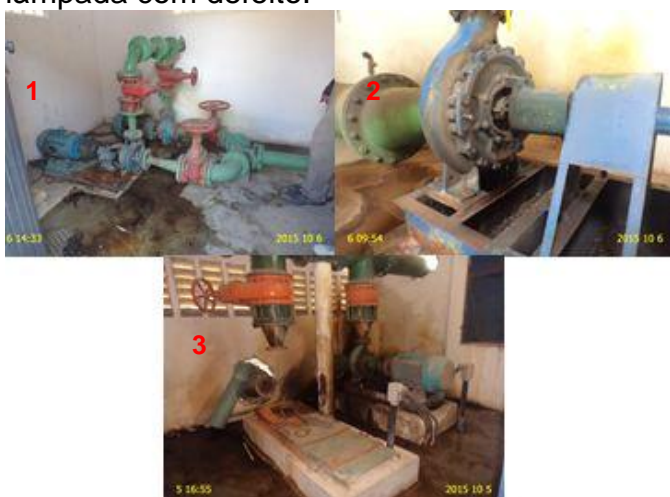
Foto 15 - EEAT-02 (1), EEAT-03 (2) e EEPR-01 (3): vazamento nas gaxetas das bombas.
