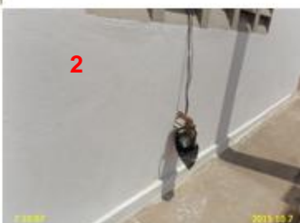
Foto 21 - EEE-02 (1) e EEE-03 (2): instalações elétricas inadequadas
