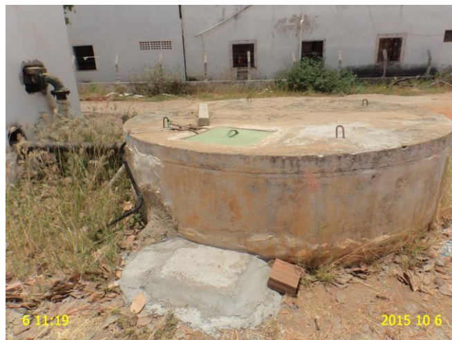
Foto 8 - REN-03: ausência de identificação, ausência de tubulação de ventilação e pintura deteriorada.
