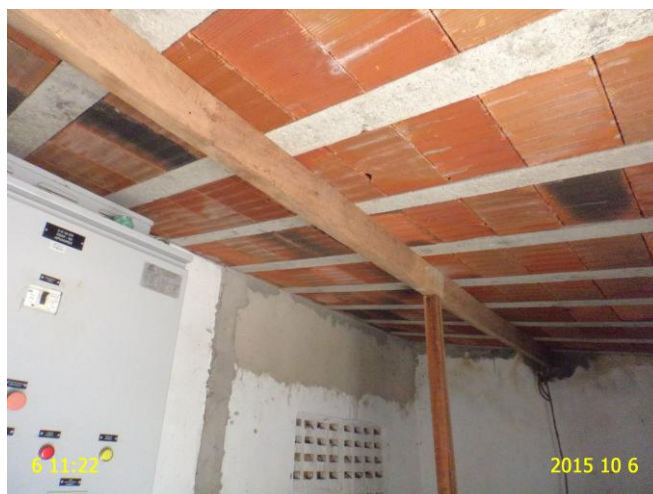
Foto 14 - Booster REN-03: ausência de iluminação elétrica.
