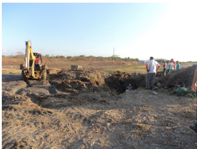
Foto 1 - AAB-02: Ocorrência operacional nº 000030/UNBCL - Retirada de vazamento na adutora do Açude Gameleira.
