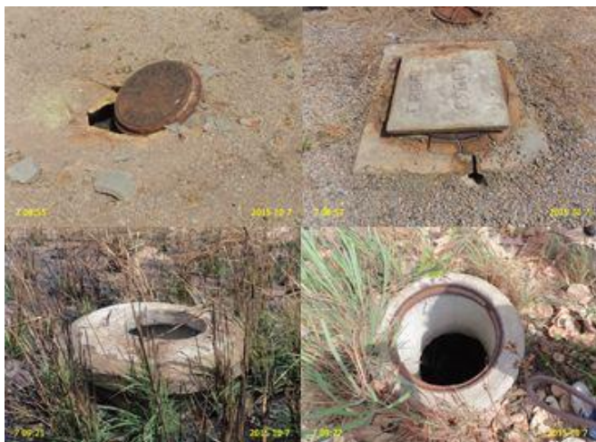
Foto 25 - ETE: caixas de inspeção ou passagem sem tampas ou com tampas inadequadas.
