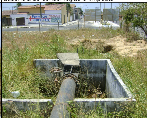
Foto 8 – Caixa de inspeção danificada e tomada pela vegetação.
