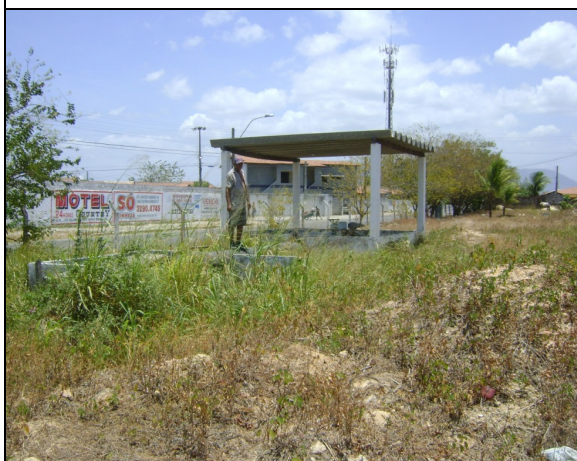
Foto 7 – Área do REL: ausência de conservação e limpeza.
