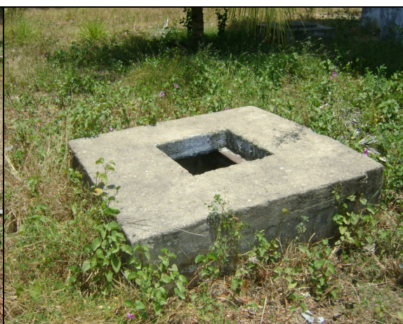
Foto 10 – Caixa de inspeção sem tampa/grade na área do REL.
