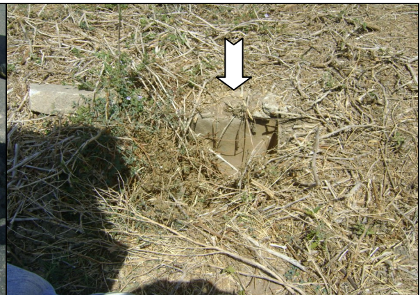
Foto 18 – Registro de descarga soterrado na Rua 1 x Rua M.
