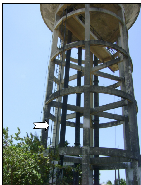
Foto 14 – REL: escada de acesso externa sem gaiola protetora.
