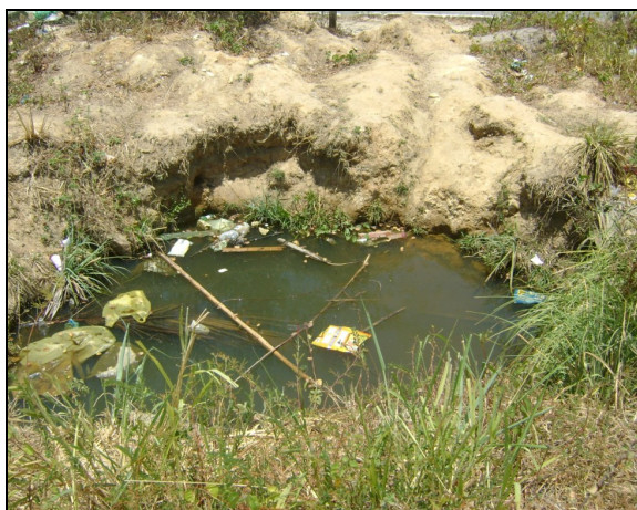
Foto 11 – Área do REL: vazamento em tubulação e erosão.
