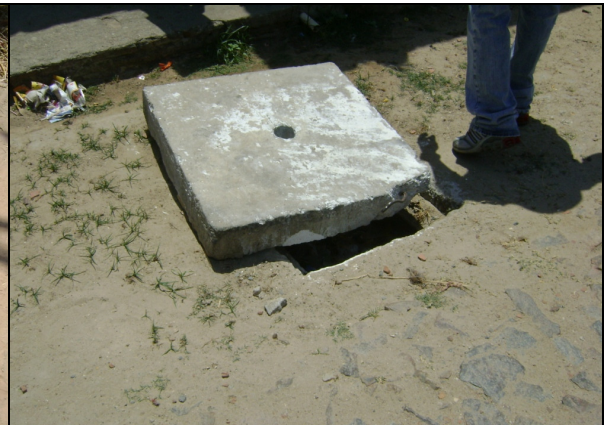
Foto 16 – Registro de manobra apresentando tampa sem fechamento adequado, na Rua 84, nº 09.
