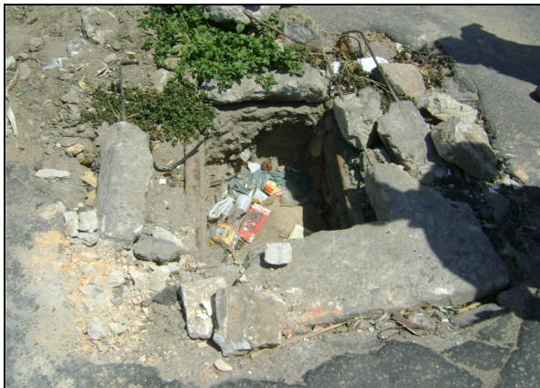
Foto 17 – Registro de descarga na Rua 45 x Av. VI apresentando caixa danificada
