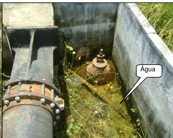
Foto 12 – Vazamento em registro existente na área do REL.
