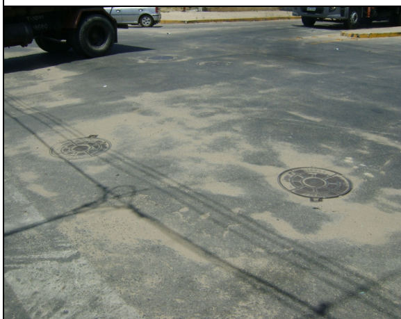
Foto 3 – UTR 44: caixas de inspeção dos aparelhos de medição instalados no cruzamento da Rua 20 com Rua 4 (Novo Maracanaú).
