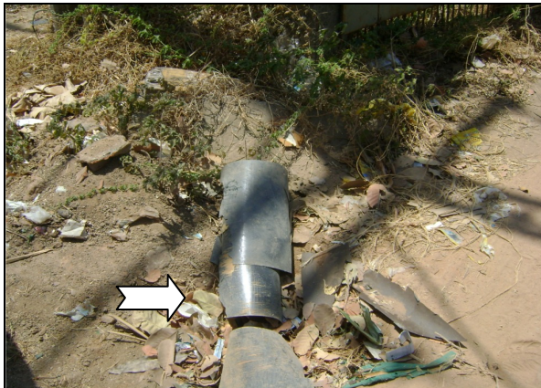
Foto 15 – Registro de descarga soterrado na Rua Miguel Alves x Antônio Alencar (Via férrea).
