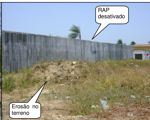
Foto 6 – Área do REL: RAP desativado e ausência de conservação e limpeza.
