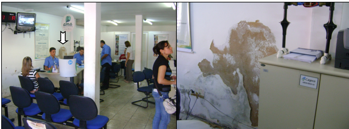
Fotos 26 e 27 – Paredes com revestimento deteriorado na loja de atendimento no bairro Jereissati.
