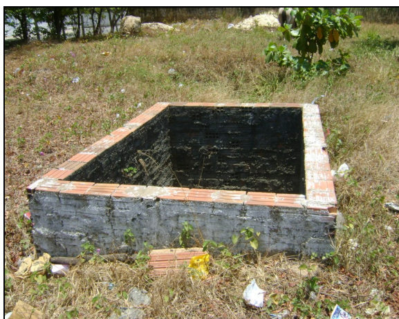
Foto 9 – Caixa de inspeção do macromedidor sem tampa/grade na área do REL.
