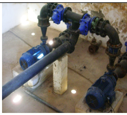
Foto 21 – EEAT-02 – Distrito de Capivara - conjuntos motores-bomba.
