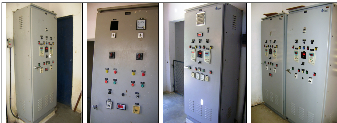
Fotos 24, 25, 26 e 27 – Quadros de comando das elevatórias EECS-01, EEAT-01, EEAT-02 e EEAT-03.
