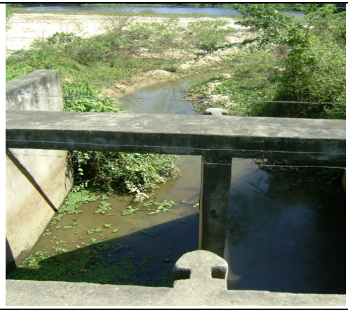
Foto 2 – Canal para captação.
