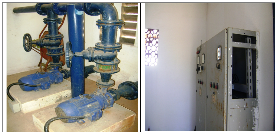
Foto 22 – EEAT-03 – Ocara - conjuntos motores-bomba.
