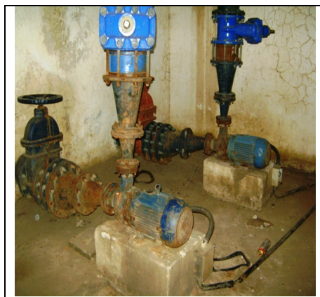
Foto 3 - EECS-01 – Captação - conjuntos motores-bomba.
