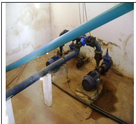
Foto 19 - EEAT-01 – ETA - conjuntos motores-bomba.
