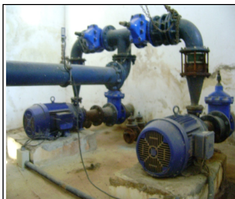
Foto 20 – EELF-01 – ETA - conjuntos motores-bomba.
