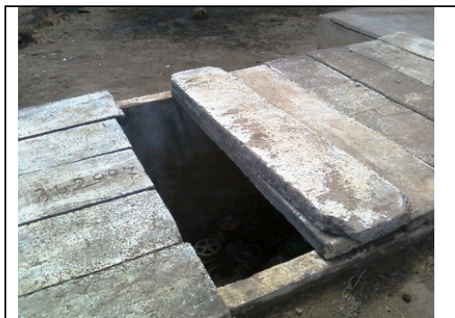
Foto 46 – Adutora de água tratada - caixa de proteção aberta
