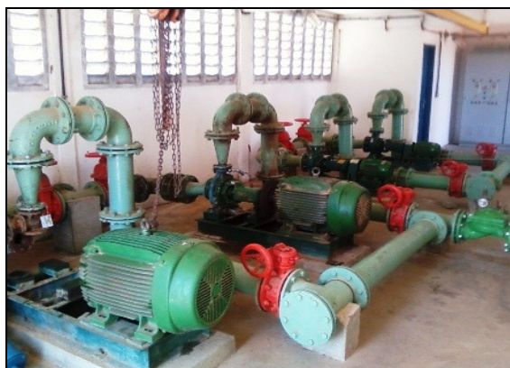
Foto 19 – EEAT-01 e EELF-01 – detalhes dos conjuntos motores-bomba
