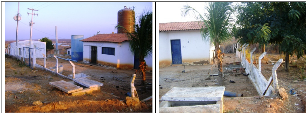
Fotos 31 e 32 – Área dos reservatórios RAP-03 e RAP-04
