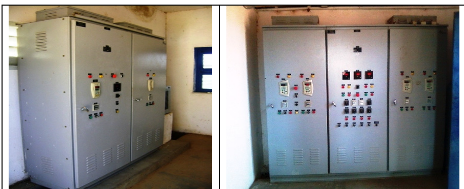
Fotos 22 e 23 – Quadros de comando das elevatórias EEAB-01, EEAT-01 e EELF-01
