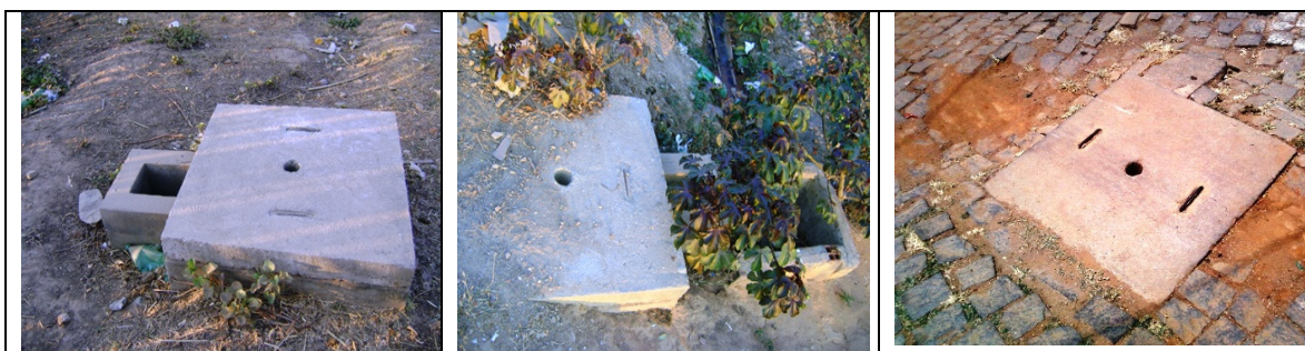
Fotos 51, 52 e 53 – Registros de descarga nas Avenidas Antonio Amâncio Rodrigues e Pedro Batista dos Santos e Rua José Deir Mota
