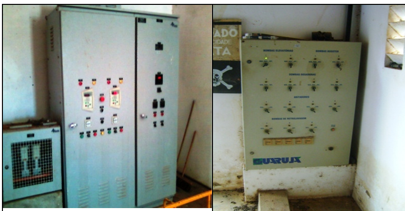
Fotos 24 e 25 – Quadros de comando das elevatórias EEAT-02 e EEAT-03
