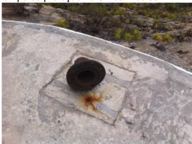
Foto 13 – RAP-01: tubulação de ventilação sem tela de proteção.
