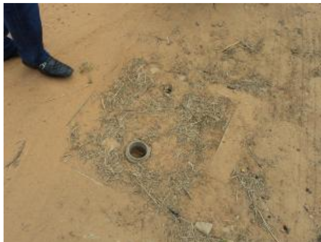
Foto 10 – RDA: registro de descarga sem tampa de proteção na Rua Joaquim Barbosa.
