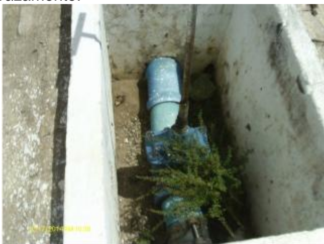
Foto 7 – ETA: registro com caixa sem tampa ou grade de proteção.
