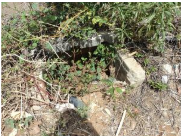
Foto 9 – RDA: registro de descarga sem caixa na Rua Joaquim Medeiros (1).
