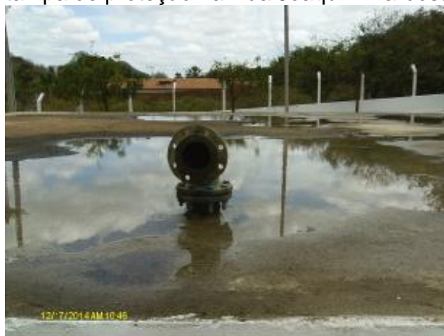
Foto 12 – RSE-01: tubulação de ventilação sem tela de proteção.
