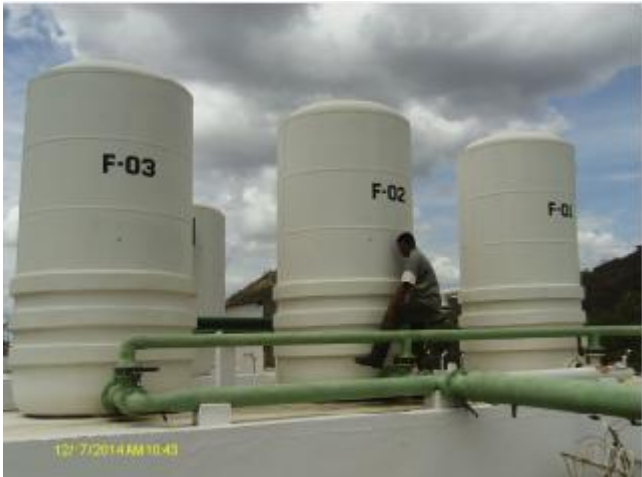
Foto 3 – Filtros: ausência de escadas de acesso.
