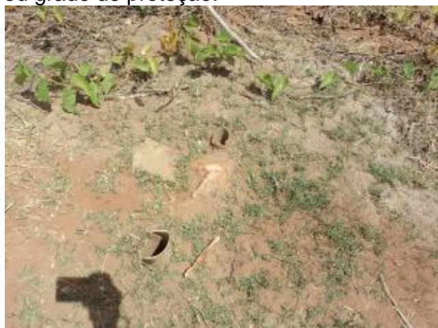
Foto 8 – RDA: registro de descarga sem caixa na Rua Joaquim Medeiros (1).
