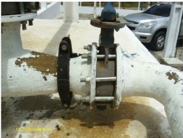
Foto 5 – Filtro F-01: presença de vazamento.
