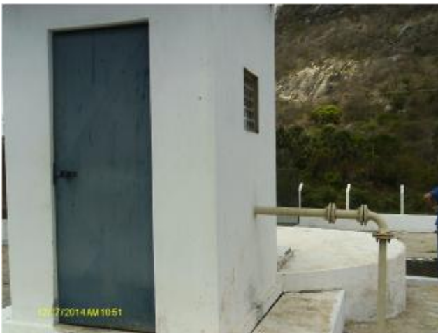
Foto 14 – ETRG (desativada): estação elevatória e reservatório.
