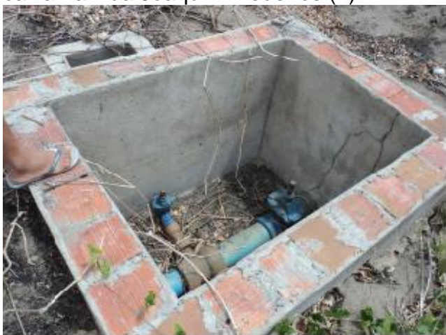
Foto 11 – RDA: registro de descarga sem tampa de proteção na CE da Biodiesel.
