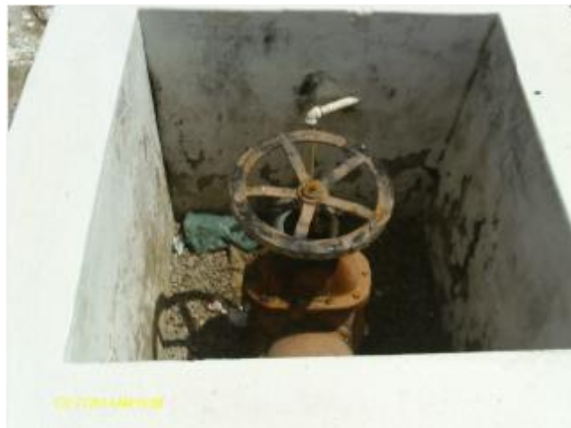
Foto 6 – ETA: registro com caixa sem tampa ou grade de proteção.
