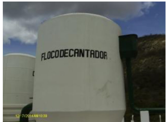
Foto 2 – Floccodecantadores: ausência de escada de acesso.
