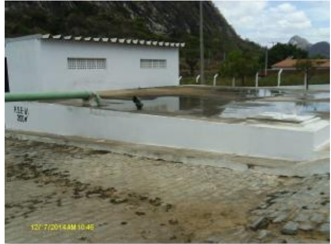
Foto 4 – RSE-01: acúmulo de água no RSE-01.
