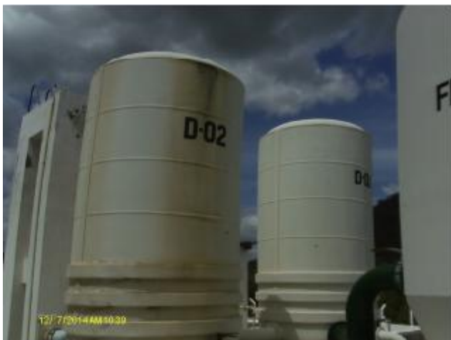
Foto 1 – Decantadores: ausência de escadas de acesso.
