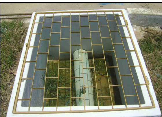
Foto 25 – Caixa de inspeção da estação pitométrica da adutora de água tratada, localizado na entrada do REL-01.
