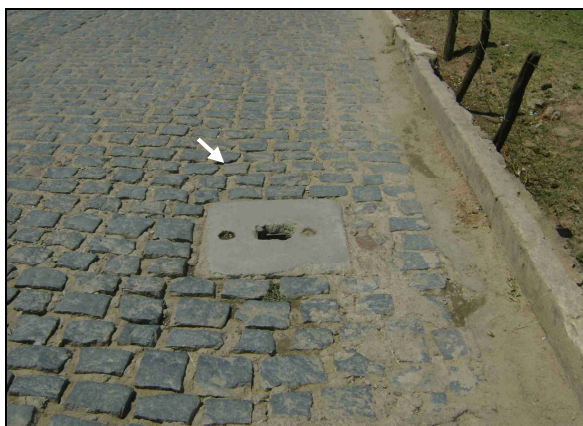
Foto 36 – Registro de descarga localizado na Av. João Joaquim.
