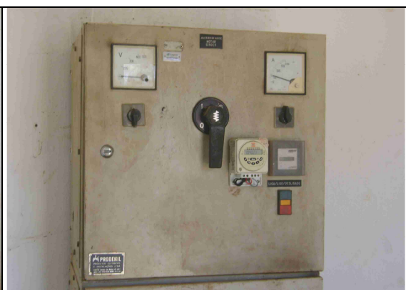
Foto 27 – Quadro de comando da EEAB-01.
