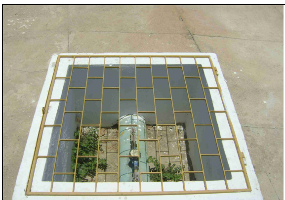
Foto 24 – Caixa de inspeção do medidor proporcional da adutora de água tratada, localizada na entrada do REL-01.
