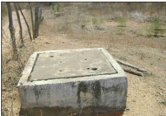
Foto 20 – Adutora de água bruta: Caixa de inspeção de ventosa.
