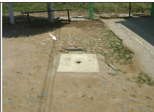
Foto 37 – Registro de descarga localizado na Rua Maria Coração Bezerra.
