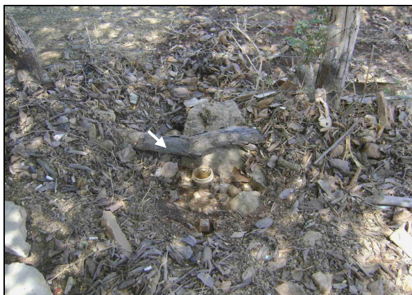
Foto 38 – Registro de descarga sem caixa de proteção, localizado na Rua Vila Freire.
