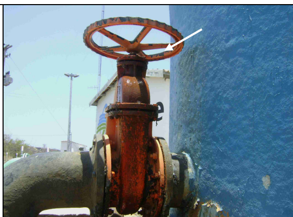
Foto 6 – Vazamento no registro de lavagem do Filtro 1.
