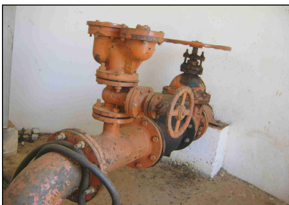
Foto 26 – Recalque do conjunto motor-bomba da EEAB-01, apresentando ventosa.
