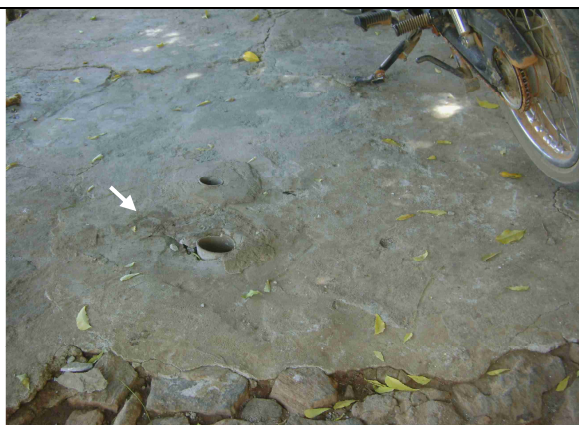
Foto 39 – Registro de descarga localizado na Rua Antônio Pinto com General Tibúrcio.
