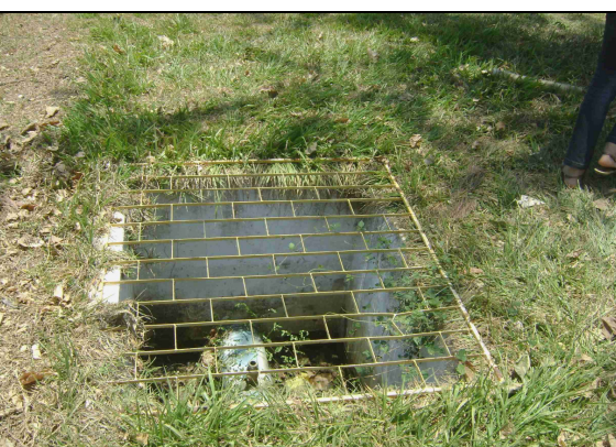
Foto 23 – Caixa de inspeção da estação pitométrica da adutora de água bruta, localizada na ETA (entrada dos filtros).
