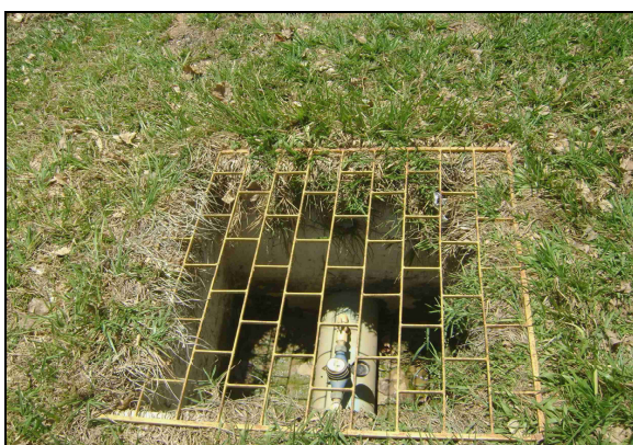
Foto 22 – Caixa de inspeção do medidor proporcional da adutora de água bruta, localizada na ETA (entrada dos filtros).
