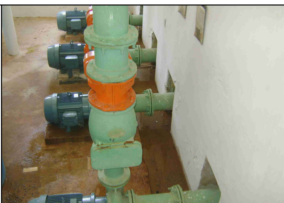
Foto 29 – Conjunto moto-bomba da EEAT-02 e EEAT-03.
