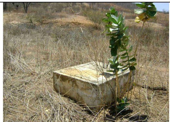
Foto 21 – Adutora de água bruta: Caixa de inspeção de ventosa.
