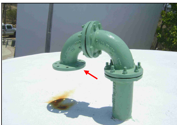
Foto 33 – RAP-02: Tubulação de ventilação sem tela de proteção.
