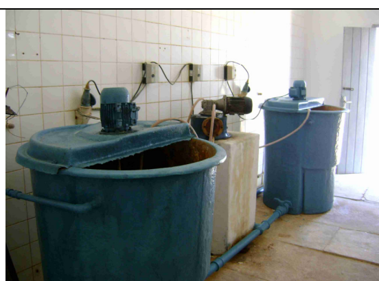
Foto 16 – Tanques de dosagens na casa de química.
