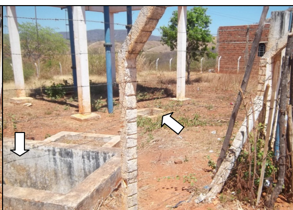
Foto 24 – Área do REL-01: caixas de inspeção sem grades ou tampas.
