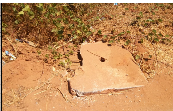
Foto 28 – Registro de descarga localizado na Estrada para Caririçu: tampa danificada.
