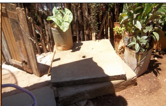
Foto 30 – Registro de descarga localizado na Rua Padre Cícero, 47 - Centro.
