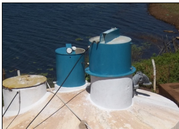
Foto 20 – RAP-01: tanques de dosagem.
