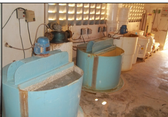
Foto 6 – Tanques dosadores na casa de química.
