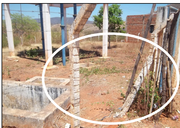
Foto 23 – REL-01: cerca de proteção danificada.
