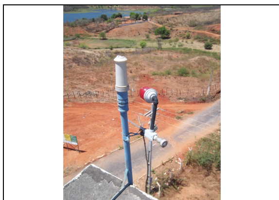
Foto 25 – REL-01: pára-raios danificado.
