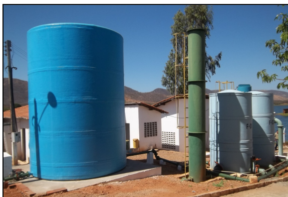
Foto 3 – Decantador e filtros.
