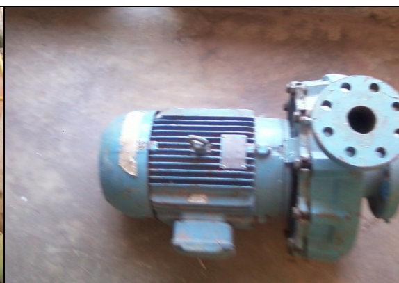
Foto 15 – Conjunto motor-bomba reserva.
