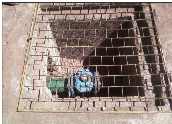
Foto 11 – Macromedidor na saída do RAP-01.
