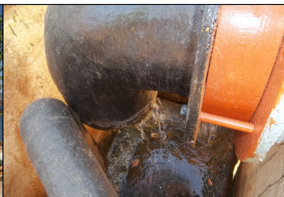
Foto 4 – Registro de descarga do filtro 1 apresentando vedação ineficiente.
