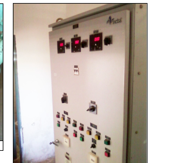
Foto 17 – Quadro de comando da EE-02.
