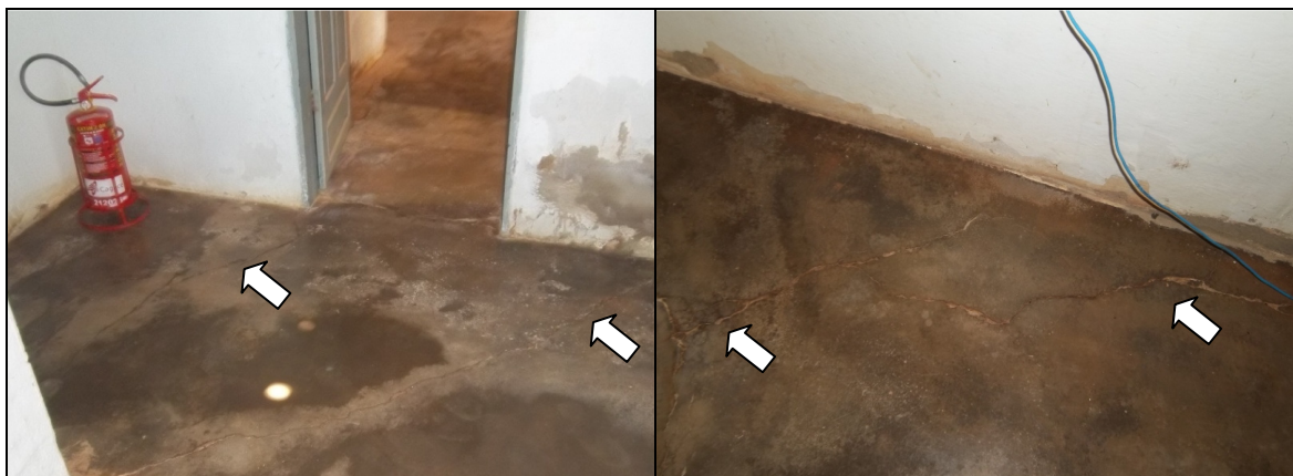
Fotos 39 e 40 – Piso do escritório apresentando trincas.
