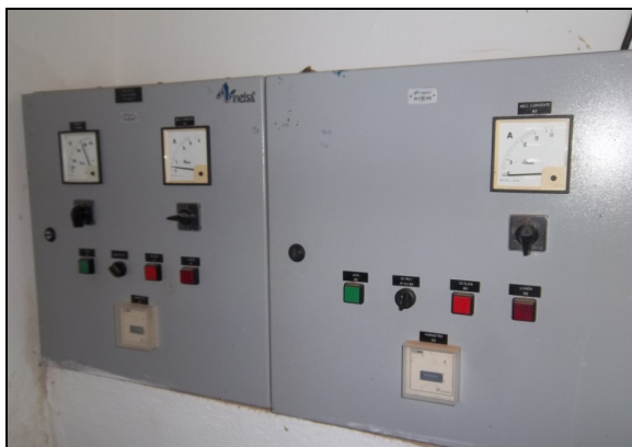
Foto 12 – Quadro de comando da EE-01 - situado na mesma edificação da elevatória EE-02.
