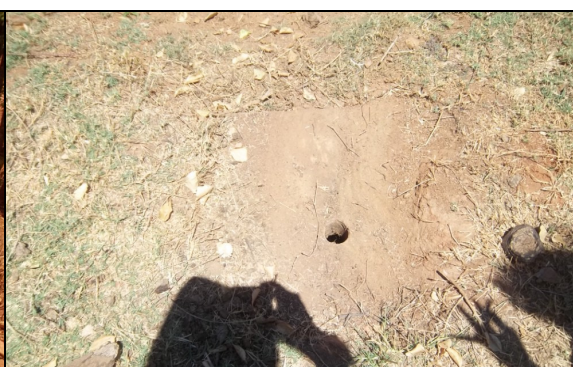
Foto 32 – Registro de descarga localizado no Sítio Junco – Junco.
