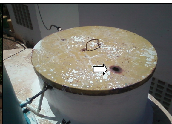
Foto 19 – Tampa de inspeção danificada pela corrosão.
