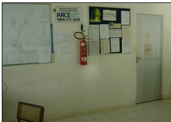
Foto 49 – Extintor de incêndio do escritório.
