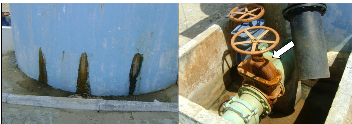
Foto 7 – Vazamento no filtro 1.
