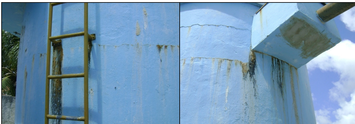
Fotos 5 e 6 – Fissuras com vazamento no filtro 1.
