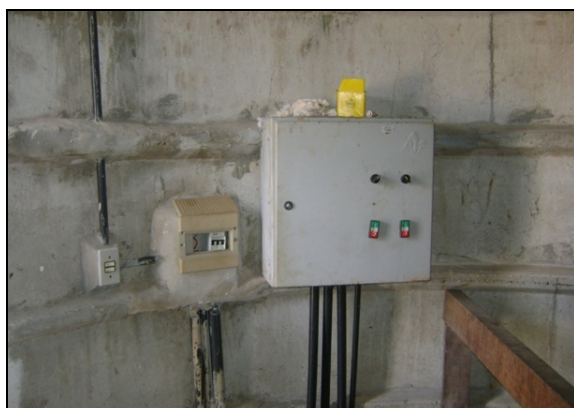
Foto 28 – Quadro de comando da EERD-01.
