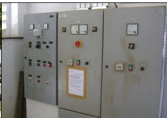
Foto 24 – Quadro de comando das elevatórias EEAT-01 e EEAT-02.
