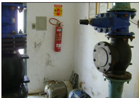
Foto 25 – Extintor de incêndio da casa de comando das elevatórias EEAT-01 e EEAT-02.
