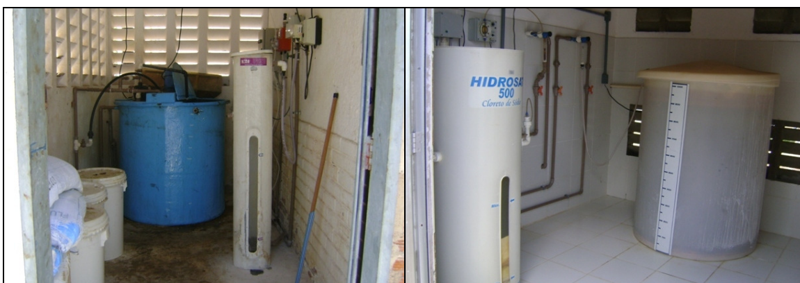
Foto 10 – Dosadores de PAC e de flúor.
