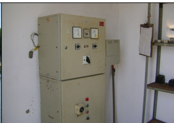
Foto 19 – Quadro de comando da EECS-01.
