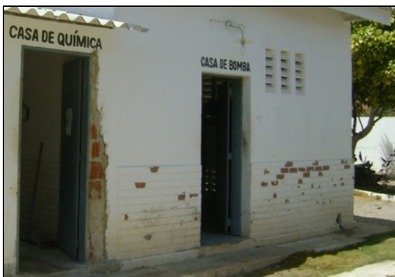
Foto 23 – Casa de comando das elevatórias EEAT-01 e EEAT-02.
