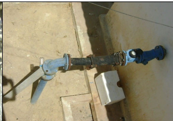
Foto 38 – Macromedidor na saída do RAP-01.
