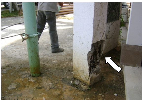
Fotos 34 e 35 – Base dos pilares do REL-01.
