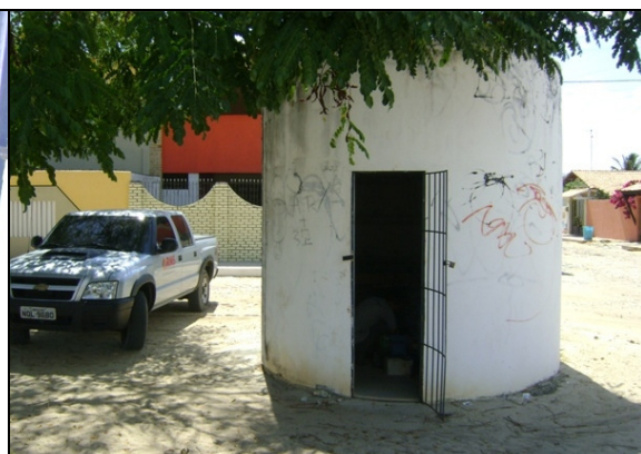
Foto 27 – Casa de comando da elevatória EERD-01.
